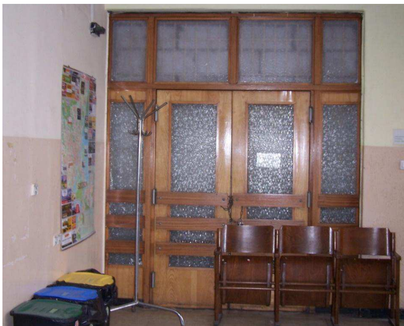
Fot. 5. Drzwi prowadzące na wyłączony z użytku korytarz na I piętrze, oczyszczone z przemalowań, lakierowane.
