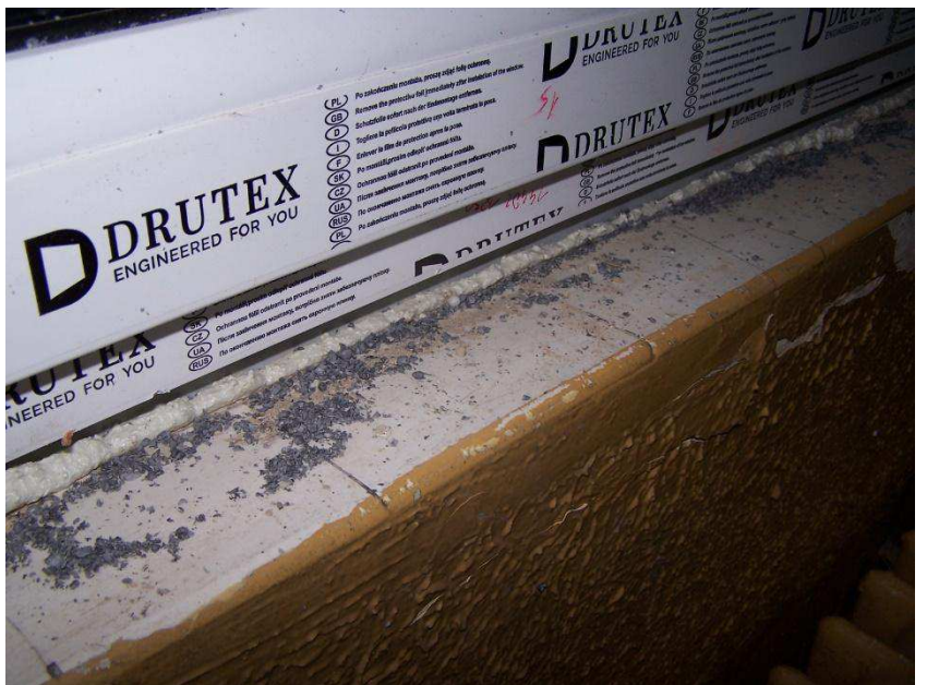
Fot. 26. Parapet z płytek ceramicznych. Usunięte płytki odpływowe.
