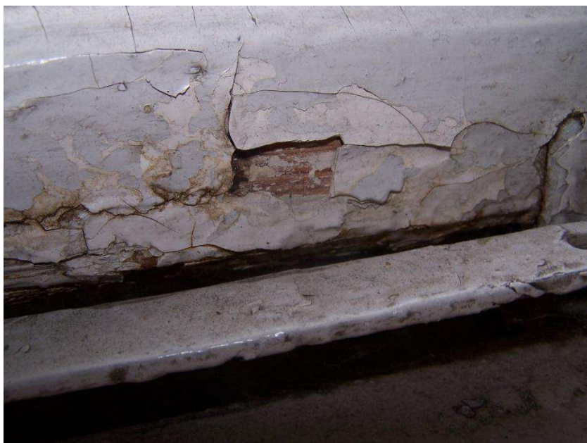
Fot. 10. Odspojone warstwy farb na oryginalnej stolarnie okiennej.
