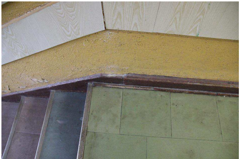
Fot. 25. Posadzka wykończona współczesnymi płytkami PCV. Połączenie cokolika ze sztucznego kamienia z drewnianą listwą przypodłogową.
