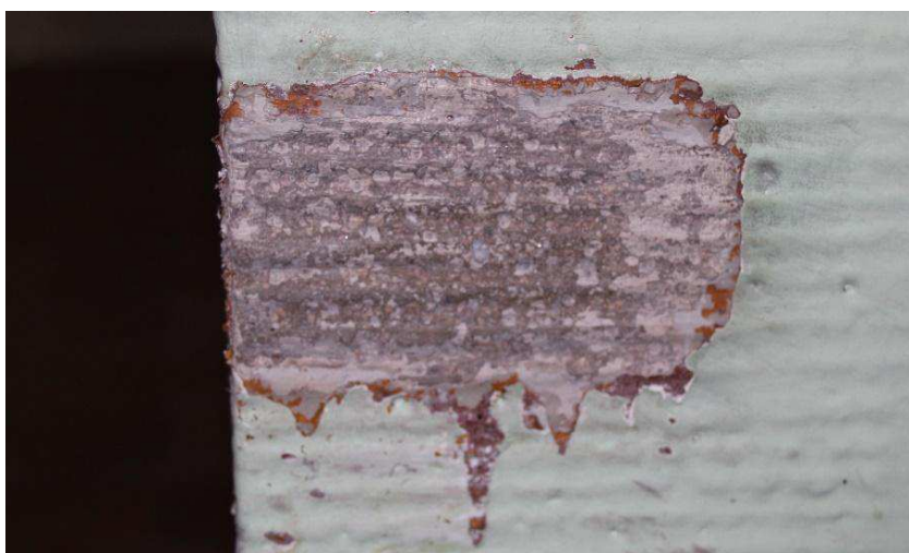
Fot. 15. Odkrywka na słupie: sztuczny kamień, ryflowany.
