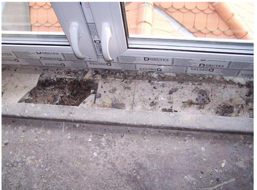
Fot. 35. Współczesna stolarka okienna z PCV, uszkodzony parapet z płytek ceramicznych.
