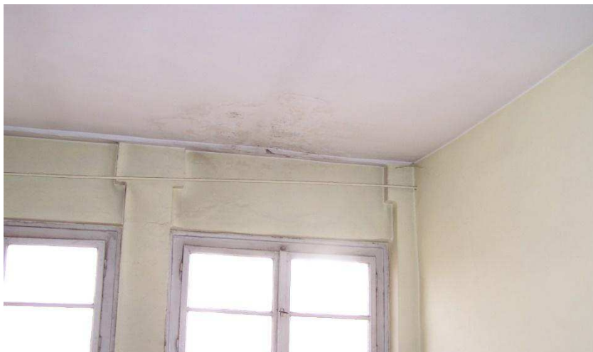
Fot. 1. Uszkodzone wyprawy tynkarskie, widoczne spęcherzenia i przebarwienia: nasiąkanie zewnętrzne
