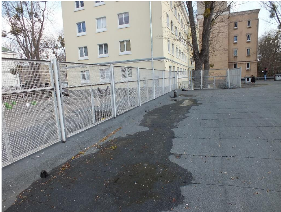
Zdj. 18. Początki korozji i ubytki powłok malarskich ogrodzenia stropodachu
