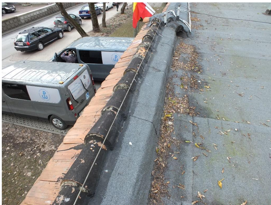
Zdj. 15. Izolacja z papy wykonana na wierzchu dachówki ceramicznej ściany attykowej
