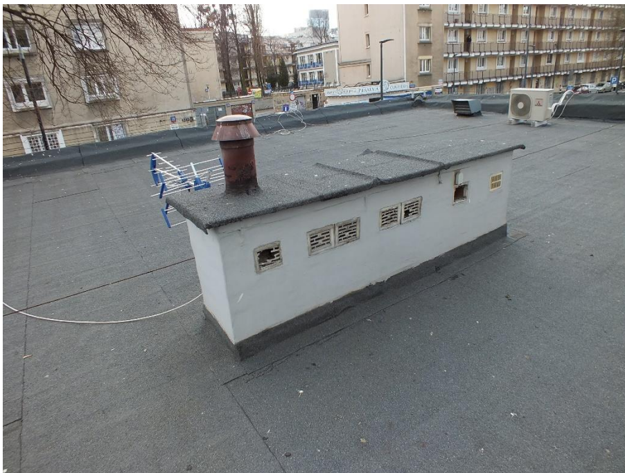
Zdj. 13. Uszkodzenia kominów – degradacja wyprawy elewacyjnej, ubytki kraterk
