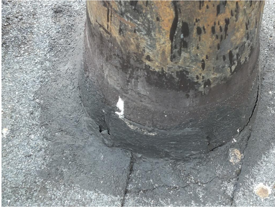
Zdj. 11. Ubytki uszczelnień wywiewek kominowych na styku z pokryciem
