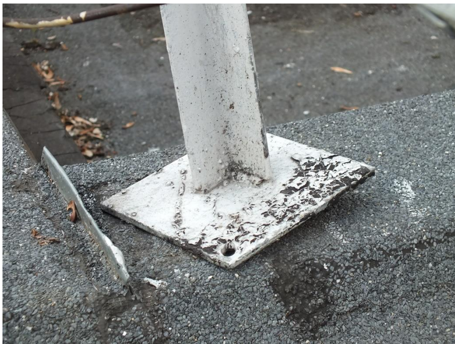
Zdj. 10. Odspojenie stołków instalacji odgromowej
