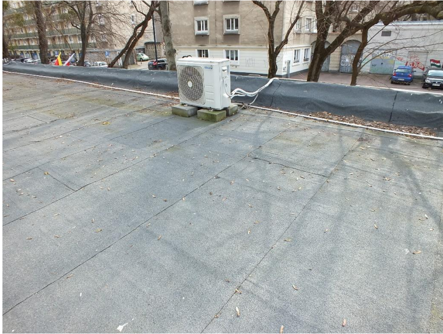
Zdj. 17. Urządzenia ustawione na dachu budynku
