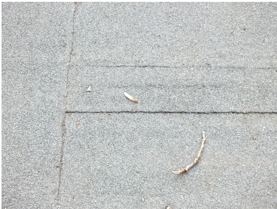
Zdj. 5. Nieprawidłowo wykonane pokrycie – niedogrzone rolki, brak odpowiedniego wypływu
