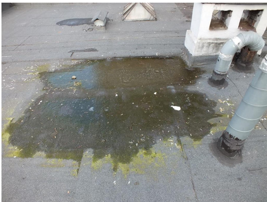
Zdj. 14. Ślady po zastoinach wody świadczące o nieprawidłowym wyprofilowaniu pokrycia dachowego
