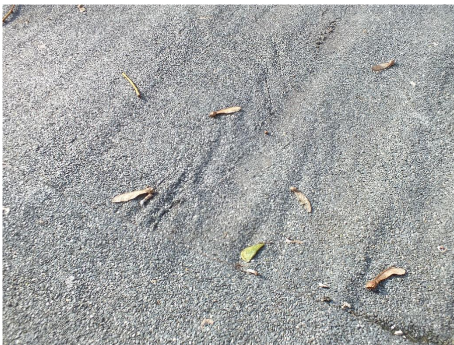
Zdj. 2. Uszkodzenia pokrycia z papy
