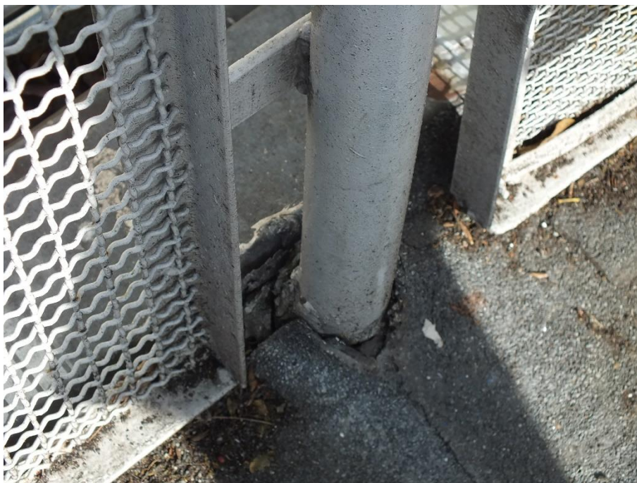
Zdj. 6. Ubytki uszczelnienia pokrycia na styku z słupkami ogrodzenia
