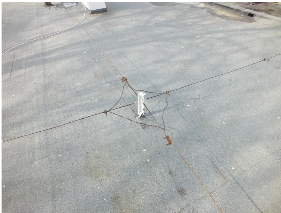
Zdj. 7. Brak uszczelnienia przejść stołków instalacji odgromowej przez pokrycie dachowe z papy
