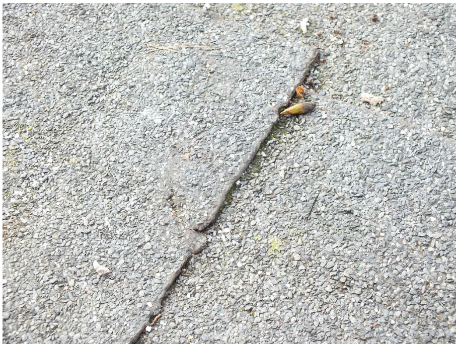
Zdj. 4. Nieprawidłowo wykonane pokrycie – niedogrzone rolki, brak odpowiedniego wypiływu
