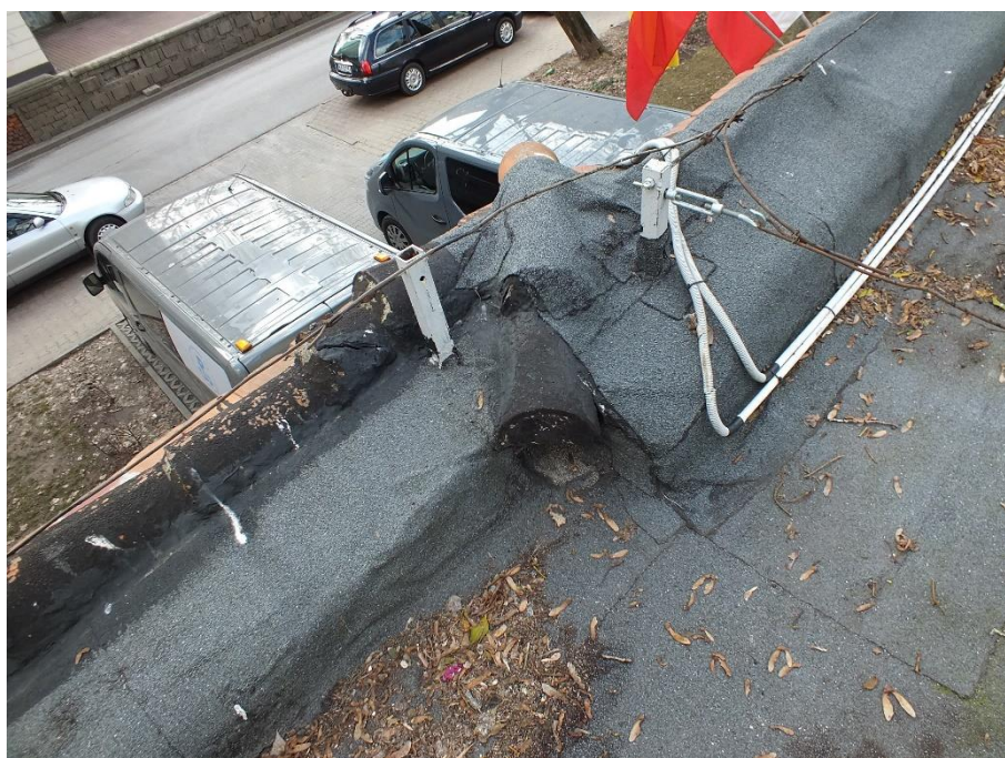
Zdj. 16. Niefachowo wykonane uszczelnienie attyki w narożu
