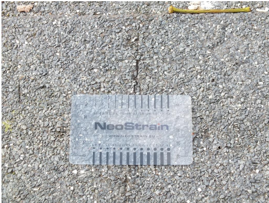
Zdj. 3. Widoczne pęknięcia pokrycia – pomiar rozwartości
