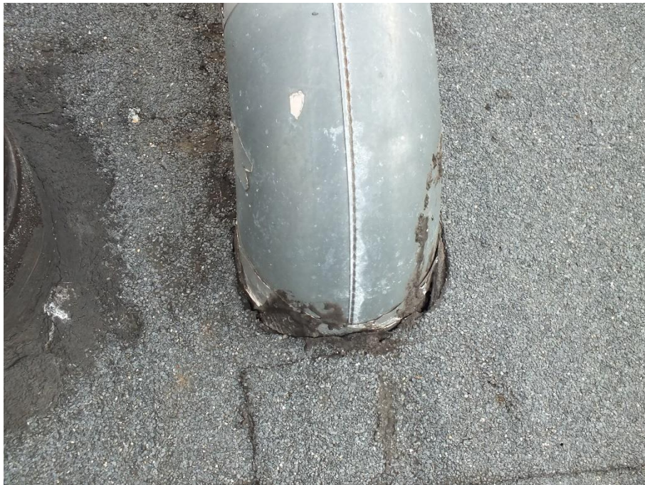
Zdj. 12. Ubytki uszczelnień wywiewek kominowych na styku z pokryciem
