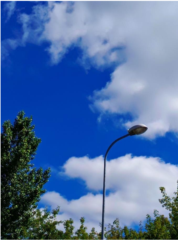
Oprawa typu SGS – drogowa - zamontowana wzdłuż Północnej Obwodnicy Miasta ul. Mościckiego do Sandomierskiej;
