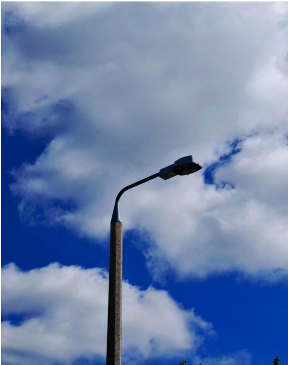
Oprawa typu OUS – drogowa – zamontowana przy ulicy Kosynierów Raclawickich
