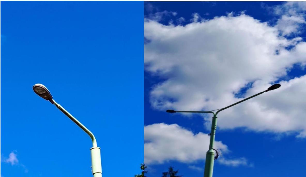
Oprawa typu OU-05 – drogowa – zamontowana między innymi przy ul. Szkolnej, Słonecznej oraz Piłsudskiego;
