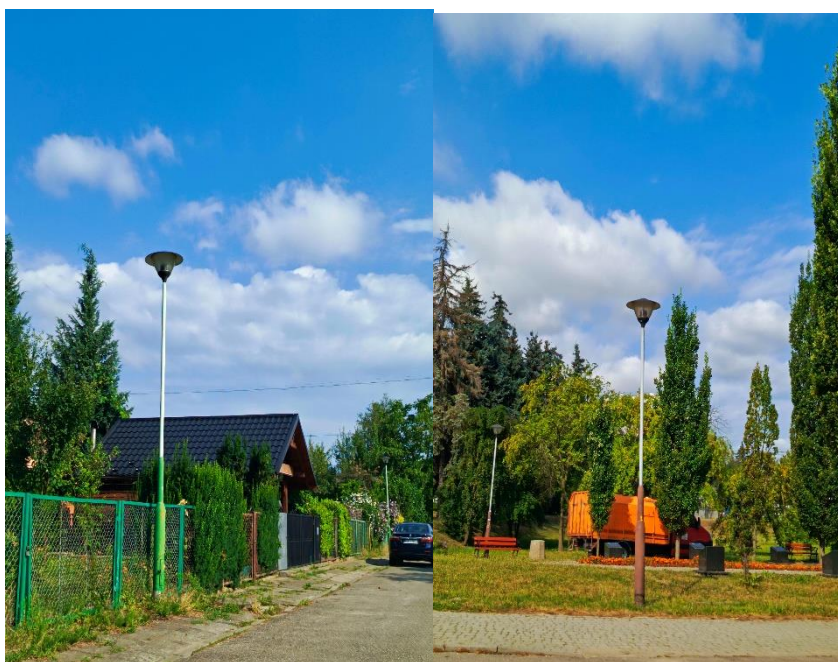
Oprawa typu OCP – Parkowa – zamontowana przy Sportowej, Żółdziowej;
