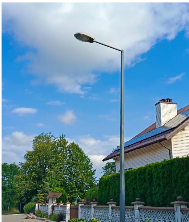
Oprawa typu SGS – zamontowana przy ulicy Cisowej
