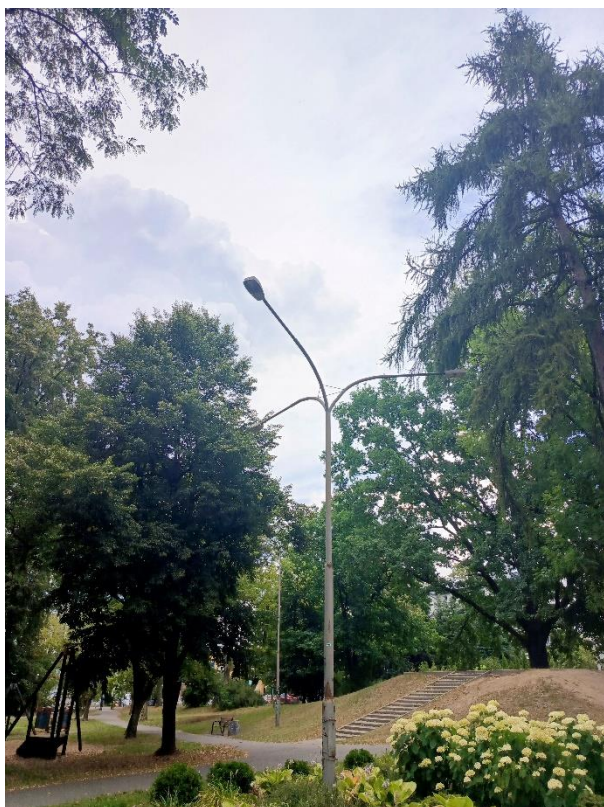
Oprawa typu WSL – zamontowana w Parku Jordanowskim
