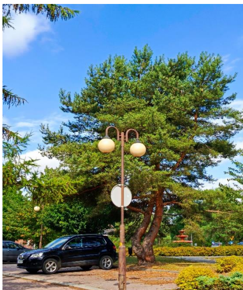
Oprawa typu OPC – kula zamontowana na skwerze Pendereckiego
