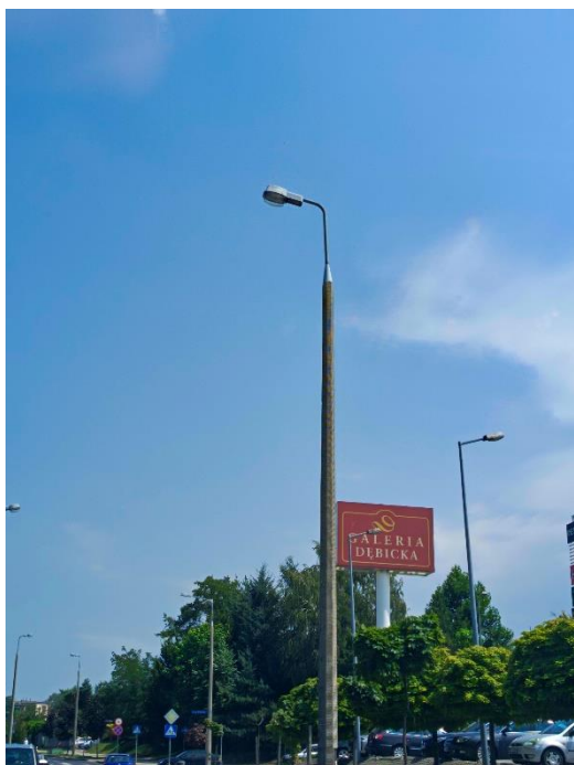
Oprawa typu OSU – drogową – zamontowana m. in. przy ul. Nosala, Chopina, Strażackiej;
