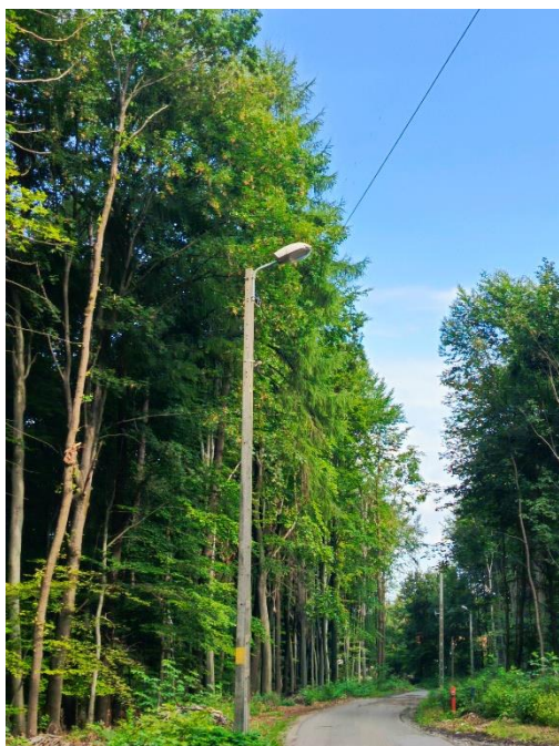
Oprawa typu SGS – drogowa – zamontowana przy ulicy Wilhelma Macha
