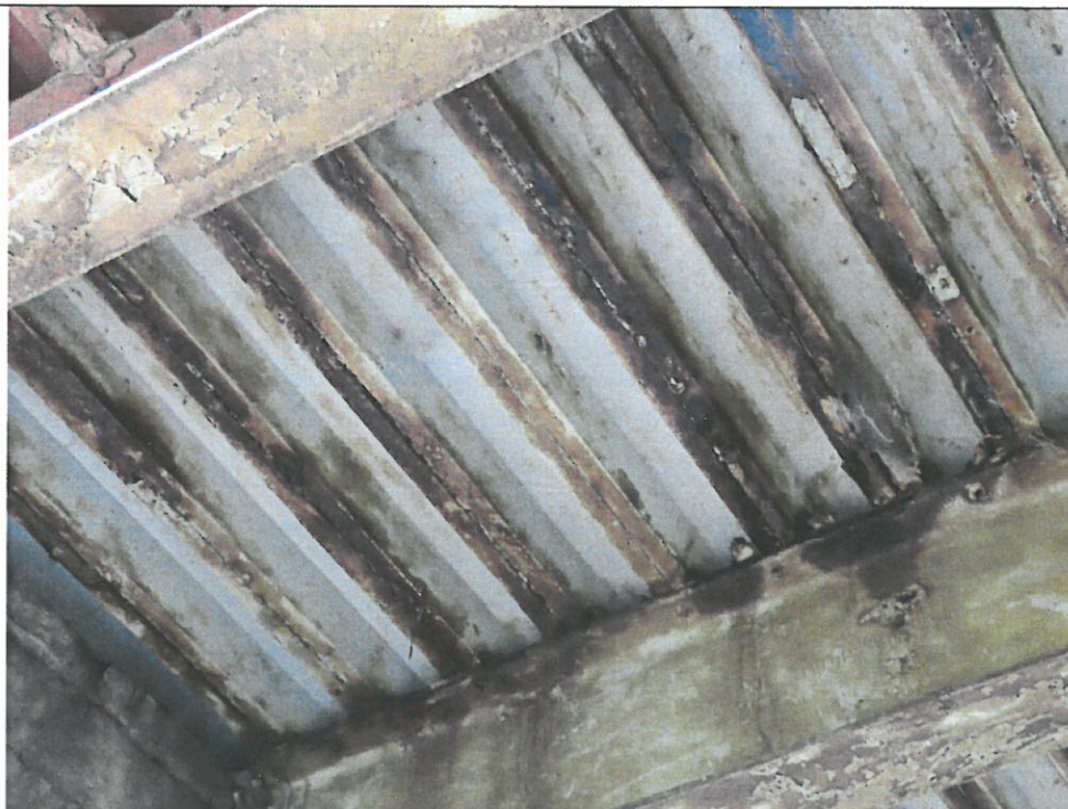
Fot. 4 Korozja pomostu oraz belek dźwigarów głównych cd.
