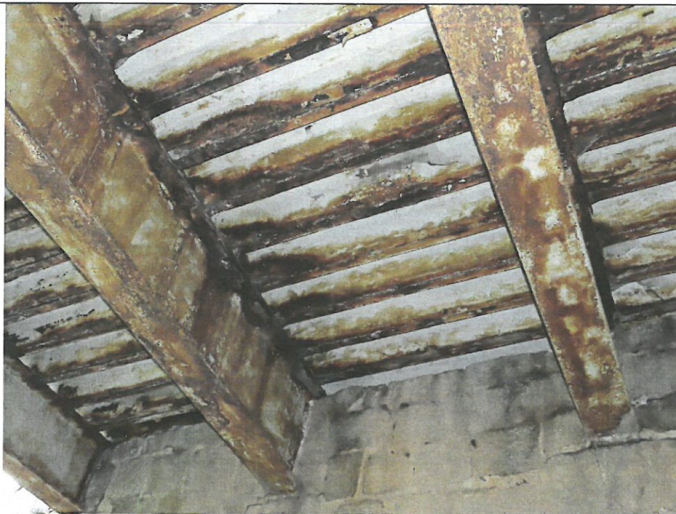
Fot. 3 Korozja pomostu oraz belek dźwigarów głównych
