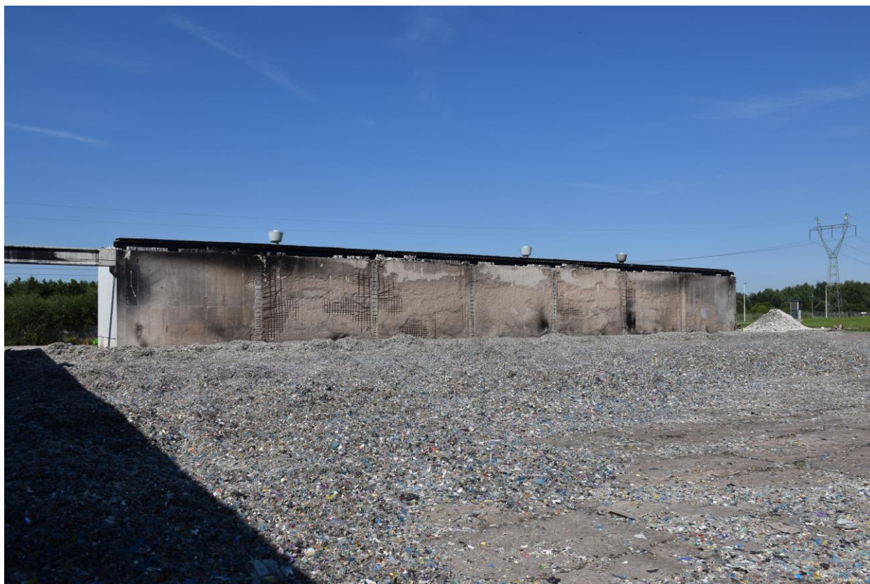
Rys.1a. Ogólny widok odsłoniętej ściany magazynu nr 11, przeznaczonej do naprawy.
