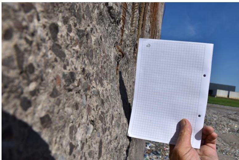
Rys.1c. Widok uszkodzenia otuliny zbrojenia na ścianie magazynu nr 11. Uszkodzenia sięgają do 60mm od pierwotnej powierzchni ściany. Projektuje się naprawę profesjonalnymi systemami naprawczymi PCC .
