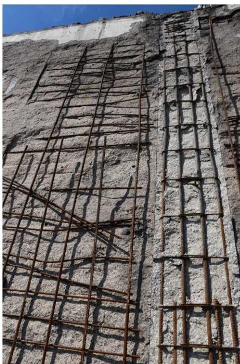
Rys.1b. Widok uszkodzenia otuliny zbrojenia na ścianie magazynu nr 11. Projektuje się naprawę profesjonalnymi systemami naprawczymi PCC .
