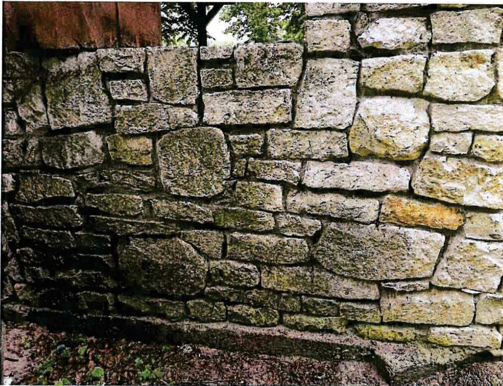
Fot. 3. Altana w pobliżu Dworu w Krzykawce, Fragment muru z ciosów wapienia. Widoczne ciemne i zielone naloty spowodowane zabrudzeniem i aktywnością mikrobiologiczną.
