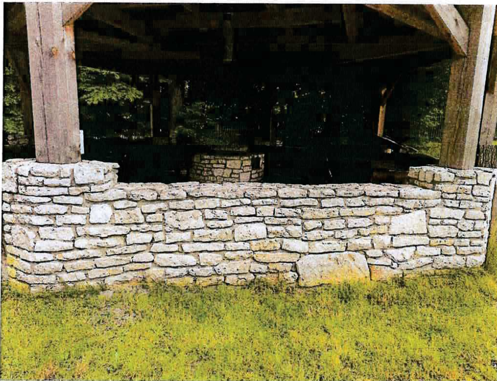
Fot. 4. Altana w pobliżu Dworu w Krzykawce, Inny fragment muru z wapienia, widoczny dobry stan.
