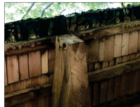
FOT. NR 6 - WIDOK NA DACH ALTANY OD WNETRZA ALTANY WIDOCZNE ZBUTWIALE ELEMENTY POKRYCIA
