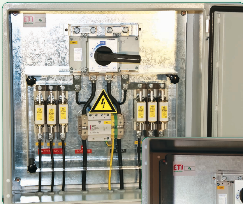
Rozdzielnica DC (wkładki NH gPV)
