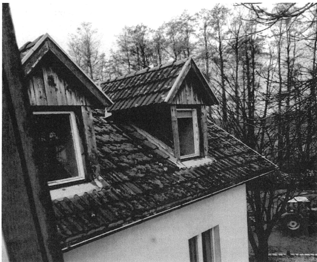
Fot. 12. Dach pokryty mchem oraz porostami.
