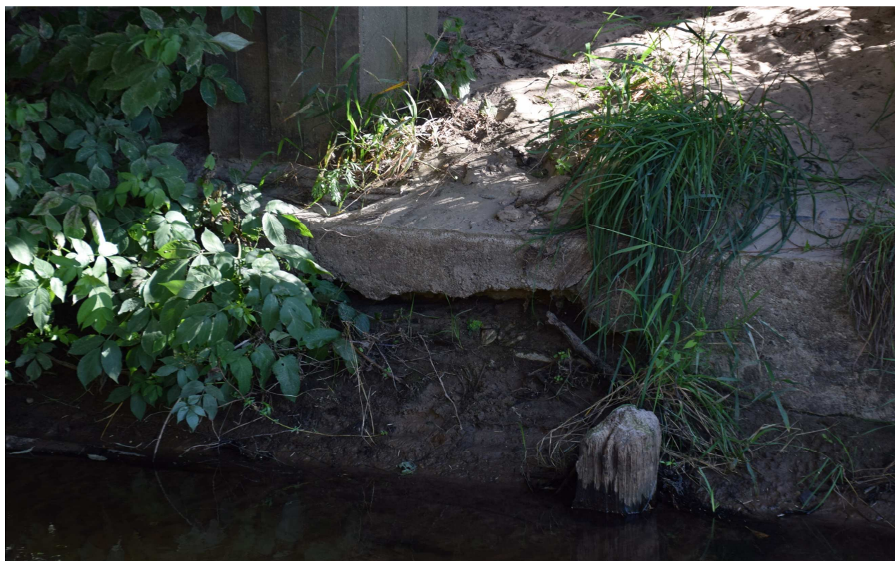
Fot. 11. Wegetacja roślinności, rysy i ubytki betonu filara.
