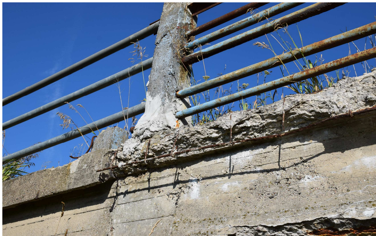
Fot. 9. Korozja i ubytki betonu oraz korozja zbrojenia gzymsu.
