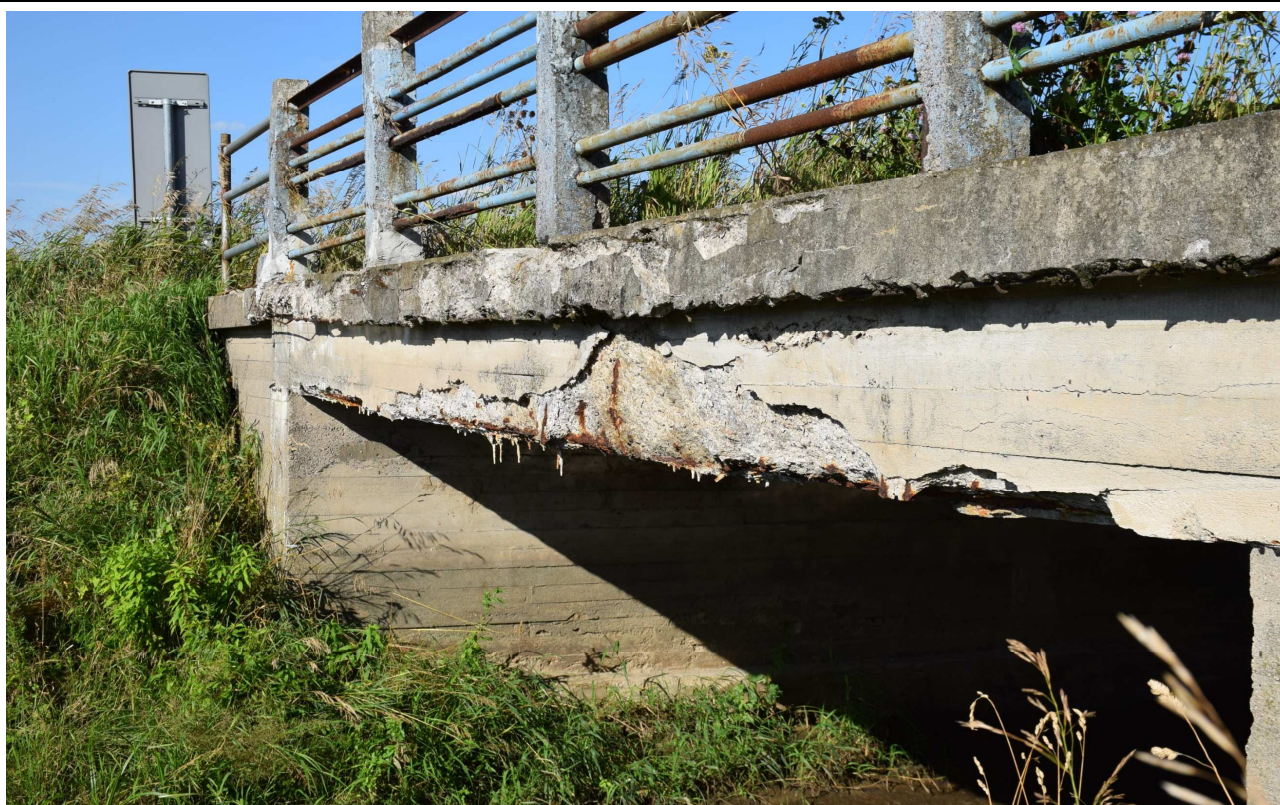
Fot. 6. Korozja, rysy, ubytki i korozja stali zbrojeniowej gzymsu i płyty pomostu.
