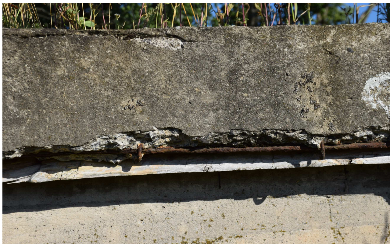
Fot. 7. Ubytki betonu oraz korozja zbrojenia gzymsu.
