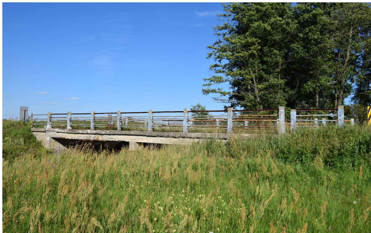
Fot. 3. Widok z boku od strony zachodniej.
