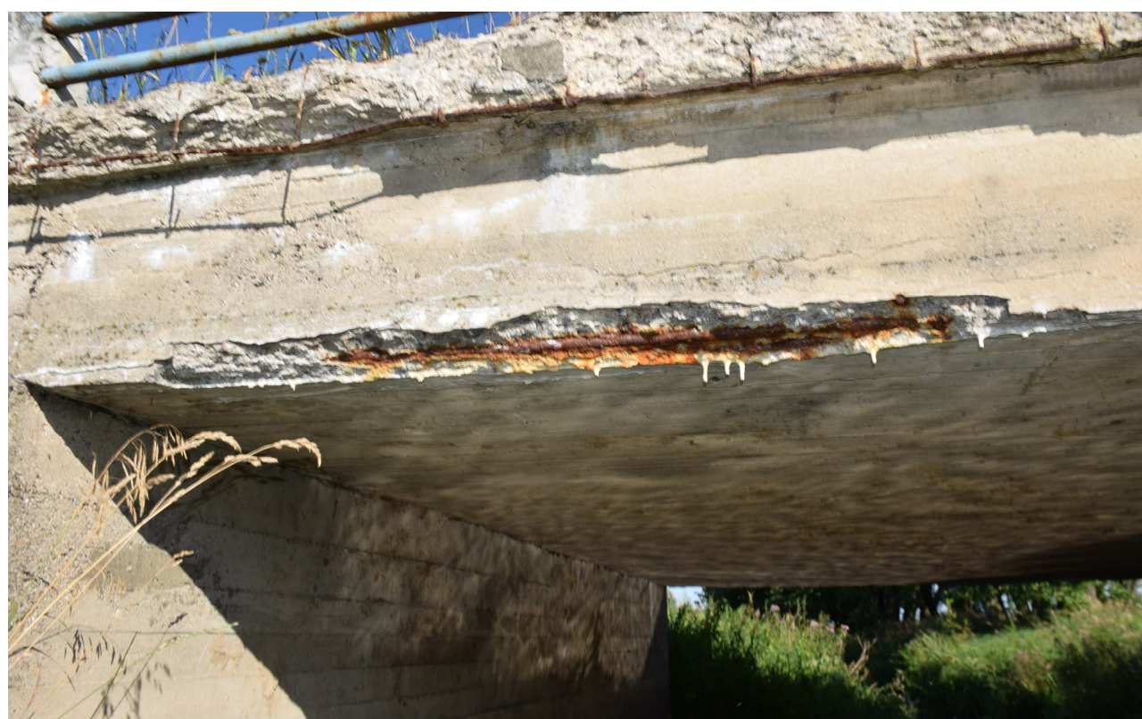
Fot. 10. Korozja, rysy i ubytki betonu dźwigara (płyty pomostu).
