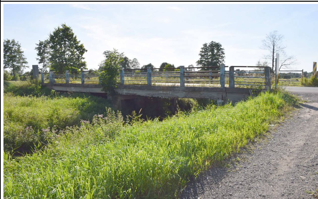
Fot. 2. Widok z boku od strony wschodniej.
