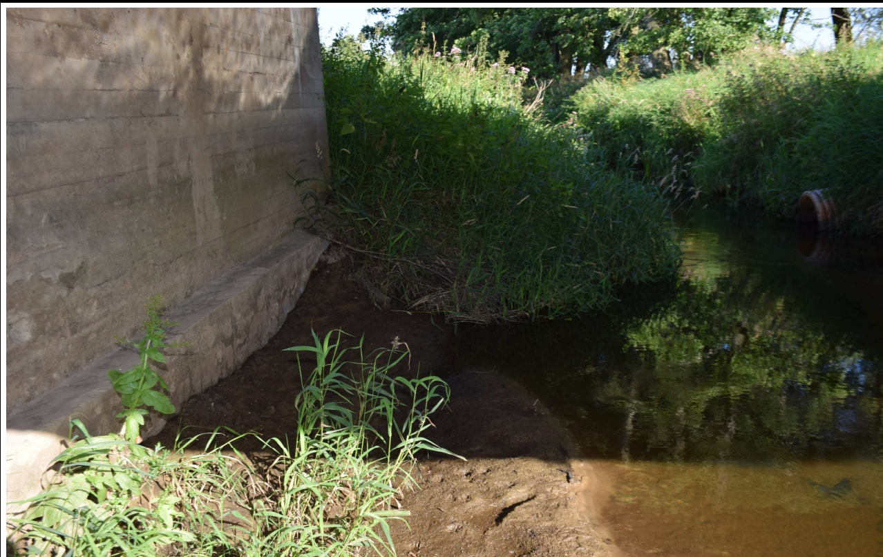
Fot. 12. Ubytki i przemieszczenia terenu oraz wegetacja roślinności w przestrzeni podmostowej.
