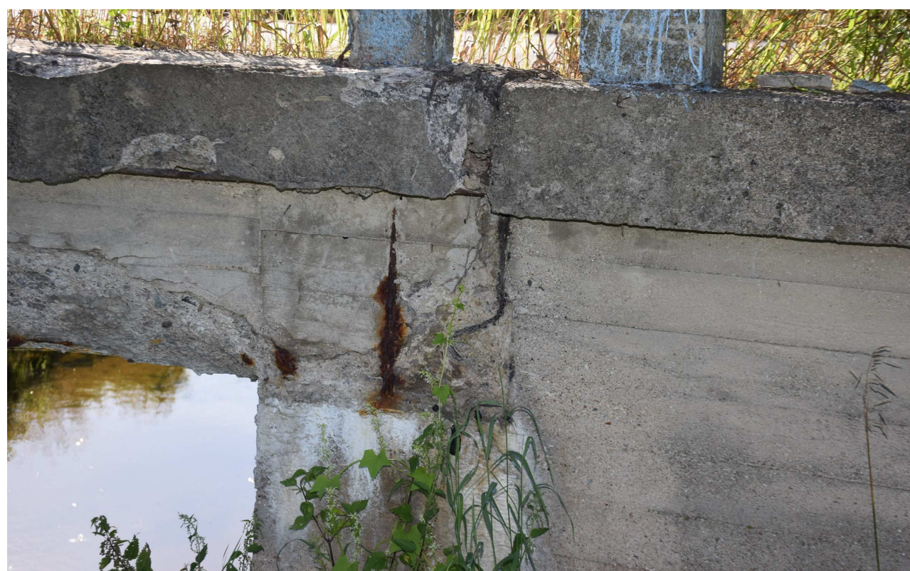
Fot. 8. Ubytki betonu, korozja, rysy i korozja zbrojenia dźwigara (płyty pomostu).
