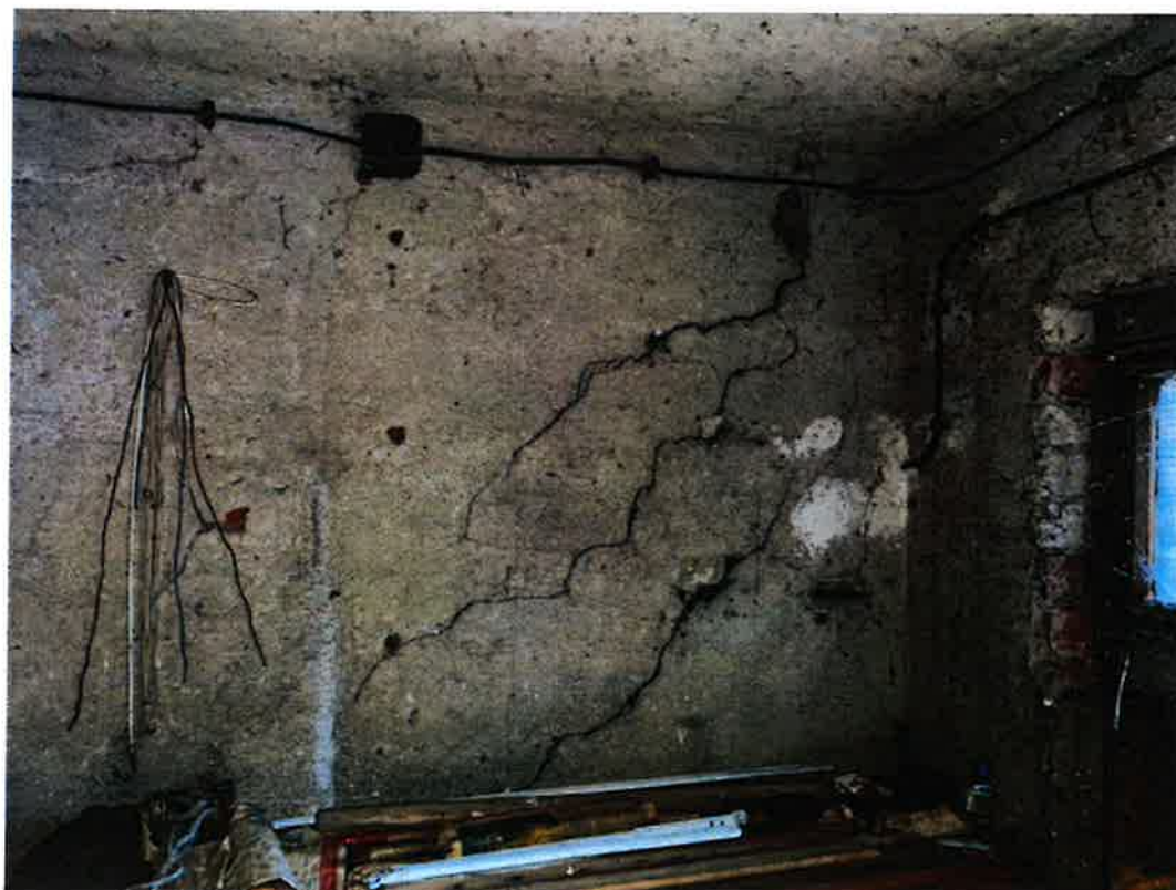
9.7 Spękania ścian murowanych na parterze.
