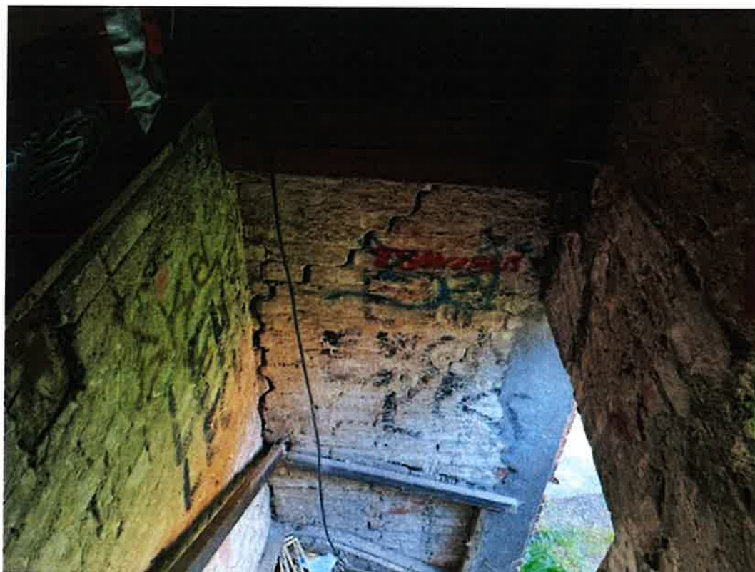
9.13 Pęknięcia ściany murowanej w rejonie schodów na poddasze.
