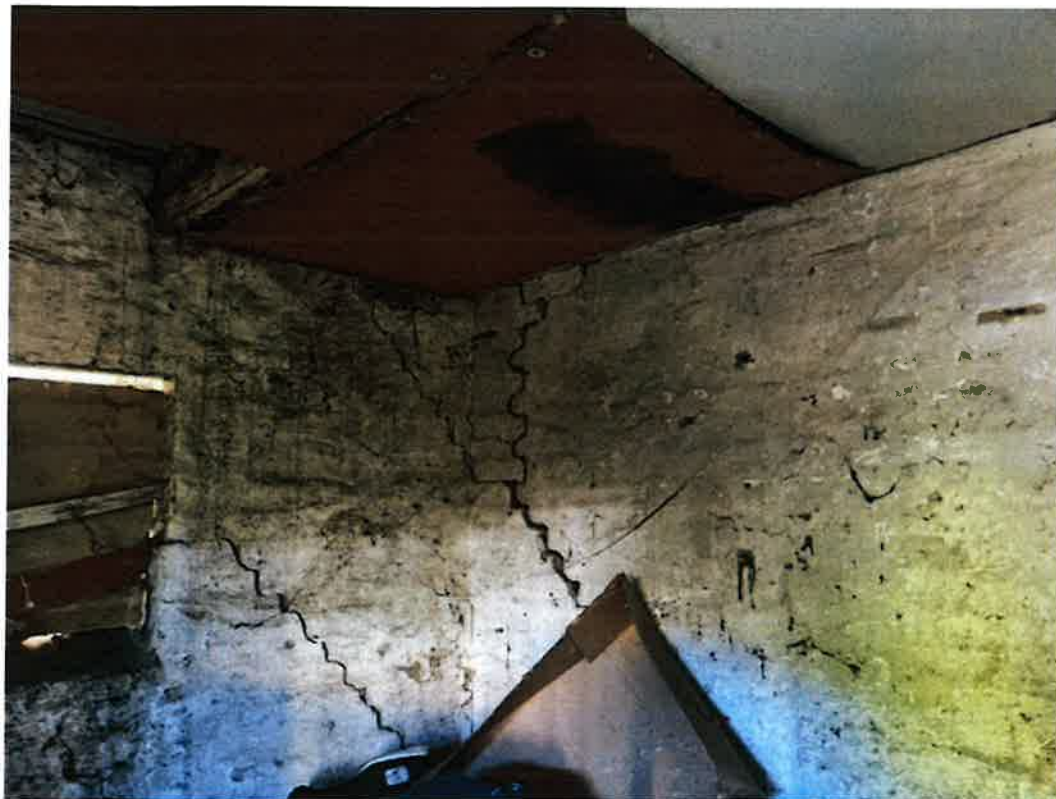
9.8 Spękania ścian murowanych na parterze.
