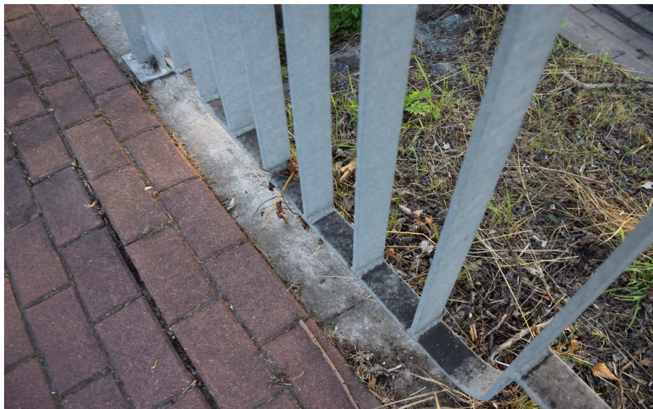
Fot. 7. Zanieczyszczenia balustrady.
