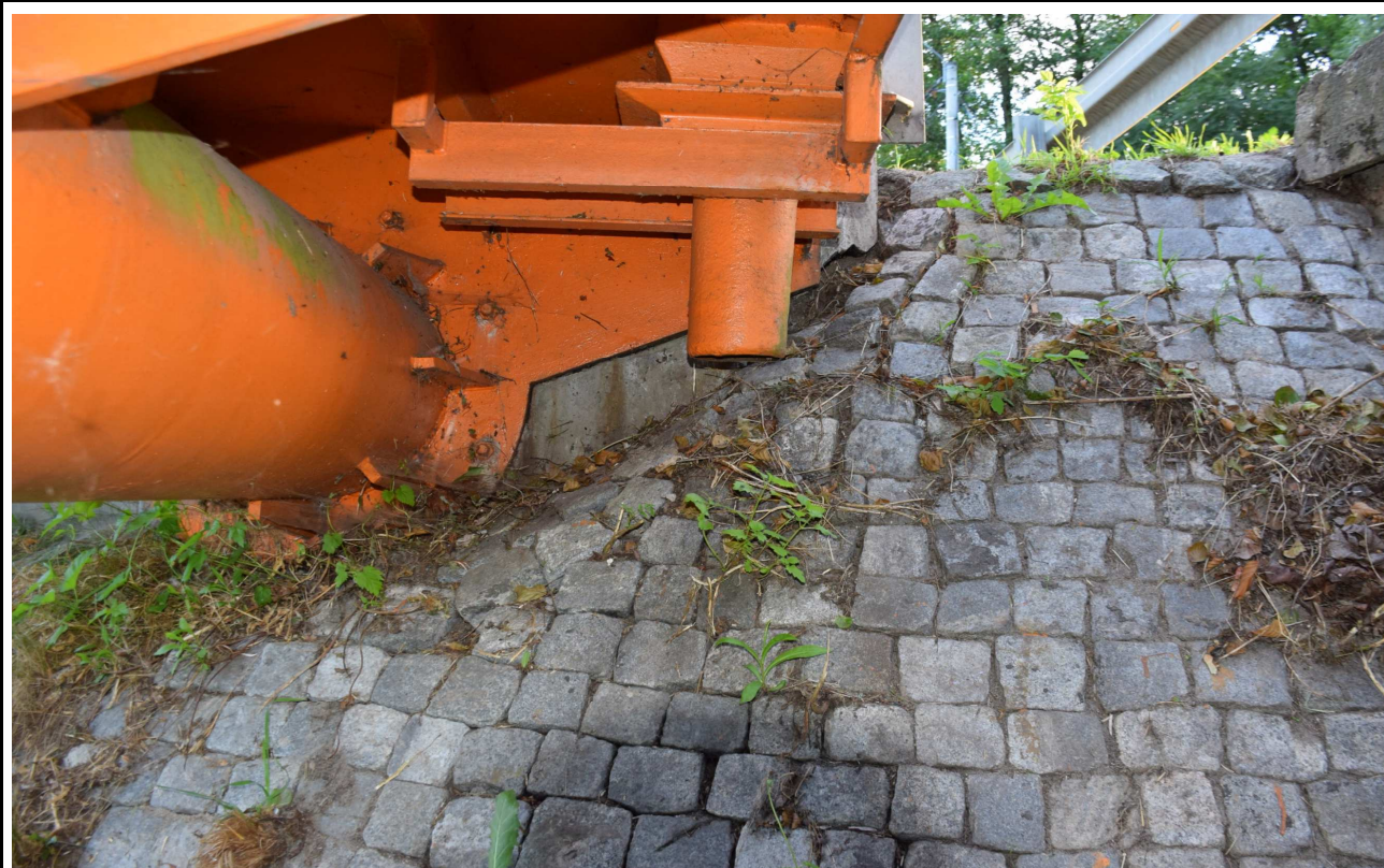
Fot. 10. Ubytki spoin kamiennego umocnienia skarpy.
