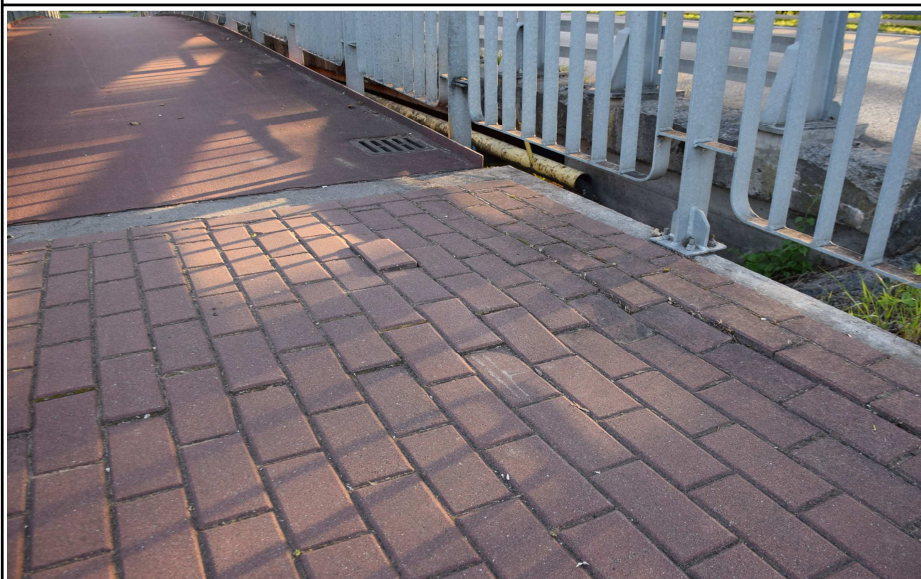
Fot. 6. Przemieszczenia kostki betonowej na dojściu do obiektu.
