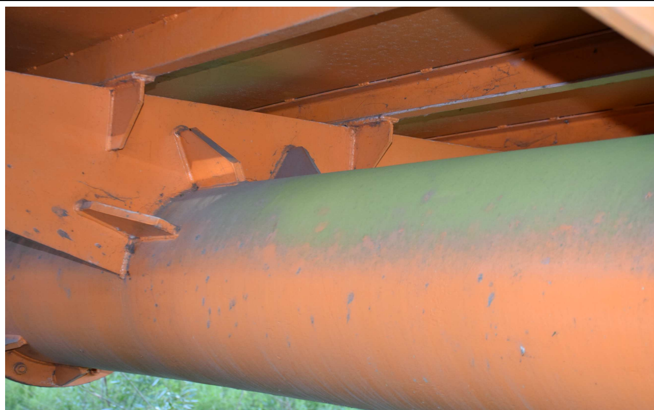
Fot. 8. Zanieczyszczenia dźwigara.
