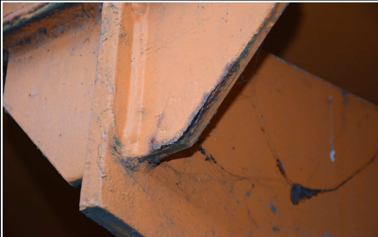
Fot. 9. Korozja dźwigara stalowego.
