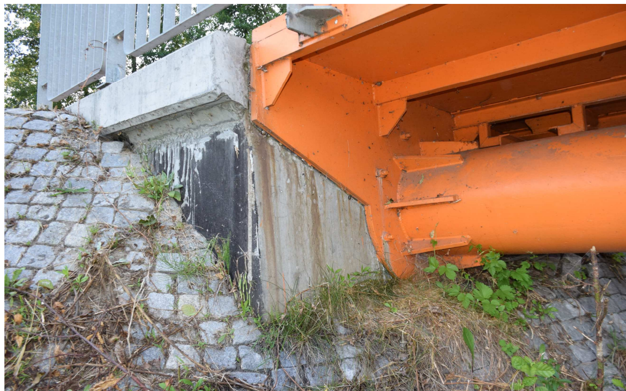
Fot. 11. Zanieczyszczenia betonu przyczółka.
