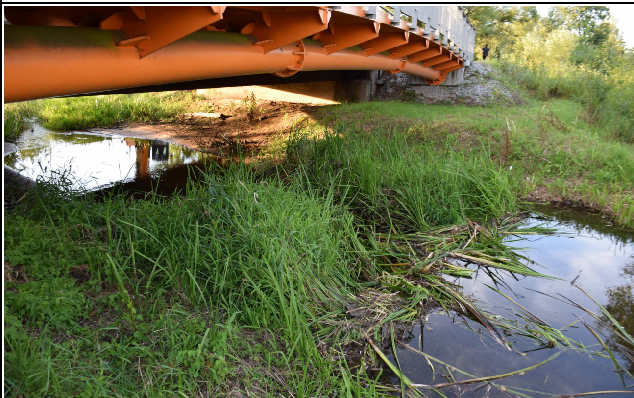
Fot. 12. Wegetacja roślinności w przestrzeni pod obiektem.
