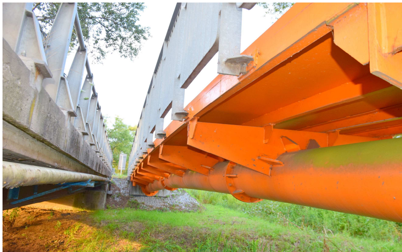
Fot. 3. Widok z boku od strony zachodniej.
