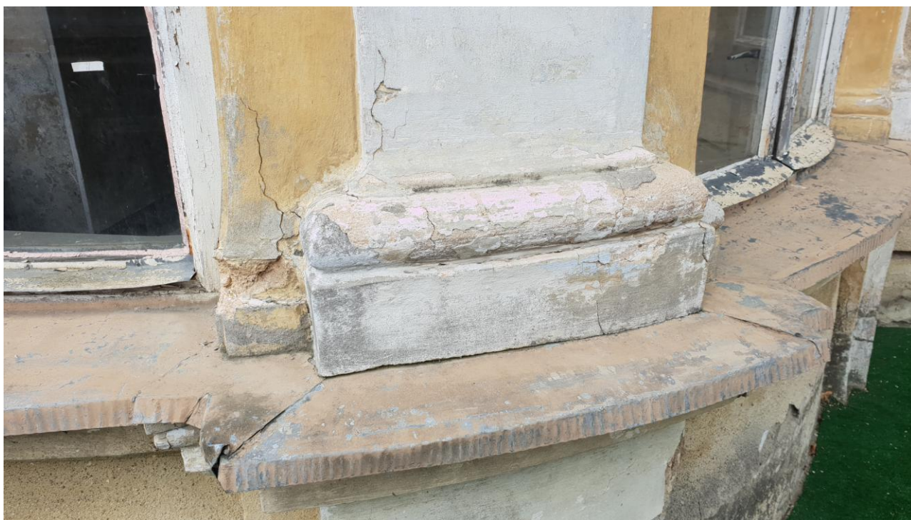
Fot.8. Łazienki borowinowe .Stan zachowania elewacji - czerwiec 2021.
