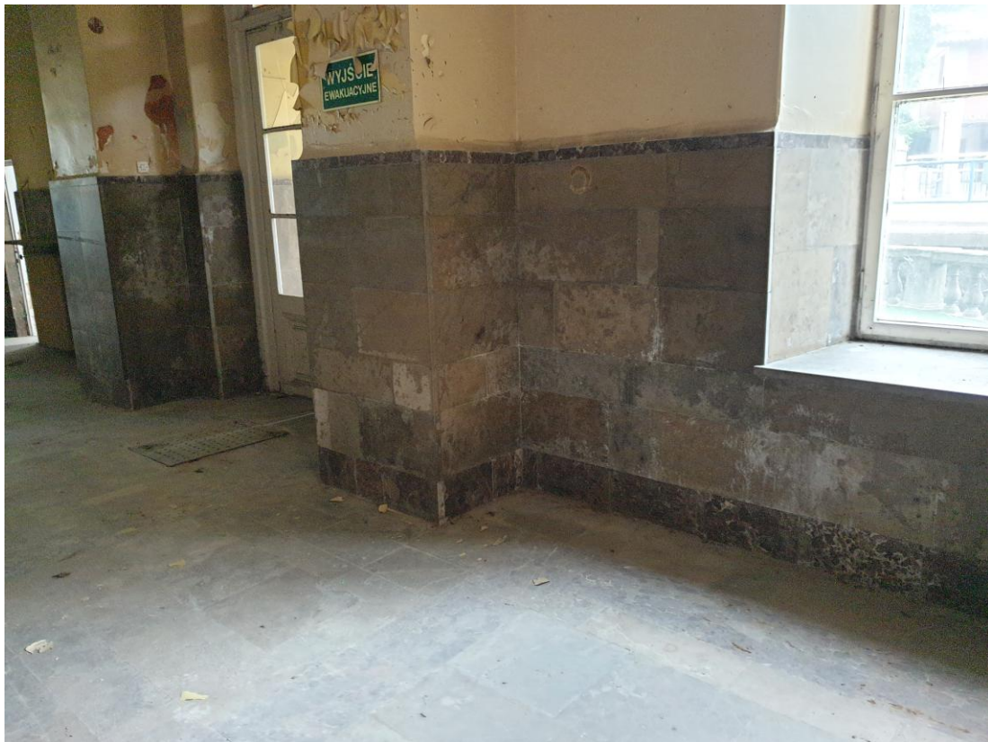
Fot.26,27.Łazienki borowinowe .Stan zachowania okładziny na korytarzach - czerwiec 2021
