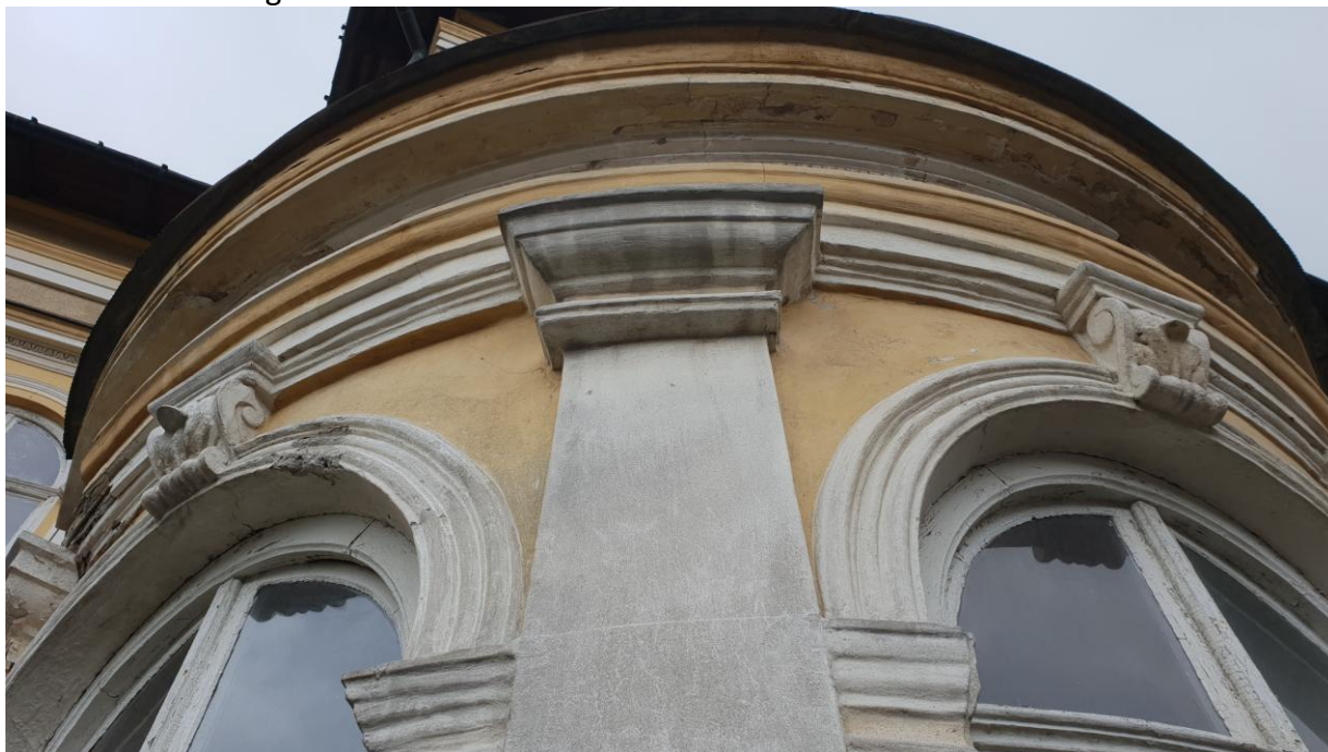
Fot.13. Łazienki borowinowe .Stan zachowania elewacji - czerwiec 2021.
