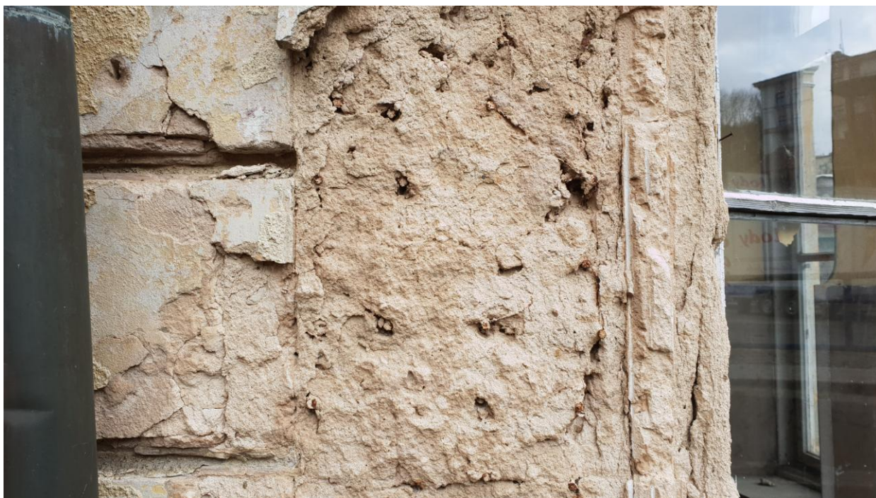
Fot.6. Łazienki borowinowe .Stan zachowania elewacji - czerwiec 2021.
