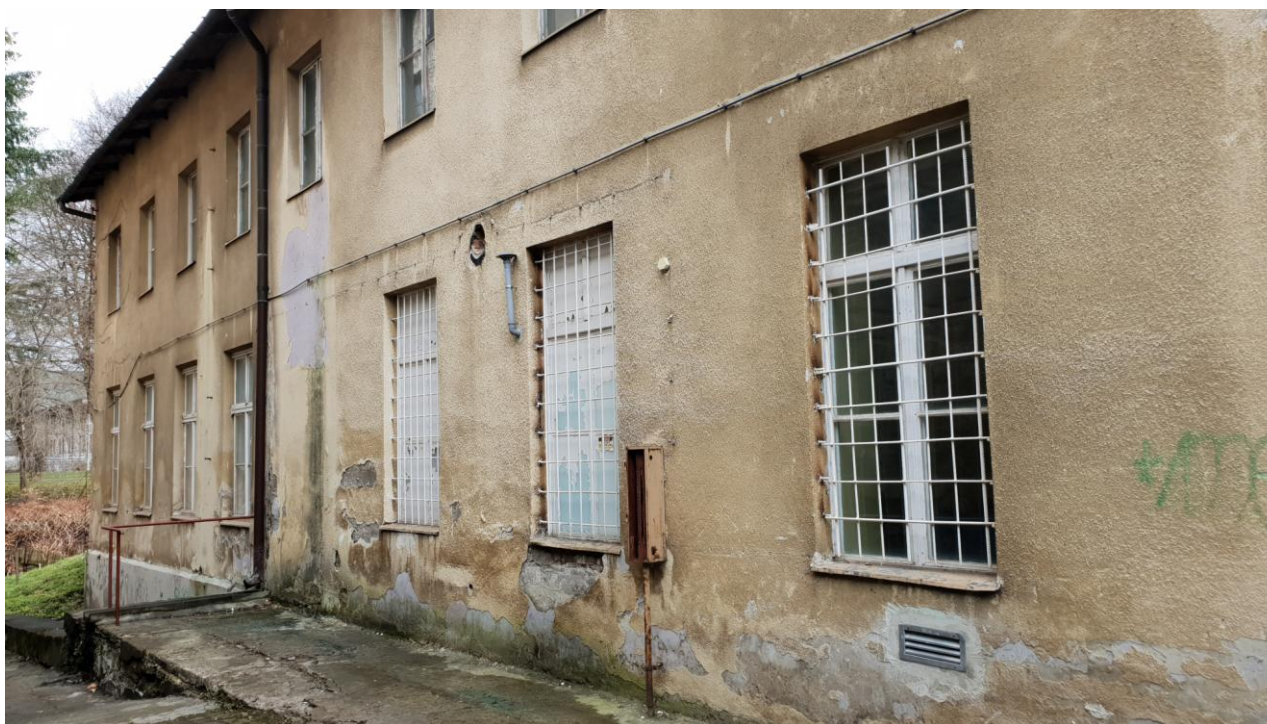
Fot.10. Łazienki borowinowe .Stan zachowania elewacji - czerwiec 2021.
