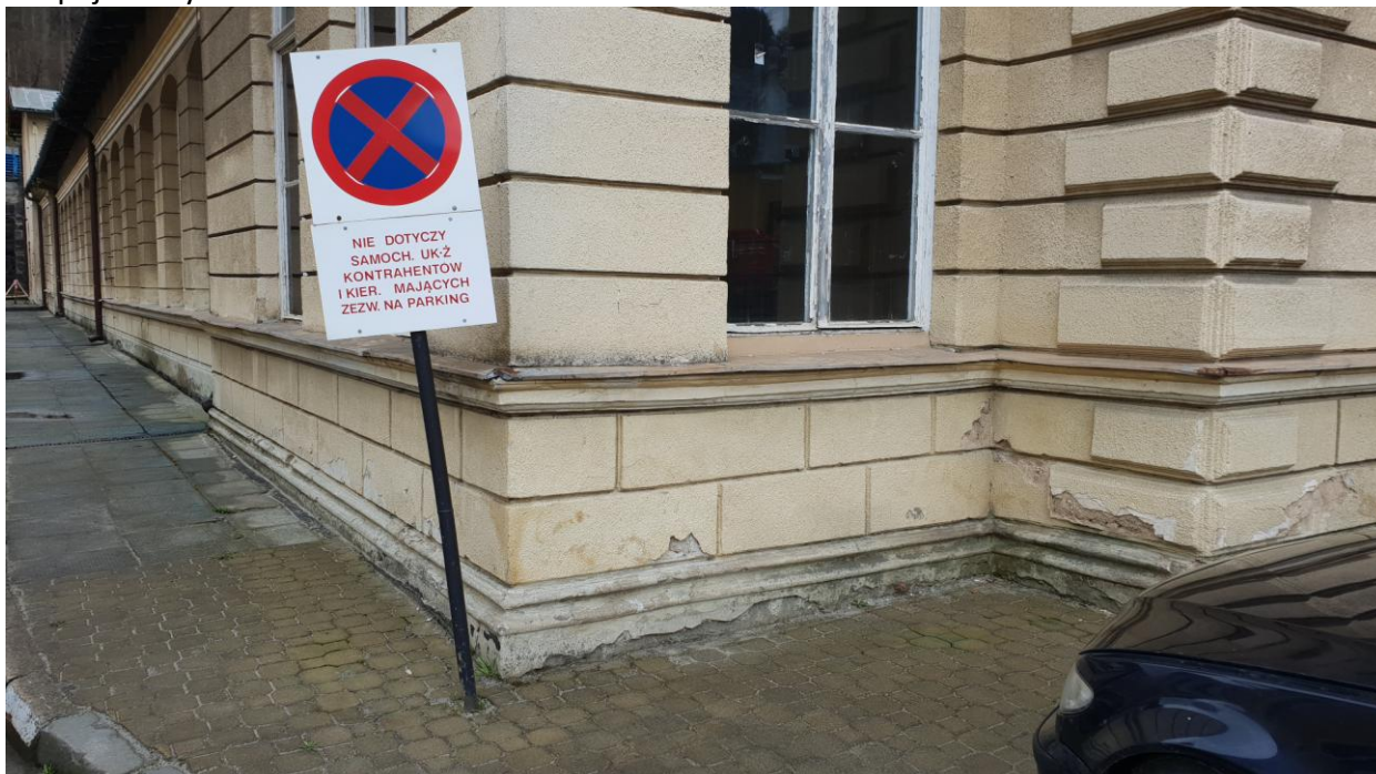
Fot.3. Łazienki borowinowe .Stan zachowania elewacji - czerwiec 2021.
