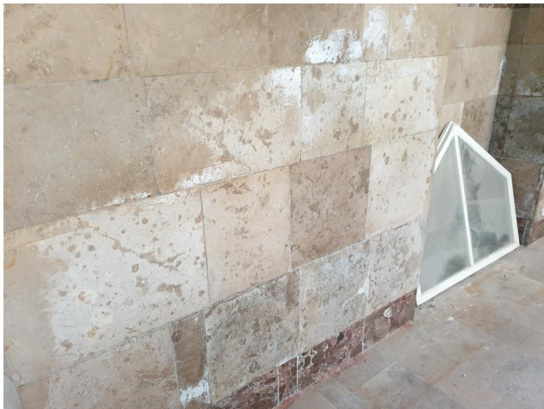
Fot.23,24.Łazienki borowinowe .Stan zachowania okładziny na korytarzach - czerwiec 2021
