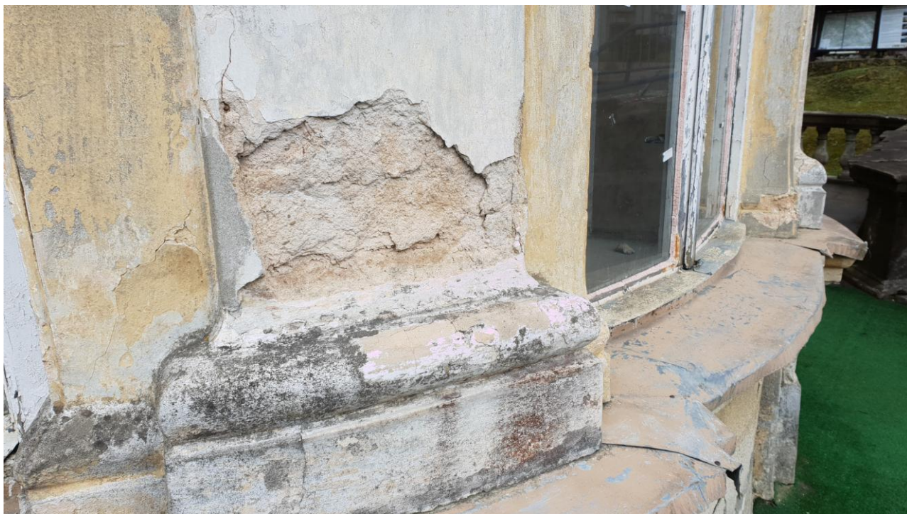
Fot.7. Łazienki borowinowe .Stan zachowania elewacji - czerwiec 2021.
