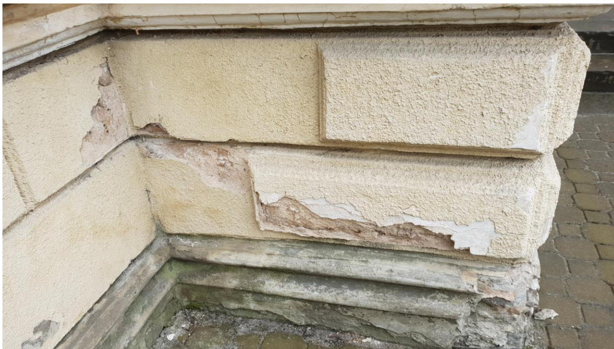
Fot.4. Łazienki borowinowe .Stan zachowania elewacji - czerwiec 2021.
