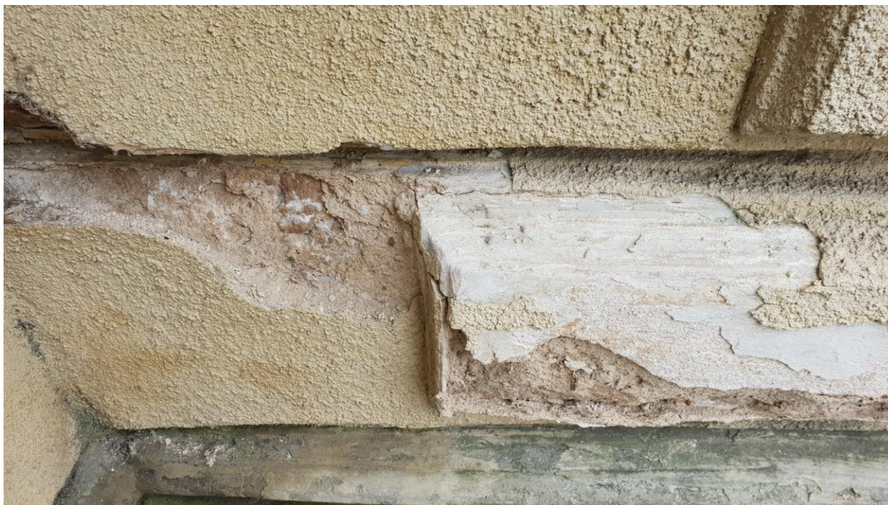
Fot.5. Łazienki borowinowe .Stan zachowania elewacji - czerwiec 2021.
