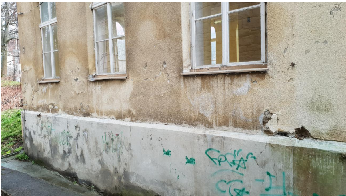
Fot.15 łazienki borowinowe .Stan zachowania elewacji - czerwiec 2021.
