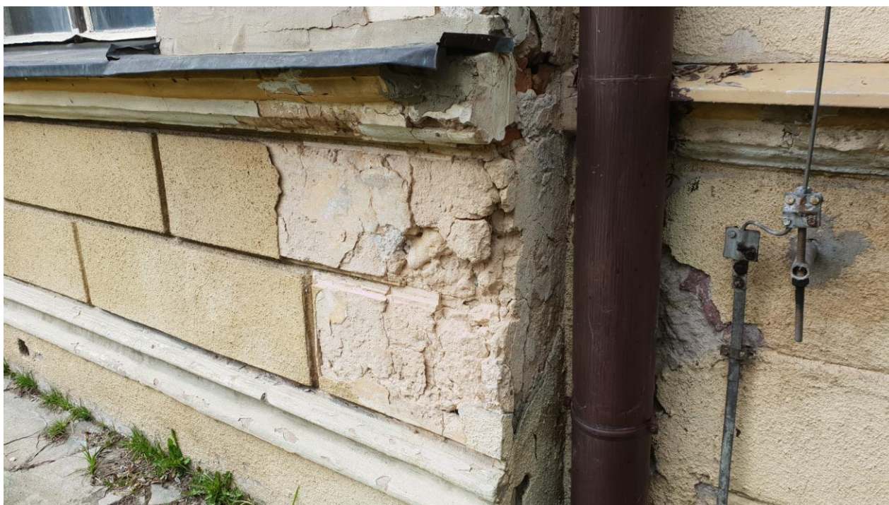
Fot.11. Łazienki borowinowe .Stan zachowania elewacji - czerwiec 2021.
