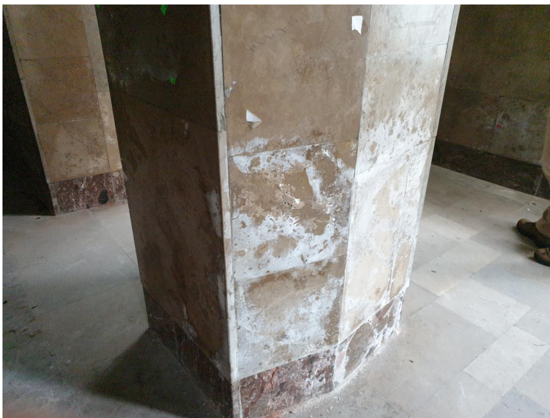
Fot.28,29.Łazienki borowinowe .Stan zachowania okładziny na korytarzach - czerwiec 2021
