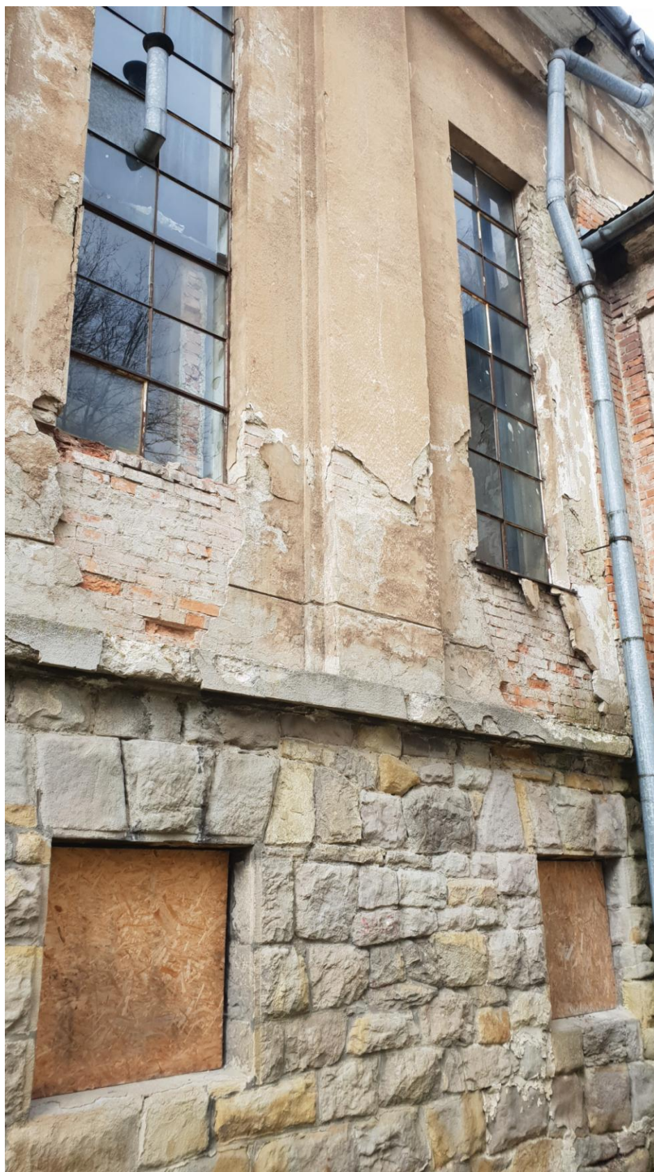
Fot.19 Łazienki borowinowe .Stan zachowania elewacji - czerwiec 2021
