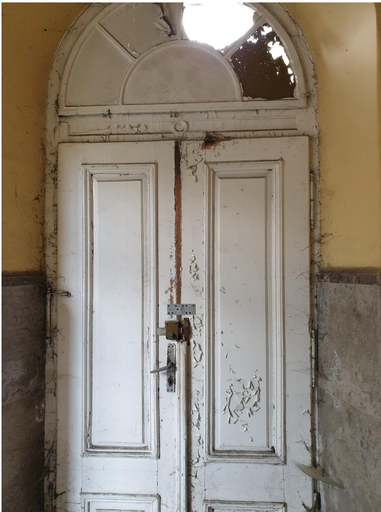
Fot.30.Łazienki borowinowe .Stan zachowania historycznej stolarki drzwiowej - czerwiec 2021
