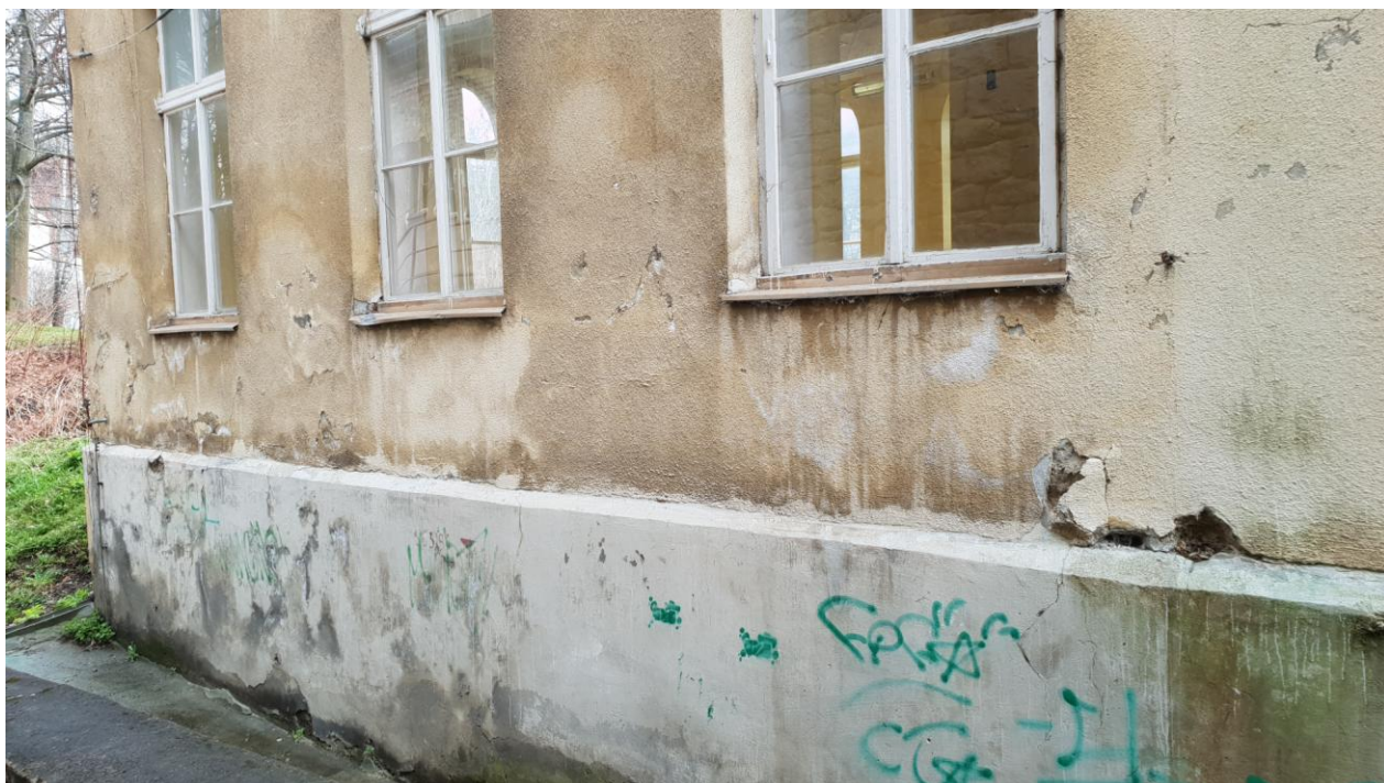
Fot.12. Łazienki borowinowe .Stan zachowania elewacji - czerwiec 2021.
