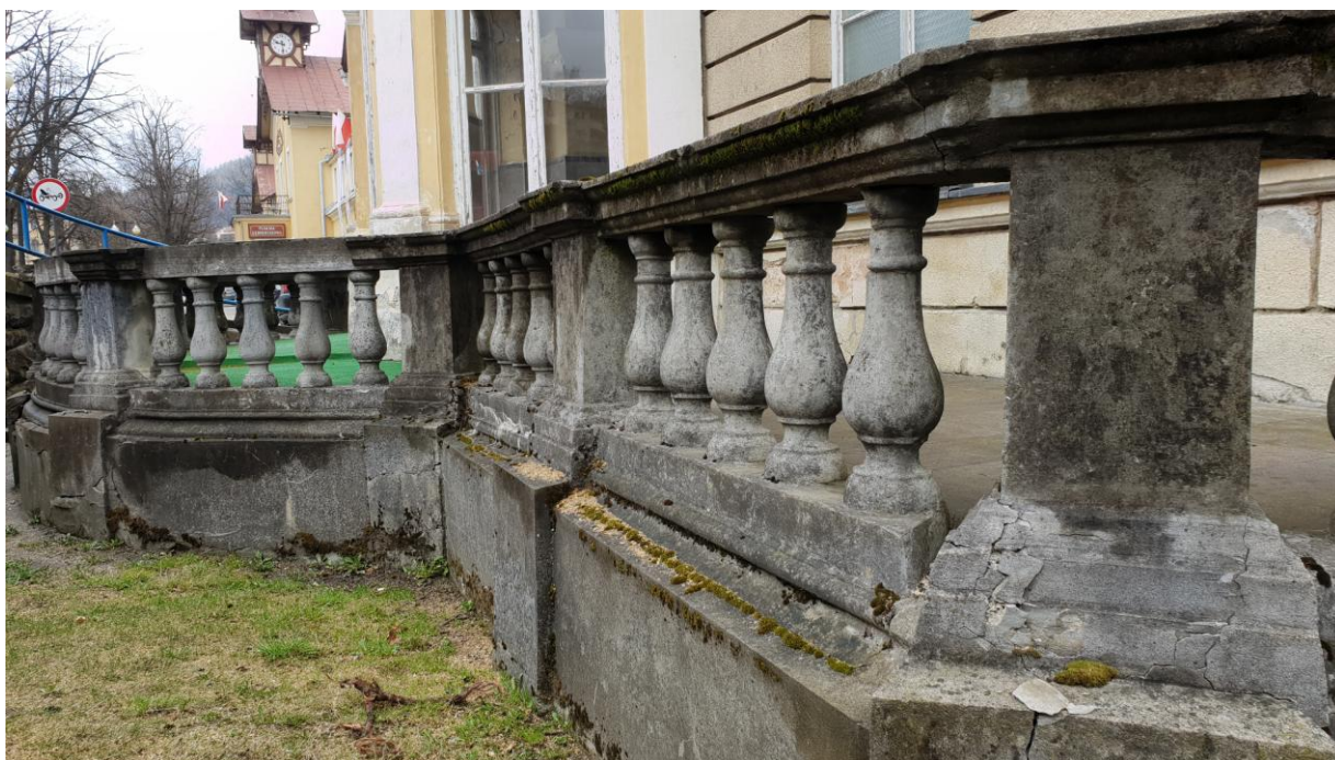
Fot.14 łazienki borowinowe .Stan zachowania elewacji - czerwiec 2021.
