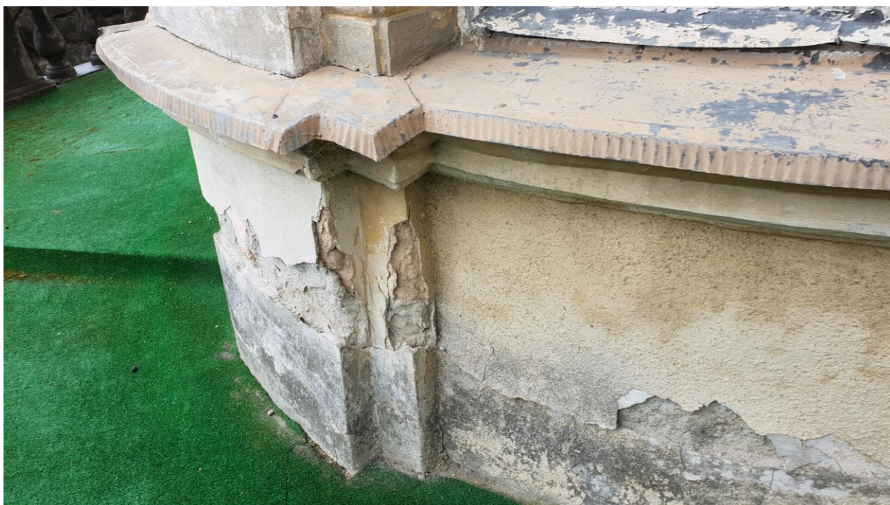
Fot.9. Łazienki borowinowe .Stan zachowania elewacji - czerwiec 2021.
