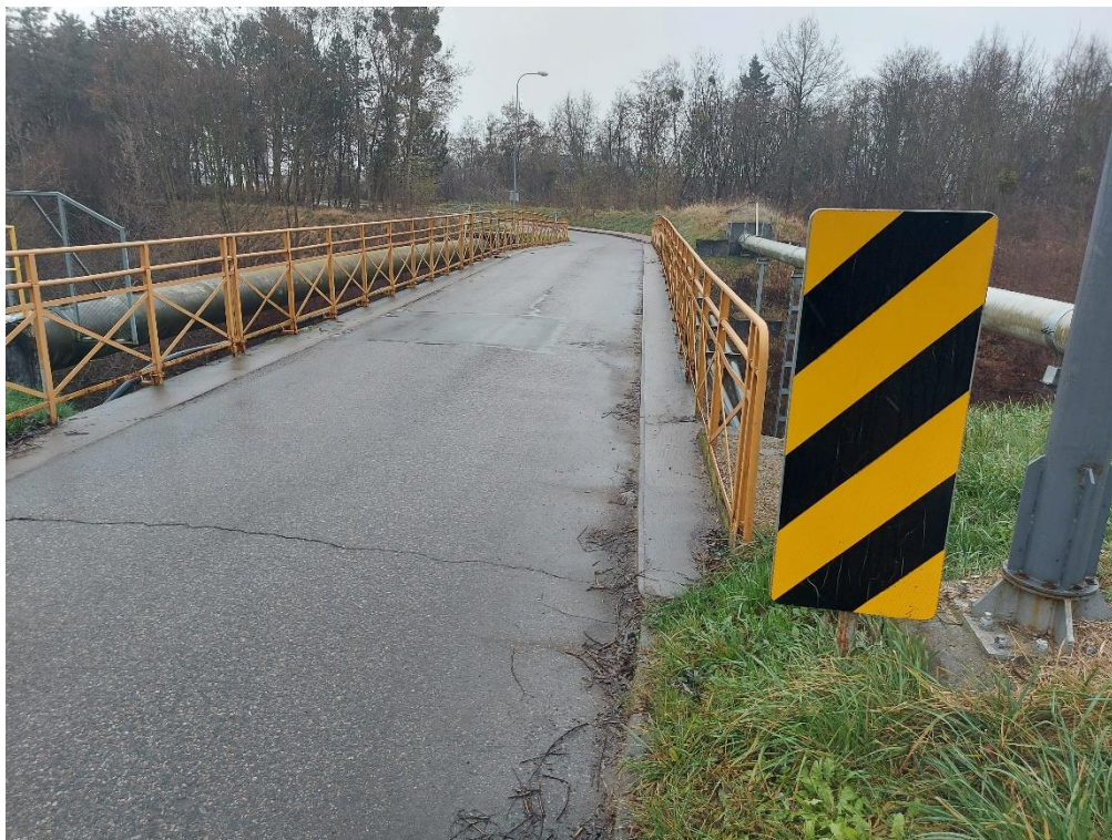
Fot. 9. Nawierzchnia na obiekcie, szczelina dylatacyjna od strony południowej.
