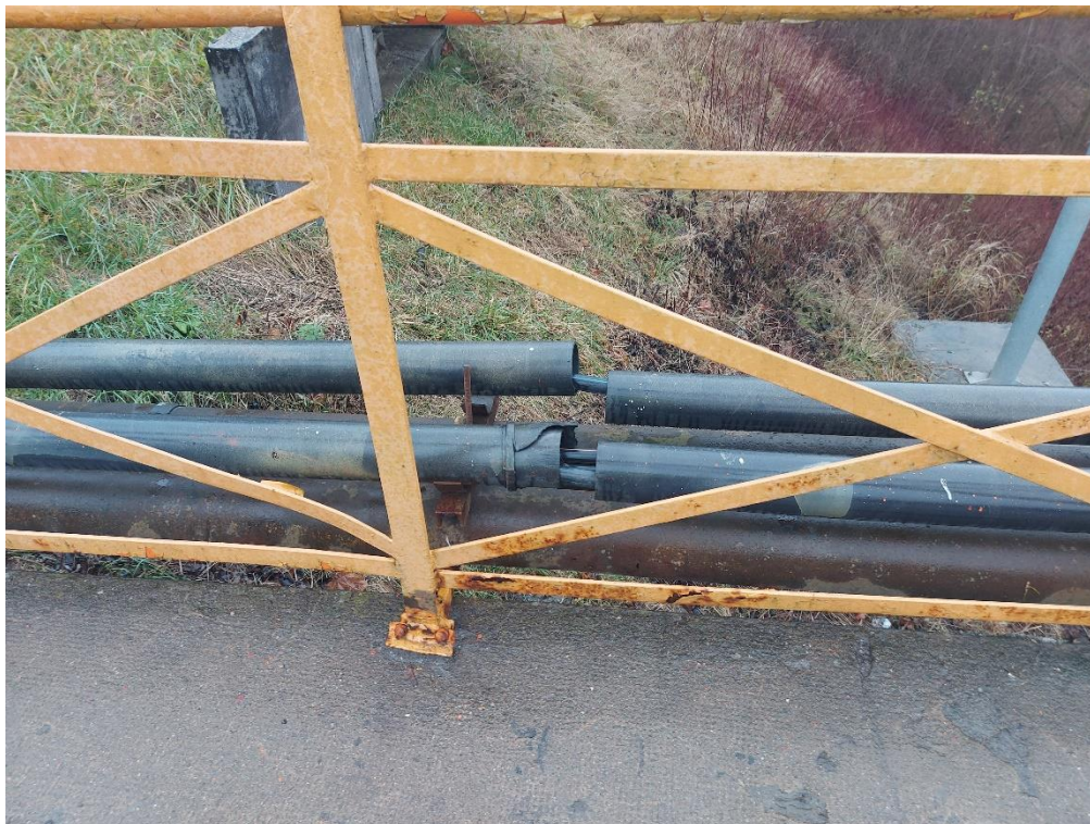
Fot. 32. Urządzenia obce, balustrada stalowa.
