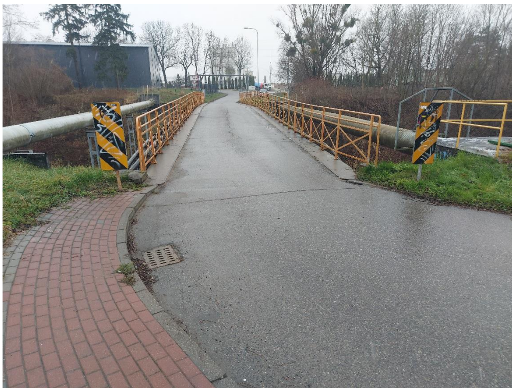
Fot. 10. Nawierzchnia na obiekcie, szczelina dylatacyjna od strony północnej.
