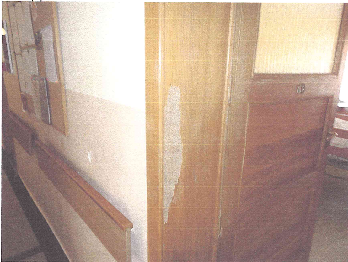
Nr 7 – Uszkodzona ościeżnica drzwi – remont wszystkich drzwi do pomieszczeń w obrębie korytarza na II i III piętrze
