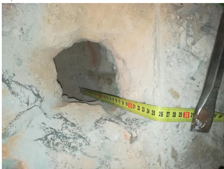
Nr6. Odkrywka warstw stropowych stropu nad piwnicą- ODKRYWKA NR1- odwiercono łączną grubość warstw nad płytą ceramiczną stropu Kleina -25cm.
