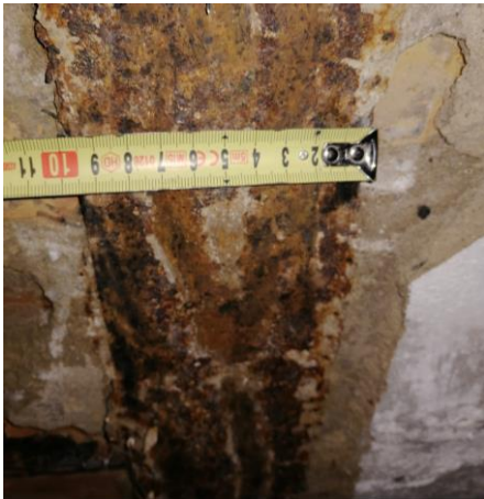
Nr15. Widok stalowych belek stropu Kleina osłoniętych od spodu tynkiem cementowym na siatce stalowej Rabitza- nalot korozji powierzchniowy.
