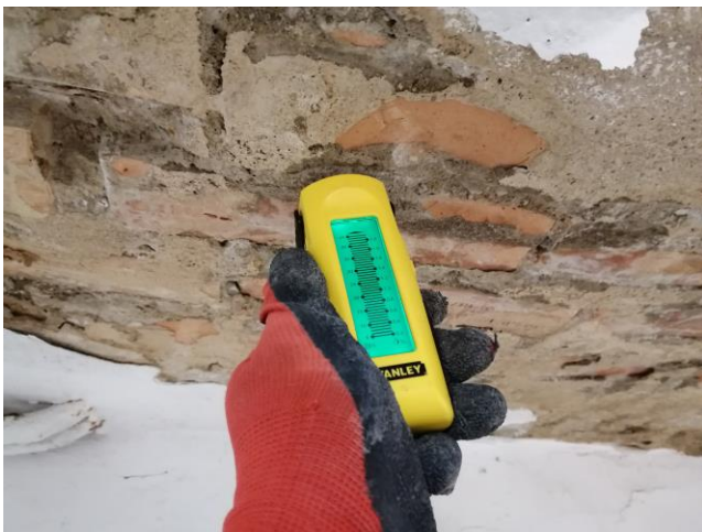
Nr12. Pomiar zawilgocenia przegrody stropowej w warstwie płyty ceramicznej od spodu stropu - warstwa mokra. Widoczne gołym okiem zawilgocenie tynku cementowego oraz spoin cementowych płyty ceramicznej.
