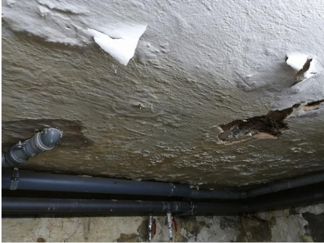
Nr10. Widok stropów od spodu- silne zawilgocenia w miejscach przebić instalacyjnych, łuszczenie się warstw malarskich, odparzenia i spękania tynków.
