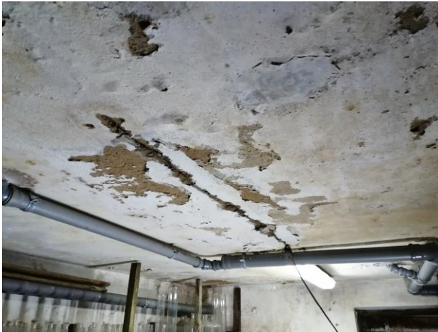
Nr11. Widok stropów od spodu- silne zawilgocenia w miejscach przebić instalacyjnych, łuszczenie się warstw malarskich, odparzenia i spękania tynków.
