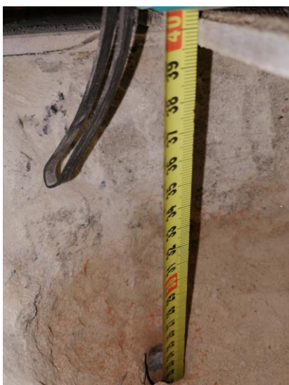
Nr8. Odkrywka warstw stropowych stropu nad piwnica- ODKRYWKA NR3- odwiercono łączną grubość warstw posadzkowych wraz z płytą ceramiczną stropu Kleina – 41cm.
