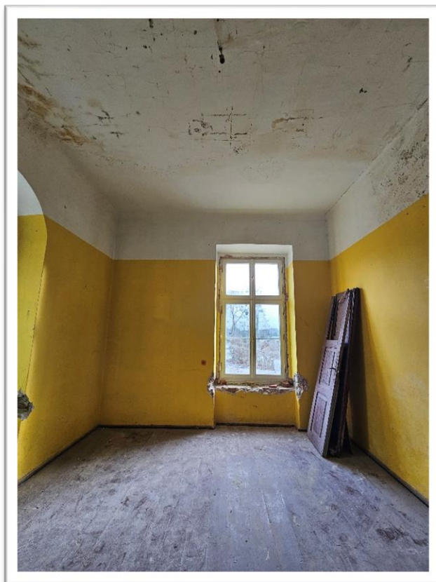
Fotografia 15 Stan istniejący (inventaryzacja pom. 13 parter) – Sala życzeń (proj. pom. 1.13) – widok stanu po adaptacji pomieszczeń na mieszkanie (pokój).
