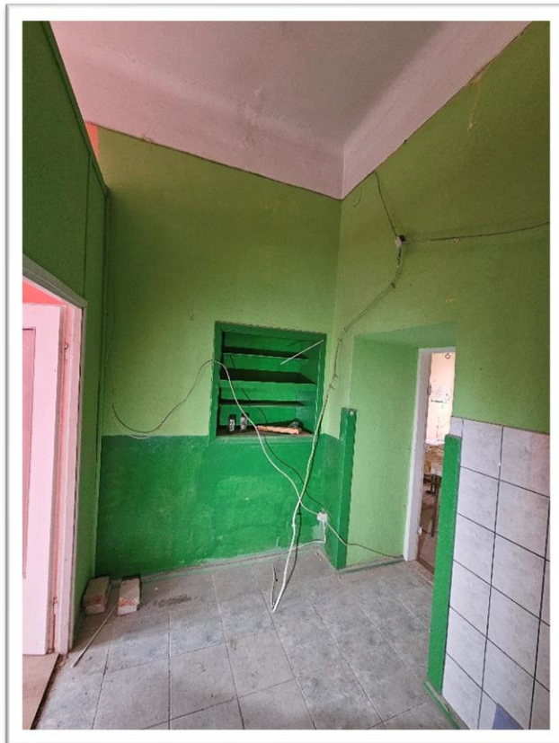
Fotografia 7 Stan istniejący (inwentaryzacja pom. 17 parter) – Szatnia (proj. pom. 1.11) – widok stanu po adaptacji pomieszczeń na mieszkanie (kuchnia)
