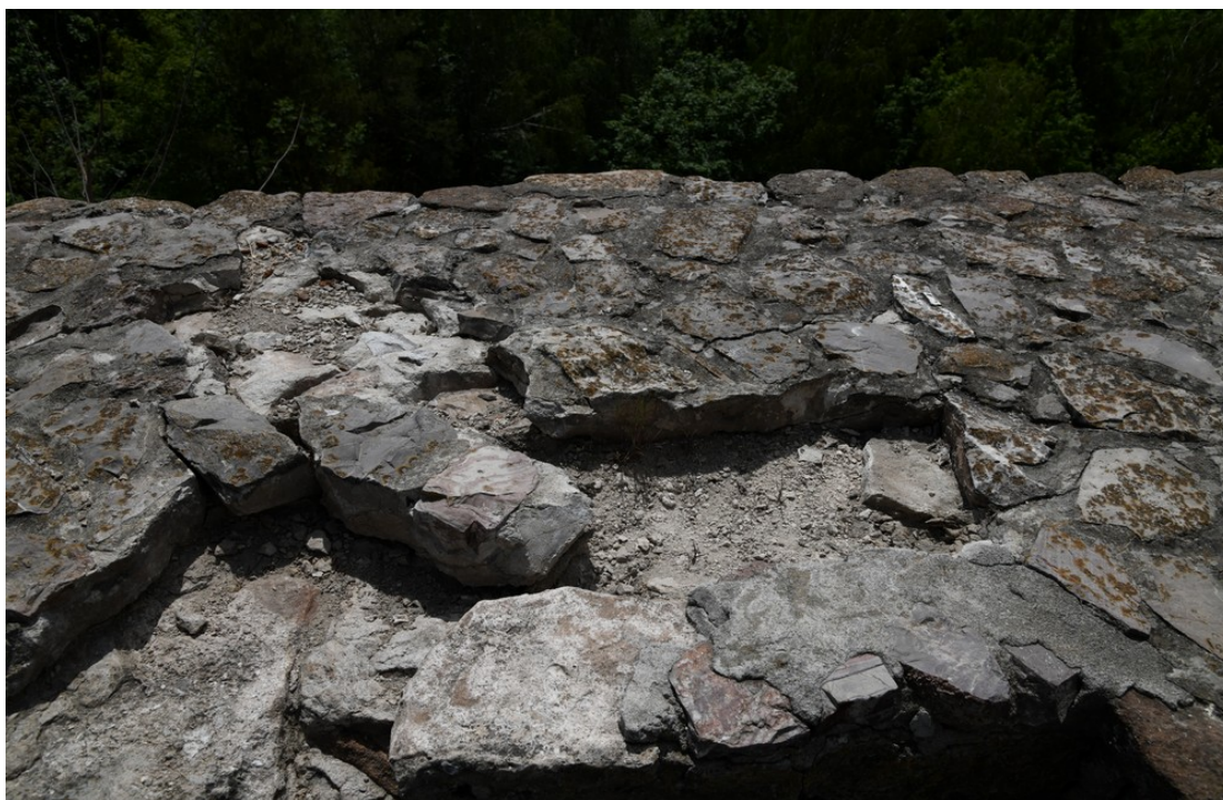
Fot. 28 Chęciny – Zamek Królewski Mur obwodowy południowy, wewnętrzny, korona Stan przed konserwacją Fot. Marek Mazurek 2024
