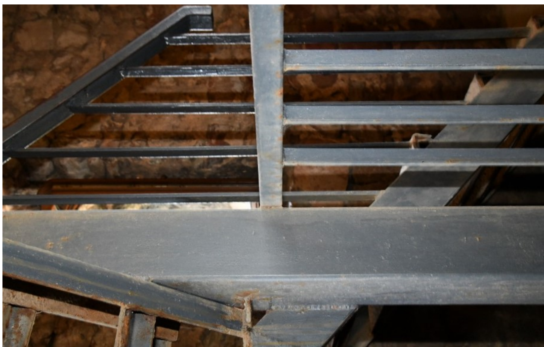
Fot. 130 Chęciny – Zamek Królewski Wieża zachodnia, stalowe schody Stan przed konserwacją Fot. Marek Mazurek 2024
