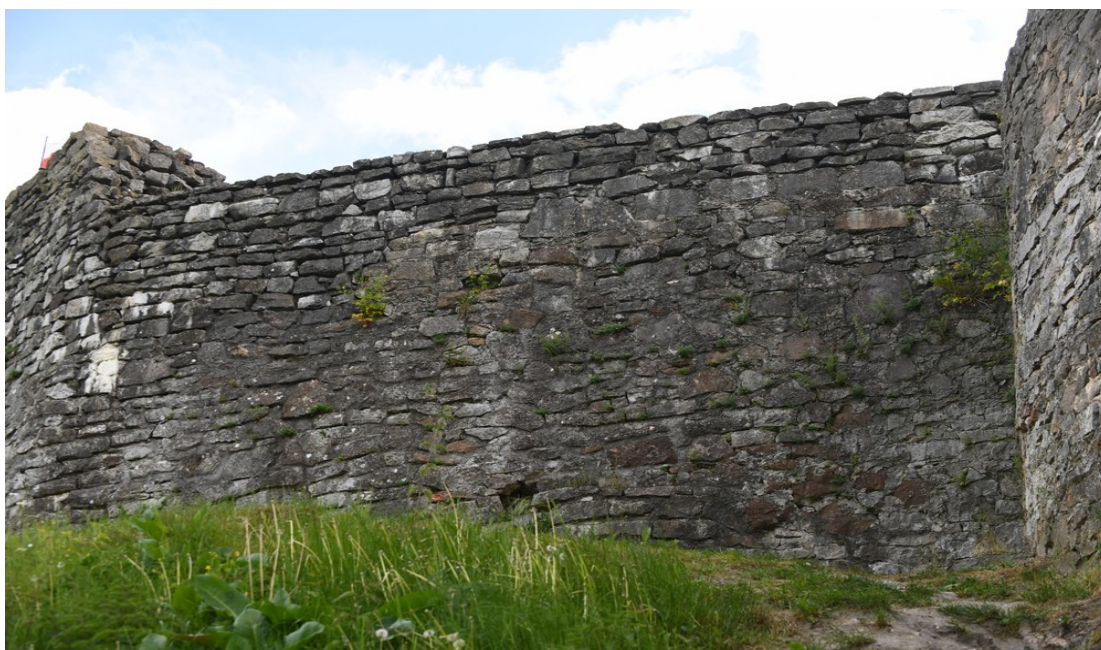
Fot. 45 Chęciny – Zamek Królewski Mur obwodowy północny, zewnętrzny Stan przed konserwacją Fot. Marek Mazurek 2024
