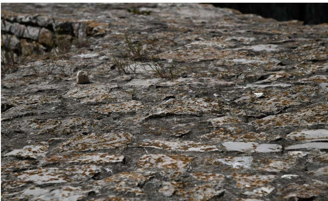
Fot. 26 Chęciny – Zamek Królewski Mur obwodowy południowy, wewnętrzny, korona Stan przed konserwacją Fot. Marek Mazurek 2024
