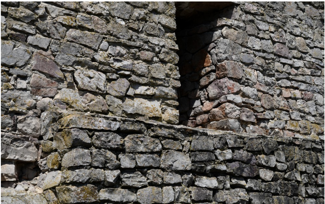
Fot. 42 Chęciny – Zamek Królewski Przedbramie wschodnie Stan przed konserwacją Fot. Marek Mazurek 2024
