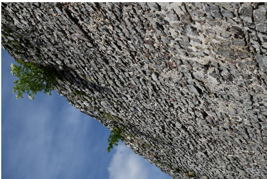
Fot. 18 Chęciny – Zamek Królewski Mur obwodowy południowy, zewnętrzny Stan przed konserwacją Fot. Marek Mazurek 2024
