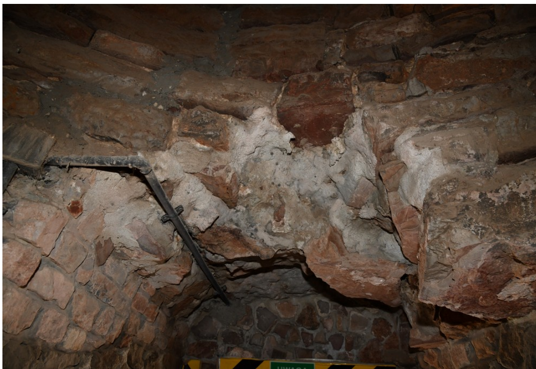
Fot. 154 Chęciny – Zamek Królewski Wieża wschodnia, mury wewnętrzne Stan przed konserwacją Fot. Marek Mazurek 2024
