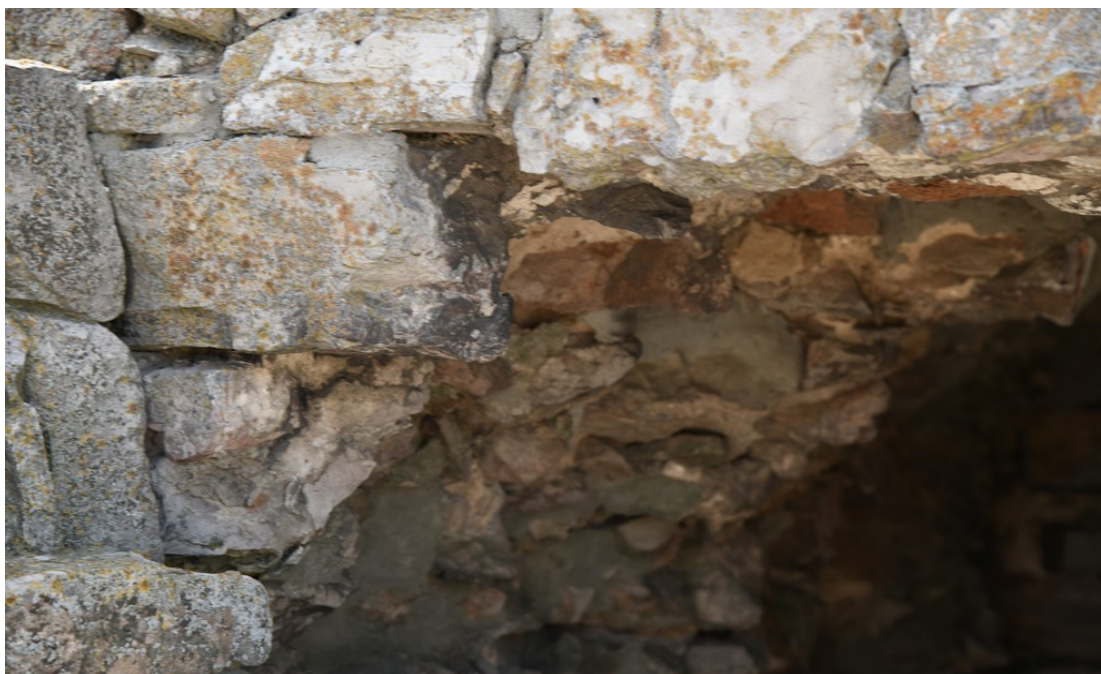
Fot. 143 Chęciny – Zamek Królewski Wieża środkowa, mury zewnętrzne Stan przed konserwacją Fot. Marek Mazurek 2024
