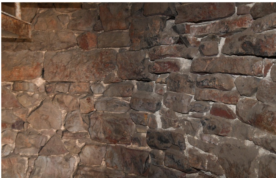
Fot. 153 Chęciny – Zamek Królewski Wieża wschodnia, mury wewnętrzne Stan przed konserwacją Fot. Marek Mazurek 2024
