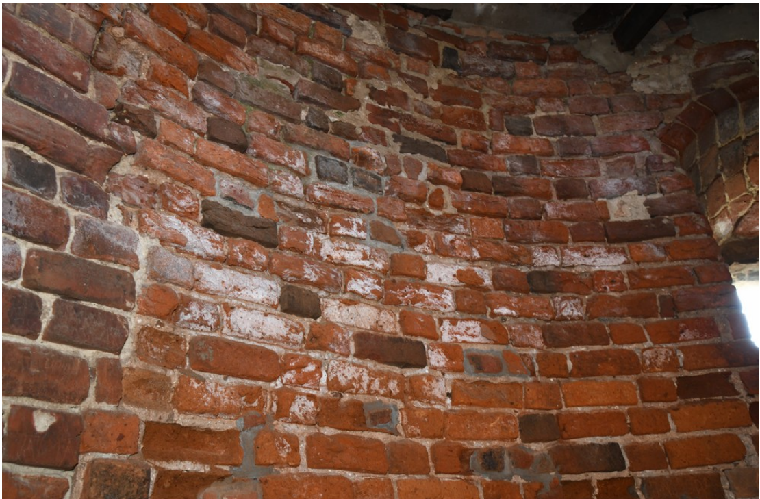
Fot. 156 Chęciny – Zamek Królewski Wieża wschodnia, mury zewnętrzne Stan przed konserwacją Fot. Marek Mazurek 2024
