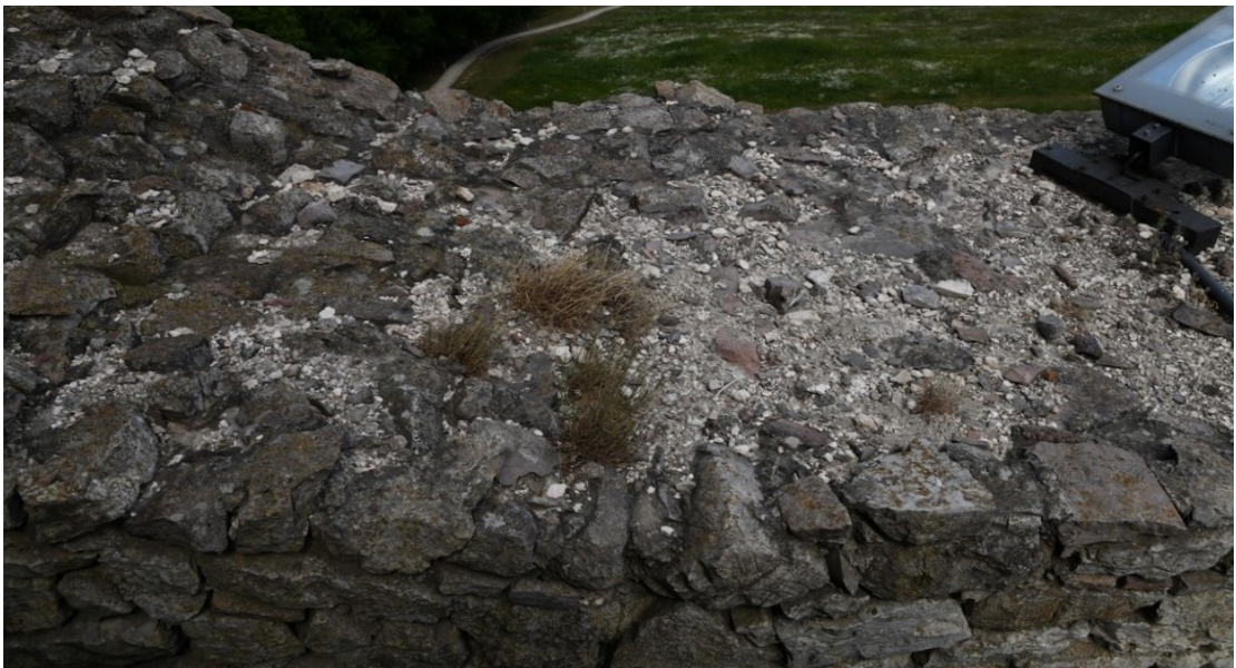
Fot. 58 Chęciny – Zamek Królewski Mur obwodowy północny, wewnętrzny, korona Stan przed konserwacją Fot. Marek Mazurek 2024
