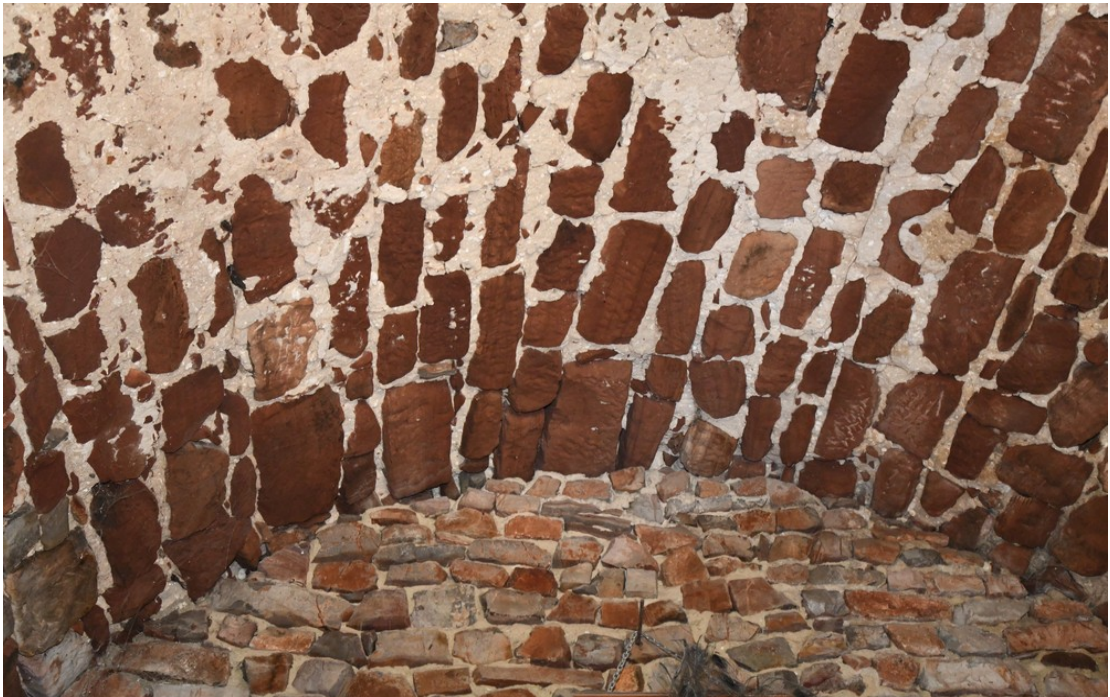
Fot. 105 Chęciny – Zamek Królewski Skarbiec, wnętrze Stan przed konserwacją Fot. Marek Mazurek 2024
