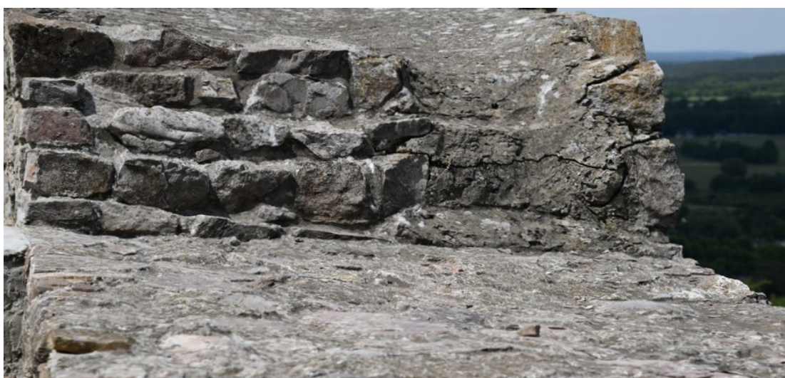
Fot. 62 Chęciny – Zamek Królewski Mur obwodowy północny, wewnętrzny, korona Stan przed konserwacją Fot. Marek Mazurek 2024
