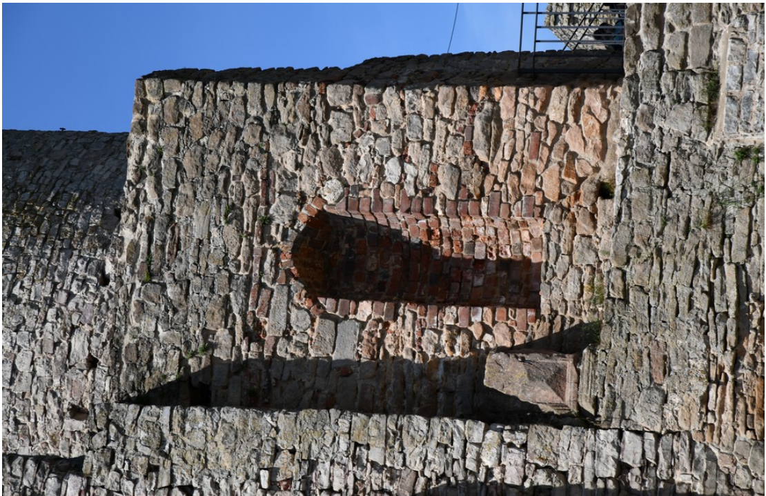
Fot. 38 Chęciny – Zamek Królewski Przedbramie wschodnie Stan przed konserwacją Fot. Marek Mazurek 2024
