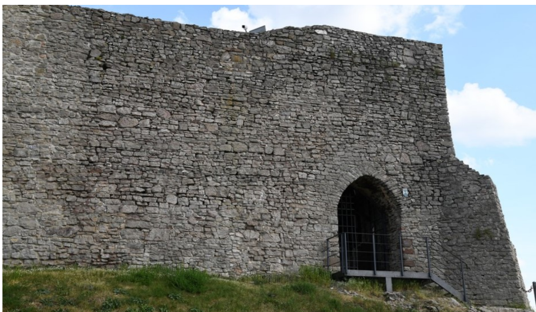
Fot. 71 Chęciny – Zamek Królewski Mur obwodowy zachodni, zewnętrzny Stan przed konserwacją Fot. Marek Mazurek 2024
