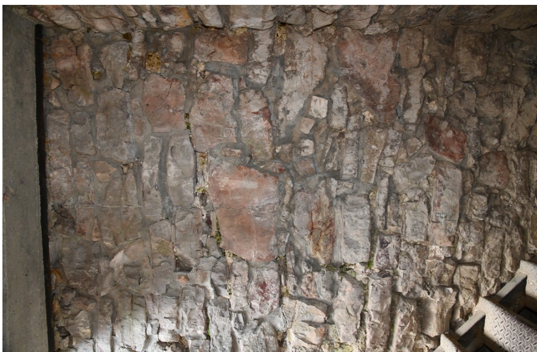
Fot. 122 Chęciny – Zamek Królewski Wieża zachodnia, mury wewnętrzne Stan przed konserwacją Fot. Marek Mazurek 2024
