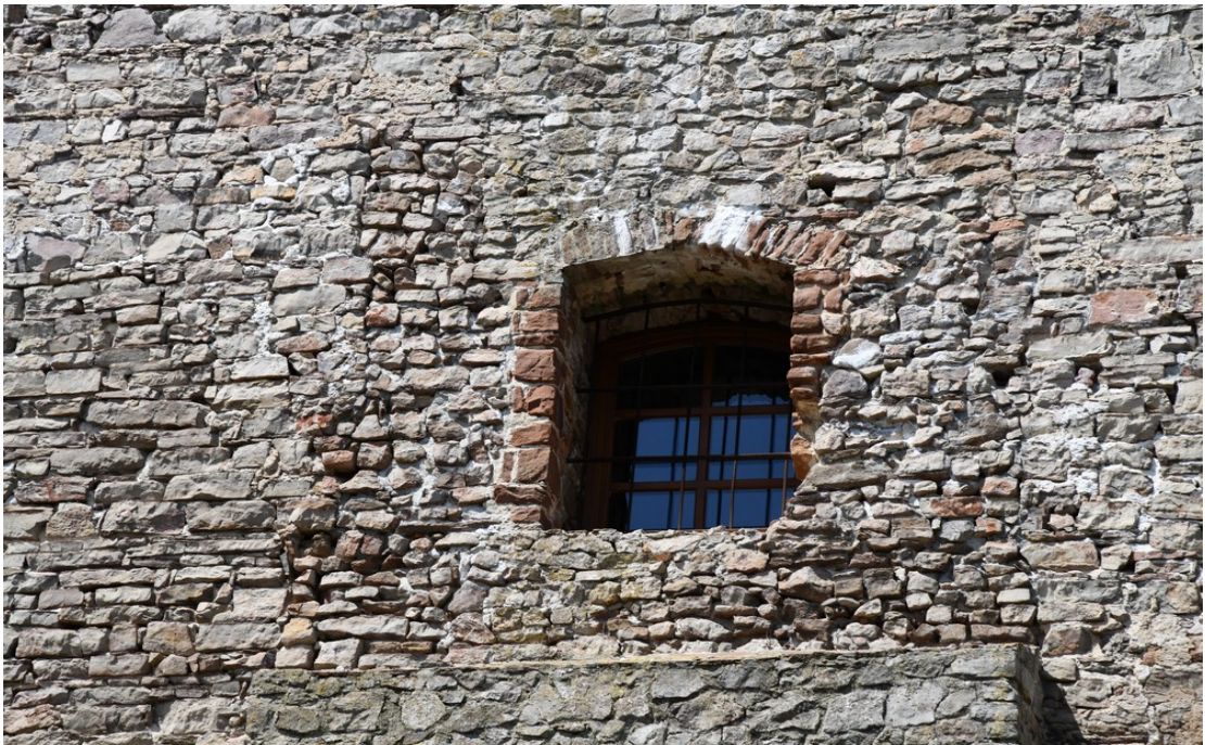
Fot. 41 Chęciny – Zamek Królewski Przedbramie wschodnie Stan przed konserwacją Fot. Marek Mazurek 2024
