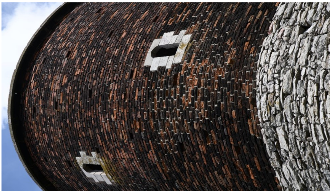
Fot. 136 Chęciny – Zamek Królewski Wieża środkowa, mury zewnętrzne Stan przed konserwacją Fot. Marek Mazurek 2024
