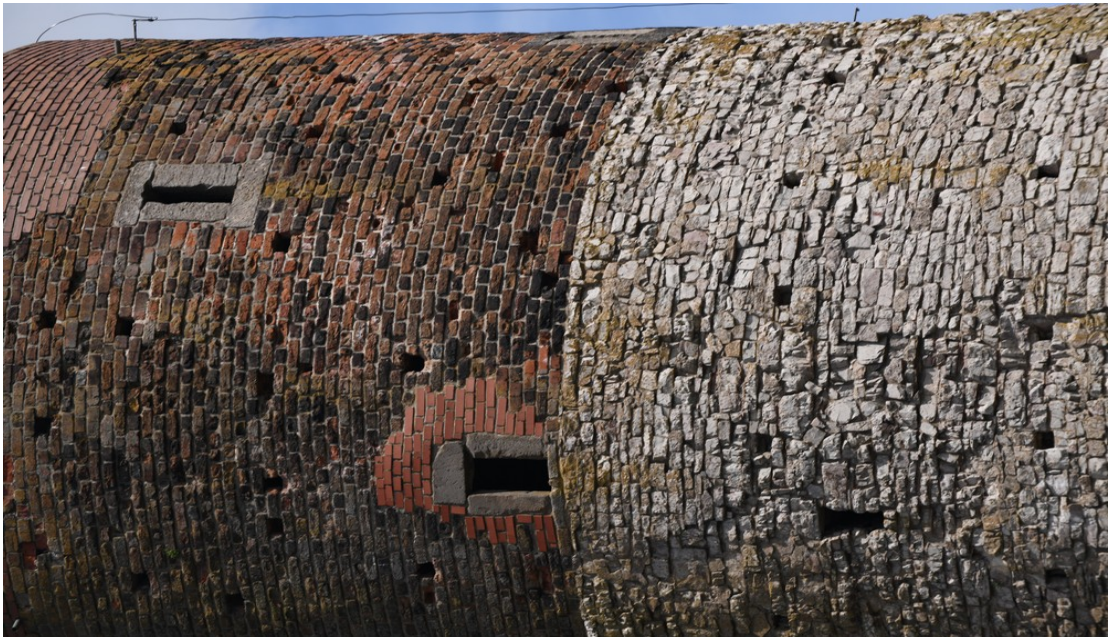
Fot. 149 Chęciny – Zamek Królewski Wieża wschodnia, mury zewnętrzne Stan przed konserwacją Fot. Marek Mazurek 2024
