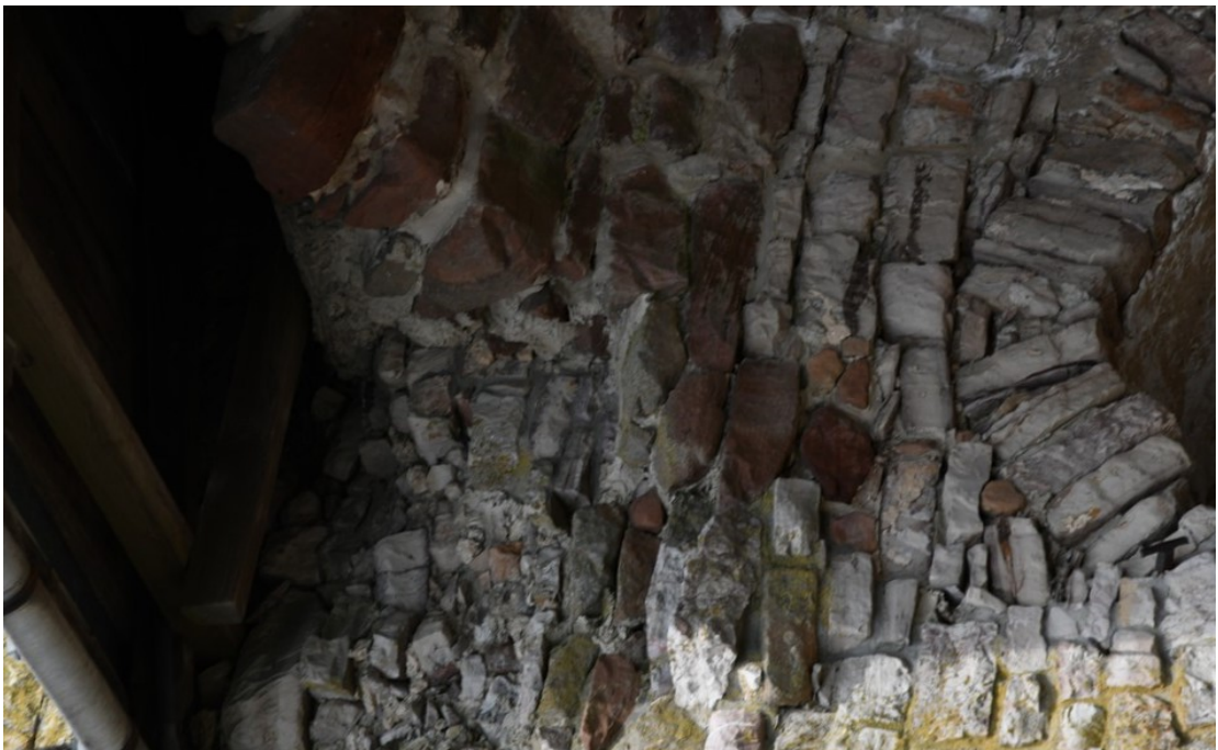
Fot. 102 Chęciny – Zamek Królewski Skarbiec, wejście Stan przed konserwacją Fot. Marek Mazurek 2024
