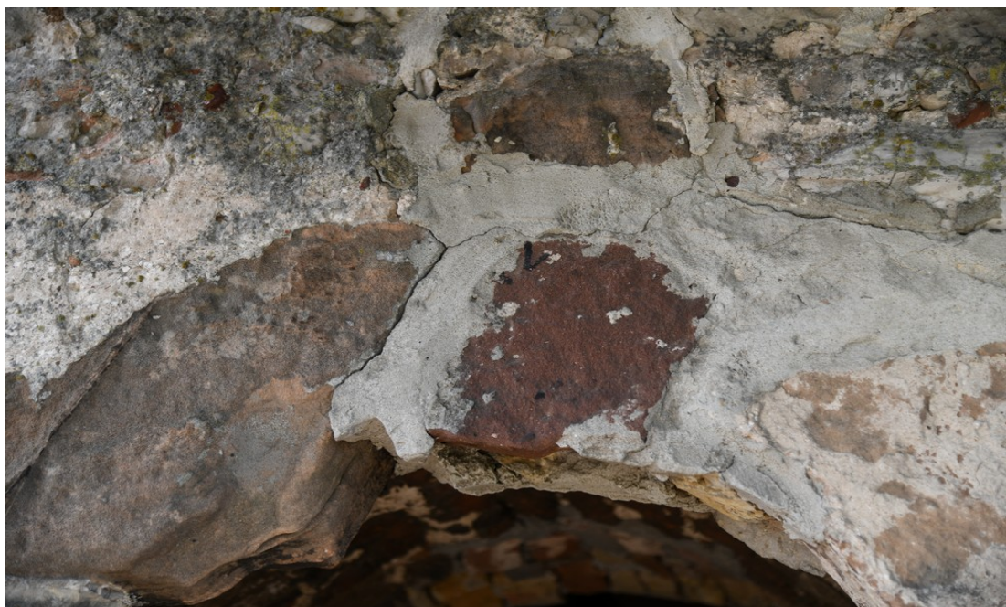
Fot. 115 Chęciny – Zamek Królewski Wieża zachodnia, mury zewnętrzne Stan przed konserwacją Fot. Marek Mazurek 2024
