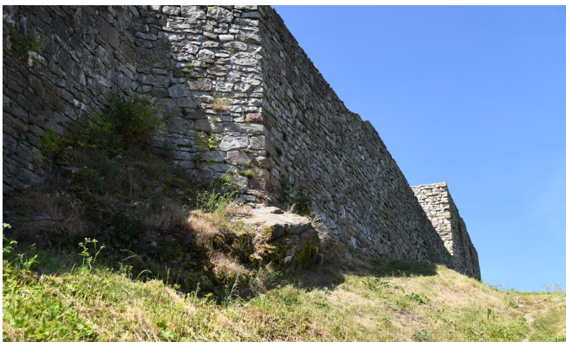
Fot. 47 Chęciny – Zamek Królewski Mur obwodowy północny, zewnętrzny Stan przed konserwacją Fot. Marek Mazurek 2024
