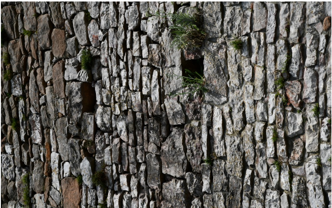
Fot. 12 Chęciny – Zamek Królewski Mur obwodowy południowy, zewnętrzny Stan przed konserwacją Fot. Marek Mazurek 2024
