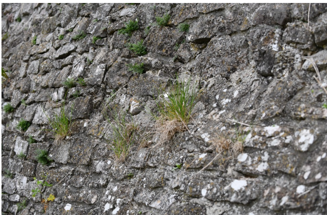
Fot. 50 Chęciny – Zamek Królewski Mur obwodowy północny, zewnętrzny Stan przed konserwacją Fot. Marek Mazurek 2024
