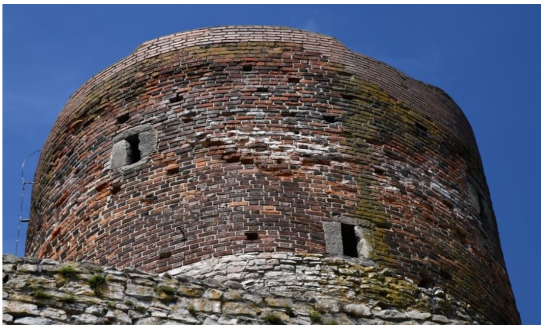
Fot. 147 Chęciny – Zamek Królewski Wieża wschodnia, mury zewnętrzne Stan przed konserwacją Fot. Marek Mazurek 2024
