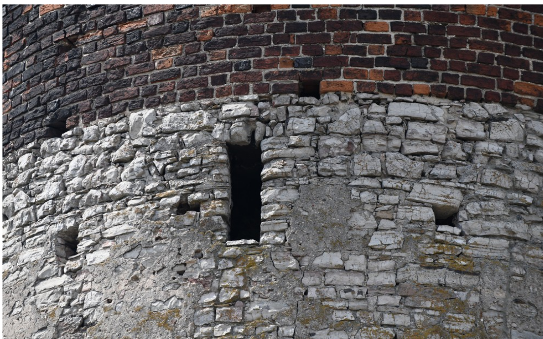
Fot. 151 Chęciny – Zamek Królewski Wieża wschodnia, mury zewnętrzne Stan przed konserwacją Fot. Marek Mazurek 2024
