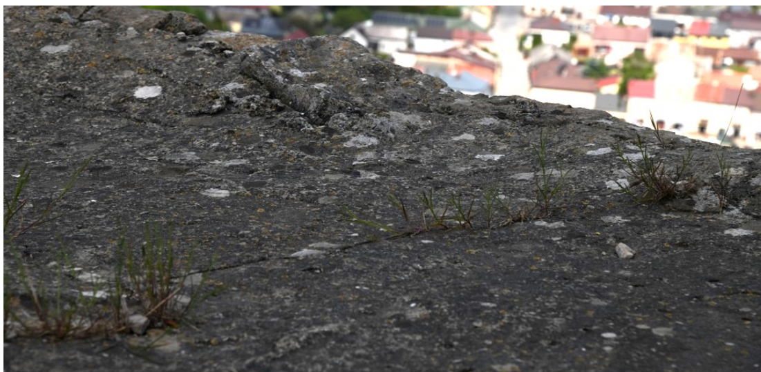
Fot. 64 Chęciny – Zamek Królewski Mur obwodowy północny, wewnętrzny, korona Stan przed konserwacją Fot. Marek Mazurek 2024
