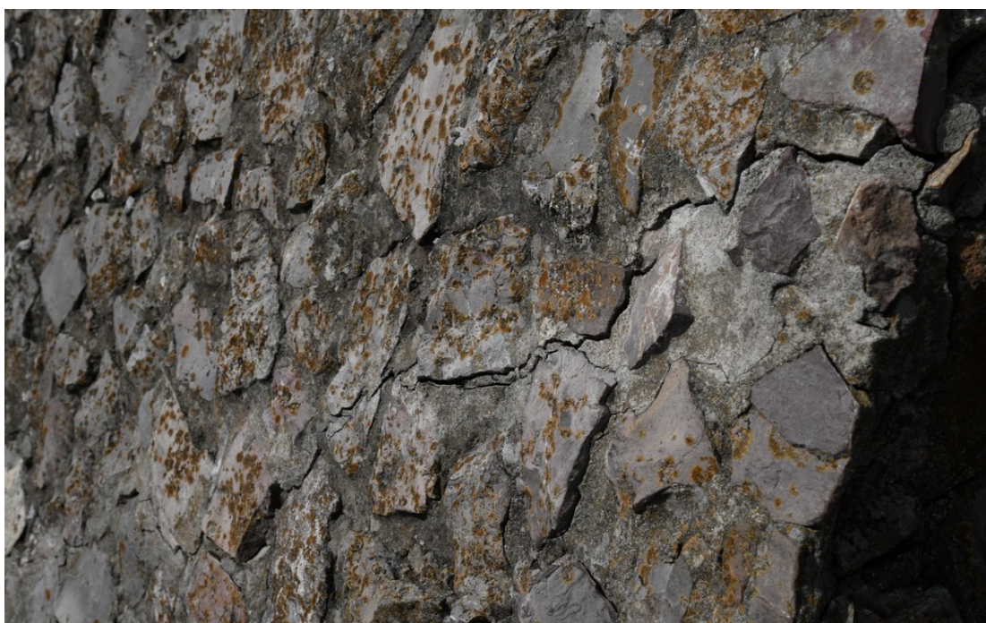
Fot. 30 Chęciny – Zamek Królewski Mur obwodowy południowy, wewnętrzny, korona Stan przed konserwacją Fot. Marek Mazurek 2024
