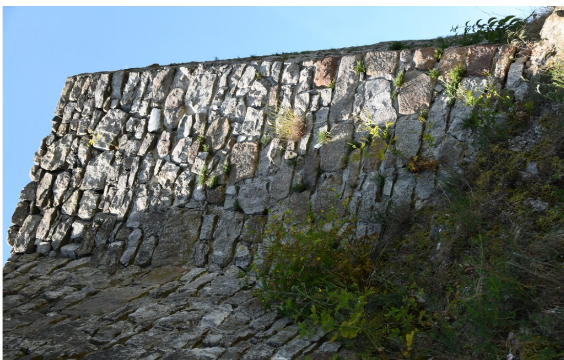
Fot. 48 Chęciny – Zamek Królewski Mur obwodowy północny, zewnętrzny Stan przed konserwacją Fot. Marek Mazurek 2024
