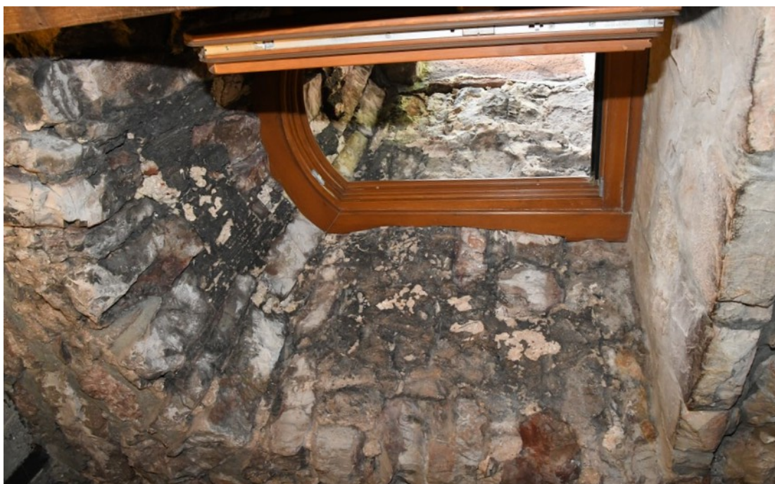
Fot. 125 Chęciny – Zamek Królewski Wieża zachodnia, mury wewnętrzne Stan przed konserwacją Fot. Marek Mazurek 2024
