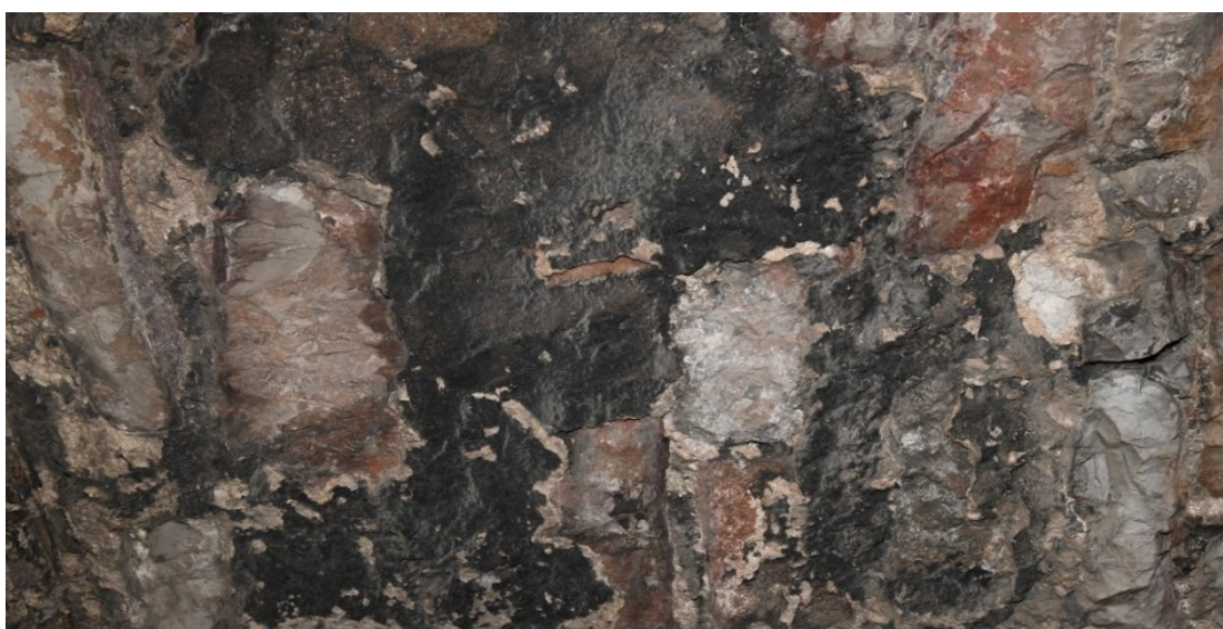
Fot. 126 Chęciny – Zamek Królewski Wieża zachodnia, mury wewnętrzne Stan przed konserwacją Fot. Marek Mazurek 2024
