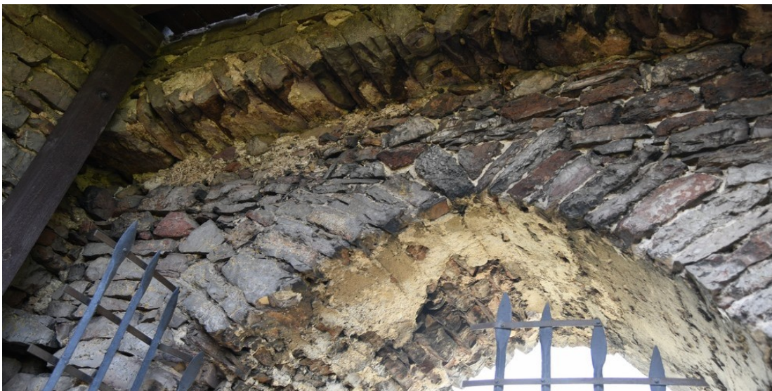
Fot. 77 Chęciny – Zamek Królewski Mur obwodowy zachodni, wewnętrzny Stan przed konserwacją Fot. Marek Mazurek 2024
