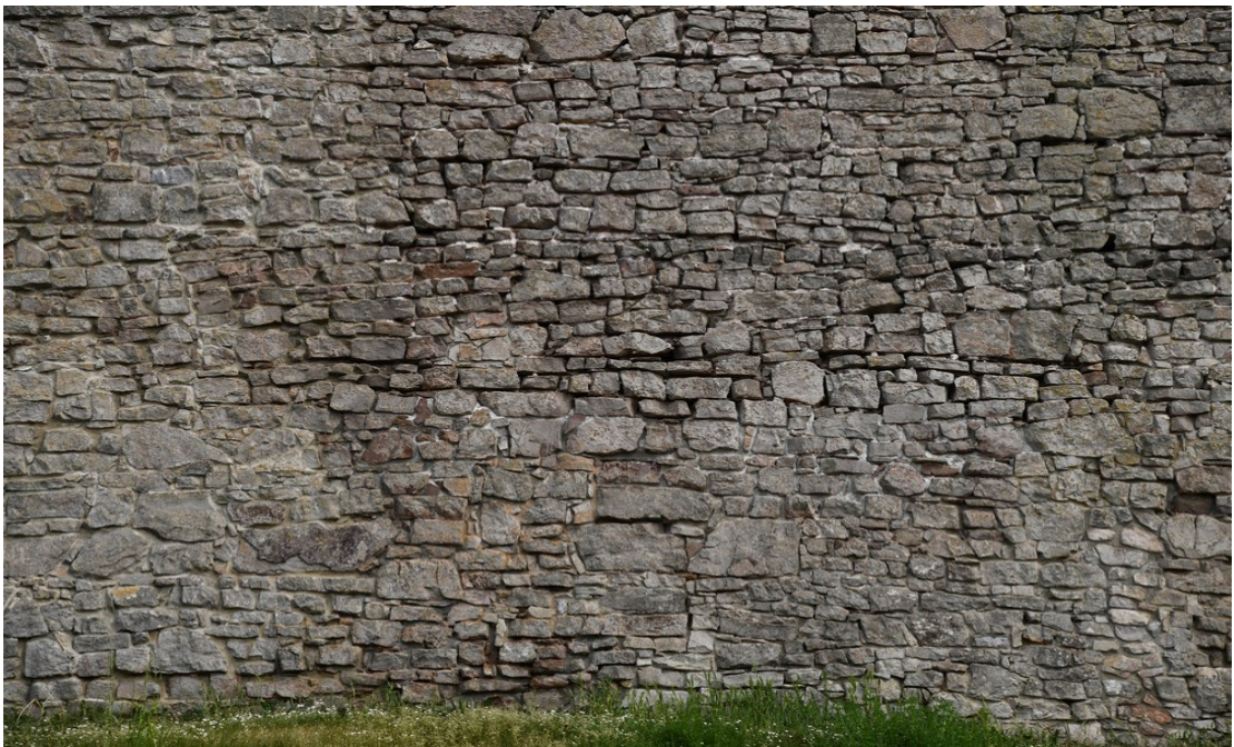
Fot. 74 Chęciny – Zamek Królewski Mur obwodowy zachodni, zewnętrzny Stan przed konserwacją Fot. Marek Mazurek 2024
