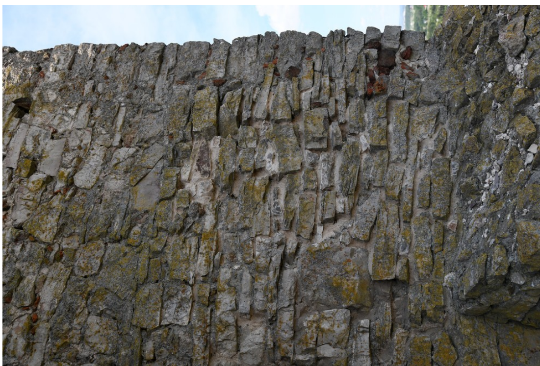
Fot. 112 Chęciny – Zamek Królewski Wieża zachodnia, mury zewnętrzne Stan przed konserwacją Fot. Marek Mazurek 2024
