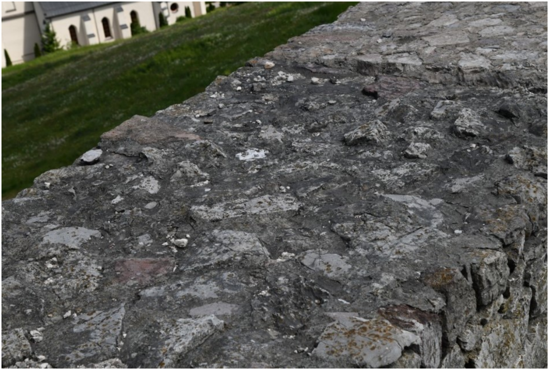
Fot. 59 Chęciny – Zamek Królewski Mur obwodowy północny, wewnętrzny, korona Stan przed konserwacją Fot. Marek Mazurek 2024
