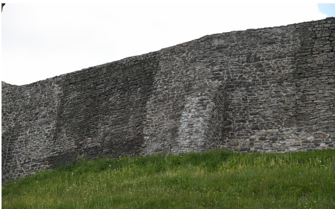
Fot. 46 Chęciny – Zamek Królewski Mur obwodowy północny, zewnętrzny Stan przed konserwacją Fot. Marek Mazurek 2024
