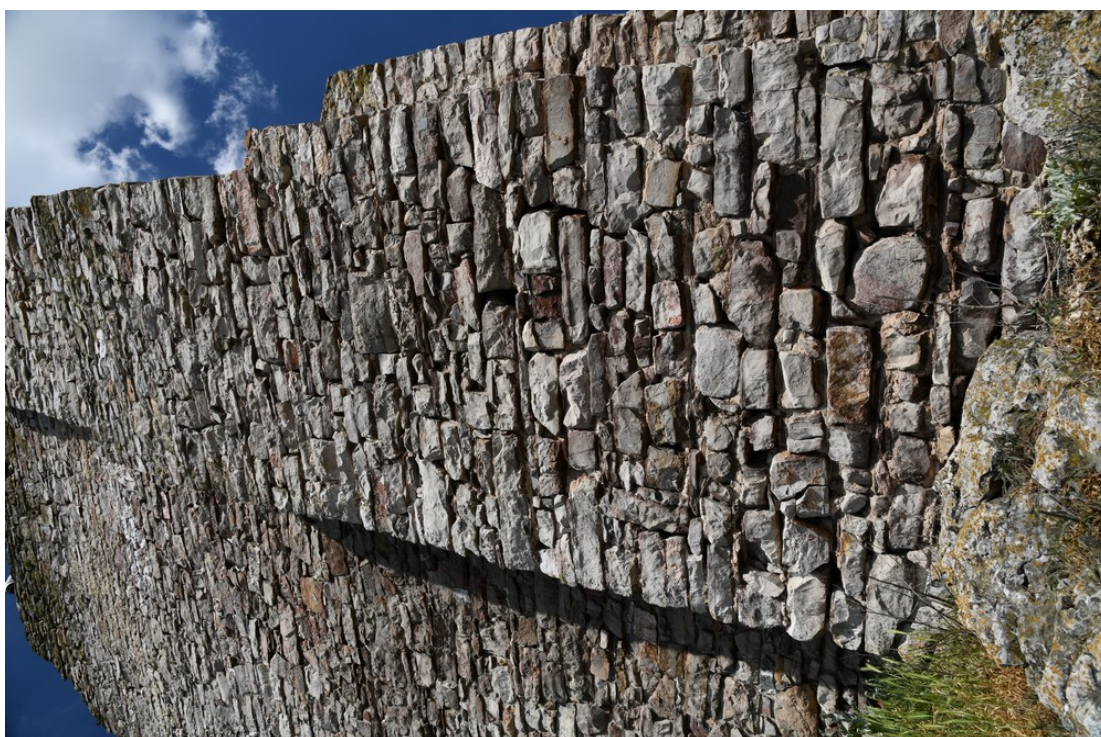
Fot. 7 Chęciny – Zamek Królewski Mur obwodowy południowy, zewnętrzny Stan przed konserwacją Fot. Marek Mazurek 2024
