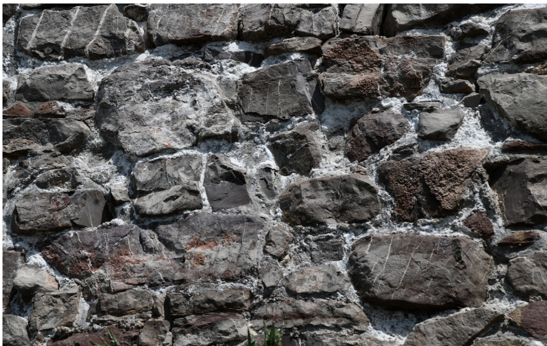
Fot. 14 Chęciny – Zamek Królewski Mur obwodowy południowy, zewnętrzny Stan przed konserwacją Fot. Marek Mazurek 2024
