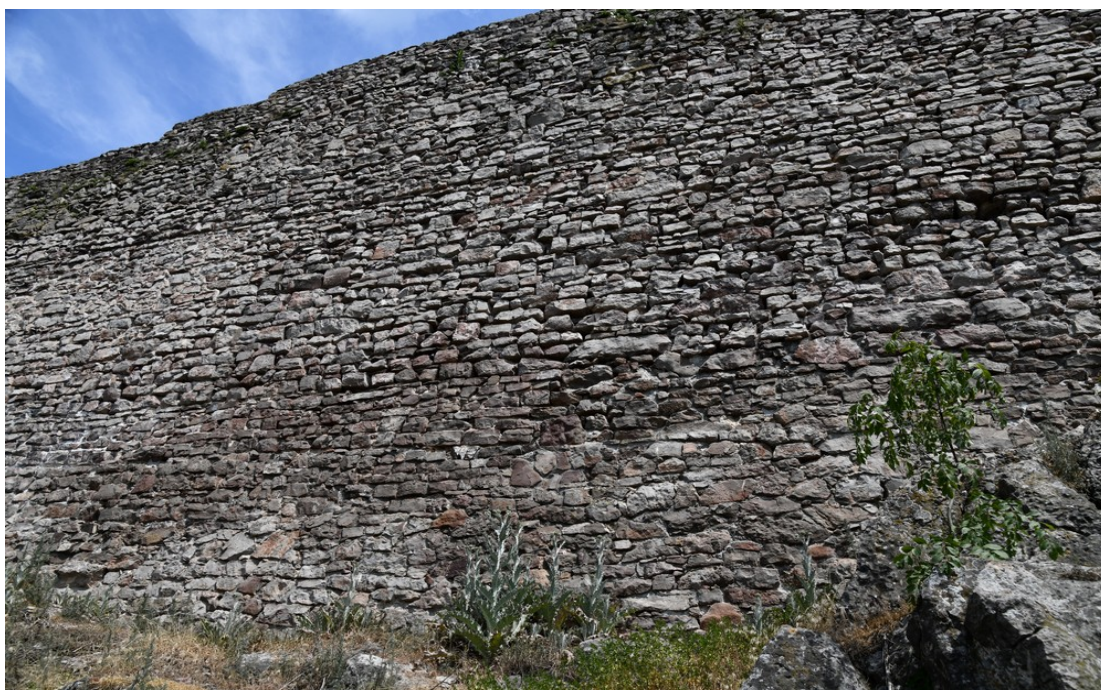
Fot. 17 Chęciny – Zamek Królewski Mur obwodowy południowy, zewnętrzny Stan przed konserwacją Fot. Marek Mazurek 2024
