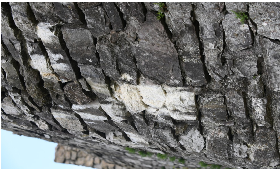
Fot. 49 Chęciny – Zamek Królewski Mur obwodowy północny, zewnętrzny Stan przed konserwacją Fot. Marek Mazurek 2024
