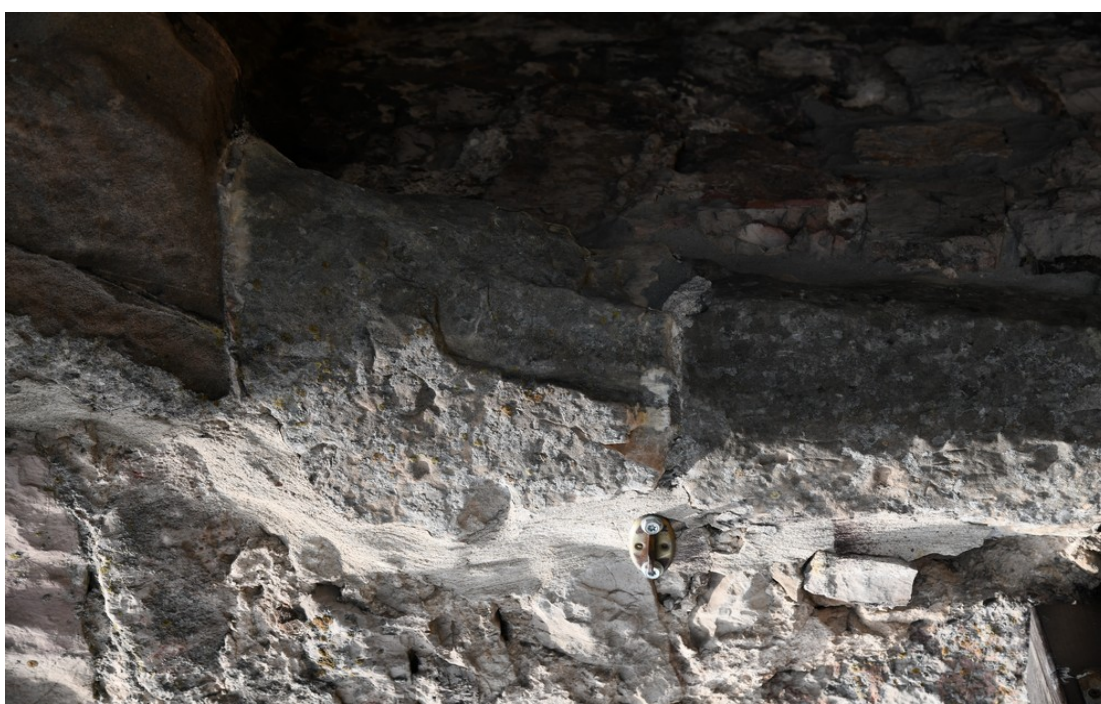
Fot. 116 Chęciny – Zamek Królewski Wieża zachodnia, mury zewnętrzne Stan przed konserwacją Fot. Marek Mazurek 2024
