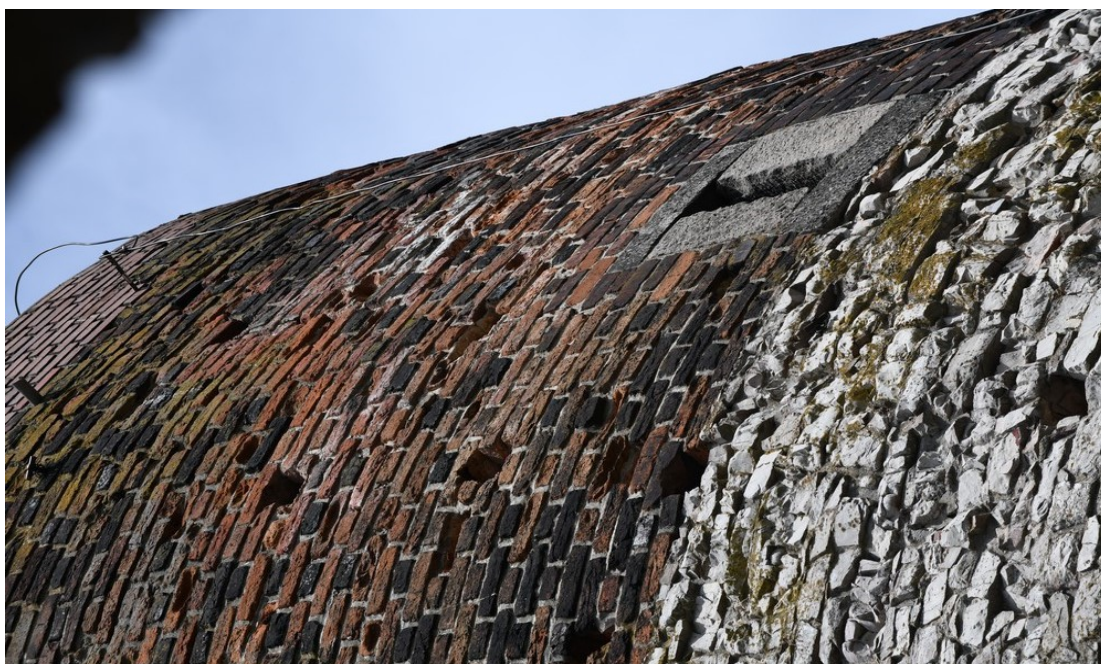
Fot. 148 Chęciny – Zamek Królewski Wieża wschodnia, mury zewnętrzne Stan przed konserwacją Fot. Marek Mazurek 2024
