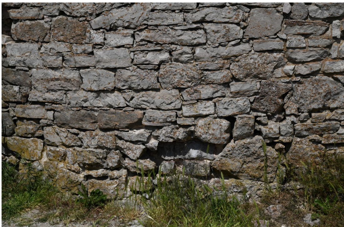
Fot. 139 Chęciny – Zamek Królewski Wieża środkowa, mury zewnętrzne Stan przed konserwacją Fot. Marek Mazurek 2024
