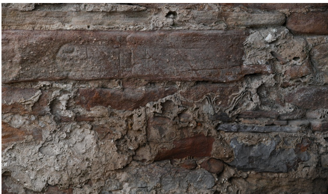
Fot. 96 Chęciny – Zamek Królewski Arkady Stan przed konserwacją Fot. Marek Mazurek 2024
