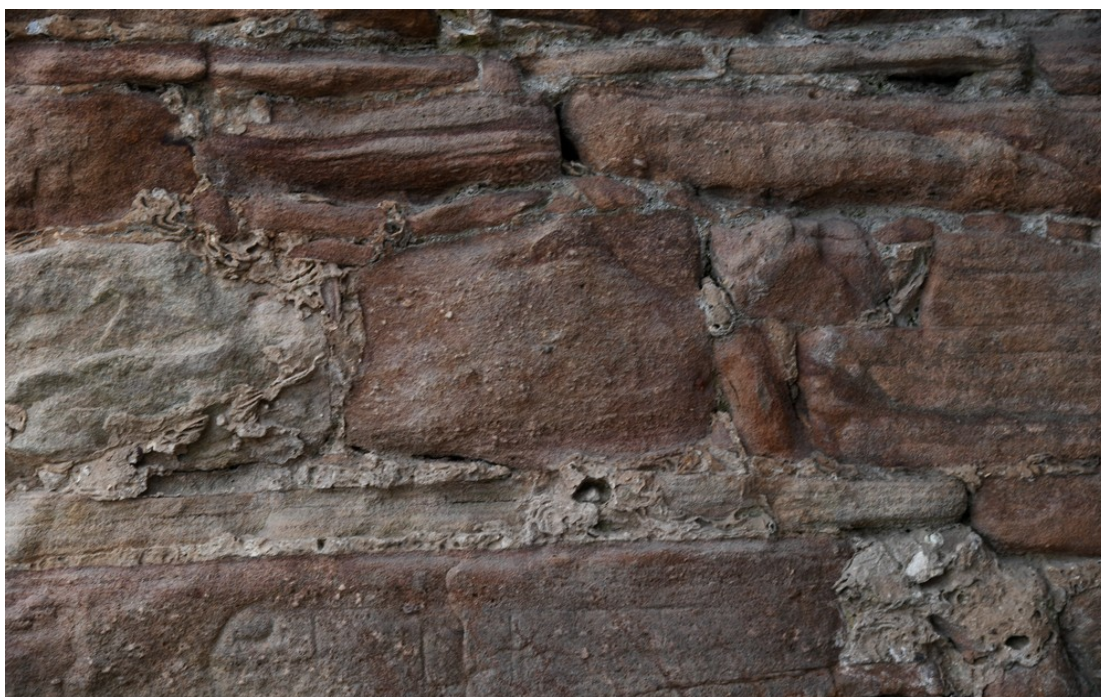
Fot. 95 Chęciny – Zamek Królewski Arkady Stan przed konserwacją Fot. Marek Mazurek 2024
