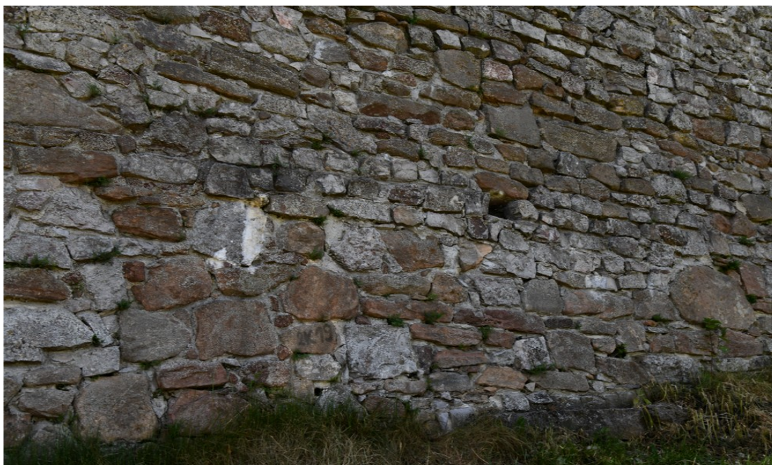
Fot. 53 Chęciny – Zamek Królewski Mur obwodowy północny, zewnętrzny Stan przed konserwacją Fot. Marek Mazurek 2024
