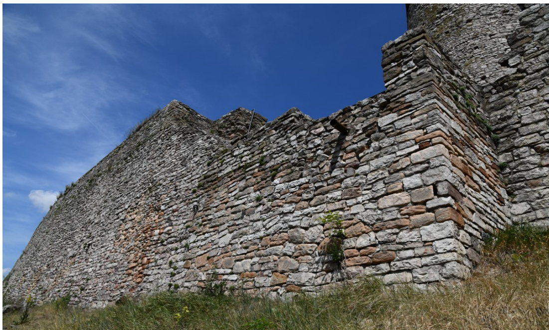
Fot. 5 Chęciny – Zamek Królewski Mur obwodowy południowy, zewnętrzny Stan przed konserwacją Fot. Marek Mazurek 2024
