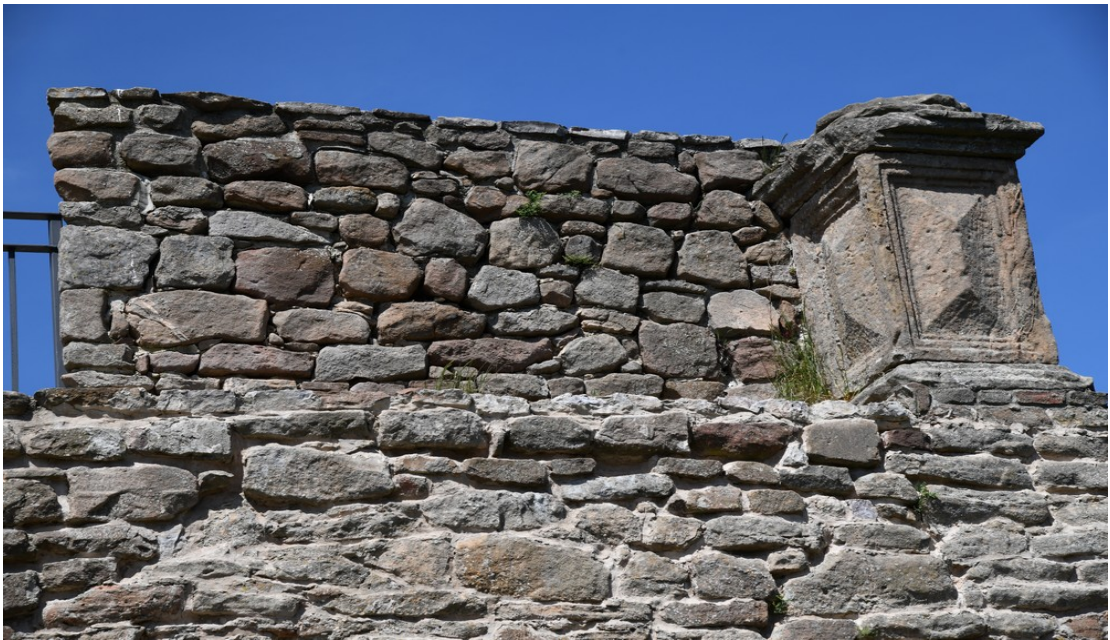
Fot. 37 Chęciny – Zamek Królewski Przedbramie wschodnie Stan przed konserwacją Fot. Marek Mazurek 2024
