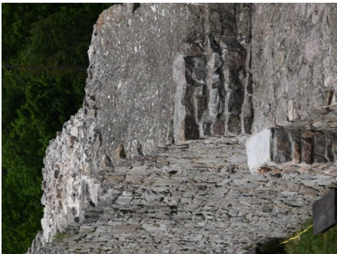
Fot. 61 Chęciny – Zamek Królewski Mur obwodowy północny, wewnętrzny, korona Stan przed konserwacją Fot. Marek Mazurek 2024
