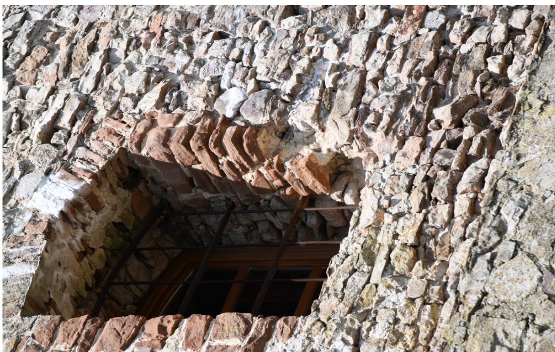
Fot. 152 Chęciny – Zamek Królewski Wieża wschodnia, mury zewnętrzne Stan przed konserwacją Fot. Marek Mazurek 2024
