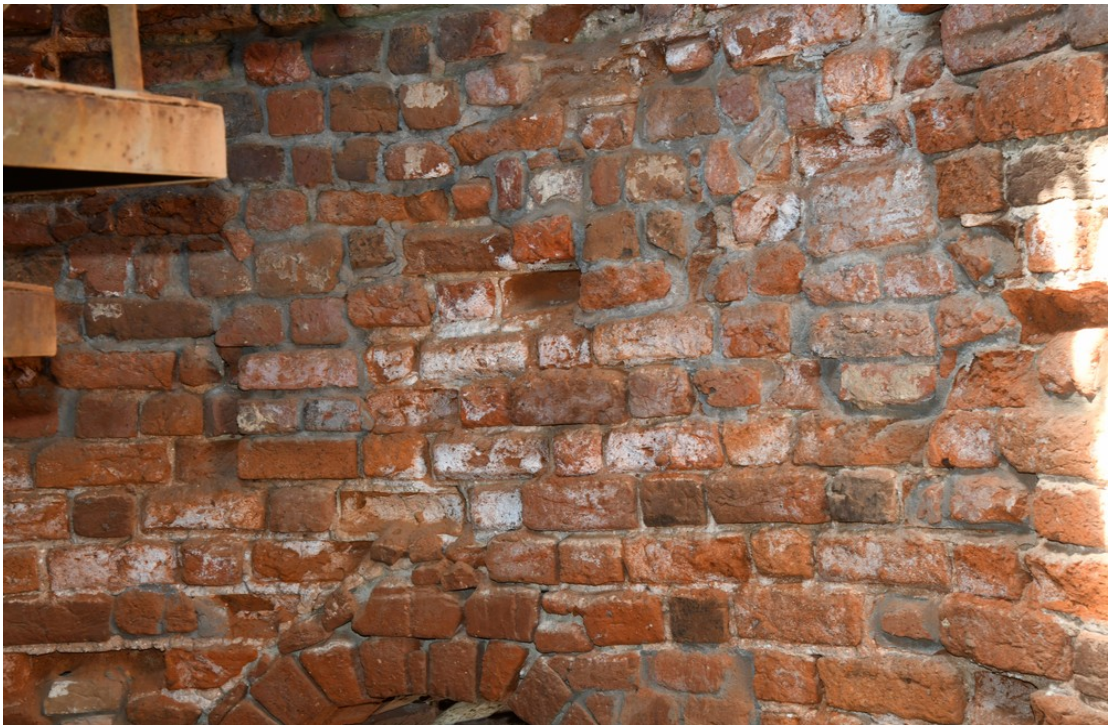
Fot. 155 Chęciny – Zamek Królewski Wieża wschodnia, mury wewnętrzne Stan przed konserwacją Fot. Marek Mazurek 2024
