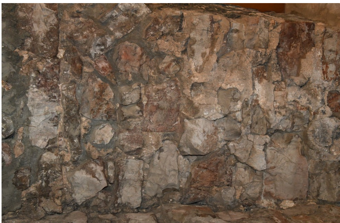
Fot. 124 Chęciny – Zamek Królewski Wieża zachodnia, mury wewnętrzne Stan przed konserwacją Fot. Marek Mazurek 2024
