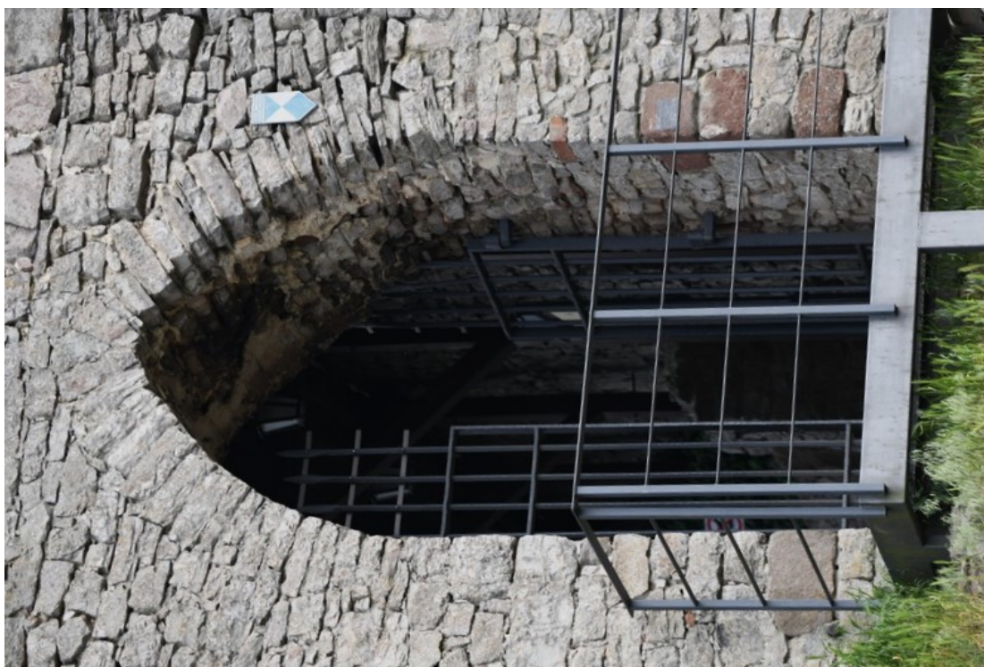
Fot. 72 Chęciny – Zamek Królewski Mur obwodowy zachodni, zewnętrzny, brama Stan przed konserwacją Fot. Marek Mazurek 2024
