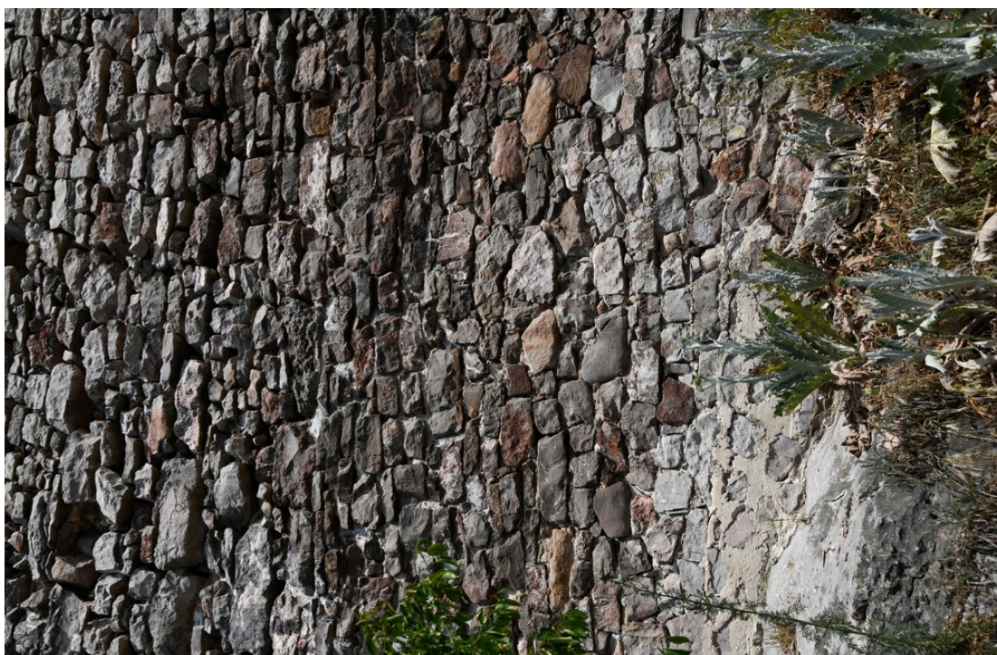
Fot. 16 Chęciny – Zamek Królewski Mur obwodowy południowy, zewnętrzny Stan przed konserwacją Fot. Marek Mazurek 2024
