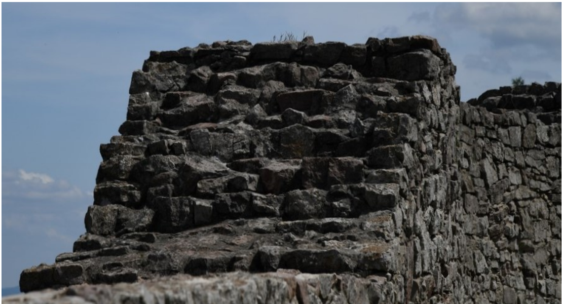
Fot. 60 Chęciny – Zamek Królewski Mur obwodowy północny, wewnętrzny, korona Stan przed konserwacją Fot. Marek Mazurek 2024
