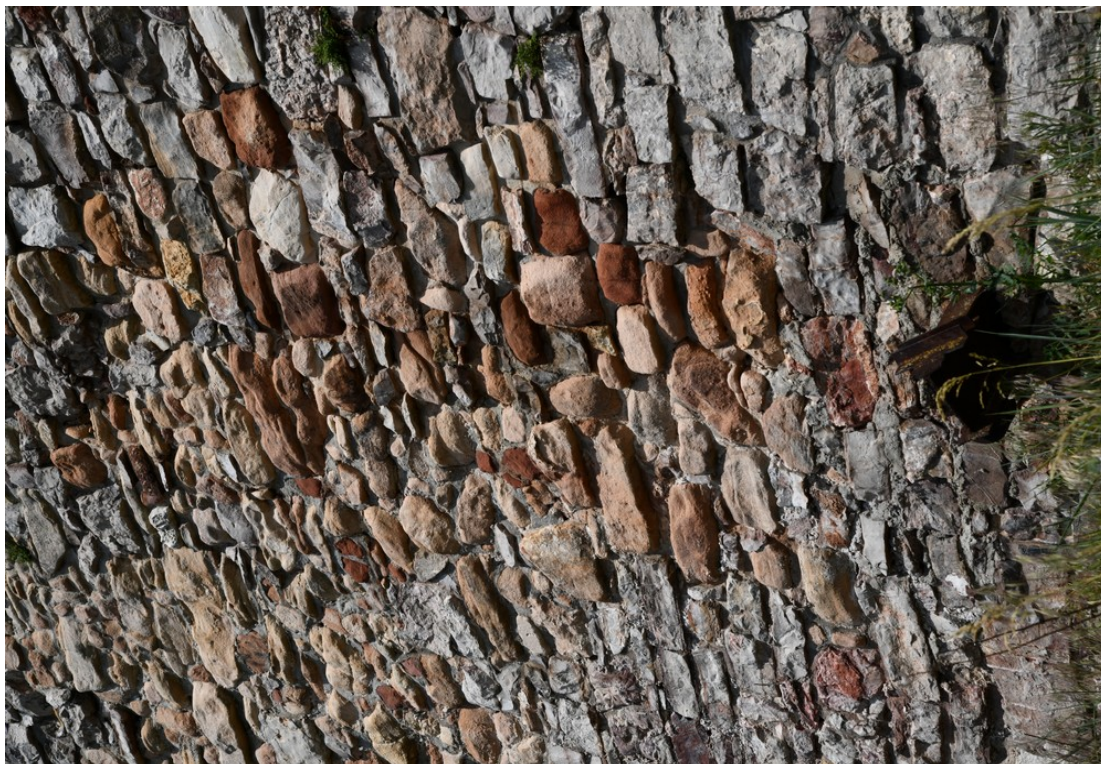
Fot. 8 Chęciny – Zamek Królewski Mur obwodowy południowy, zewnętrzny Stan przed konserwacją Fot. Marek Mazurek 2024
