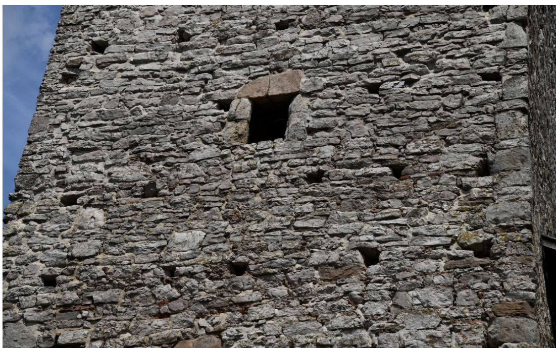
Fot. 111 Chęciny – Zamek Królewski Wieża zachodnia, mury zewnętrzne Stan przed konserwacją Fot. Marek Mazurek 2024
