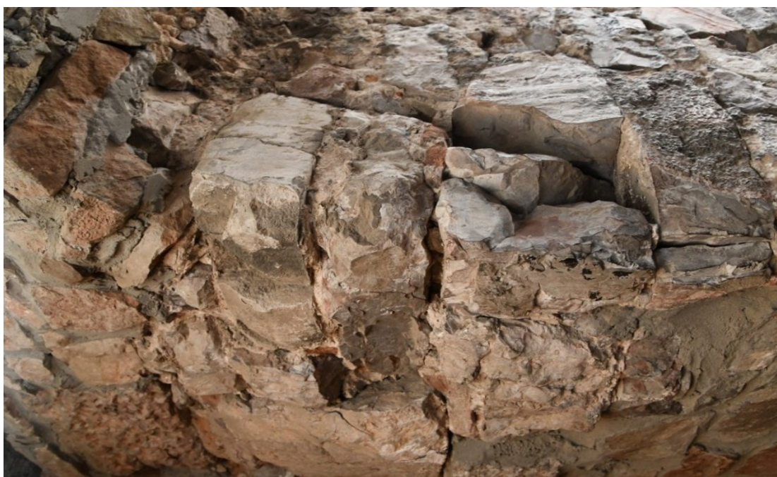
Fot. 128 Chęciny – Zamek Królewski Wieża zachodnia, mury wewnętrzne Stan przed konserwacją Fot. Marek Mazurek 2024
