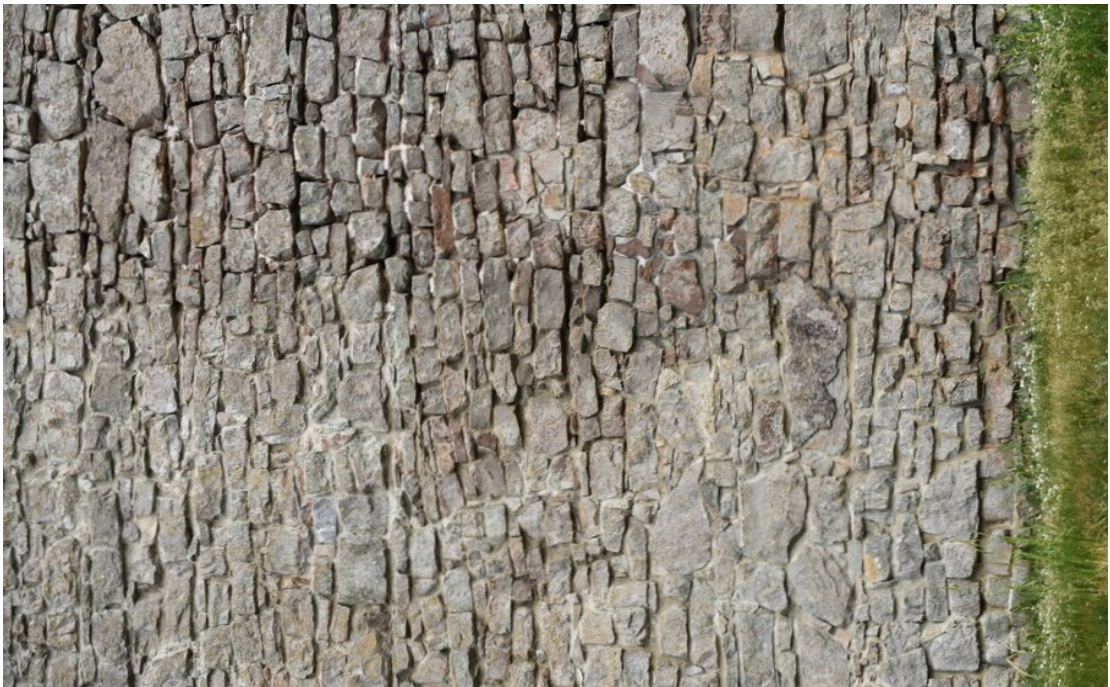
Fot. 73 Chęciny – Zamek Królewski Mur obwodowy zachodni, zewnętrzny Stan przed konserwacją Fot. Marek Mazurek 2024
