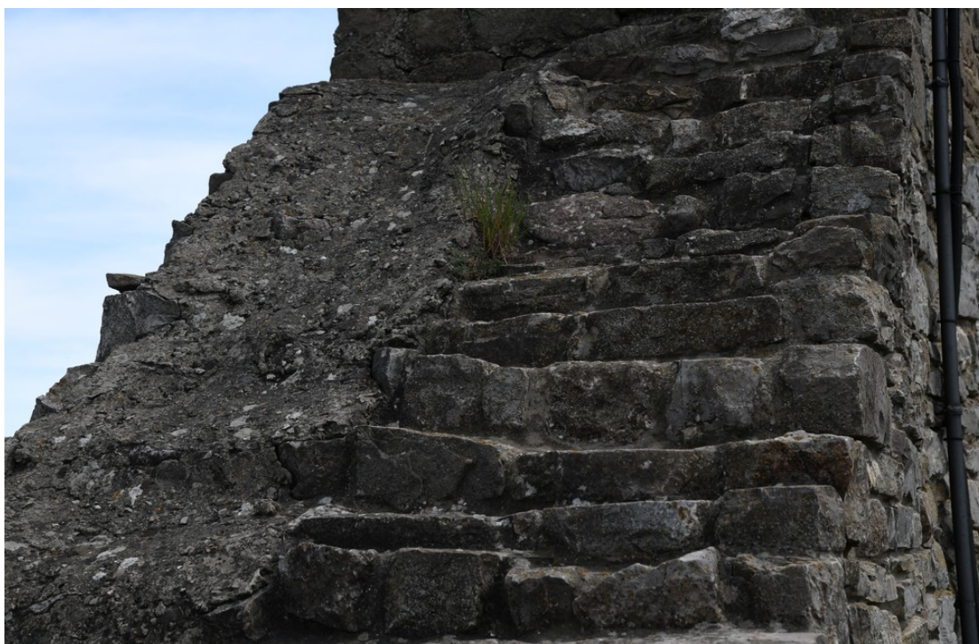
Fot. 63 Chęciny – Zamek Królewski Mur obwodowy północny, wewnętrzny, korona Stan przed konserwacją Fot. Marek Mazurek 2024
