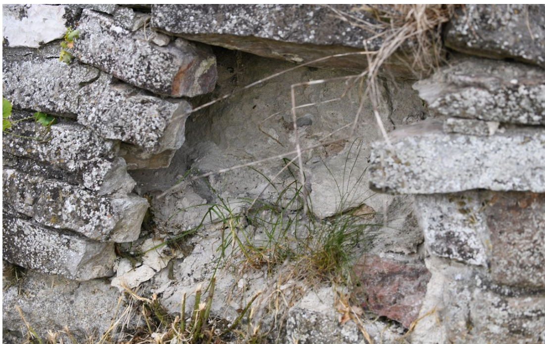
Fot. 52 Chęciny – Zamek Królewski Mur obwodowy północny, zewnętrzny Stan przed konserwacją Fot. Marek Mazurek 2024
