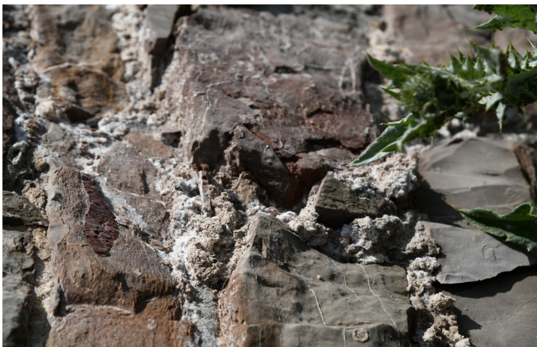
Fot. 15 Chęciny – Zamek Królewski Mur obwodowy południowy, zewnętrzny Stan przed konserwacją Fot. Marek Mazurek 2024
