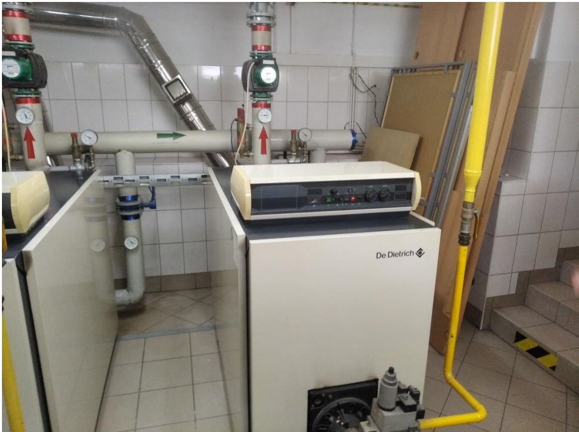
Rysunek 2. Kocioł gazowy wykorzystywany w budynku
