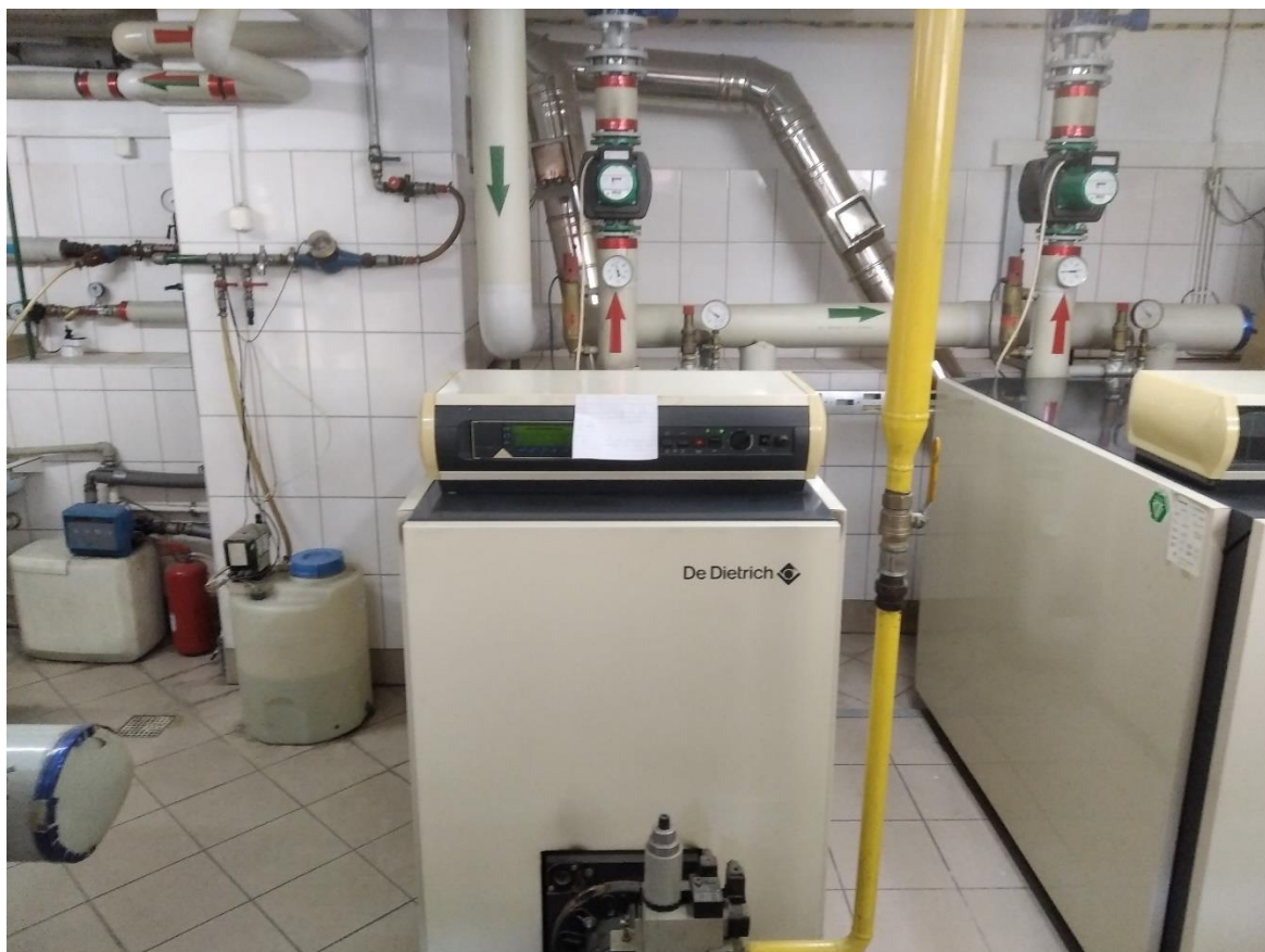
Rysunek 1. Kocioł gazowy wykorzystywany w budynku
