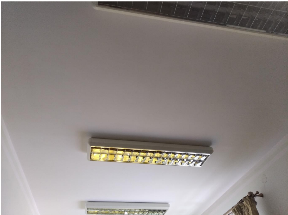
Rysunek 5. Obecne oświetlenie w rozpatrywanym budynku
