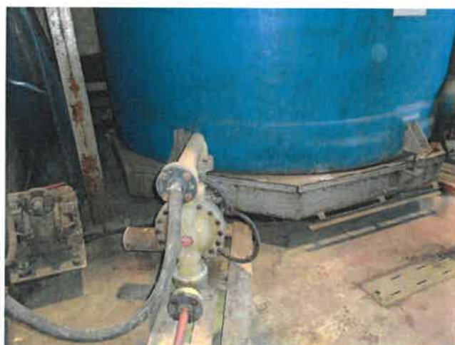
Fot. 2 Widok posadzki (strefa 1) pokrytej żywicą, w centralnym planie widoczny reaktor tworzywowy, po prawej odwodnienie liniowe.
