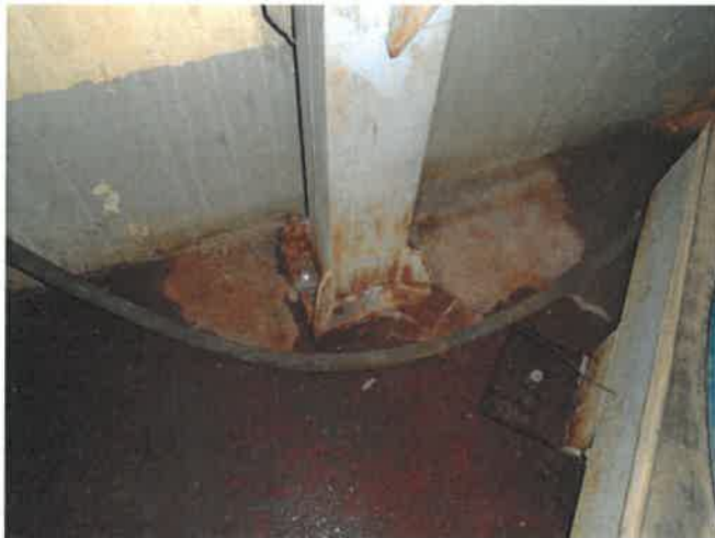
Fot. 5 Widok podstawy słupa stalowego konstrukcji wsporczej pomostu przy ścianie zewnętrznej, po prawej fragment podstawy łagownika (strefa 1).
