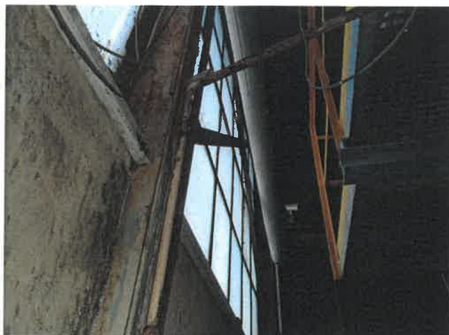
Fot. 1 Słup stalowy konstrukcji hali wystający od wewnątrz pomieszczenia z lica ściany zewnętrznej.
