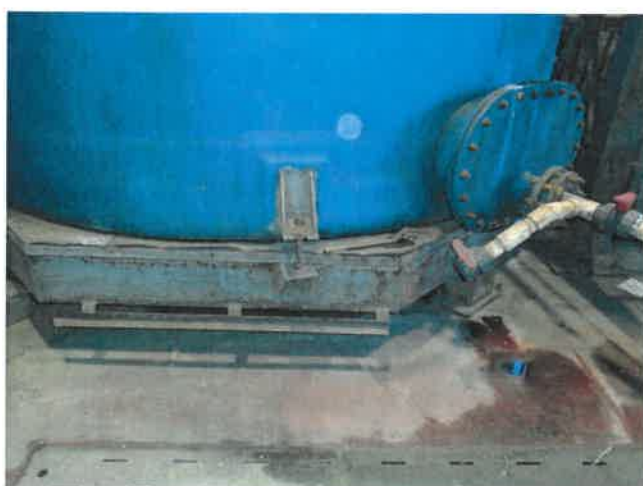
Fot. 3 Widok istniejącej posadzki (strefa 1) pokrytej żywicą, u dołu widoczna kratka ściekowa.
