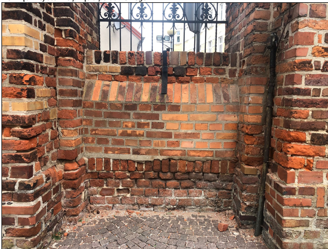
Il. 7. Wewnętrzna strona przęsa północnego bramy. Zachowana pierwotna metaloplastyka, lico ceglane w znacznym stopniu zużyte lub lokalnie wymienione w trakcie kolejnych remontów.
