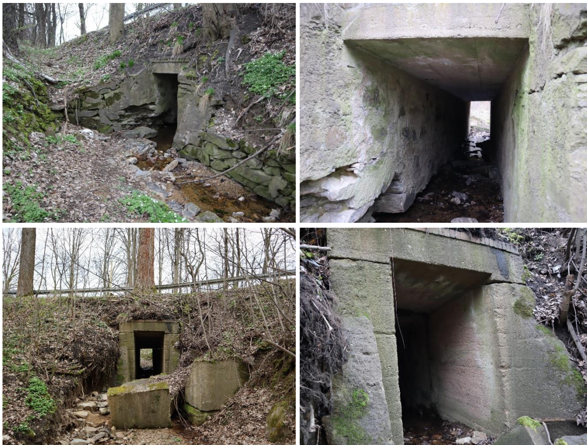
Fot. Obiekt mostowy nr 2. Górna woda, wewnątrz obiektu, dolna woda (DP 2466D, stan 03.2024 r.).
