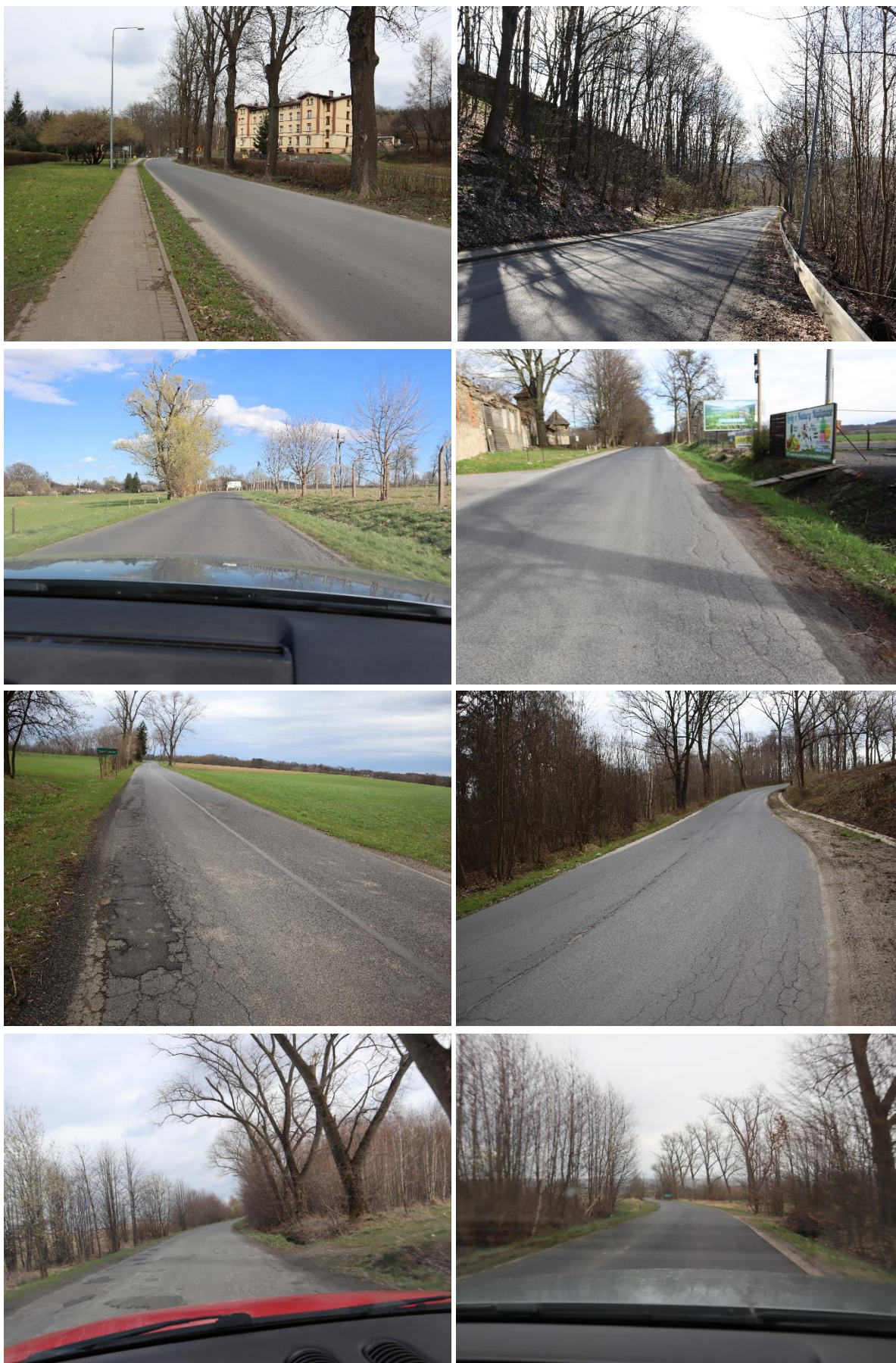
Fot. Stan nawierzchni jezdni na różnych odcinkach drogi powiatowej nr 2466D (DP 2466D, stan 03-04.2024 r.).
