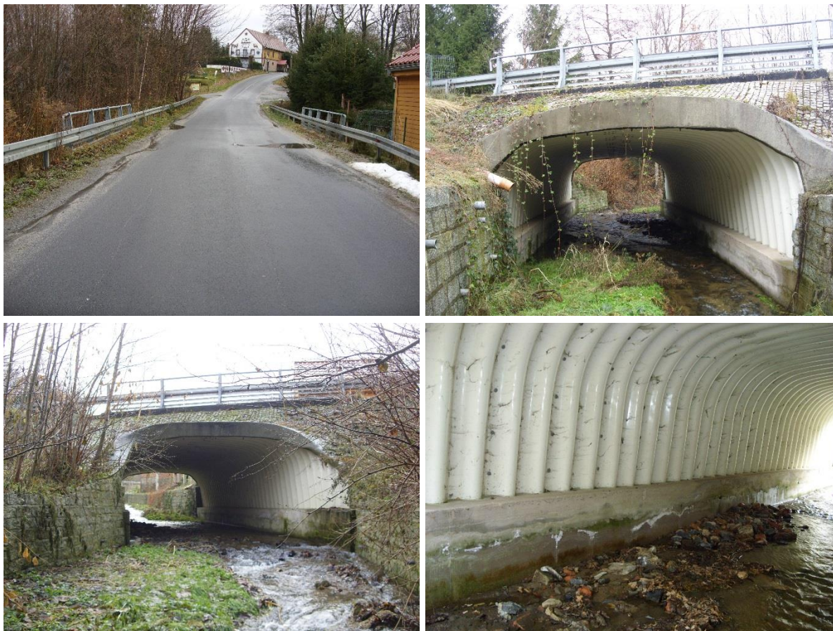
Fot. Obiekt mostowy nr 1. Widok ogólny, górna woda, dolna woda, wewnątrz obiektu (DP 2466D, stan 12.2023 r.).
