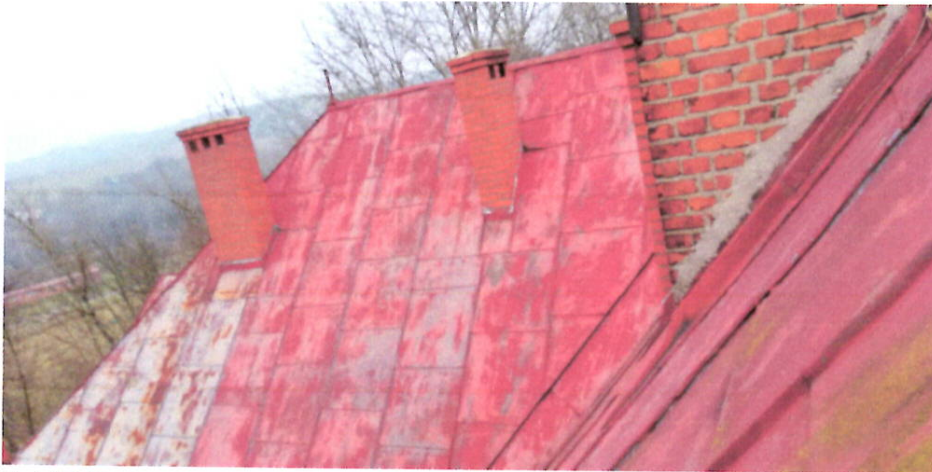
Fot.17. Dach budynku - pokrycie z blachy ocynkowanej płaskiej na rąbek stojący – wyraźnie widoczne uszkodzenia blachy (ślady korozji) oraz ochronnych powłok malarskich.
