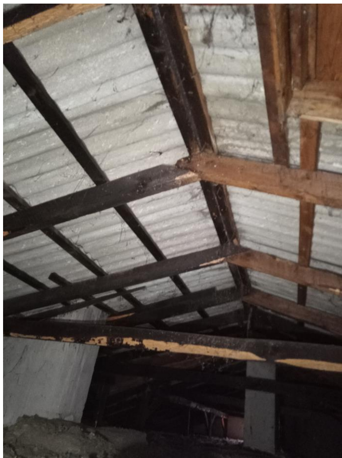
Fot. 4 Stan istniejący więźby i pokrycia dachu
