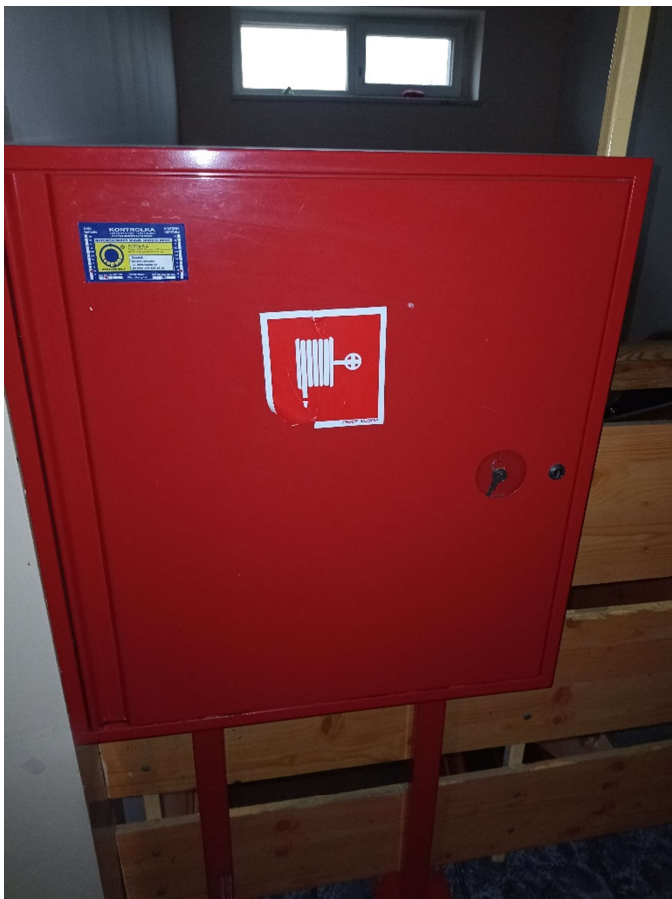
Fot.63 Widok szafki hydrantowej na klatce schodowej.
