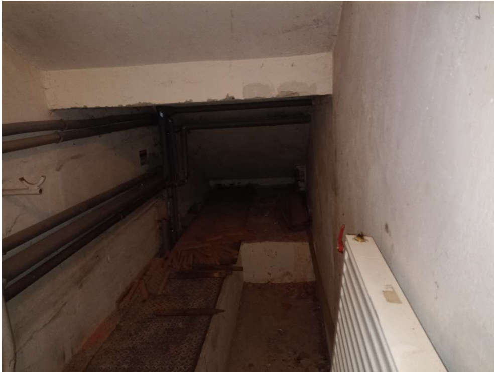
Fot.24 Widok pomieszczenia z instalacjami sanitarnymi – parter.
