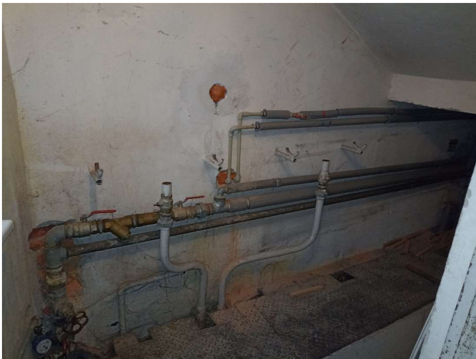
Fot.23 Widok pomieszczenia z instalacjami sanitarnymi – parter.
