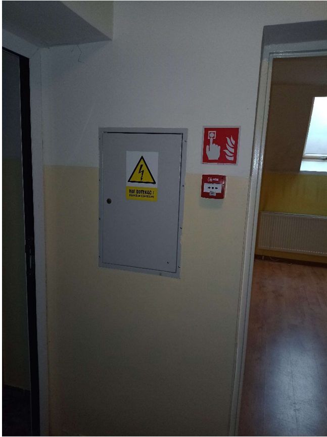
Fot.41 Widok ściany w korytarzu z urządzeniem elektrycznym - I piętro.
