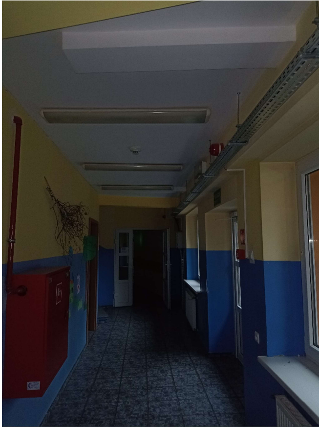
Fot.28 Widok korytarza w łączniku z drzwiami wejściowymi do segmentu B i szafką hydrantową – parter.
