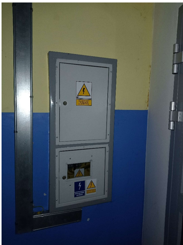
Fot.29 Widok ściany z tablicą rozdzielczą w łączniku – parter.
