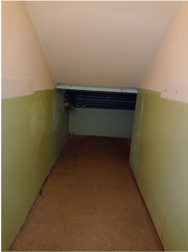
Fot. 20 Widok schowka pod schodami z instalacjami – parter.
