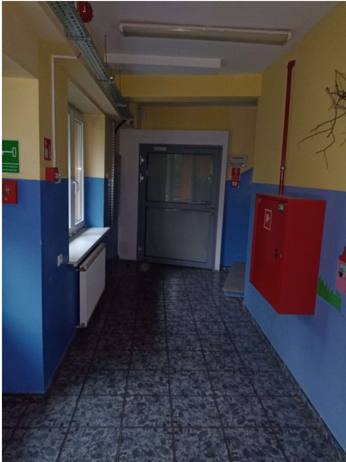
Fot.22 Widok korytarza z drzwiami do OIK, z szafka hydrantową w łączniku – parter.
