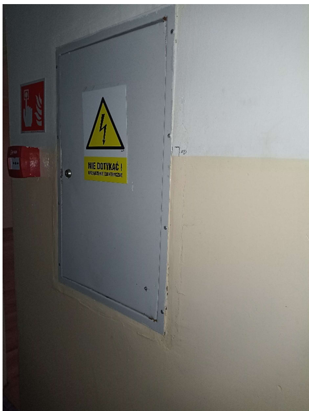
Fot.53 Widok ściany z urządzeniem elektrycznym – I piętro.
