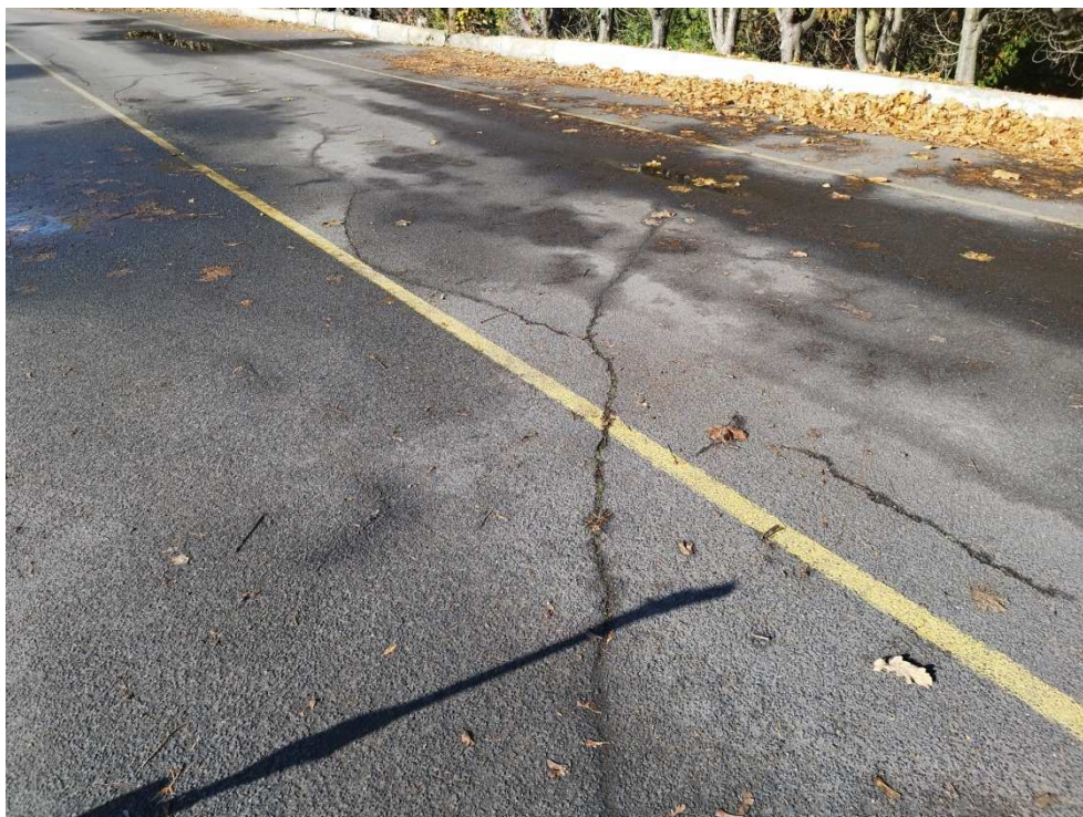
Naprawa pęknięć poprzecznych np. przy użyciu żywic bitumicznych (usunięcie roślinności, oczyszczenie pęknięcia, aplikacja wypełnienia)
