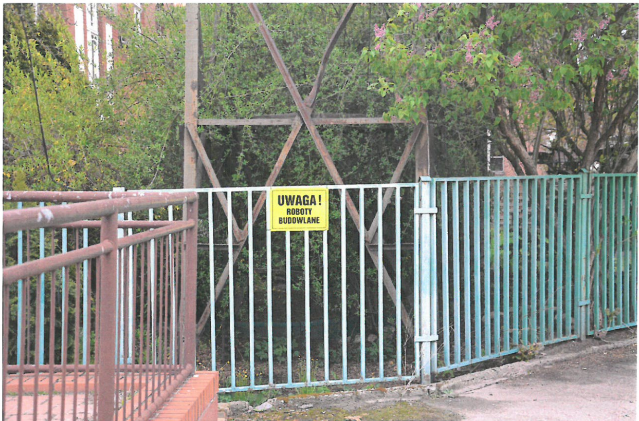
Fot. 3. Wschodnia część działki 27/13 – lokalizacja wieży, ogrodzenie obszaru wokół wieży, roślinność u podstawy wieży
