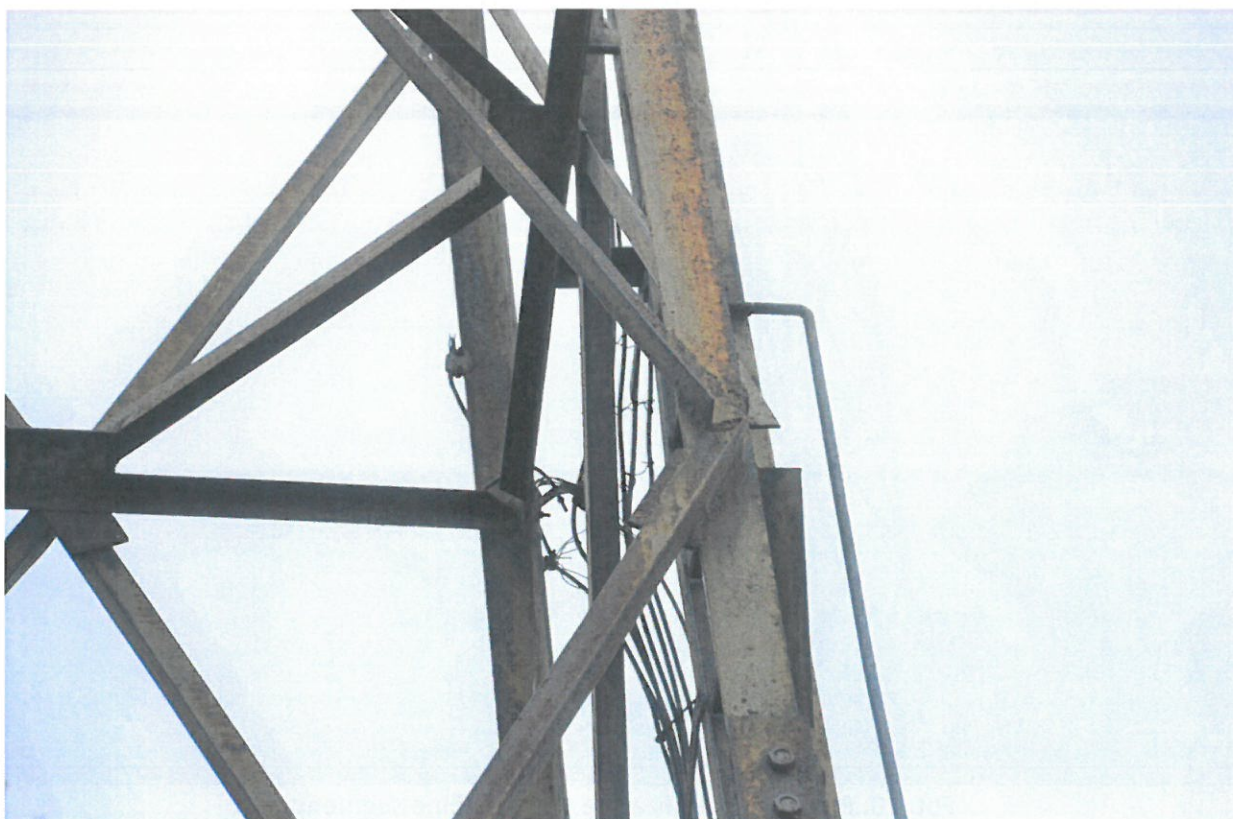
Fot. 12. Połączenie segmentów – widoczne spawane połączenie stężeń z krawężnikami
