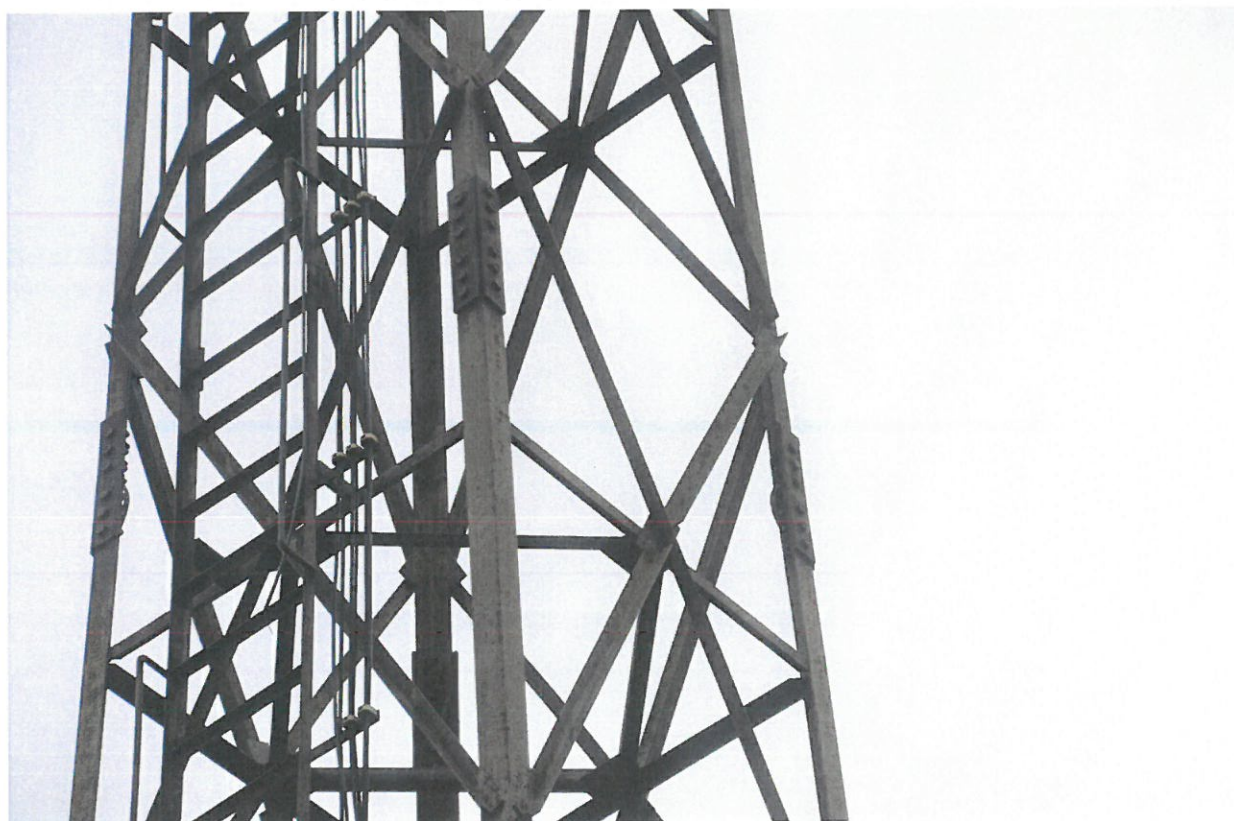
Fot. 11. Drabina komunikacyjna wraz z trasą kablową
