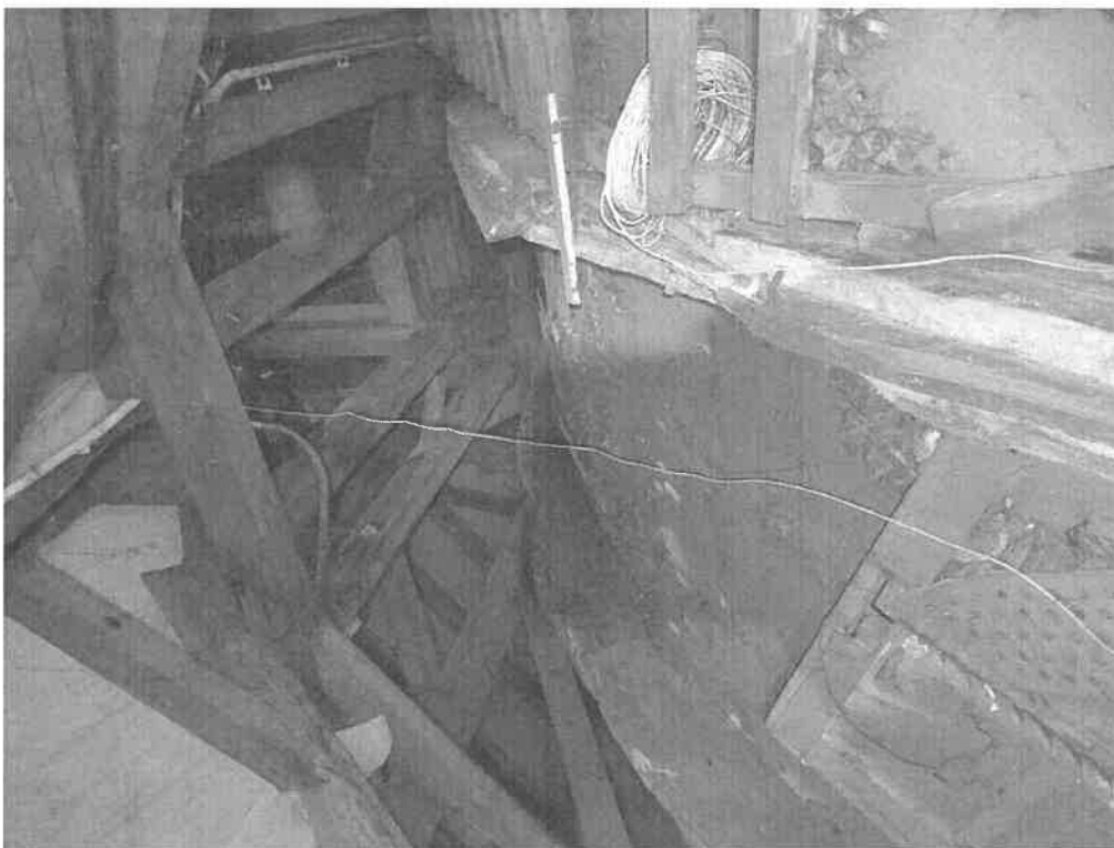
fot. nr 7 – konstrukcja lekkiego sufitu kolebowego nad nawą główną z śladami wyraźnej korozji biologicznej
