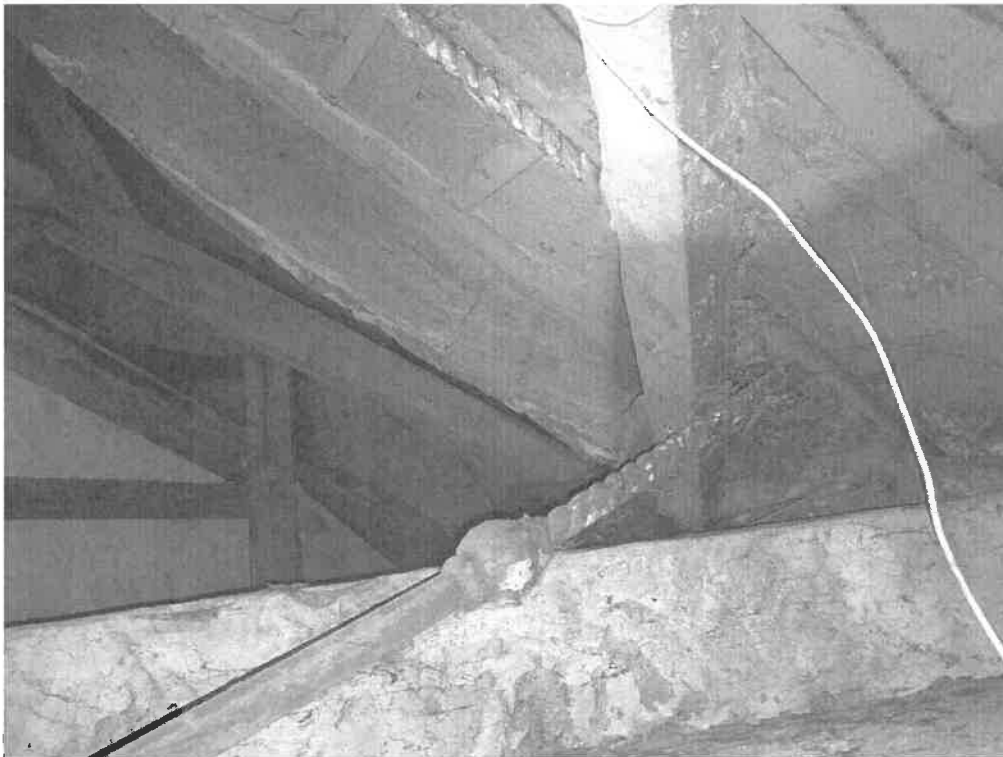
fot. nr 6 – konstrukcja lekkiego sufitu kolebowego nad nawą główną z śladami wyraźnej korozji biologicznej
