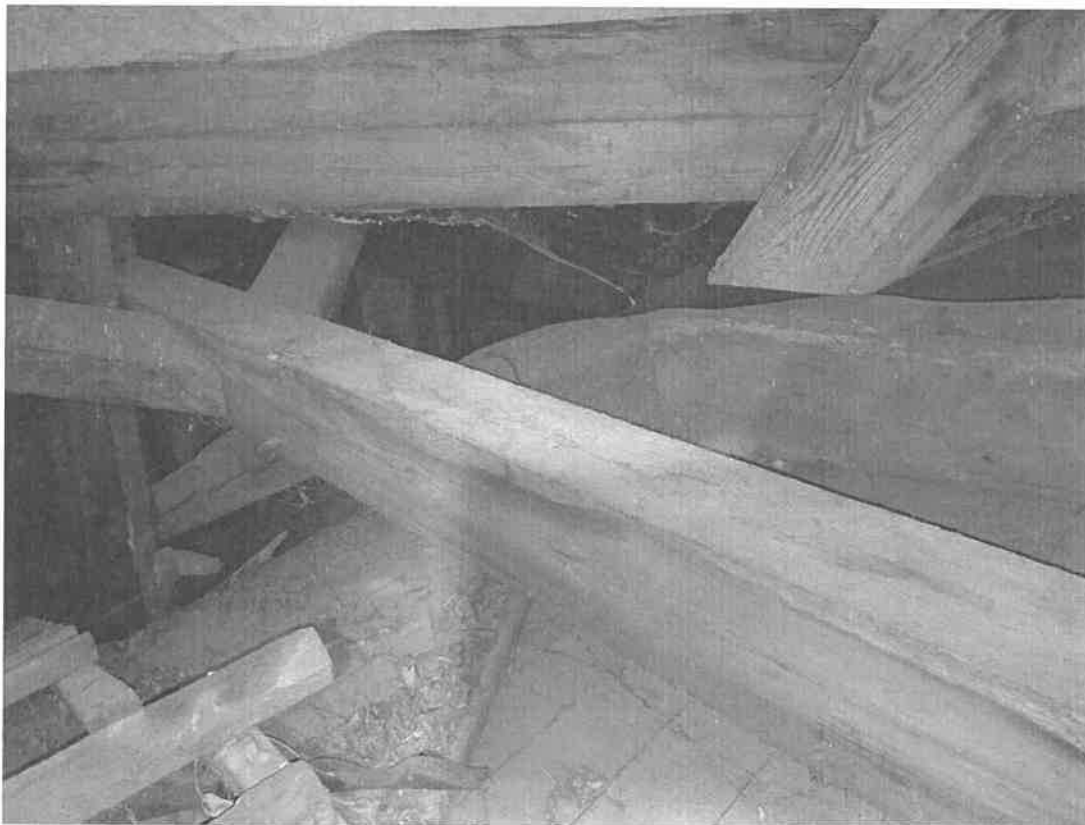
fot. nr 9 – konstrukcja lekkiego sufitu kolebowego nad nawą główną z śladami wyraźnej korozji biologicznej
