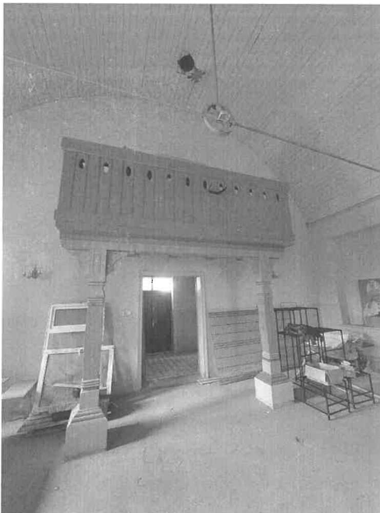
fot. nr 5 – nawa główna – widok na chór, strop kolebowy z śladami korozji biologicznej
