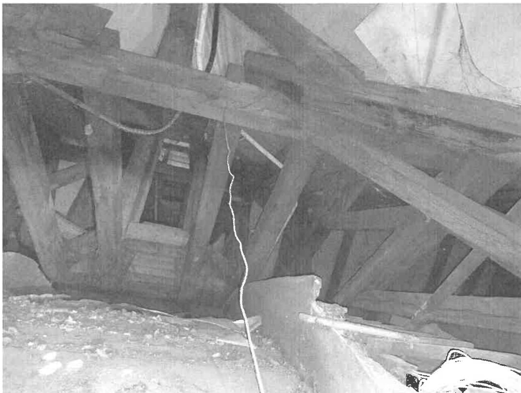
fot. nr 10 – konstrukcja lekkiego sufitu kolebowego nad nawą główną z śladami wyraźnej korozji biologicznej
