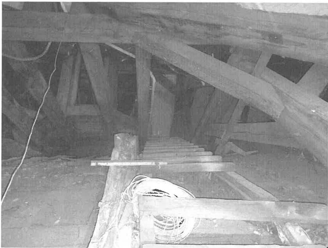
fot. nr 8 – konstrukcja lekkiego sufitu kolebowego nad nawą główną z śladami wyraźnej korozji biologicznej
