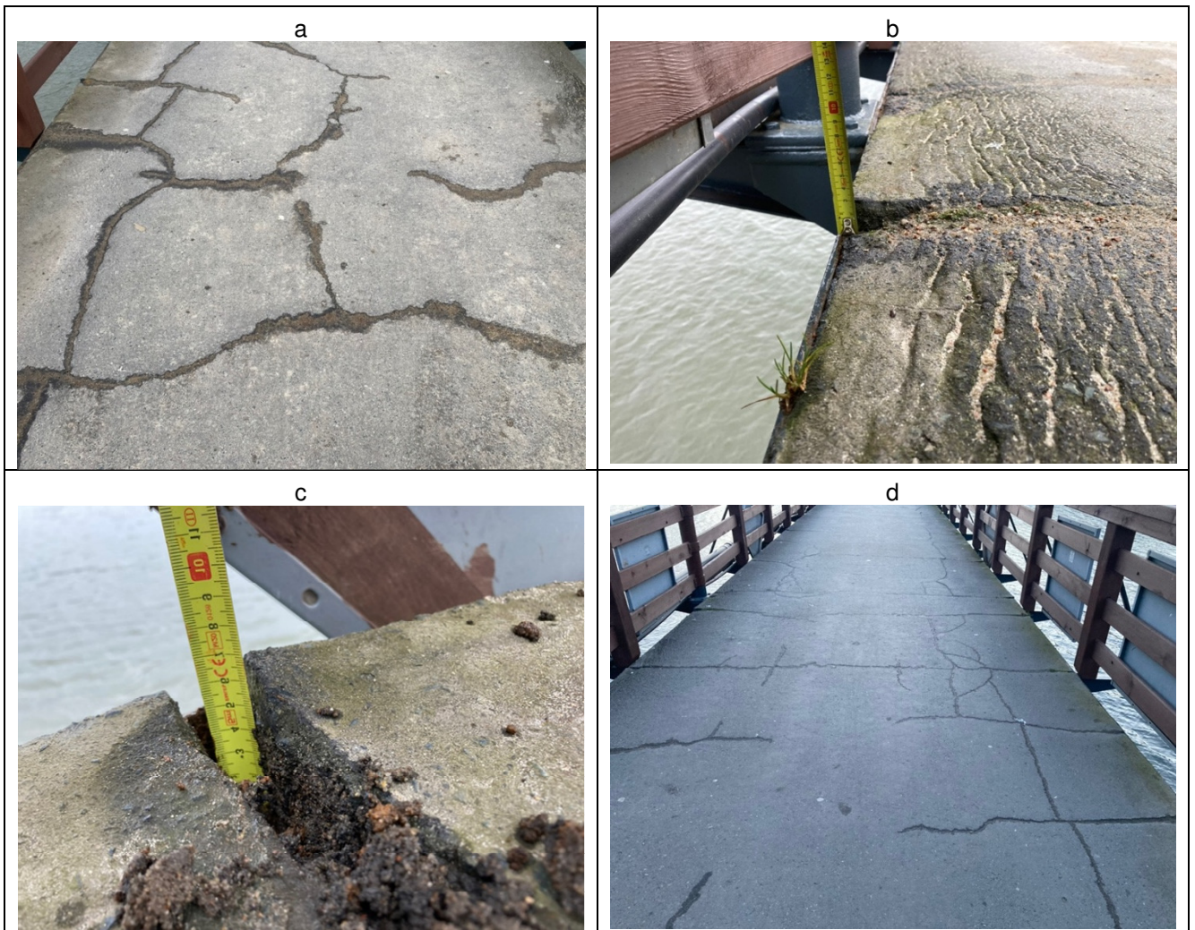
Fotografia nr 8a,b,c,d, – Deformacje, rysy i pęknięcia nawierzchni kładki
