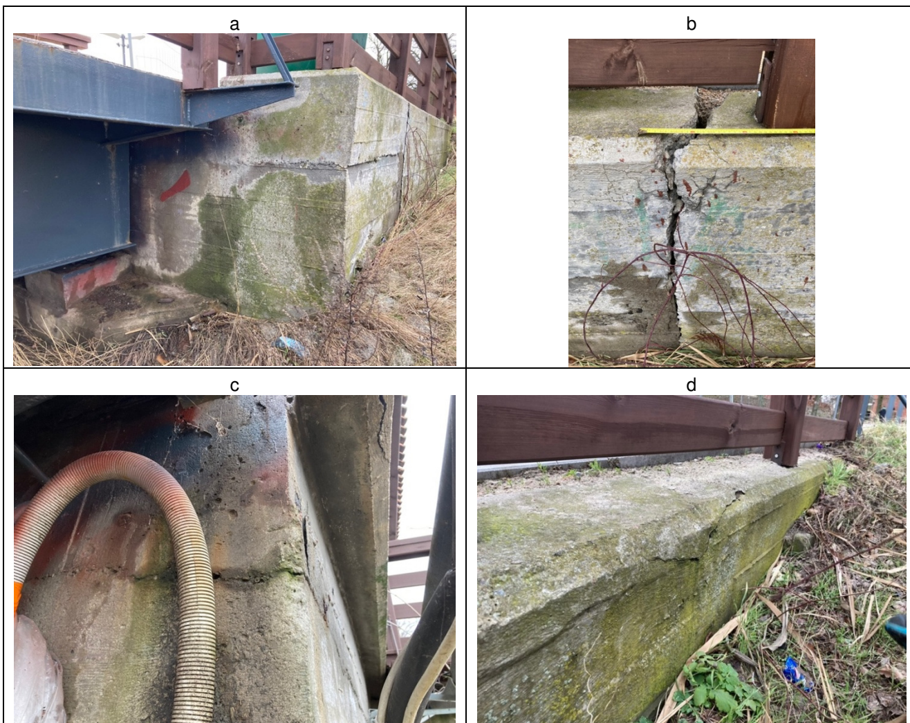
Fotografia nr 11a,b,c,d – Beton przyczółków. Zarysowania, pęknięcia, korozja i ubytki.
