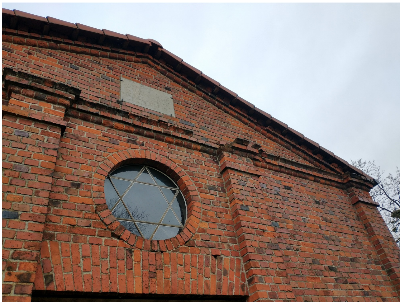
Fot. 1. Ubytki cegły w pasie gzymsu na ścianie frontowej.
