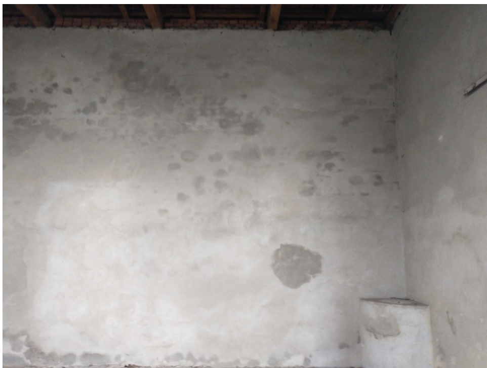
Fot. 11. Zawilgocenia ściany wewnątrz budynku.
