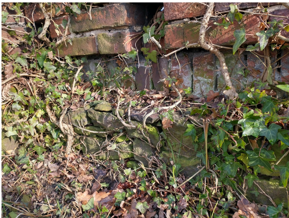
Fot. 15. Kamienna podmurówka zniszczona, porośnięta trawą i samosiejkami.
