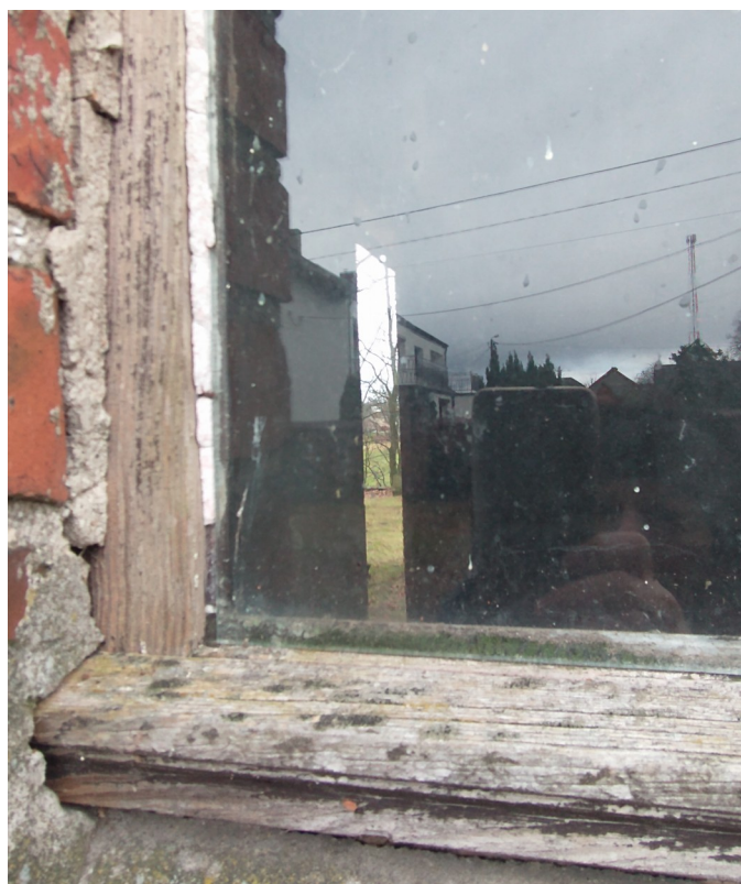
Fot. 7. Wypłukana farba i jej pozostałości na powierzchni okien.
