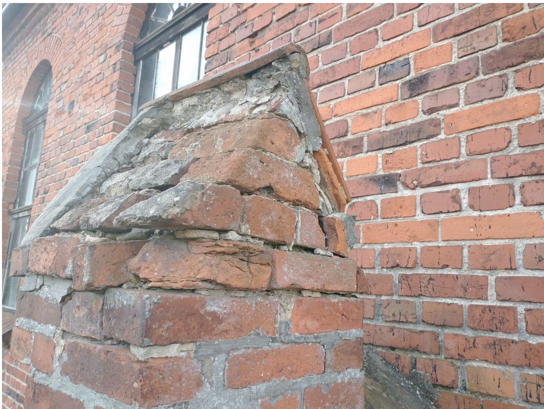
Fot. 14. Zniszczenia występujące na ogrodzeniu – np. ubytki zadaszania słupków.
