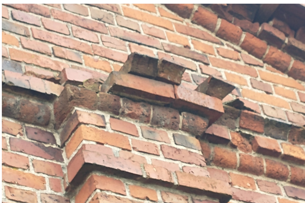
Fot. 2. Ubytki cegły w obrębie pilastra na ścianie frontowej.
