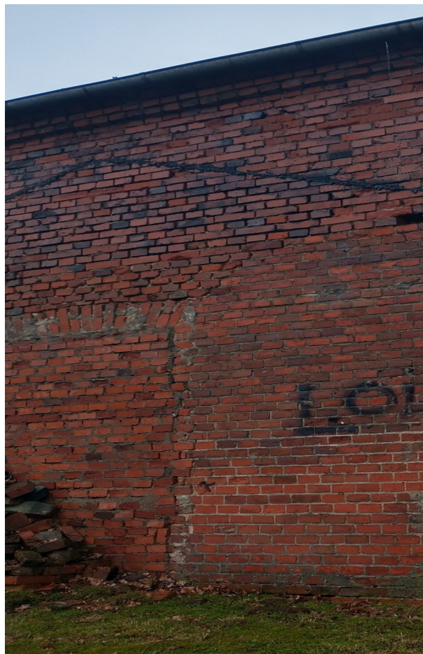
Fot. 9. Widoczny ślad po dobudówce, wtórnych drzwiach i wypłukana spoina w górnej partii ściany.
