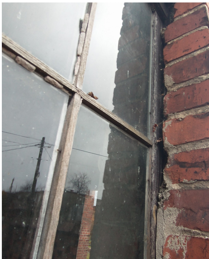
Fot. 6. Ubytki kitu wokół szyb i ram okien.
