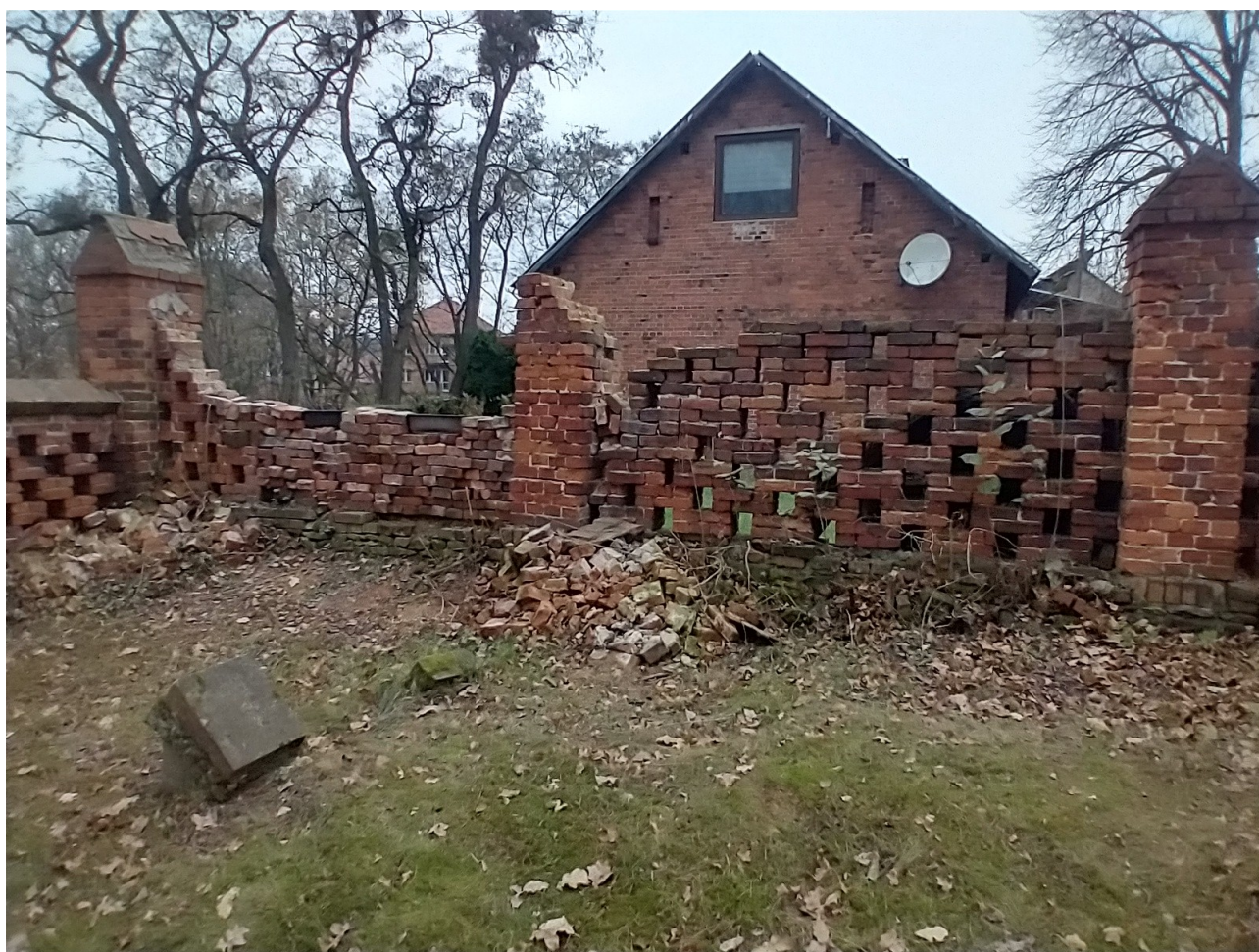
Fot. 12. Wyrwa po upadku drzewa zaplombowana na luzno bez zaprawy.
