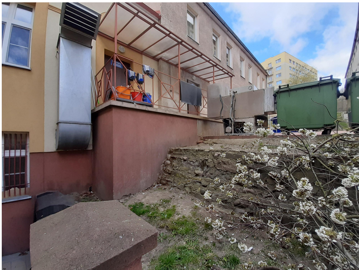
Fot. 24. Rampa przy skrzydle północno- zachodnim- płytki w złym stanie, ubytki tynku cokołowego nad gruntem
