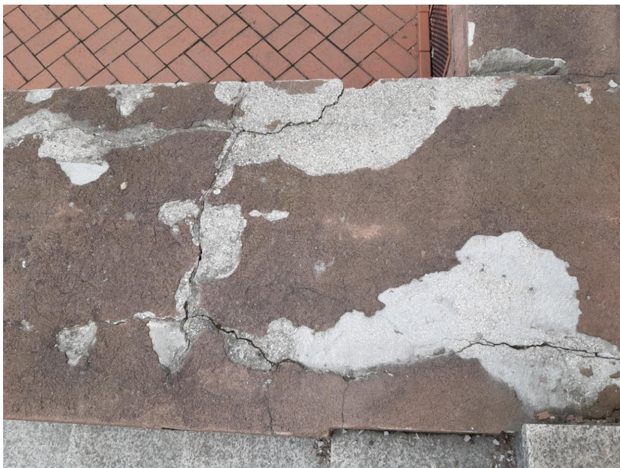
Fot. 7. Czapy lastriko na murkach schodów - znaczne spękania struktury betonowej, tynk cienkowarstwowy całkowicie zdegradowany
