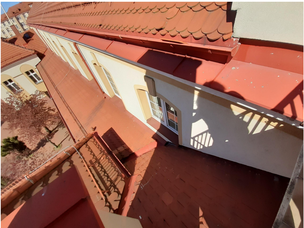
Fot. 12. Pokrycie dachowe z obróbkami - stan ogólny dobry. Podczas remontu i docieplenia ścian nie przełożono pokrycia dachowego na styku z docieplanymi murami, pozostawiając nieestetyczny nawis izolacji nad połaciami.
