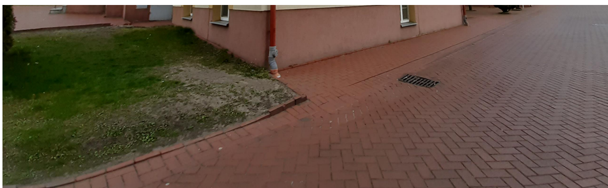
Fot. 17. Obrzeża jezdni. Lokalne zapadnięcia koryta odwadniającego
