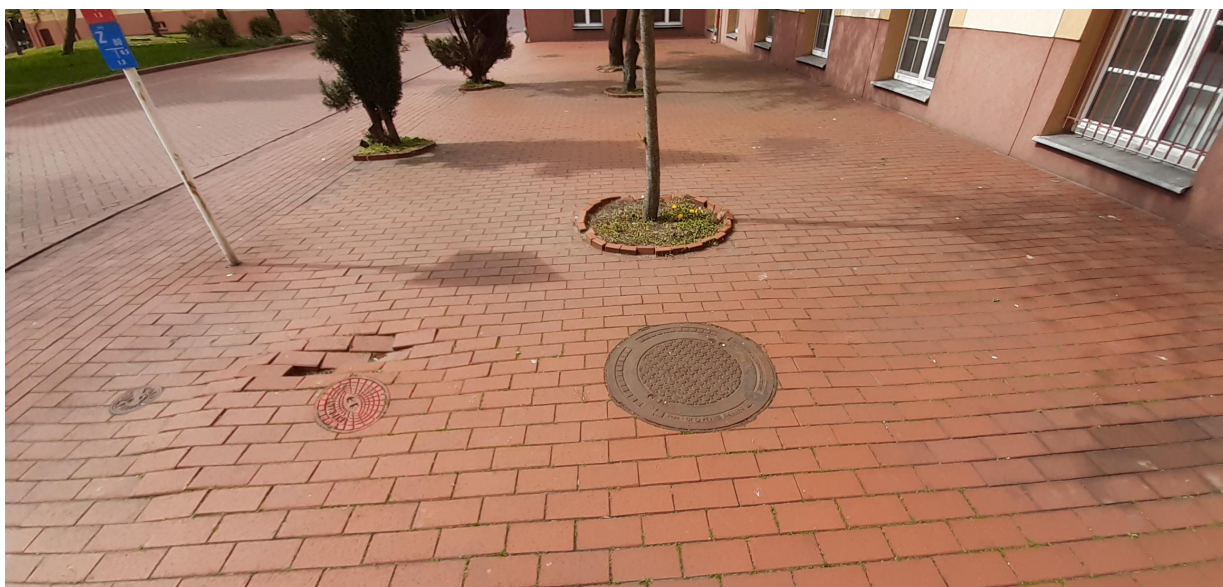
Fot. 16. Nawierzchnie z kostki klinierowej. Miejscowe wypłukanie podbudowy oraz uszkodzone obrzeża nasadzeń.
