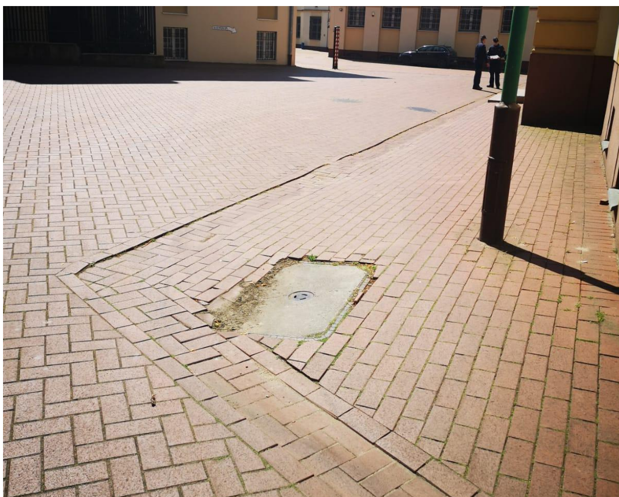
Fot. 21. Nawierzchnie z kostki klinierowej. Koryto odwadniająjące i zapadająca się studzienka
