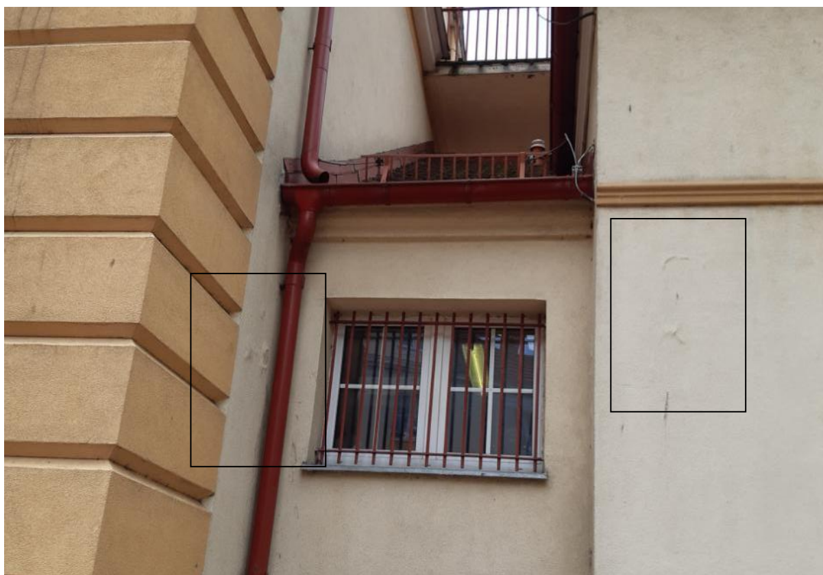
Fot. 19. Tynki cienkowarstwowe- miejscowe wybrzuszenia tynków przy łączniku
