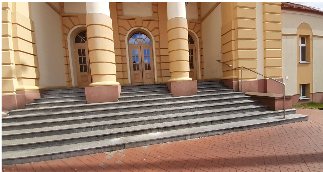
Fot. 6. Schody granitowe - widoczne wykwyty solne i bio-zanieczyszczenia. Ubytki okładziny granitowej stwierdzono na licach 2 pierwszych stopni
