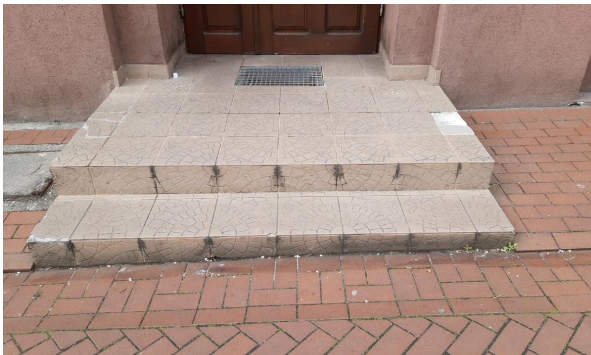
Fot. 20. Nawierzchnia gresowa schodów- spękania i ubytki płytek
