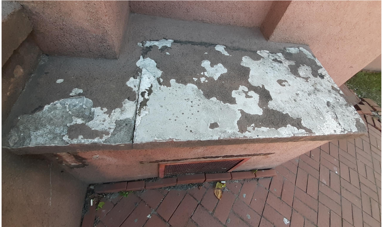
Fot. 8. Szachty wentylacyjne przy schodach - zdegradowane czapy betonowe i tynki cienkowarstwowe, odsłonięte kształtowniki stalowe nad otworami wentylacyjnymi, skorodowane kratki.
