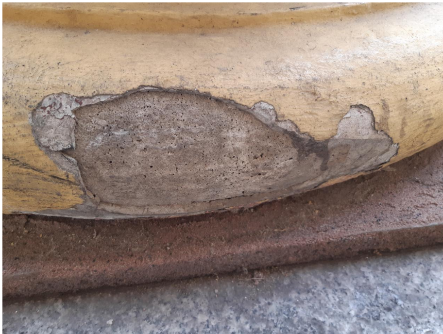
Fot.5. Bazy kolumn – miejscowe ubytki tynków
