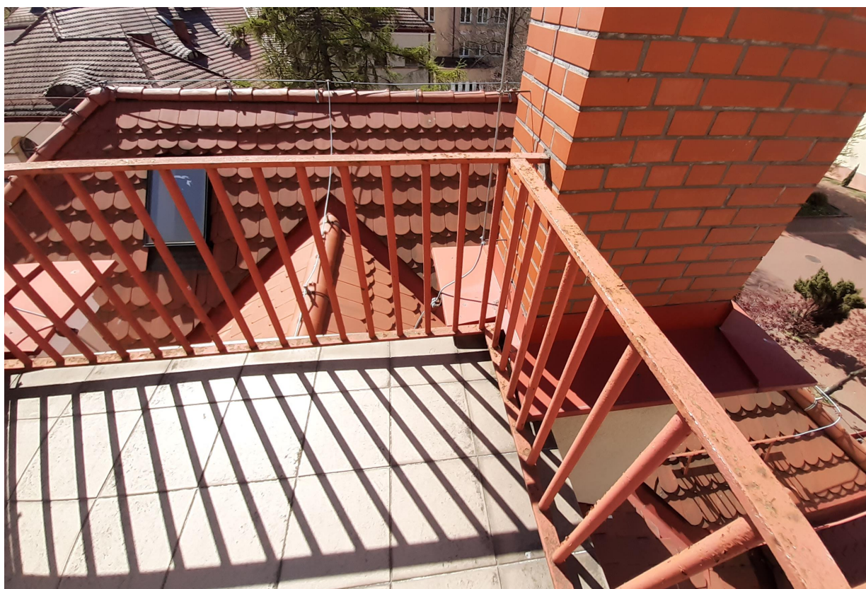
Fot. 14. Ślusarka. Wyraźne ślady korozji.
