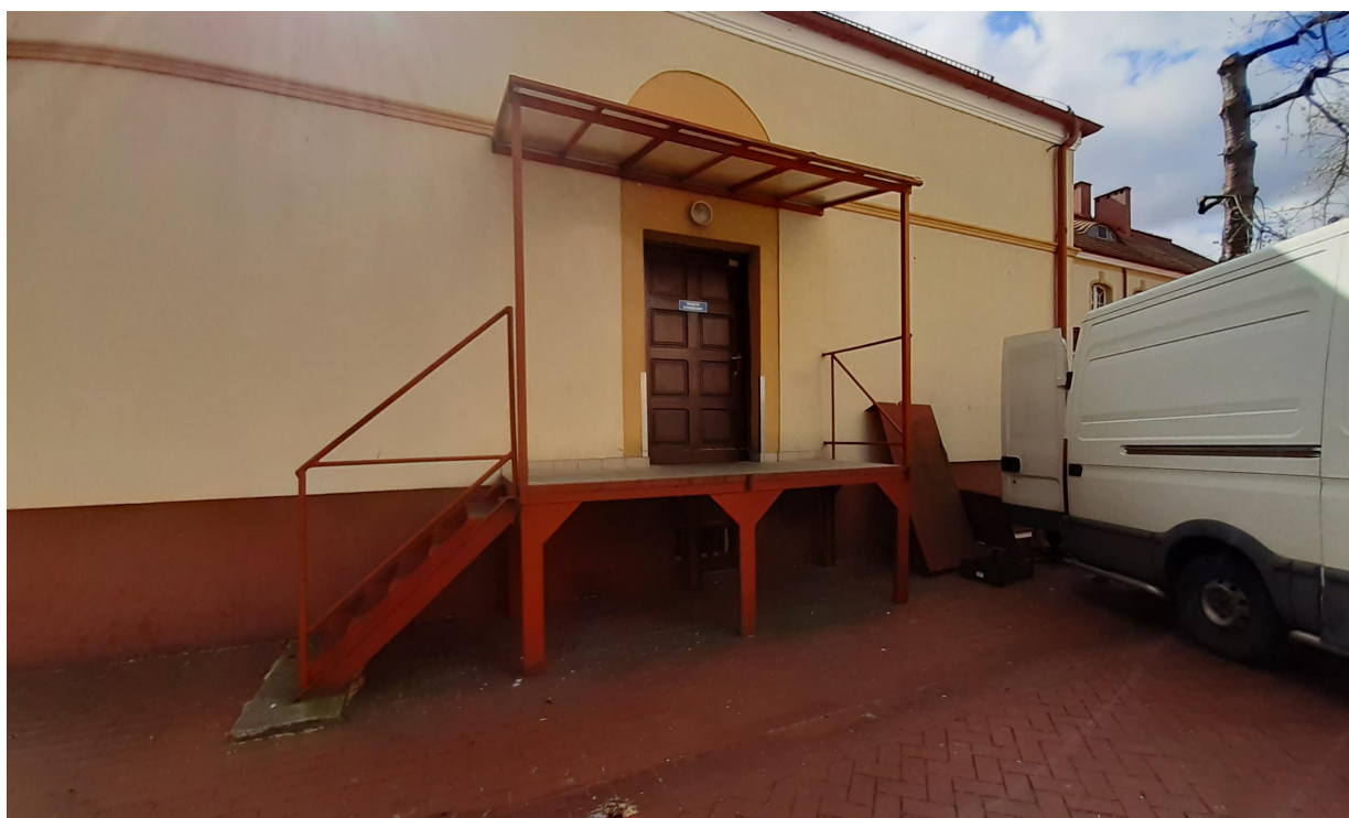
Fot. 25. Schody stalowe przy skrzydle północo-wschodnim - płytki w złym stanie, elementy stalowe ze śladami biokorozji
