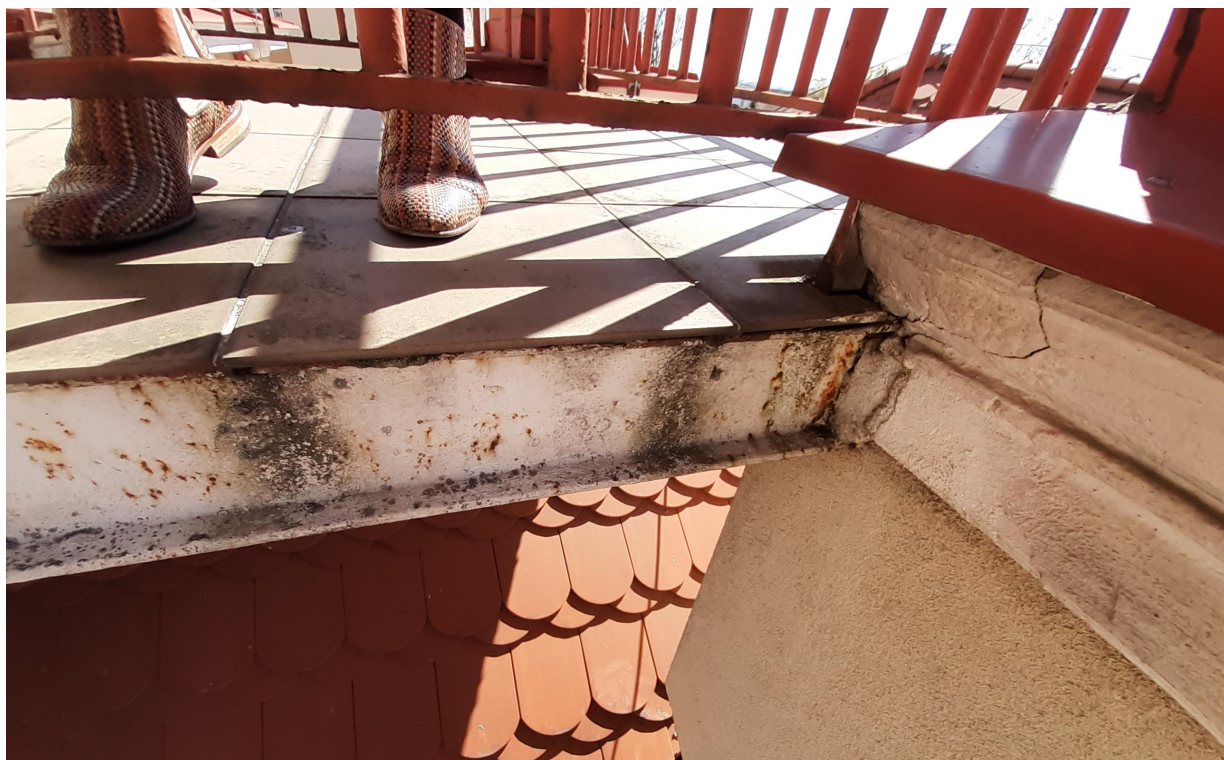
Fot. 13. Balkony. Ślady korozji na elementach konstrukcji płyt balkonowych. Brak obróbek blacharskich krawędzi balkonów. Nieznaczne spękania gzymsów podstaw kominowych, na których oparte są balkony.
