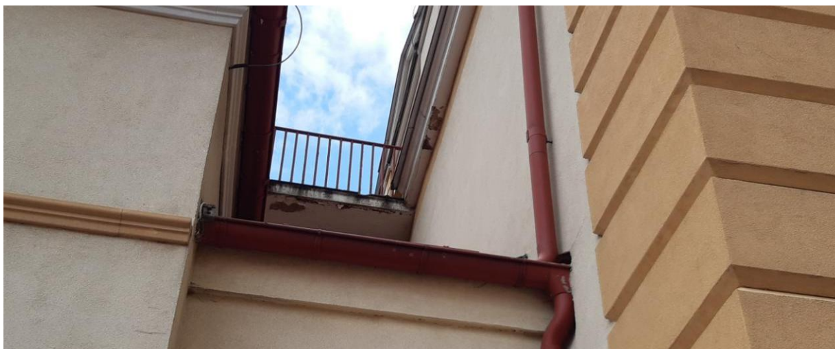
Fot. 15. Widok spodu płyty balkonowej od strony elewacji wschodniej. Łuszczące się powłoki malarskie spowodowane zaciekami wody. Miejscowy ubytek tynku na gzymsie podokapowym.
