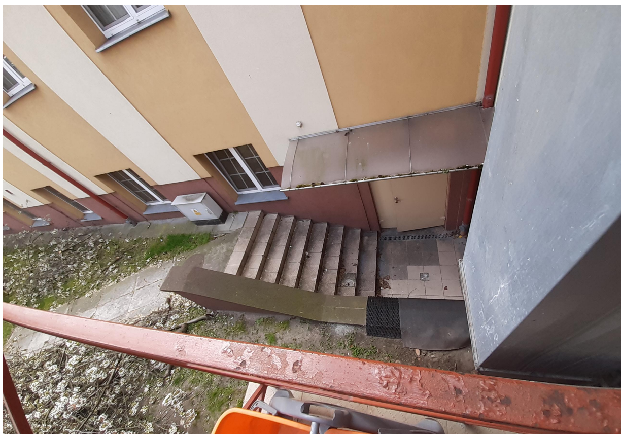
Fot. 23. Schody zaplecza kuchennego - płytki w złym stanie, czapa muru ze śladami biokorozji
