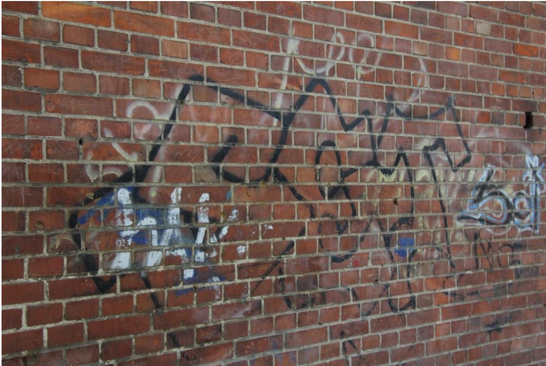
Fot. 58. Elewacja boczna, północna. Przyziemie, grafitti.
