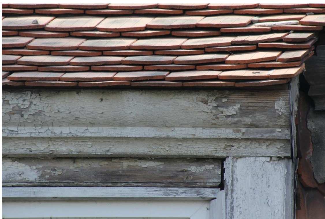
Fot. 12. Elewacja frontowa, wschodnia. Fragment dachu, strona południowa. Fragment oryginalnego drewnianego obramowania okna, widoczne zniszczenia drewna i powłok malarskich.
