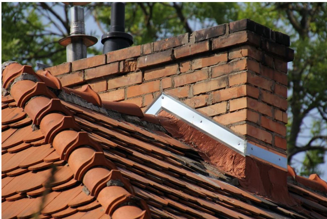
Fot. 19. Elewacja frontowa, wschodnia i południowa, komin – widoczne zniszczenia w cegle i spoinie.
