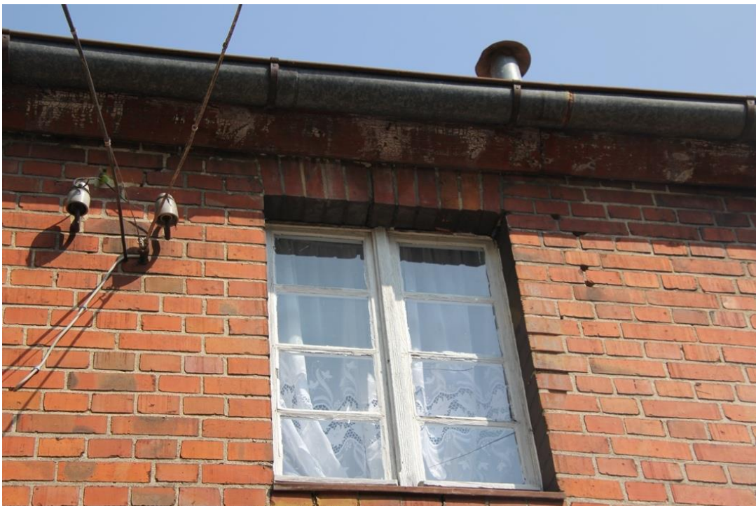
Fot. 22. Elewacja tylna, od podwórza, zachodnia, facjata. Zachowane okno klatki schodowej na I piętrze.
