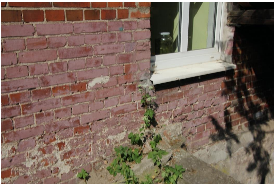
Fot. 63. Elewacja boczna, południowa. Widoczne zniszczenia spieku ceglanego powstałe na skutek pomalowania ściany szczelną powłoką malarską.
