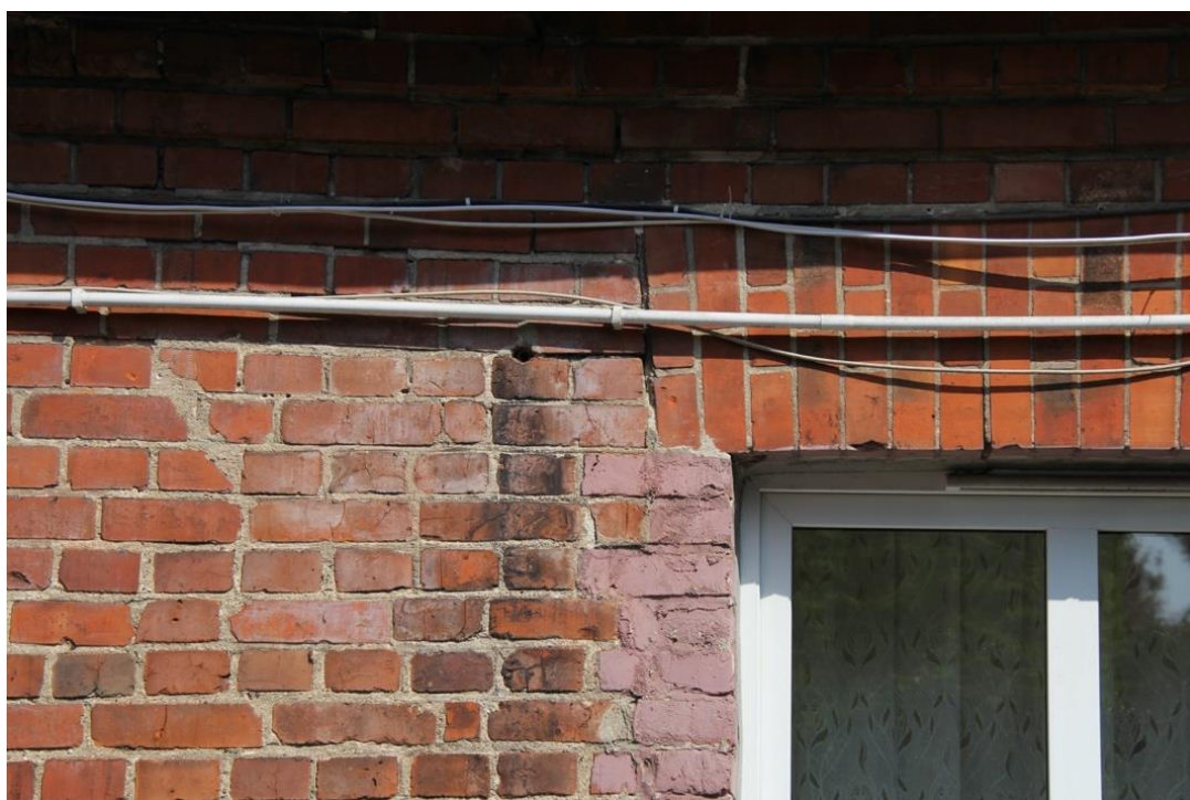
Fot. 32. Elewacja tylna, od podwórza, zachodnia, widoczne wtórne naprawy i przemalowanie cegieł, instalacje teletechniczne.
