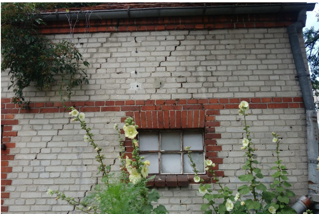
Fot. 85. Pęknięcia na elewacji frontowej
