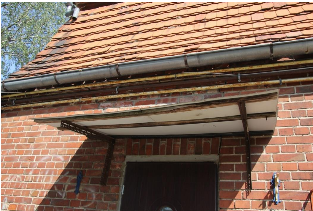
Fot. 30. Elewacja tylna, od podwórza, zachodnia. Wtórne zadaszenie.
