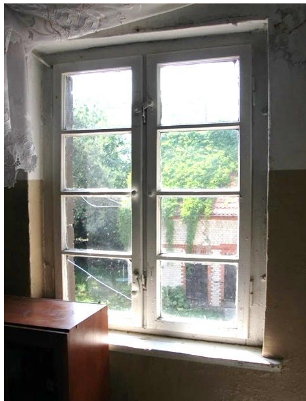
Fot. 77. Okno klatki schodowej na I piętrze.
