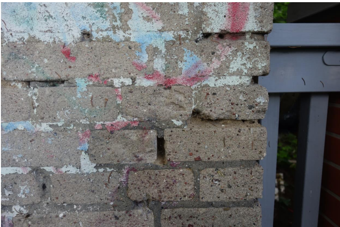
Fot. 90. Przykład zniszczeń cegły silikatowej - wypłukana powierzchnia
