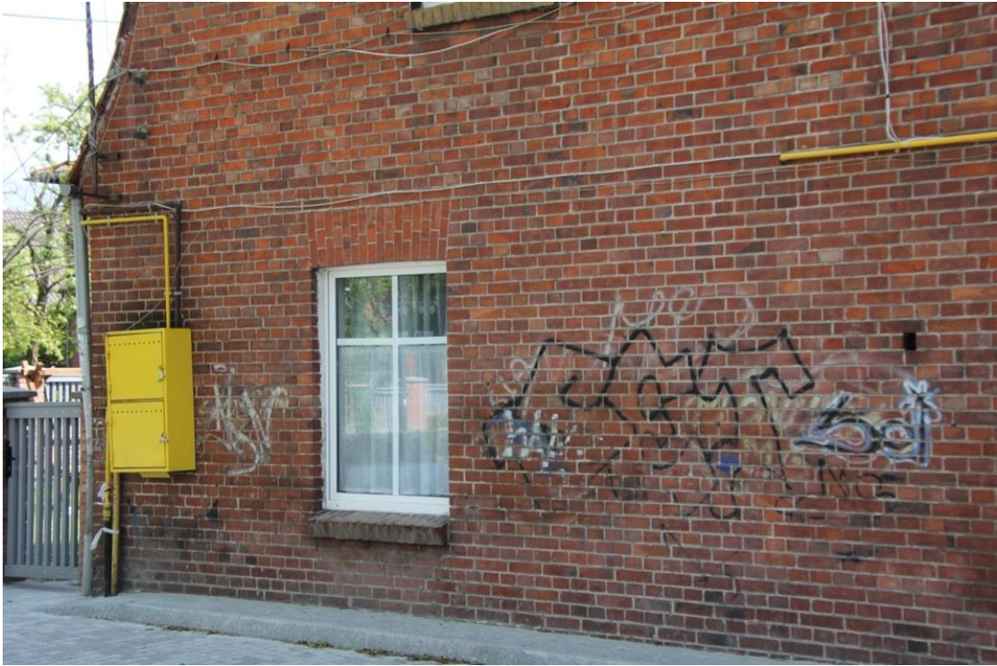
Fot. 53. Elewacja boczna, północna. Przyziemie, widoczne grafitti.
