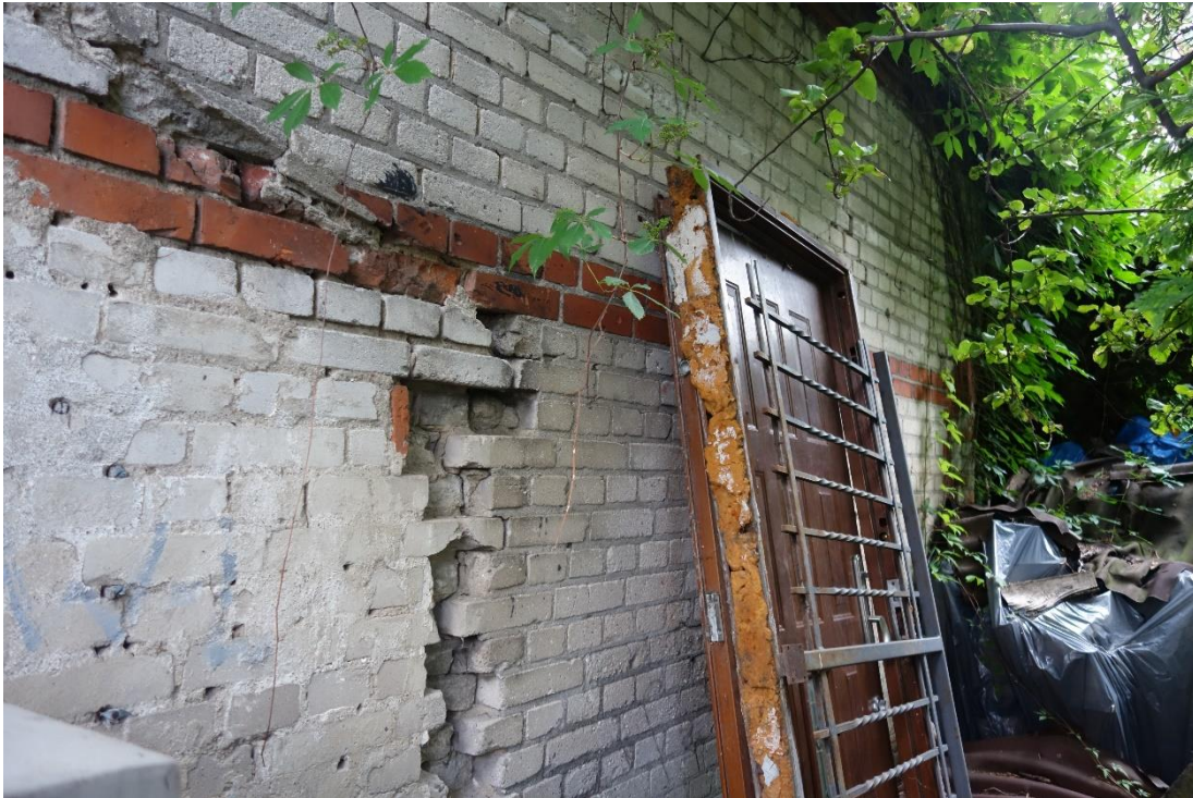
Fot. 89. Elewacja tylna, widoczne zniszczenia muru - pozostałości po przybudówce
