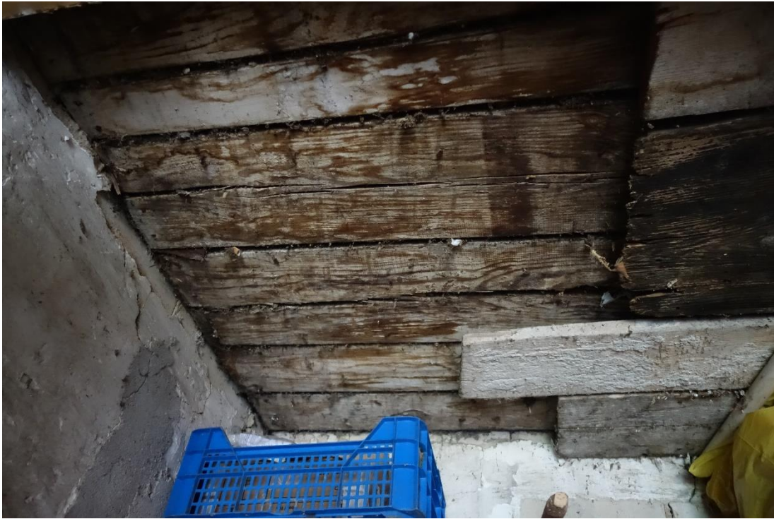
Fot. 102. Fragment stropu nad parterem, podbitka
