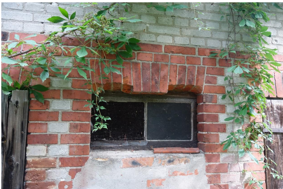
Fot. 92. Zniszczone nadproże w zamurowanym otworze okiennym elewacji południowej
