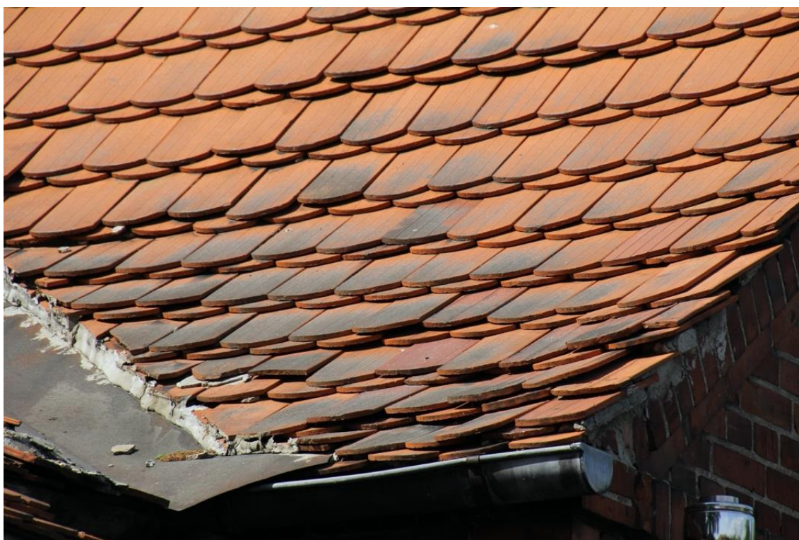
Fot. 20. Elewacja frontowa, wschodnia. Widoczne ubytki w poszyciu dachu.
