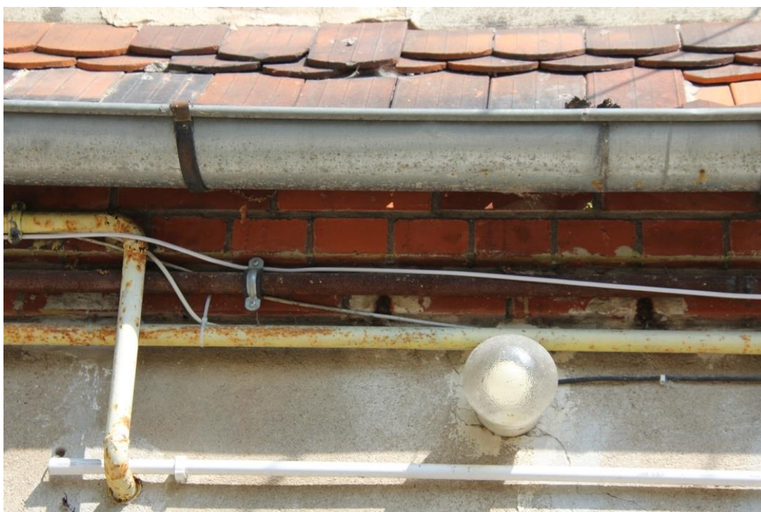
Fot. 48. Elewacja tylna, od podwórza, zachodnia. Wtórne instalacje e i wtórne oświetlenie drzwi wejściowych.
