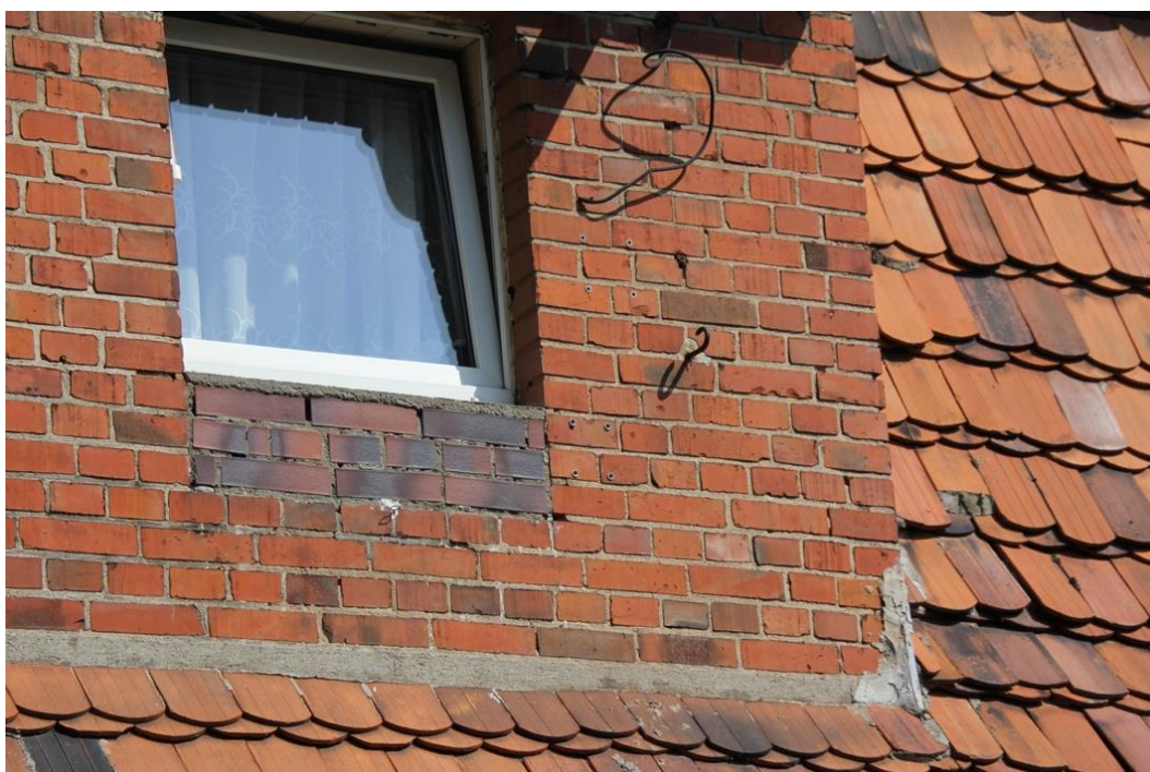
Fot. 38. Elewacja tylna, od podwórza, zachodnia. Prawa strona facjaty, stan zachowania spoiny, widoczne wtórne uzupełnienia, naprawy i zmniejszony otwór okienny.
