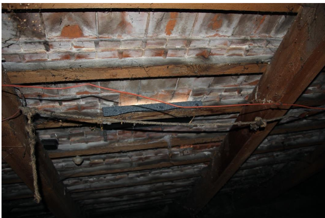
Fot. 65. Wnętrze, strych. Widoczne ubytki w poszyciu dachu.
