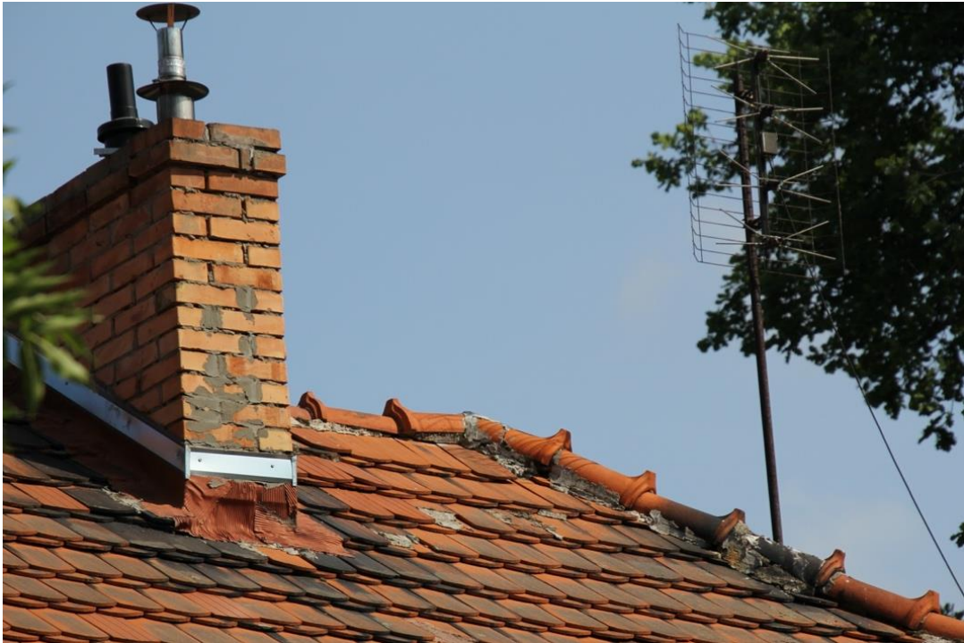
Fot. 43. Elewacja tylna, od podwórza, zachodnia. Widoczny stan zachowania dachu i komina.
