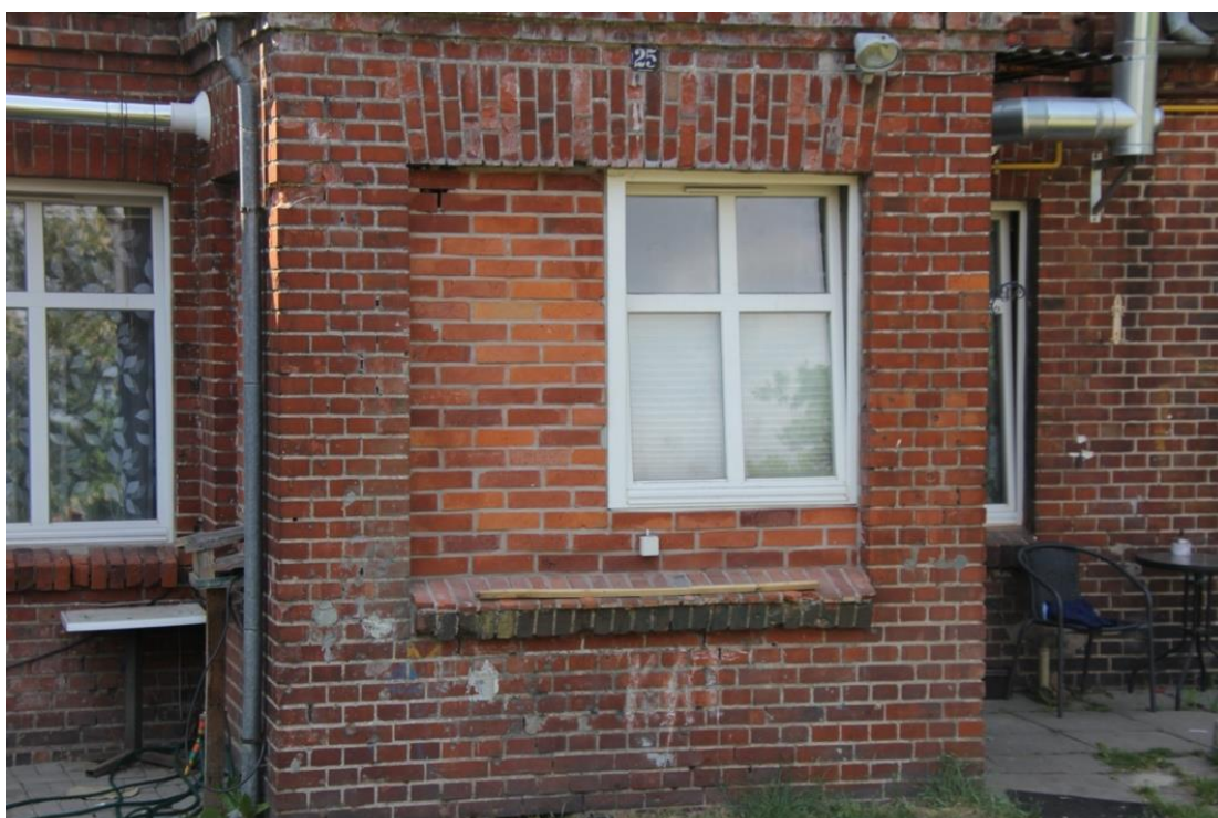
Fot. 8. Elewacja frontowa, wschodnia. Zamurowany otwór okienny ganku i wtórne, współczesne okno.
