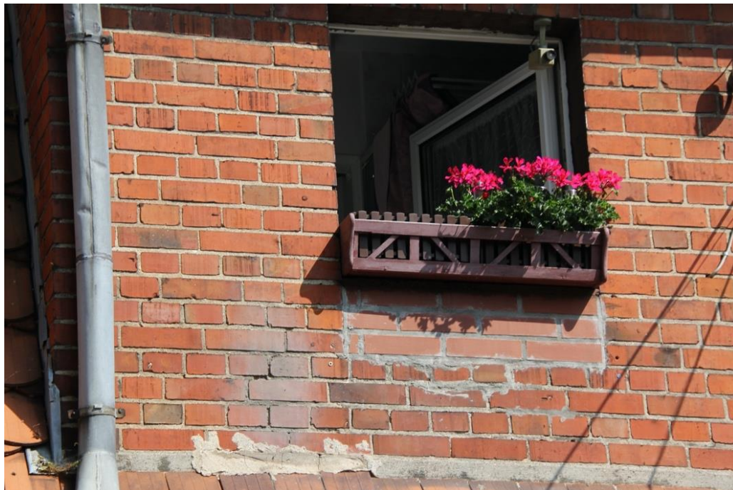
Fot. 26. Elewacja tylna, od podwórza, zachodnia. Fragment facjaty, widoczne wtórne zmniejszenie otworu okiennego.
