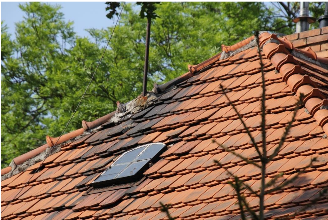
Fot. 18. Elewacja południowa, fragment połaci dachowej. Widoczne wtórne naprawy i zniszczenia pokrycia.
