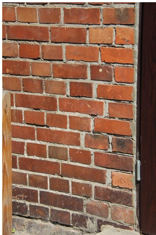
Fot. 37. Elewacja tylna, od podwórza, zachodnia. Stan zachowania spoiny, widoczne wtórne uzupełnienia.
