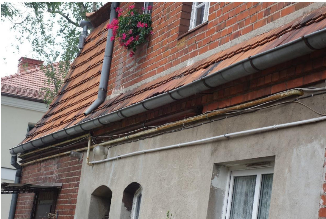
Fot. 42. Elewacja tylna, od podwórza, zachodnia, fragment., widoczne instalacje.
