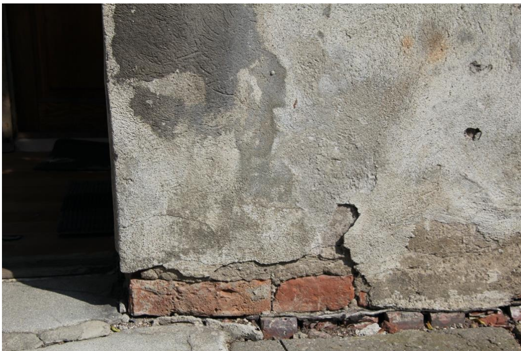
Fot. 36. Elewacja tylna, od podwórza, zachodnia. Fragment ściany otynkowanej, widoczna w ubytku tynku oryginalna ściana ceglana.
