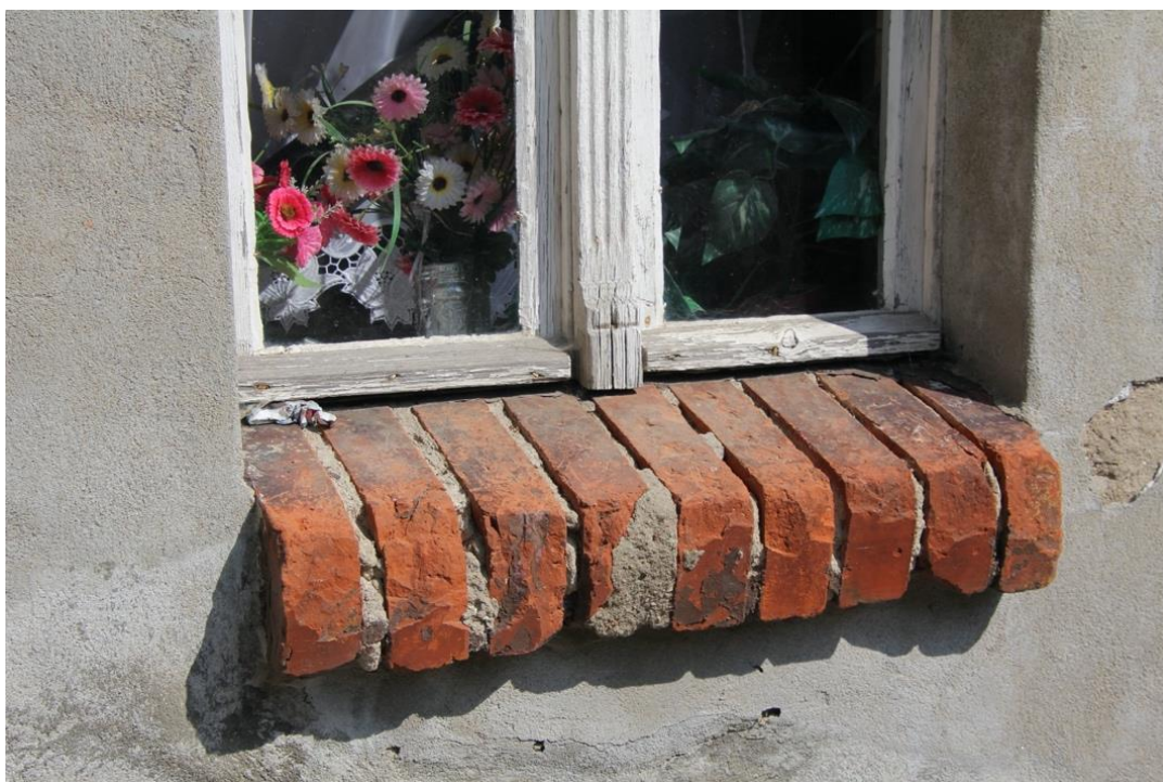
Fot. 34. Elewacja tylna, od podwórza, zachodnia. Parapet okna klatki schodowej. Zniszczenia w cegle i w spoinie.
