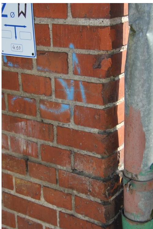
Fot. 57. Elewacja boczna, północna. Stan zachowania rury spustowej i spoiny murze ceglanym.
