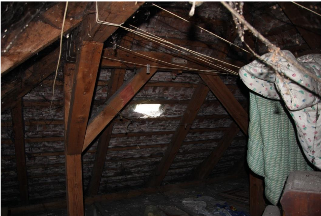
Fot. 67. Wnętrze, strych. Widoczne ubytki w poszyciu dachu..
