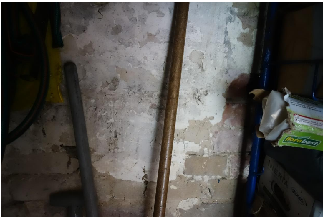
Fot. 100. Przykład zniszczeń tynków wewnętrznych
