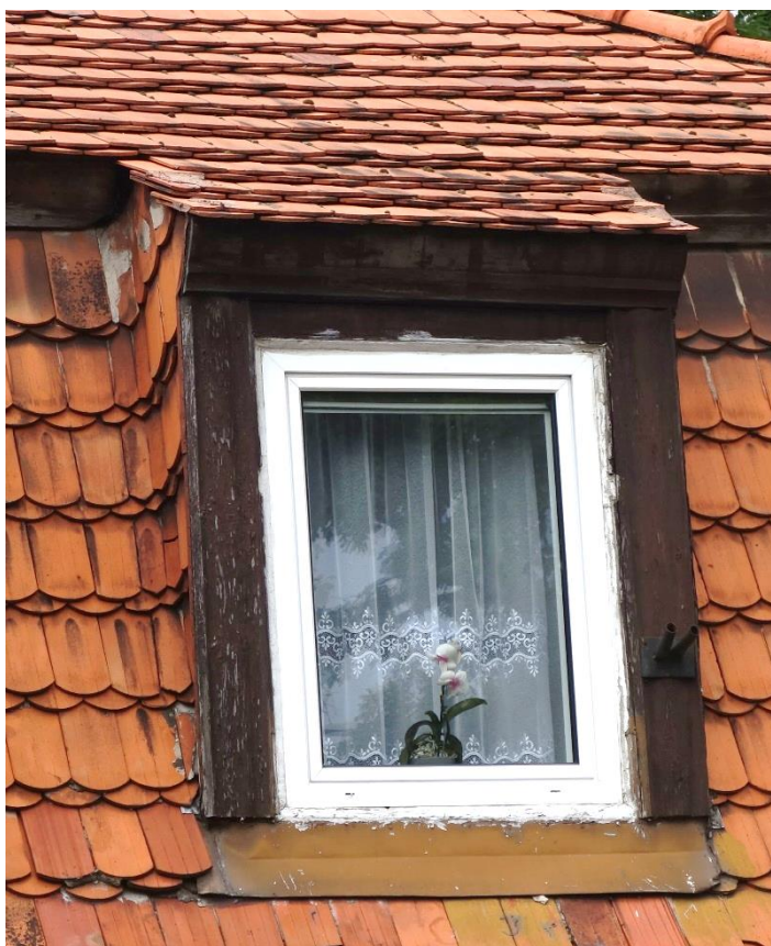
Fot. 11. Elewacja frontowa, wschodnia. Fragment dachu, strona północna. Wtórna stolarka okienna wmontowana w oryginalne drewniane obramowanie.
