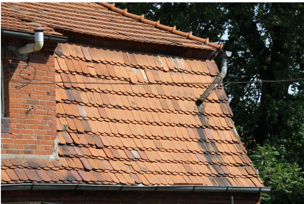
Fot. 44. Elewacja tylna, od podwórza, zachodnia. Widoczne ubytki w poszyciu dachu.
