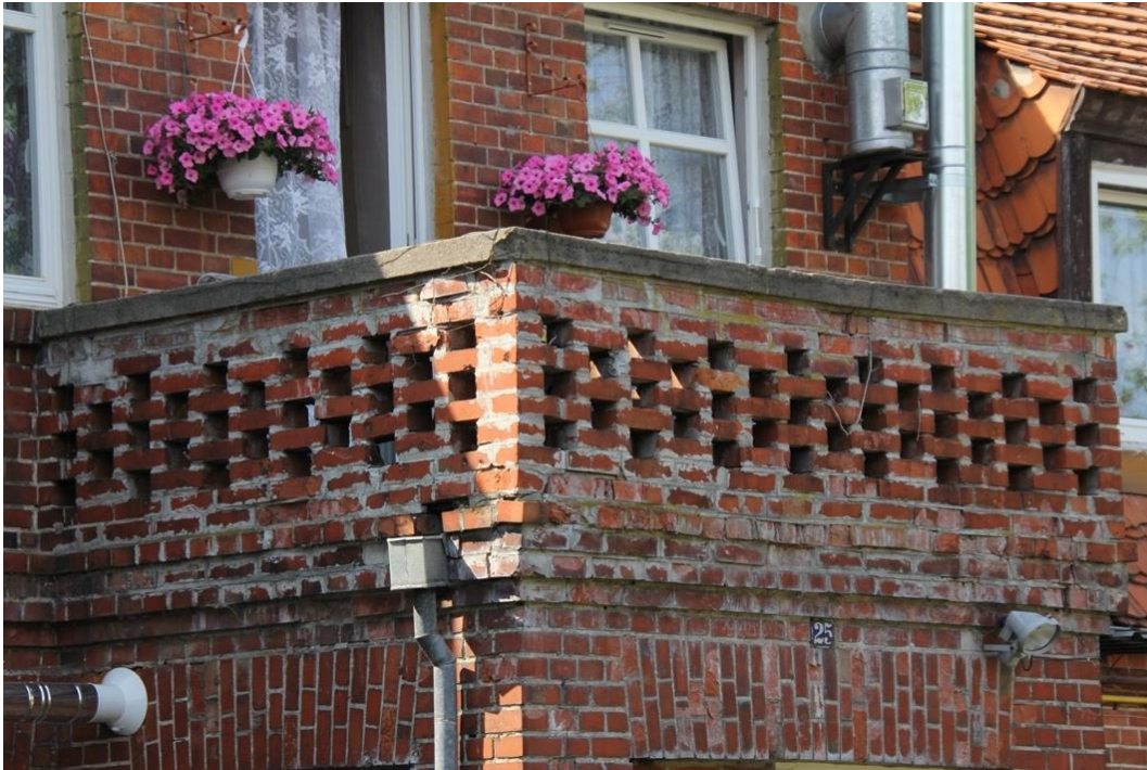
Fot. 5. Elewacja frontowa, wschodnia. Balkon – widoczne wtórne naprawy i przemurowania.
