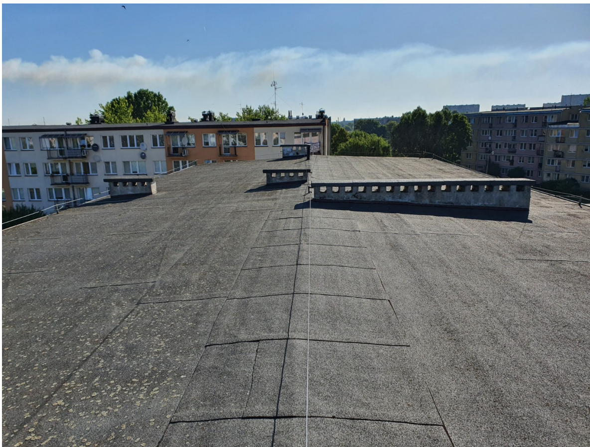
Zdj.4 . Pokrycie dachu z papy – widocznie zagrzybienie papy dachowej na połaci północnej
