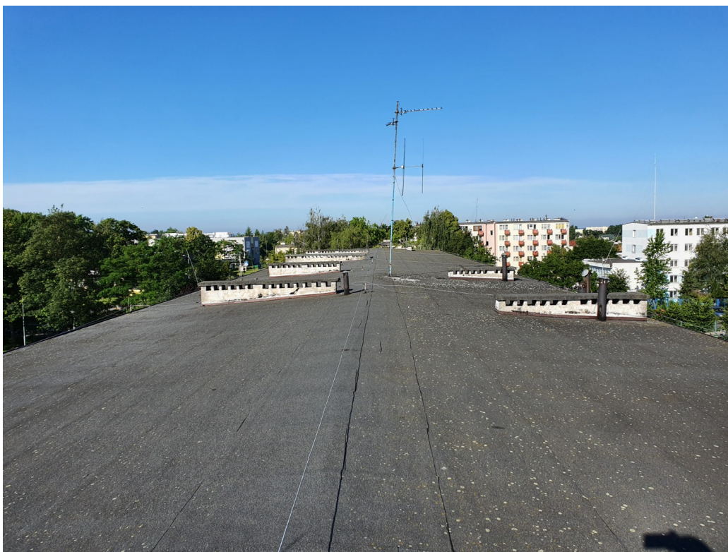
Zdj.3 . Pokrycie dachu z papy – widocznie zagrzybienie papy dachowej na połaci północnej
