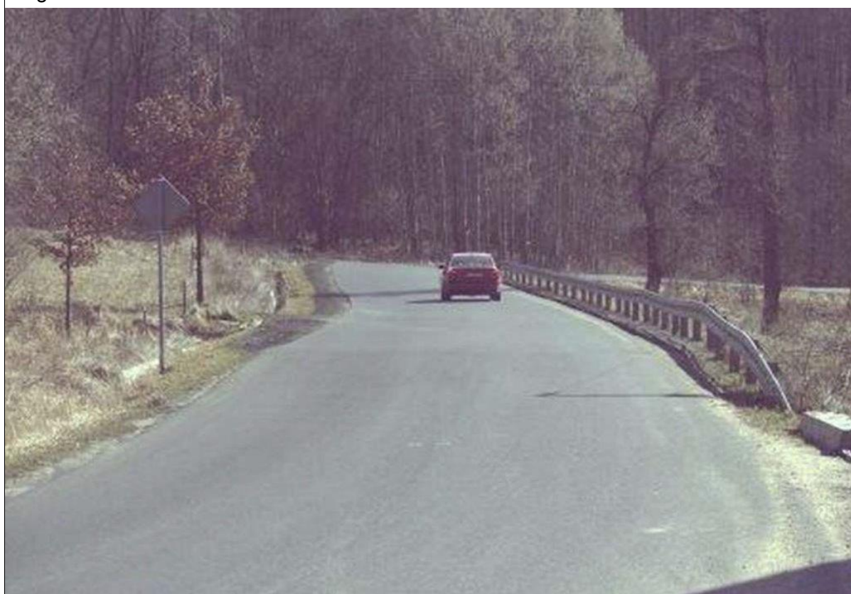
Niszczony przez osuwisko fragment drogi powiatowej.
