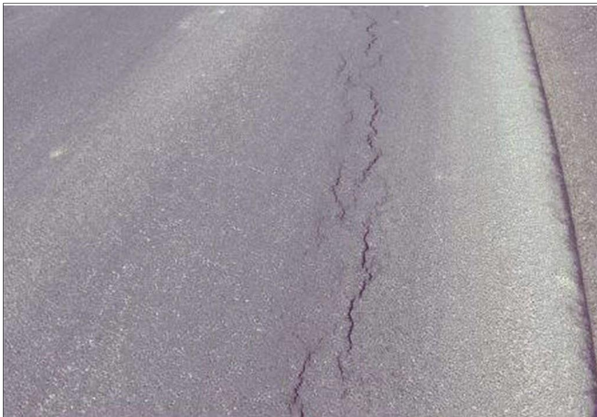
Świeże pęknięcia w jezdni.
