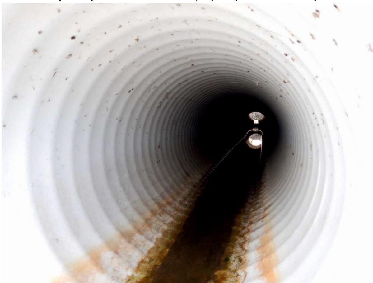
Ugięcie rury przepustu pod jezdnią.
