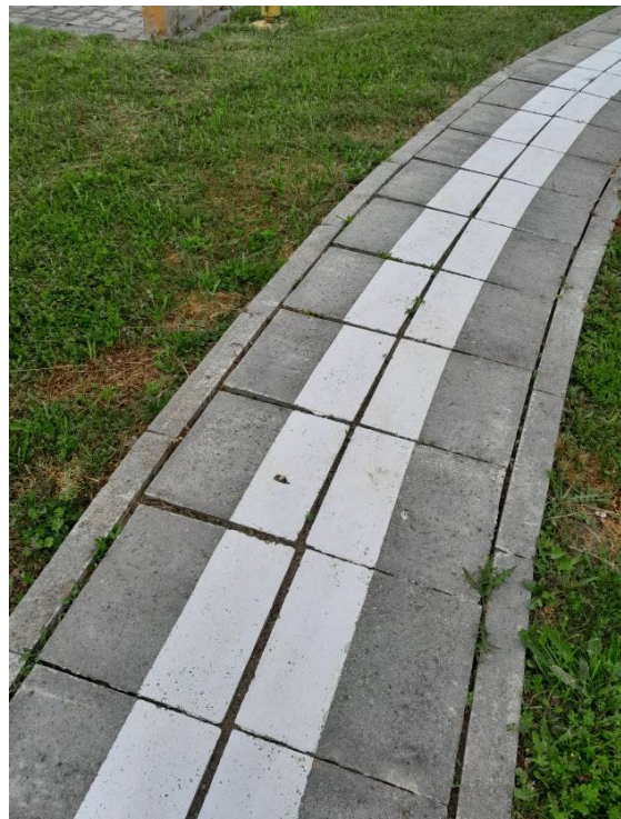
Zdj. 4. Brak wypełnienia szczelin między płytami opaski
