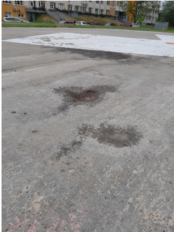
Zdj. 2. Złuszczenia płyty betonowej
