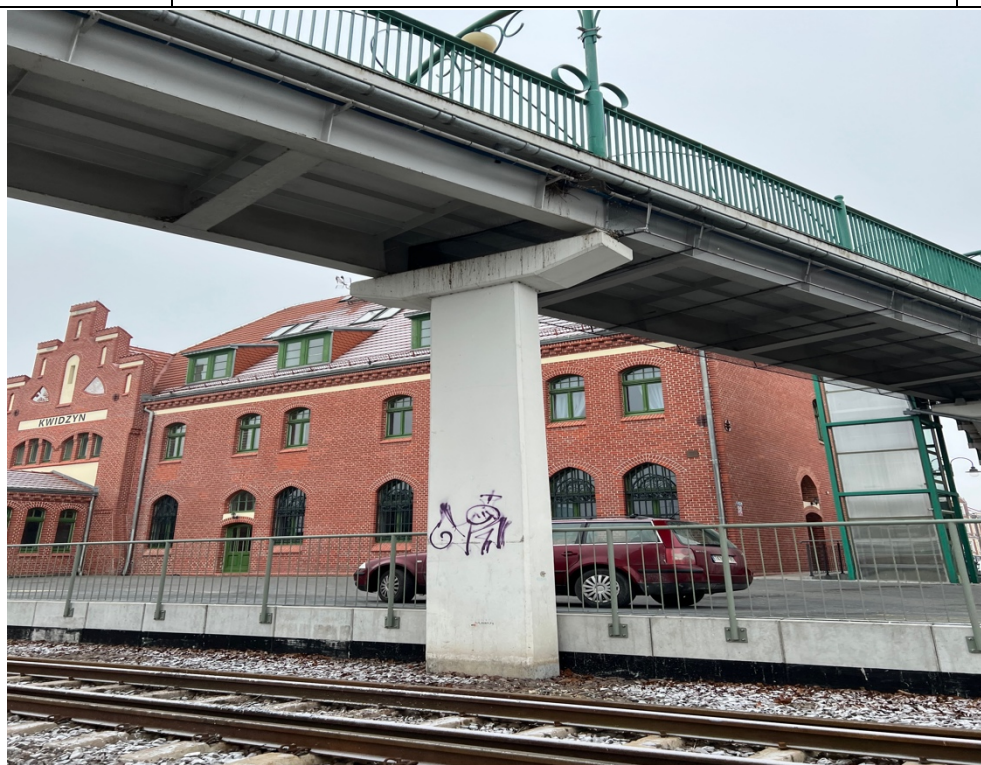
Fot. 3. Typowy filar. Uszkodzenia powłok malarskich, graffiti, zacieki odchodami ptasimi, wegetacja mchów.
