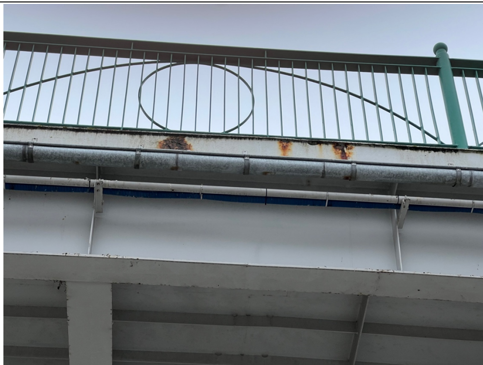
Fot. 4. Balustrada, belka podporeczowa. Widoczne ślady korozji wżerowej oraz uszkodzenia powłok malarskich.
