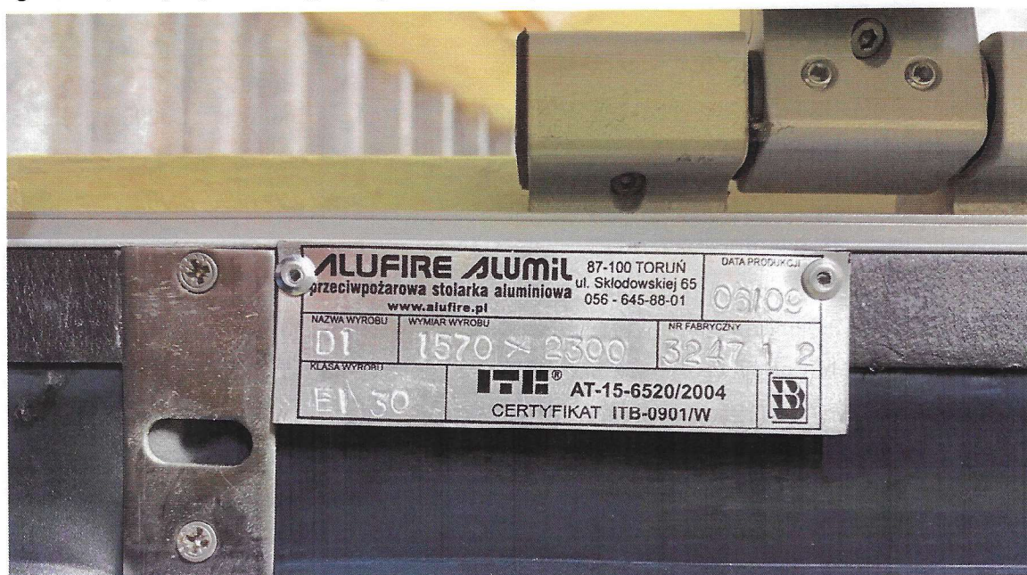
Fot.1. Przykład oznaczenia drzwi zainstalowanych w klatce schodowej BK2. Widoczne:
