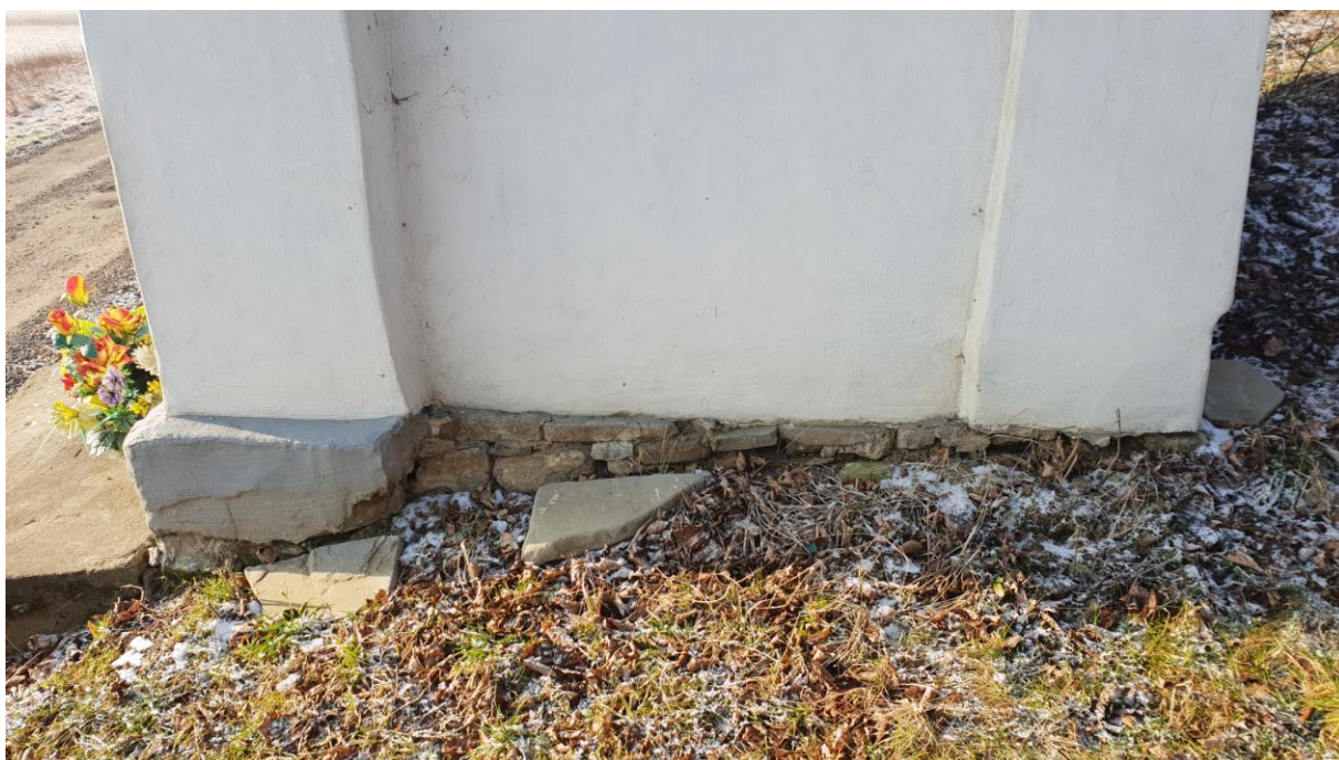
Fot.5Kapliczka w Niskowej-fragment ściany wschodniej. Stan –luty2021
