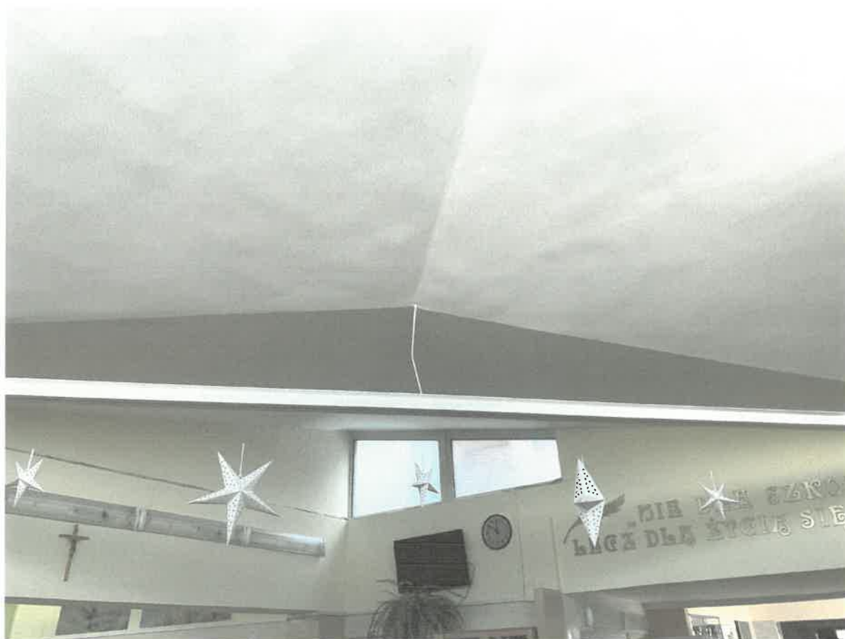
Zdj.1 – Ugięcie wieszaka widoczne na korytarzu szkoły
