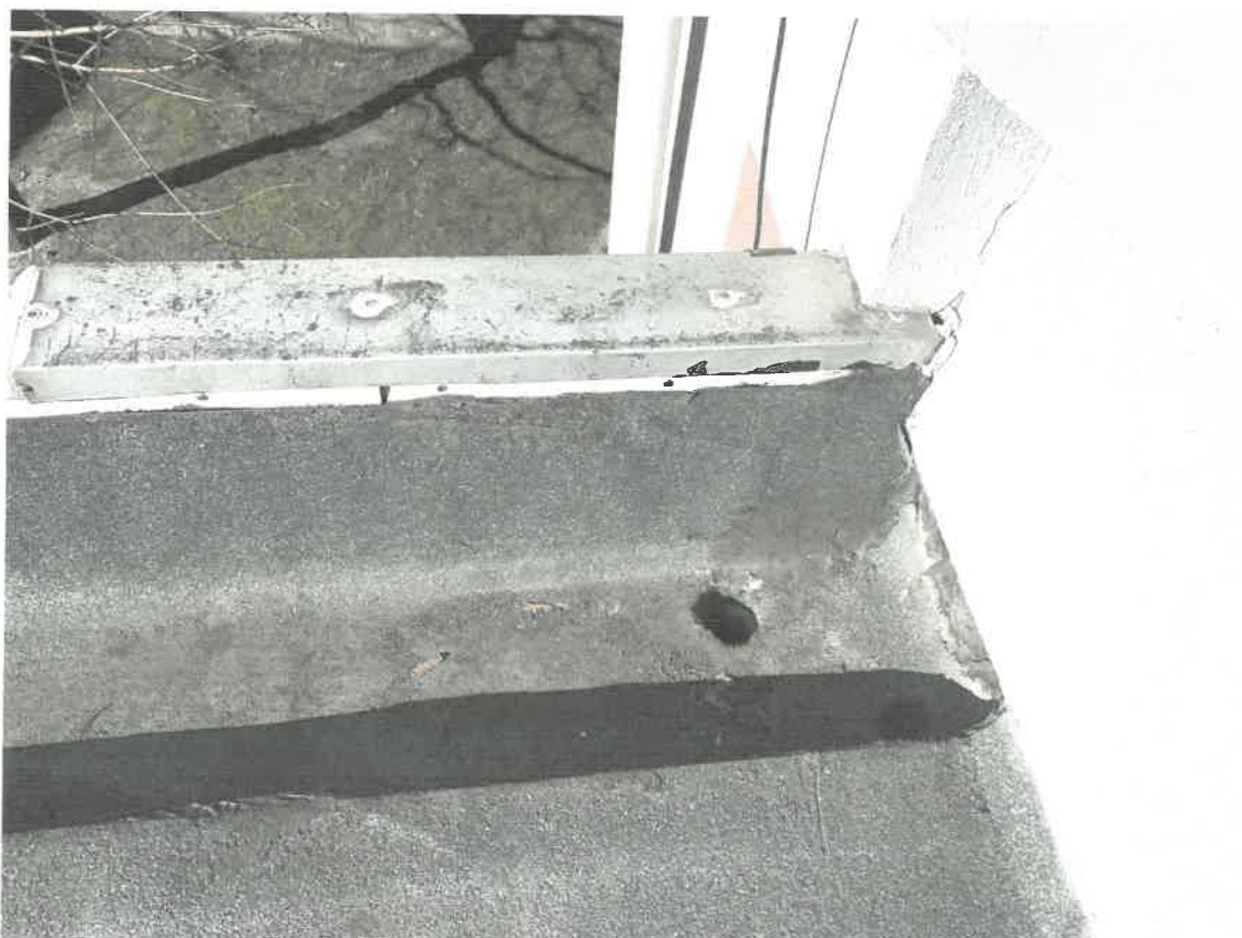
Zdj.13 . Poszerzyć otwór wykonując nowe odprowadzenie wody, zamontować kosz zabezpieczający od liści i nieczystości. Ukształtować spadek koryt a nową warstwę papy wywinąć pod obróbkę (czapkę z blachy)
