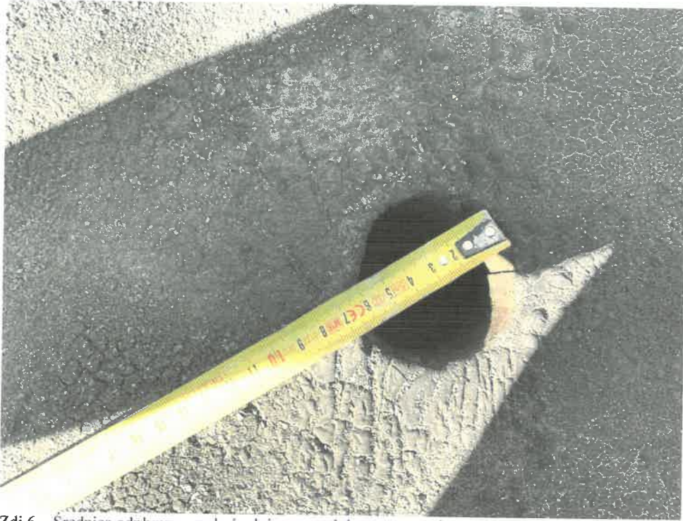
Zdj.6 – Średnica odpływu – mała średnica powoduje zator co uniemożliwia dbiór wody z dużej powierzchni
