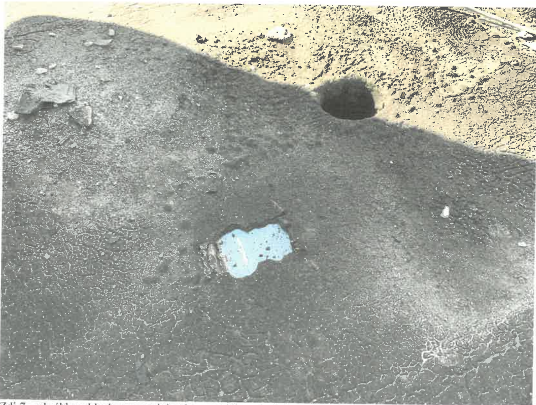
Zdj.7 – obróbka z blachy przy odpływie – zmniejsza średnicę odpływu
