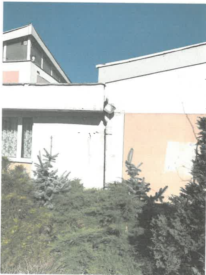
Zdj.11 . Uszkodzone sztucery - wymiany
