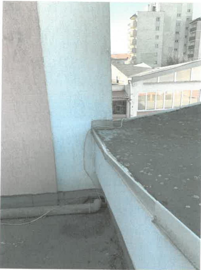
Zdj.10 . Mała średnica odpływu oraz uszkodzone obróbki dachu do wymiany
