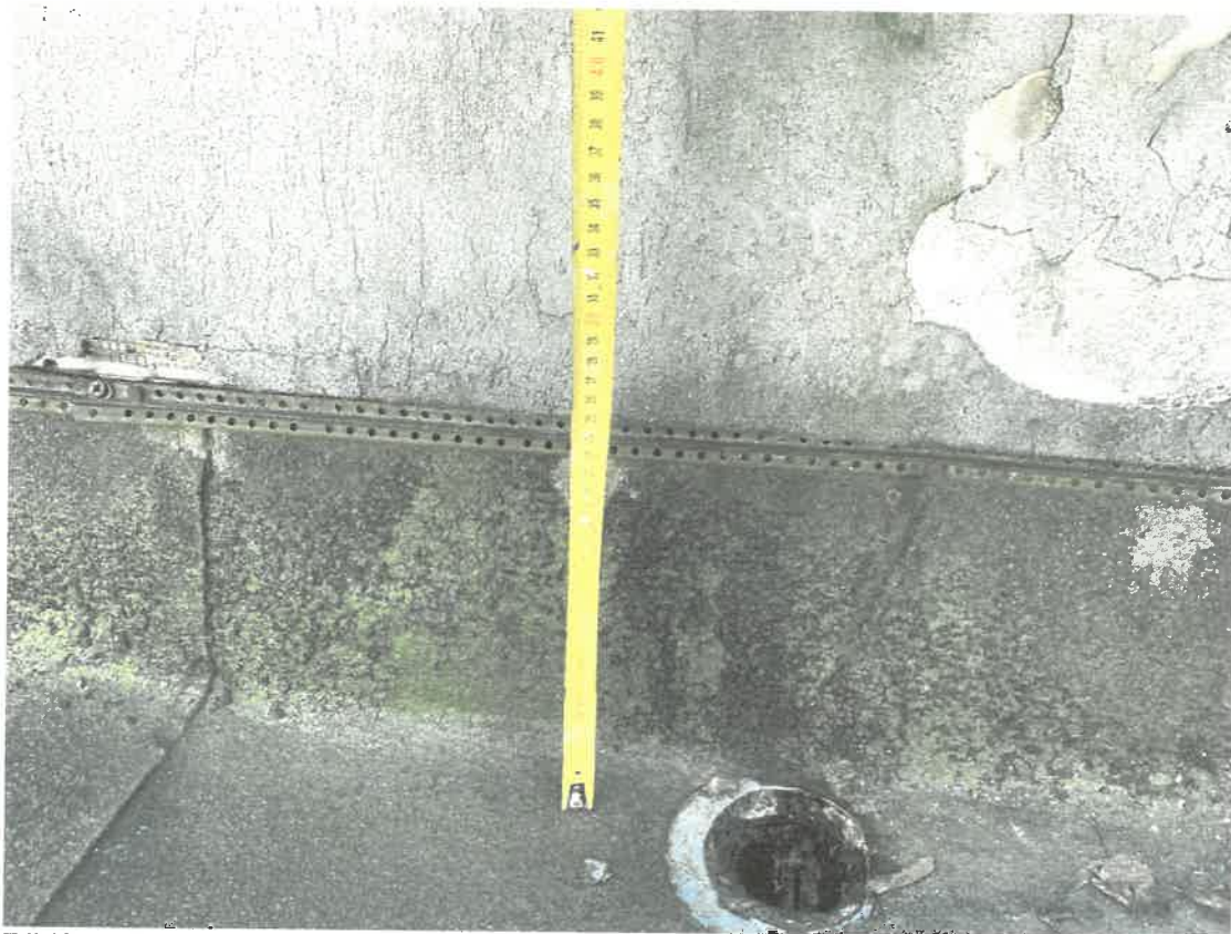
Zdj.12 . Nisko wywinięta papa na ścianę, należy zgrzać papę na wysokość ok 50cm na ścianę stosując dodatkowo uszczelniacz i obróbkę Poszerzyć otwór odprowadzenia wody, zamontować kosz zabezpieczający od liści i nieczystości
