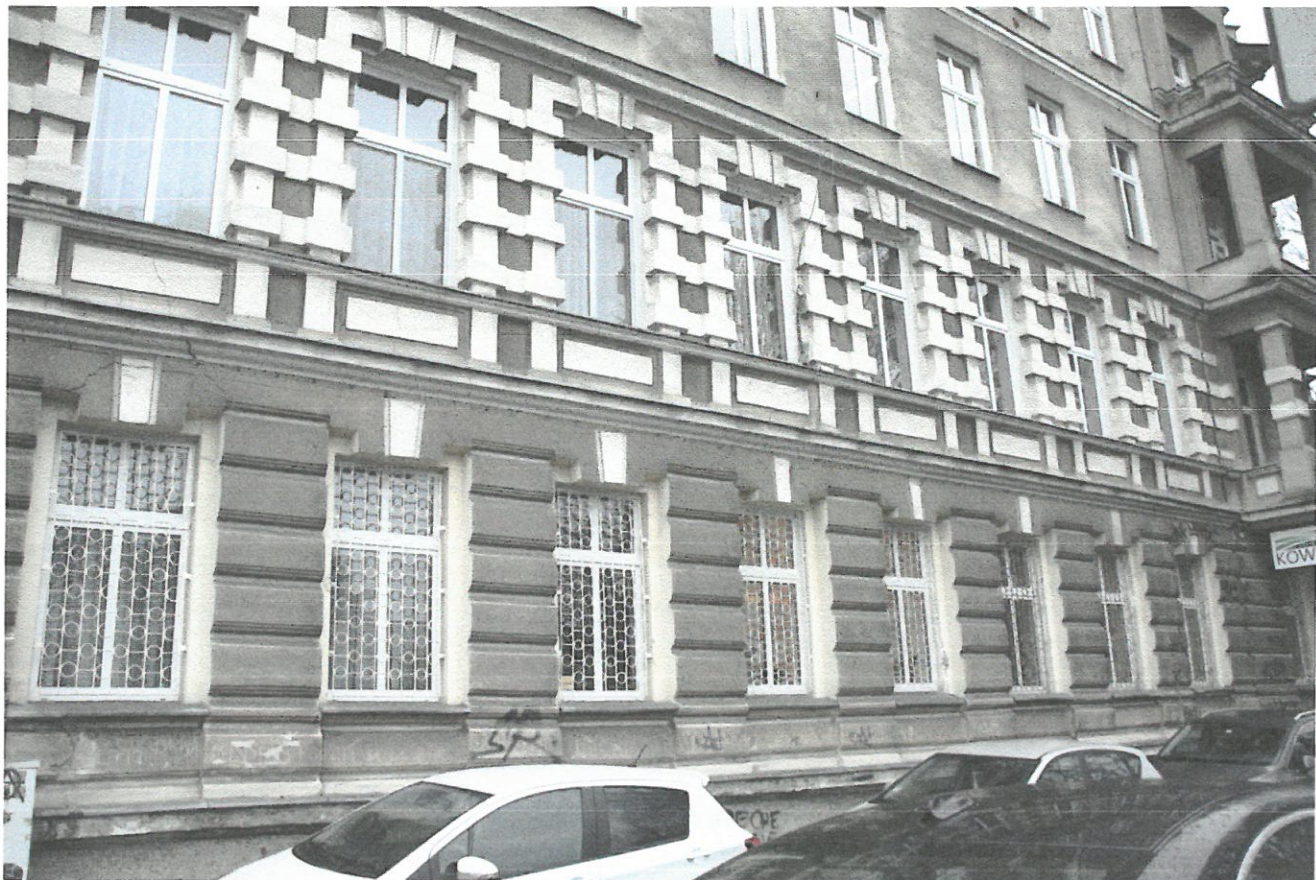
Elewacja frontowa od strony ul. Żubrów – widoczne zarysowania.
