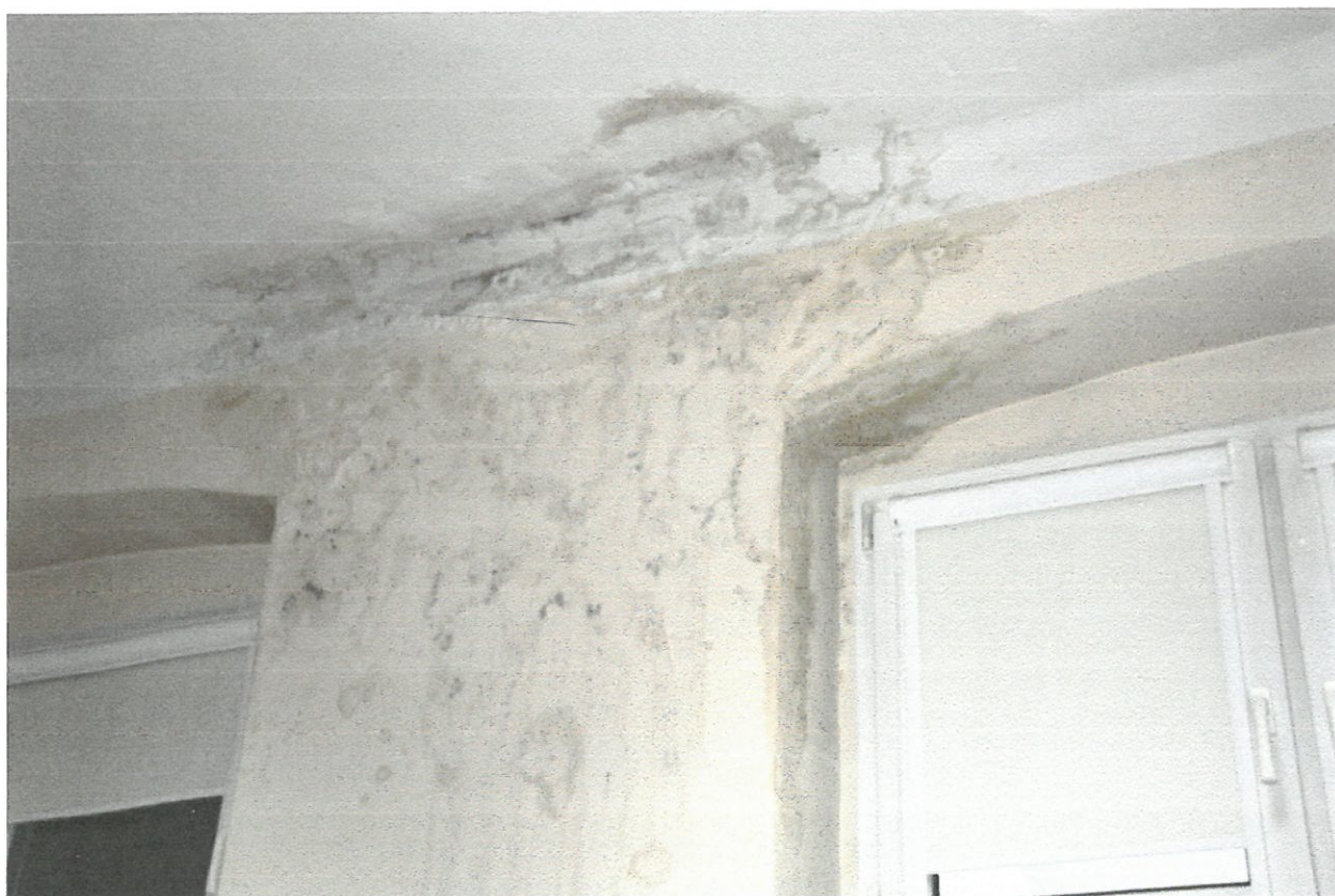
Widoczny zaciek wewnątrz budynku spowodowany nieprawidłowo wykonanym opierzeniem płyty balkonowej.
