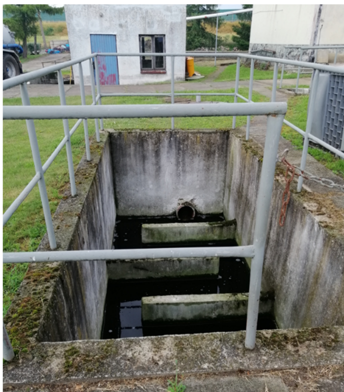
Fot.6 Komora pomiarowa i komora kontaktowa
