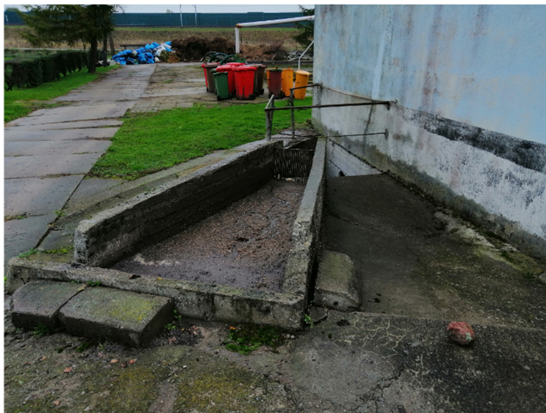
Fot.2. Punkt wlewny ścieków dowożonych
