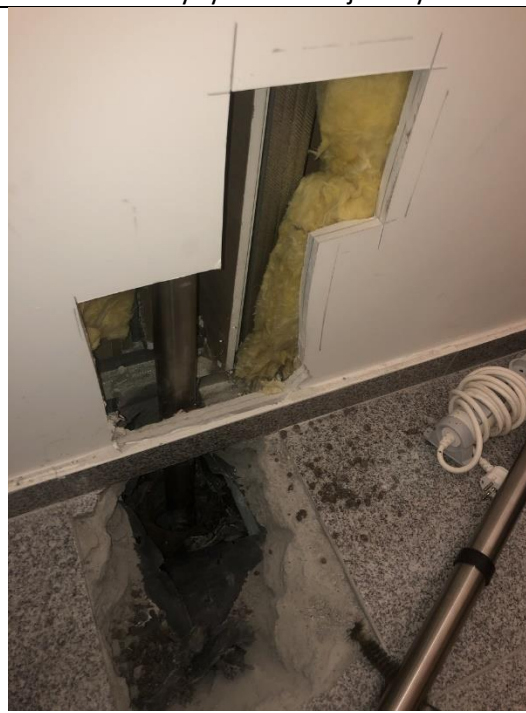
Fot. 7. Odkrywka obrazująca zalanie w pom. 0.19
