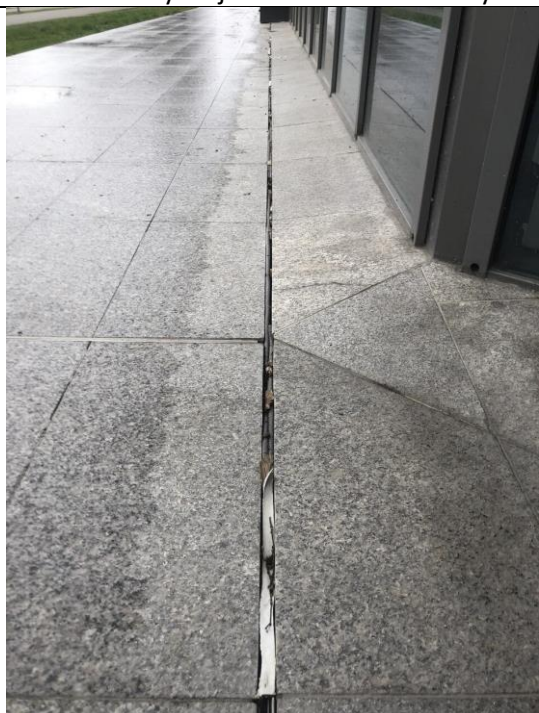
Fot. 6. Widoczne wybrakowania dylatacji
