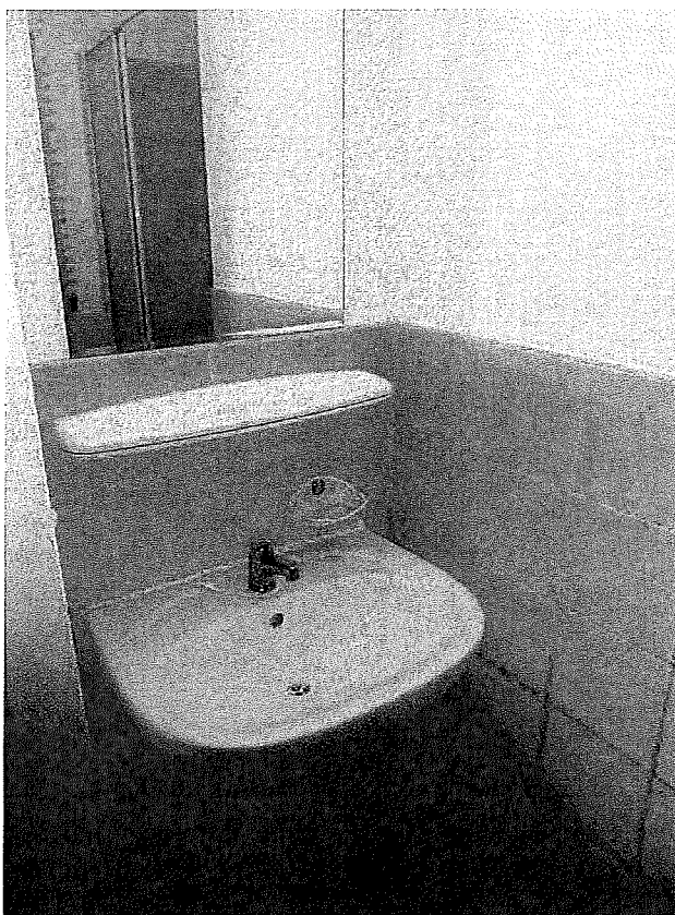
Fot. 2. Stan istniejący – widok na umywalkę
