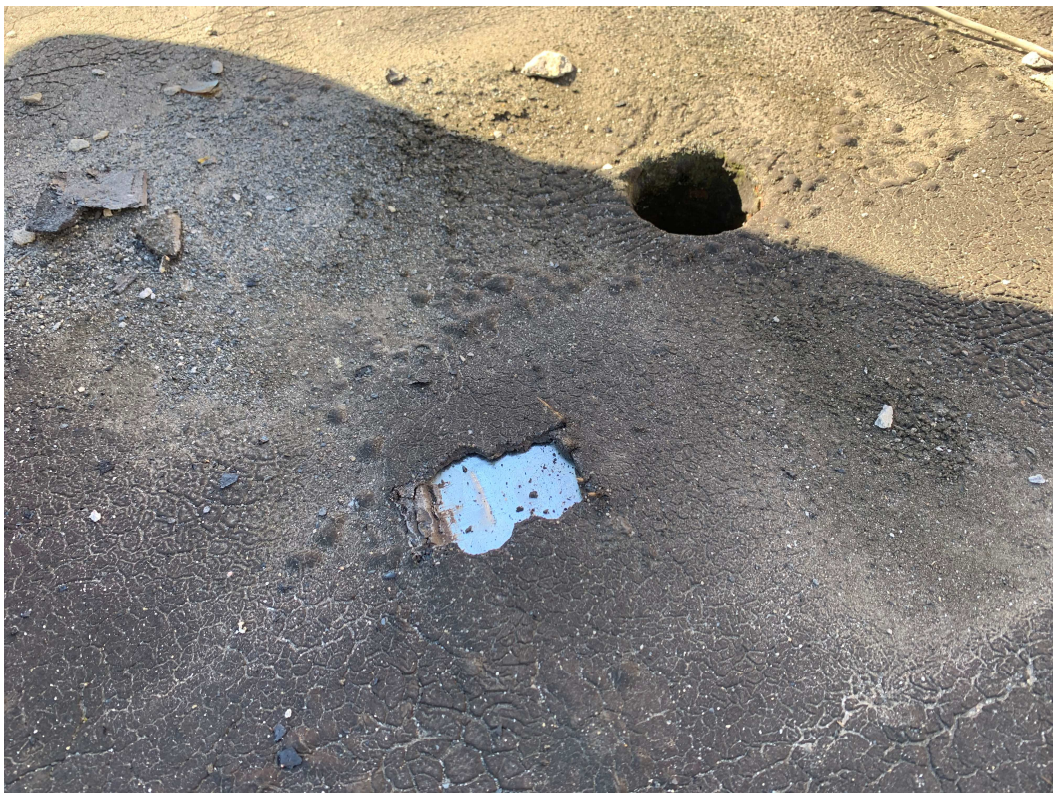
Zdj.1 – Średnica odpływu – mała średnica powoduje zator co uniemożliwia odbiór wody z dużej powierzchni
