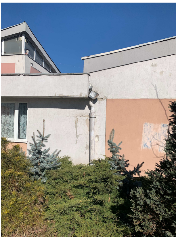
Zdj.4 . Uszkodzone sztucery - wymiany
