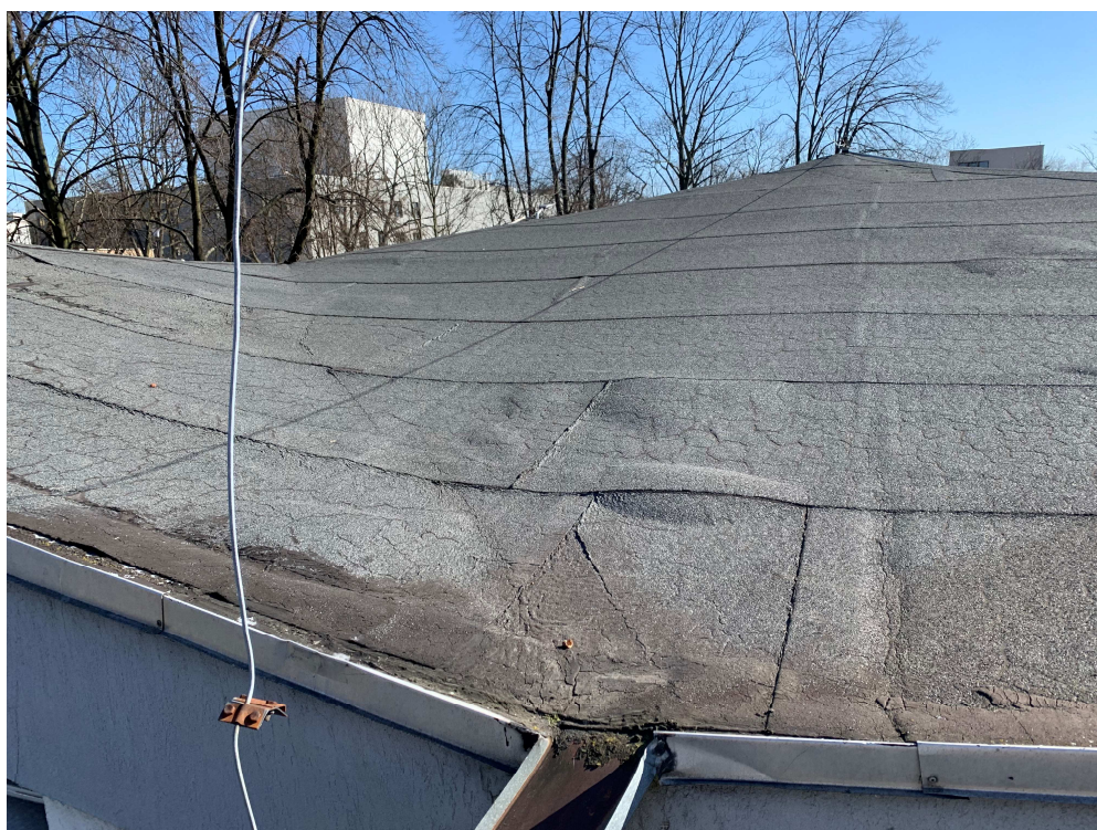
Zdj.2 . Puchle na dachu, spowodowane złym montażem/zgrzaniem warstwy papy, uszkodzone obróbki przy odpływach
