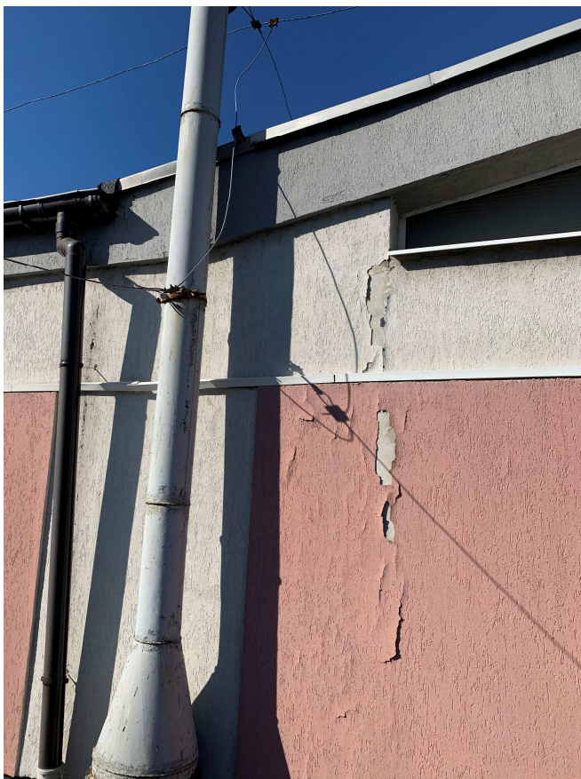
Zdj.5 . Uszkodzenia tynku – zeszkrobać części odspojone
