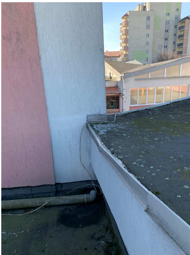
Zdj.3 . Mała średnica odpływu oraz uszkodzone obróbki dachu do wymiany
