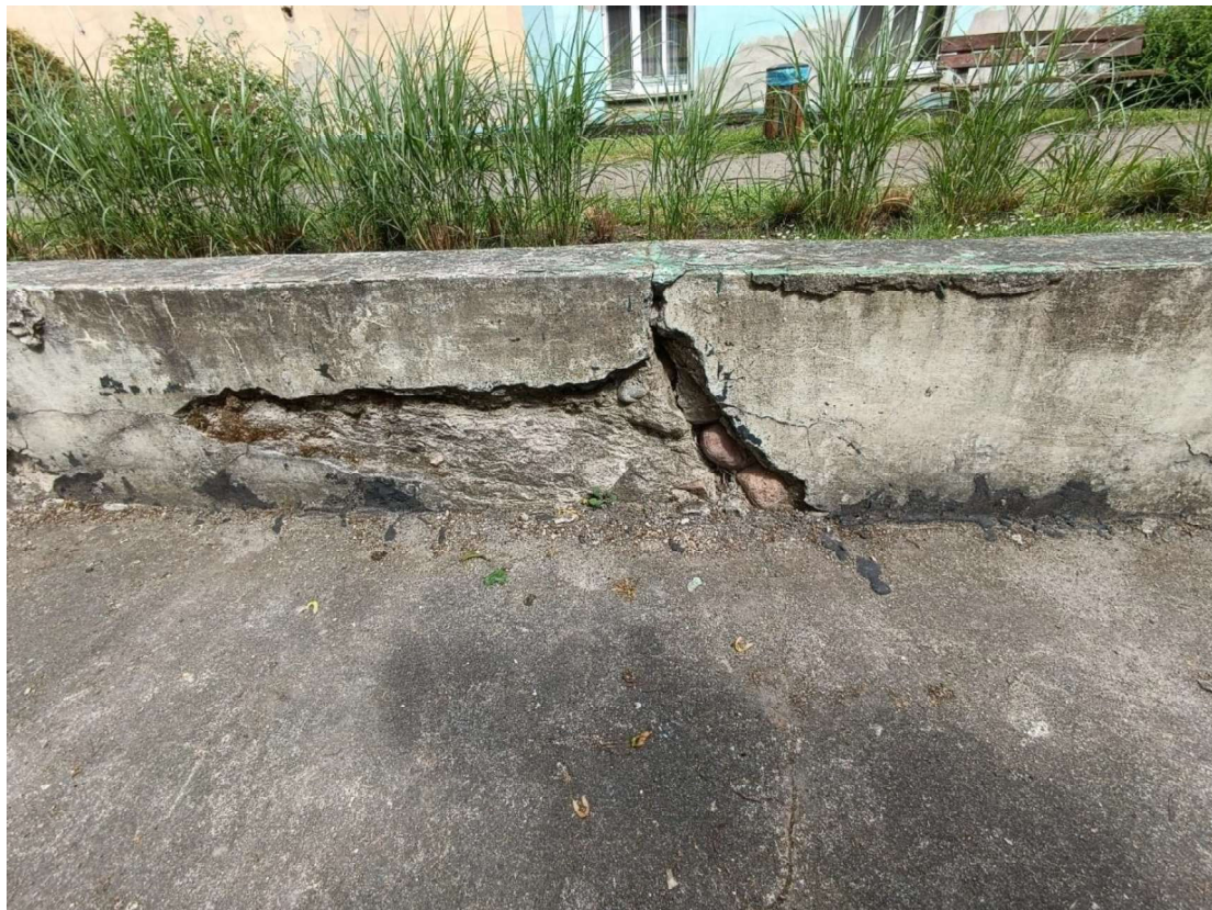
Zdjęcie nr 5, Odspojenia i pęknięcia ścian betonowej niecki
