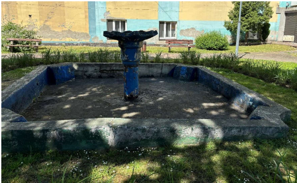
Zdjęcie nr 1, Uszkodzenie konstrukcji niecki, widoczne przełamanie na murku
