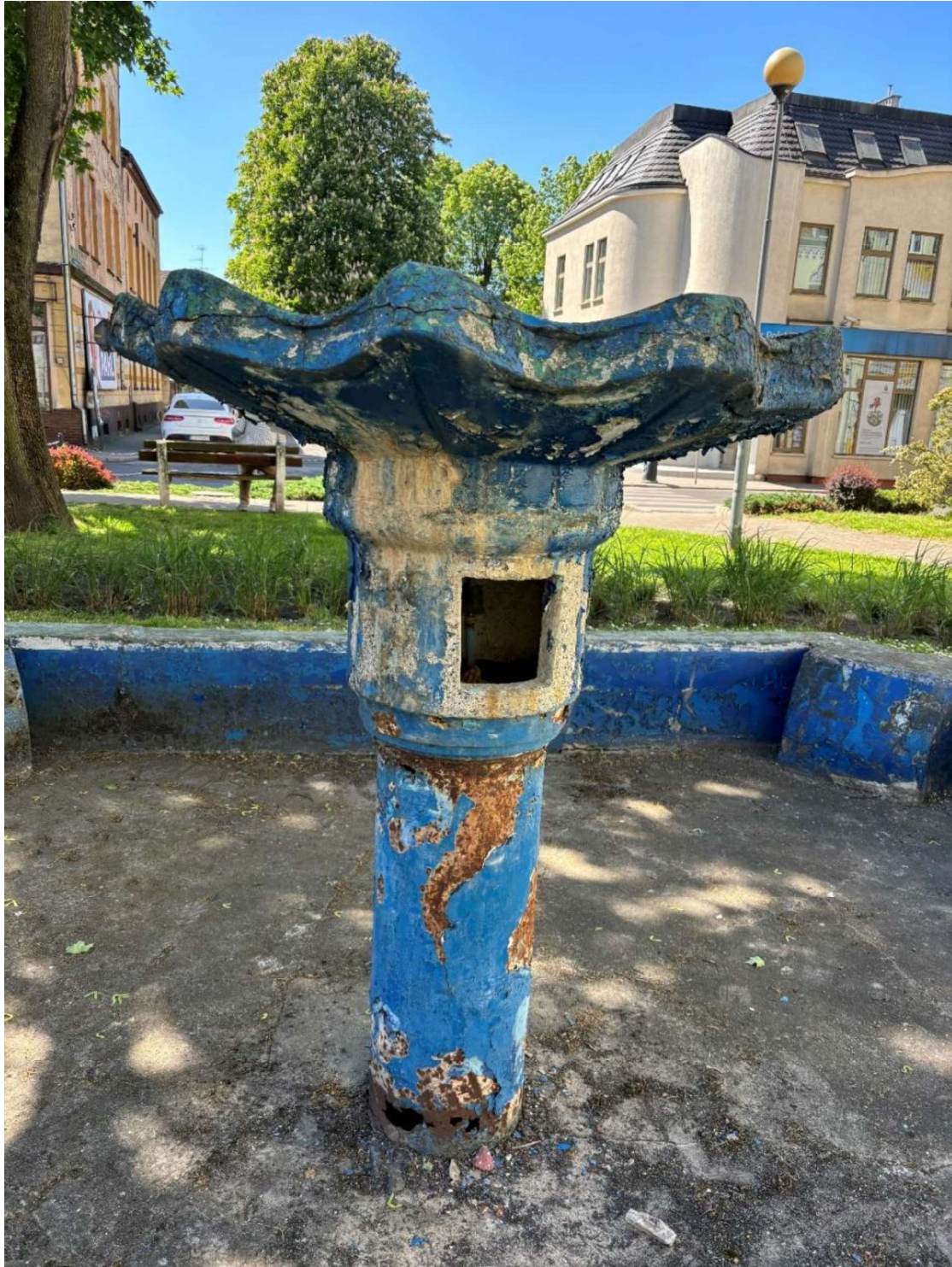
Zdjęcie nr 2, Spękania, ubytki w wyposażeniu zwieńczenia fontanny
