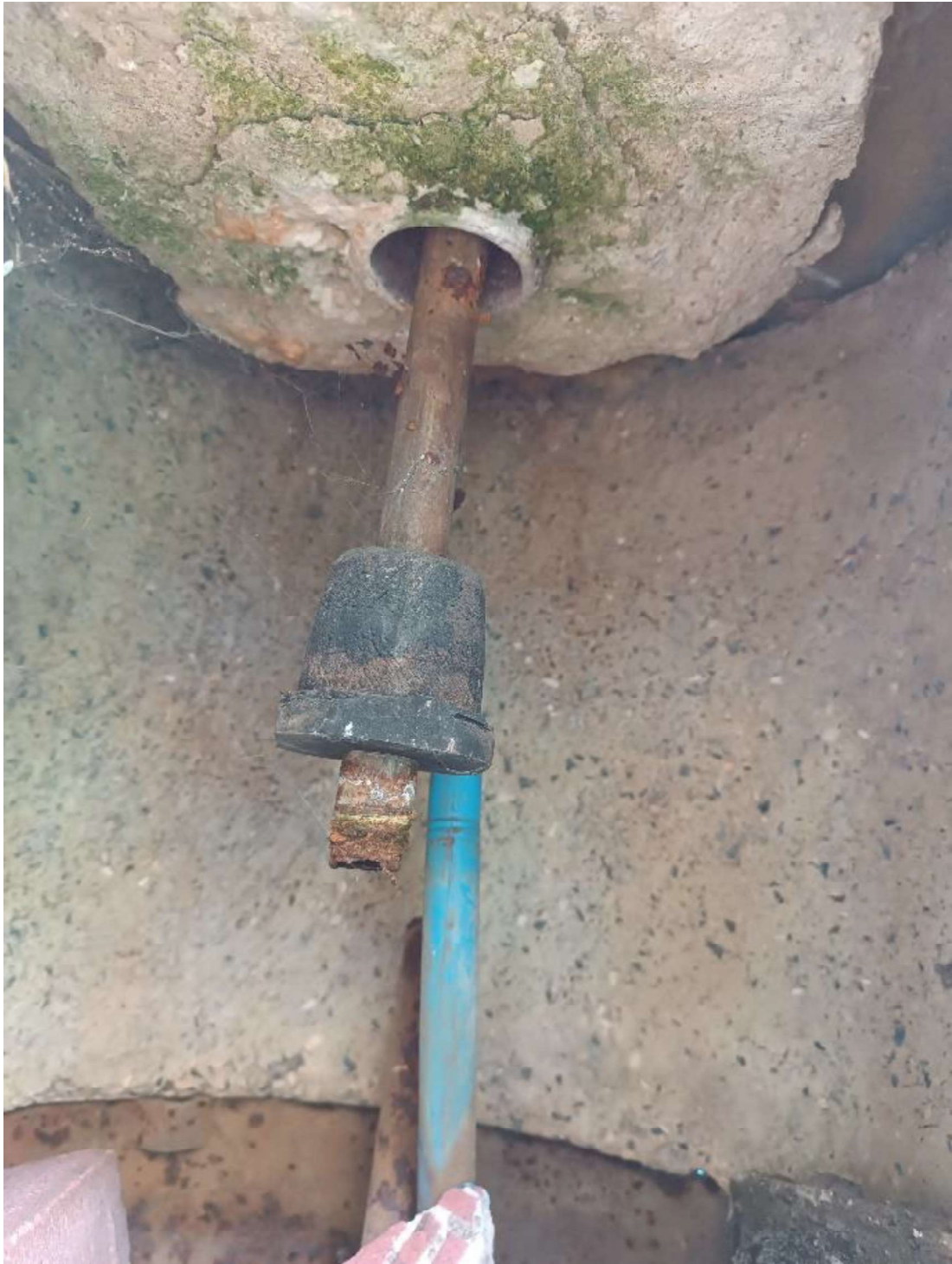
Zdjęcie nr 7, Brak ciągłości elementów systemu sanitarnego fontanny
