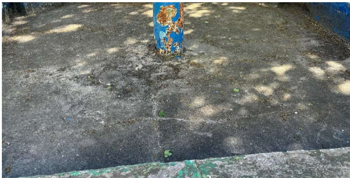
Zdjęcie nr 4, Spękania i złuszczenia betonu
