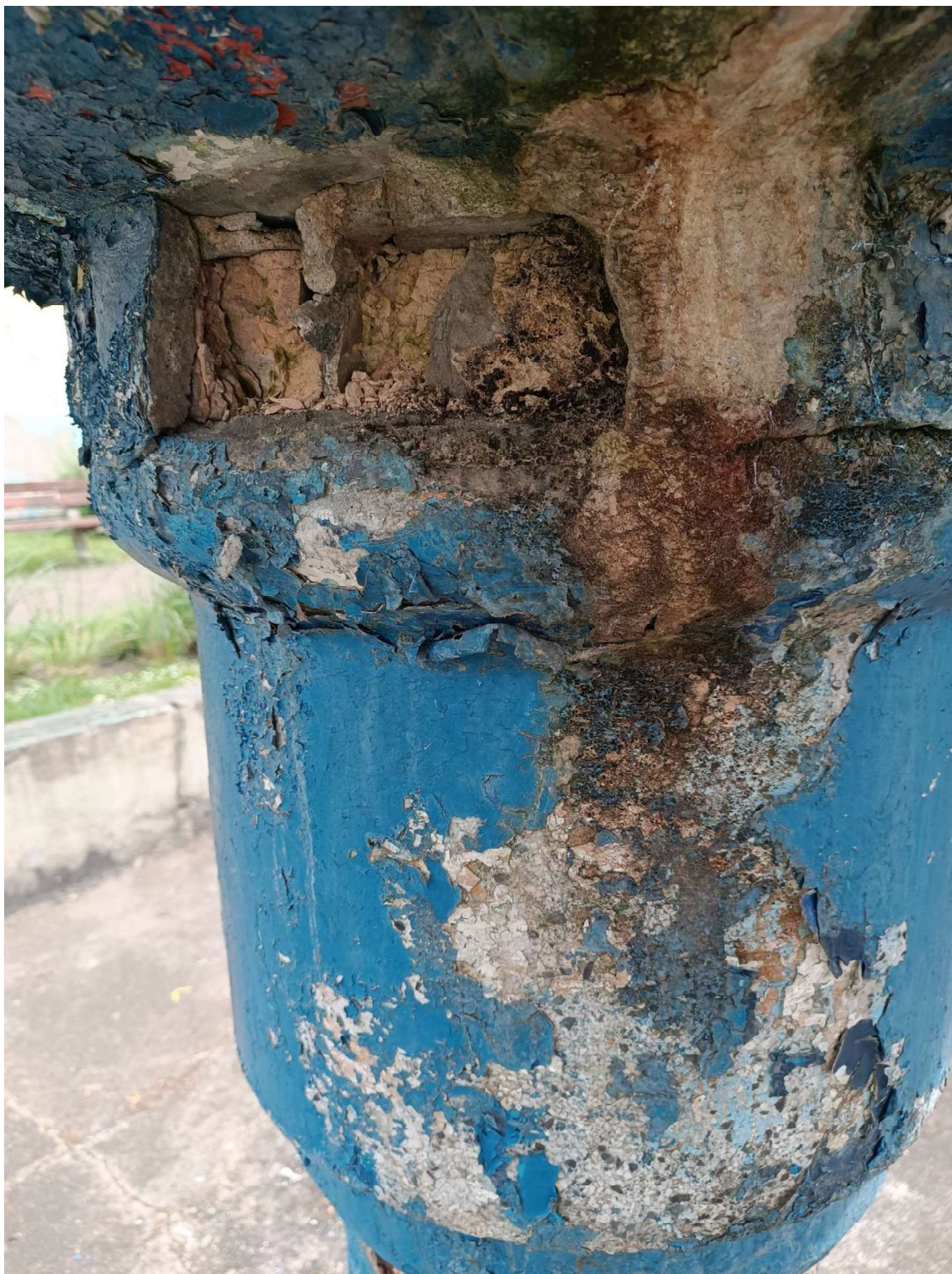
Zdjęcie nr 8, Widoczne ubytki materiałów konstrukcyjnych słupa fontanny – cegieł i lastryko
