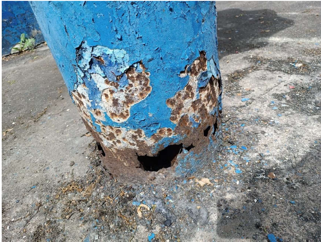
Zdjęcie nr 3, Zaawansowana korozja trzonu fontanny
