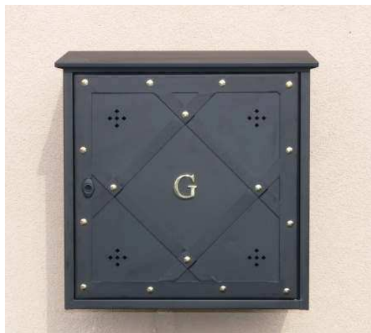
Zdj. 85 Osłona szafki gazowej; źródło: http://www.ehydrogaz.pl/Zabudowa_wnek_starogrodzka_6060-257.html
