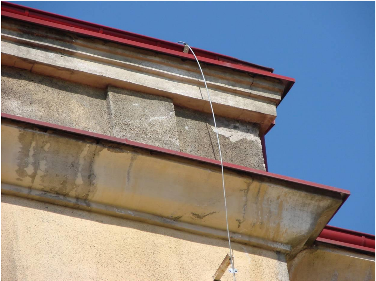
fol.28 Budynek nr 5 AMW przy ul.Śmidowicza w Gdyni., fragment zwieńczenia elewacji frontowej, widoczne spękania, zabrudzenia i wtórne warstwy przemalowań w obrębie gzymsów, przestrzeń między gzymsami pokryta wtórnie cementowym tynkiem nakrapianym (barankiem).
