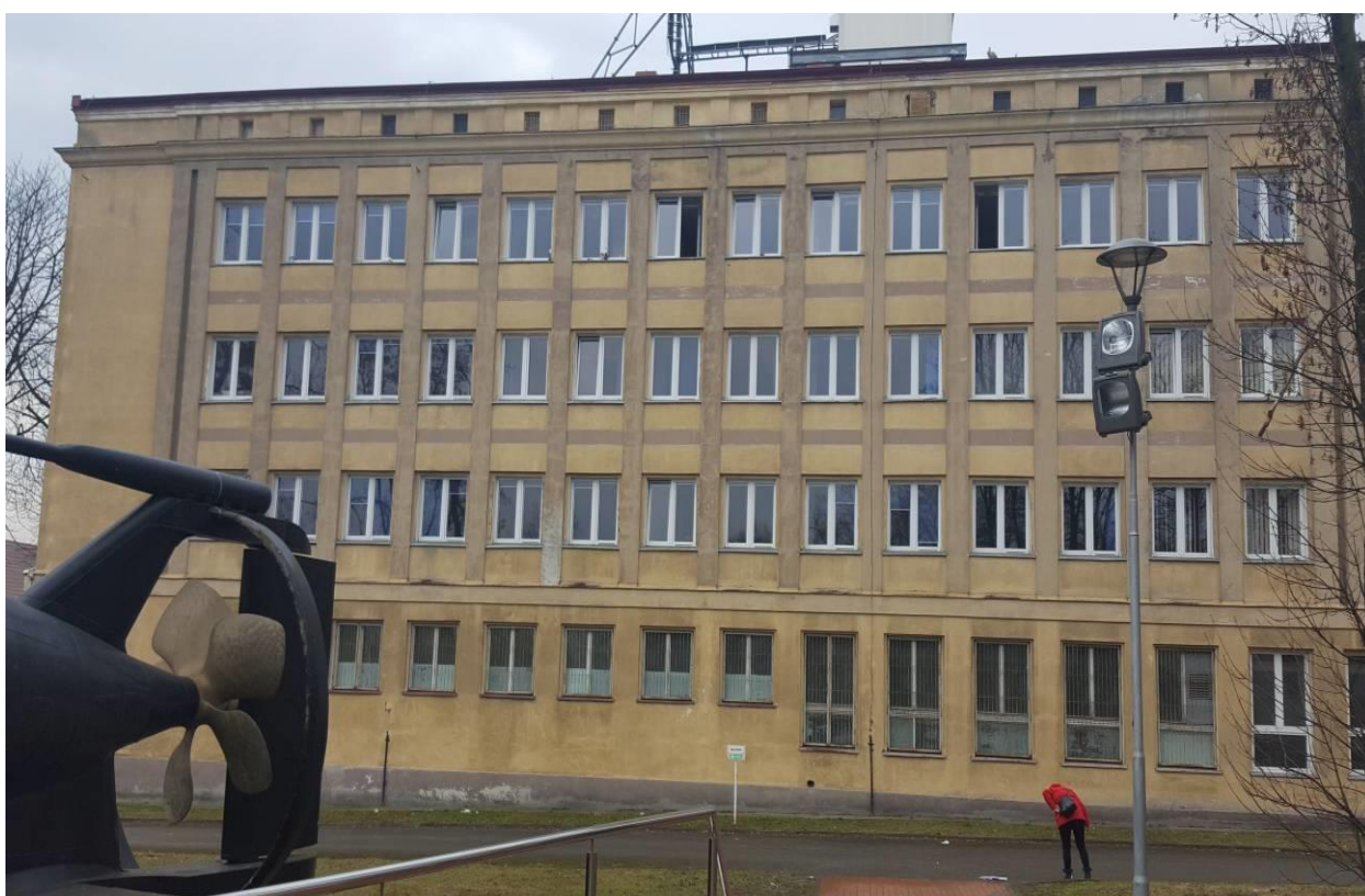
fot.25 Budynek nr 5 AMW przy ul.Śmidowicza w Gdyni., widok na elewację skrzydła zachodniego od dziedzińca.
