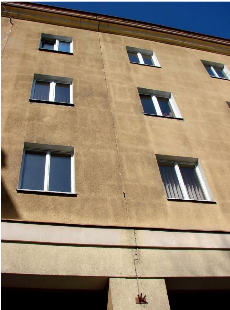
fot.22 Budynek nr 5 AMW przy ul.Śmidowicza w Gdyni, widok na elewcję wschodnią zachodniego skrzydła budynku, widoczne wtórnje dekorowane, malowane płyciny podokienne zakłcają pierwotną koncepcję kolorystyczną
