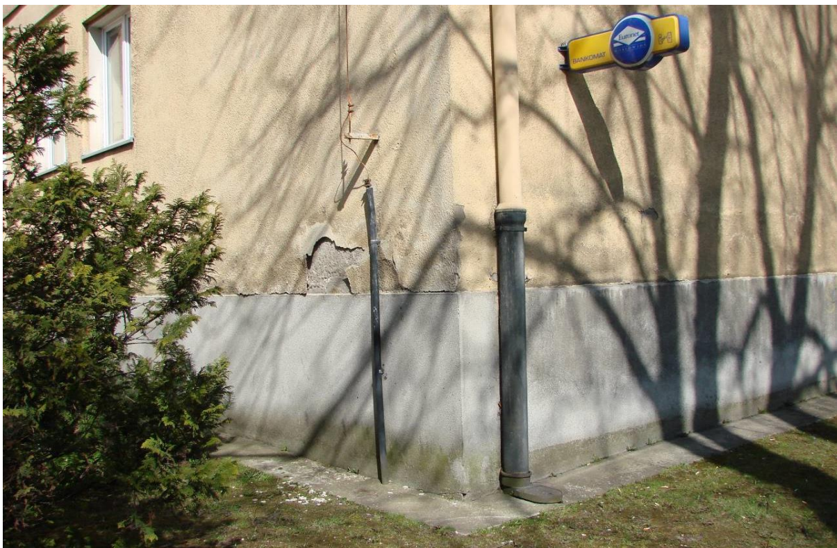
fol.29 Budynek nr 5 AMW przy ul.Śmidowicza w Gdyni., strefa cokołowa, zniszczenia spowodowane podciąganiem wody, ujawniające się powyżej lastrykowego cokołu – w strefie wysychania, świadcza o nieskutecznej izolacji budynku
