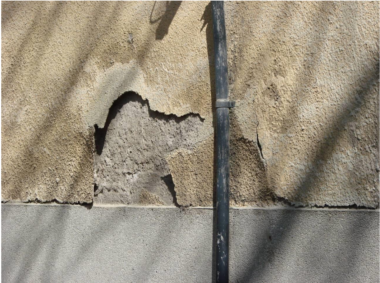
fot.30 -32 Budynek nr 5 AMW przy ul.Śmidowicza w Gdyni., strefa cokołowa, zniszczenia spowodowane podciąganiem wody, ujawniające się powyżej lastrykowego cokołu – w strefie wysychania, świadcza o nieskutecznej izolacji budynku, widoczne cementowe, wcześniejsze naprawy
