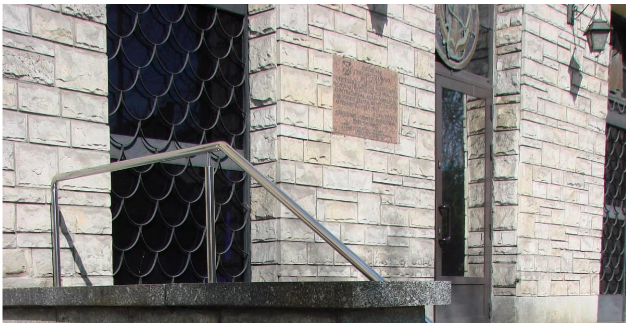
fot.13 - 17 Wejście główne, widoczne odspojenia okładziny granitowej, zabrudzenia piaskowca i metalu
