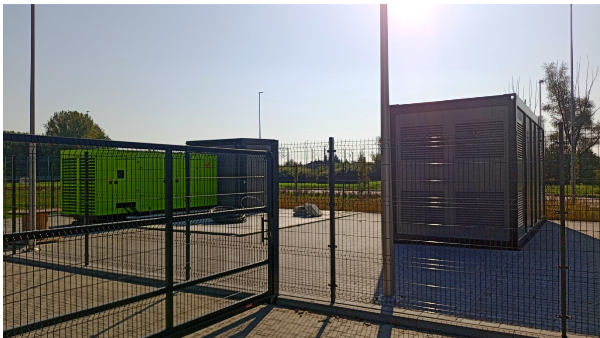
8. Strefa techniczna (agregat prądowórczy, rozdzielnia główna, stacja trafo).[2]
