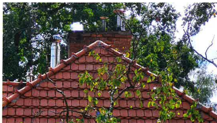
Fot. 8 Stan komina od strony północnej
