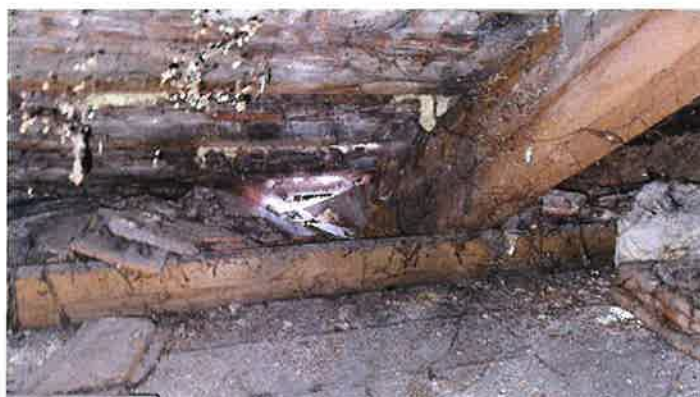
Fot. 11 Ubytek w poszyciu dachowym
