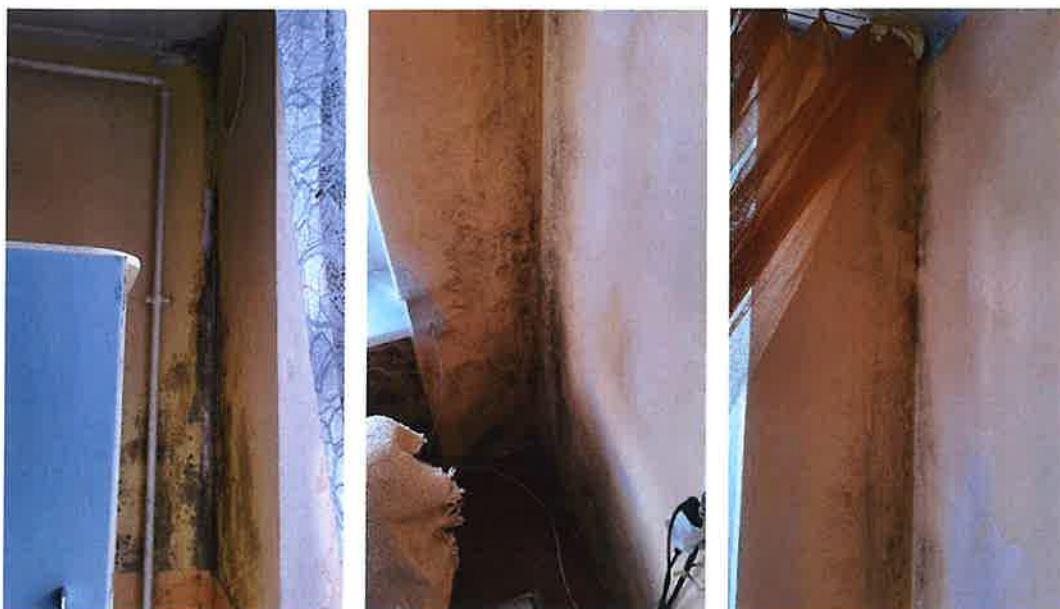
Fot. 14, 15, 16 Zagrzybienia ścian mieszkania nr 5 na piętrze (facjata)
