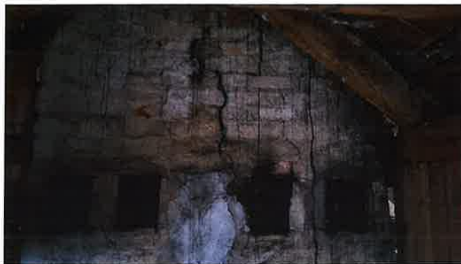
Fot. 13 Spękany komin południowy
