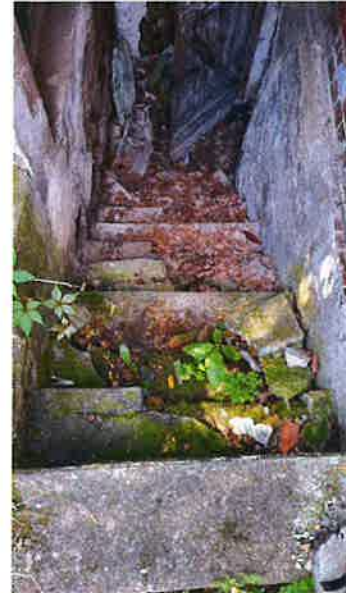
Fot. 7 Stan schodów w zejściu zewnętrznym do piwnicy
