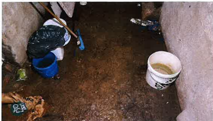
Fot. 19 Woda na posadzce w piwnicy mieszkania nr 2
