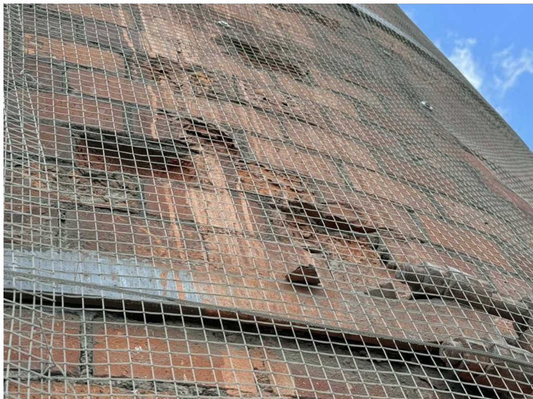
Fot. 34. Zaawansowana korozja cegieł
