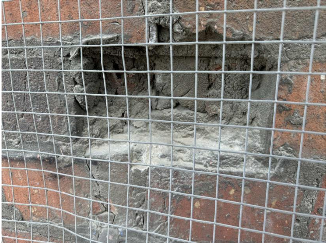
Fot. 31. Ubytki cegieł w środkowej części komina, korozja wgłębna
