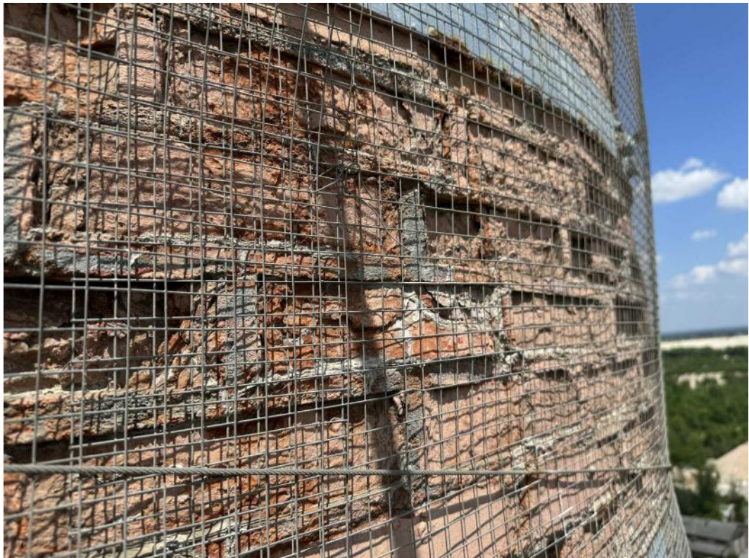
Fot. 19. Część głowicowa – zniszczenie zewnętrznej części muru na kilka centymetrów
