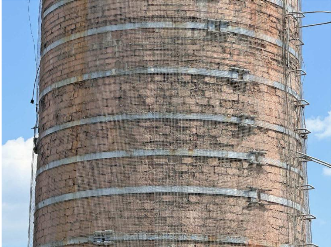
Fot. 6. Część poniżej głowicy - degradacja trzonu, głębokie ubytki lic cegieł
