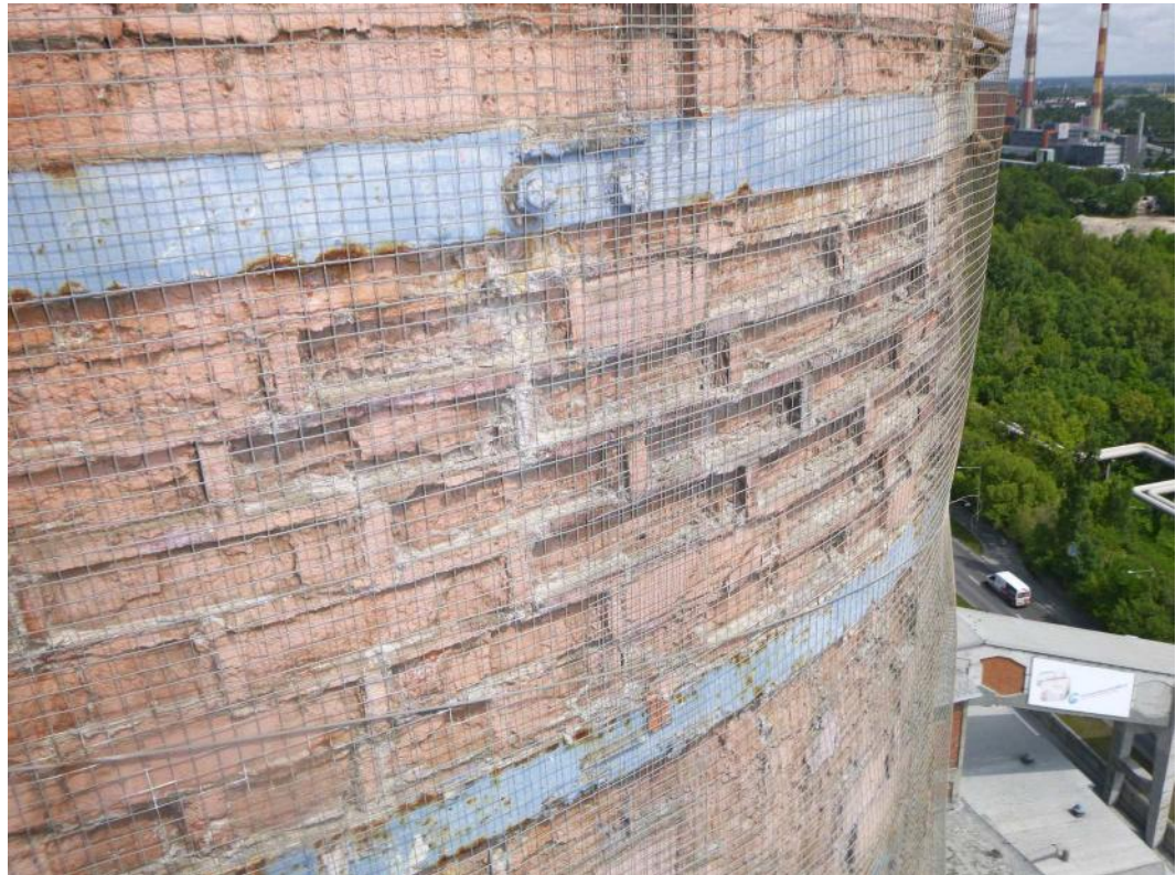
Fot. 20. Zniszczenie praktycznie wszystkich lic cegieł na koronie komina
