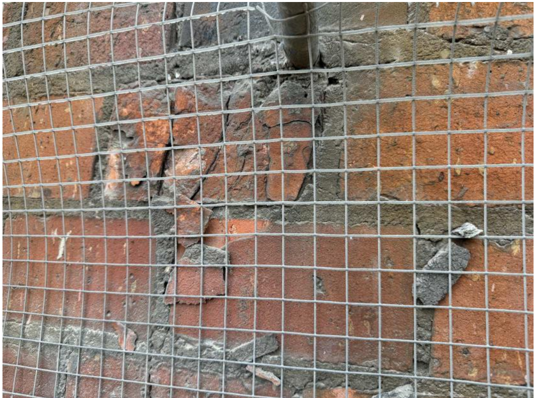
Fot. 32. Złuszczenie lic cegieł i zaprawy
