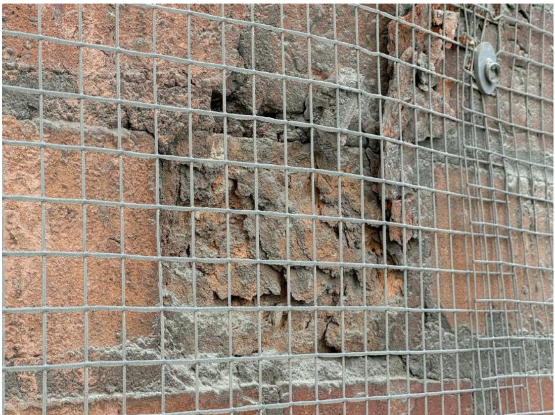
Fot. 37. Zaawansowana korozja muru, złuszczenie kolejnych warstw
