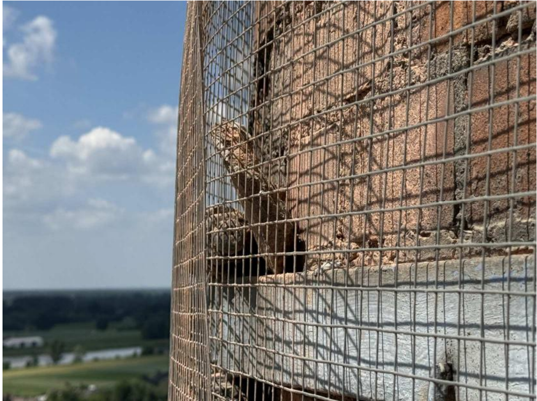
Fot. 25. Odpadanie zdegradowanych lic cegieł
