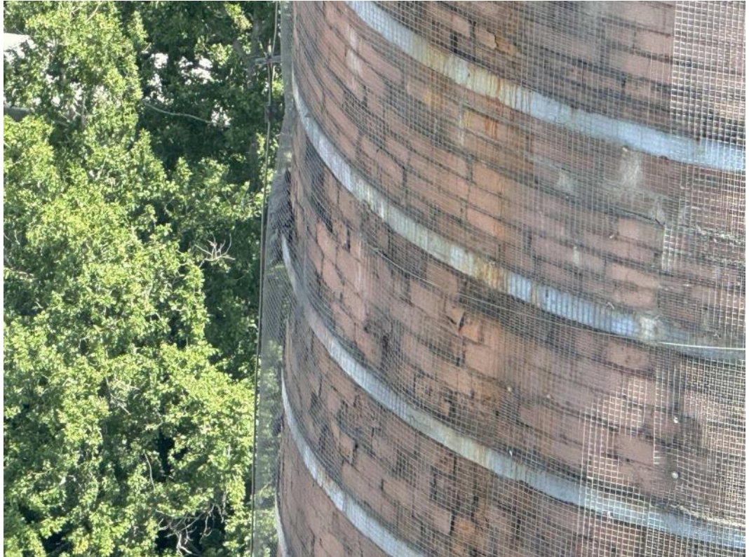
Fot. 12. Górna część kominia – liczne odpojenia lic, wycieki, degradacja muru
