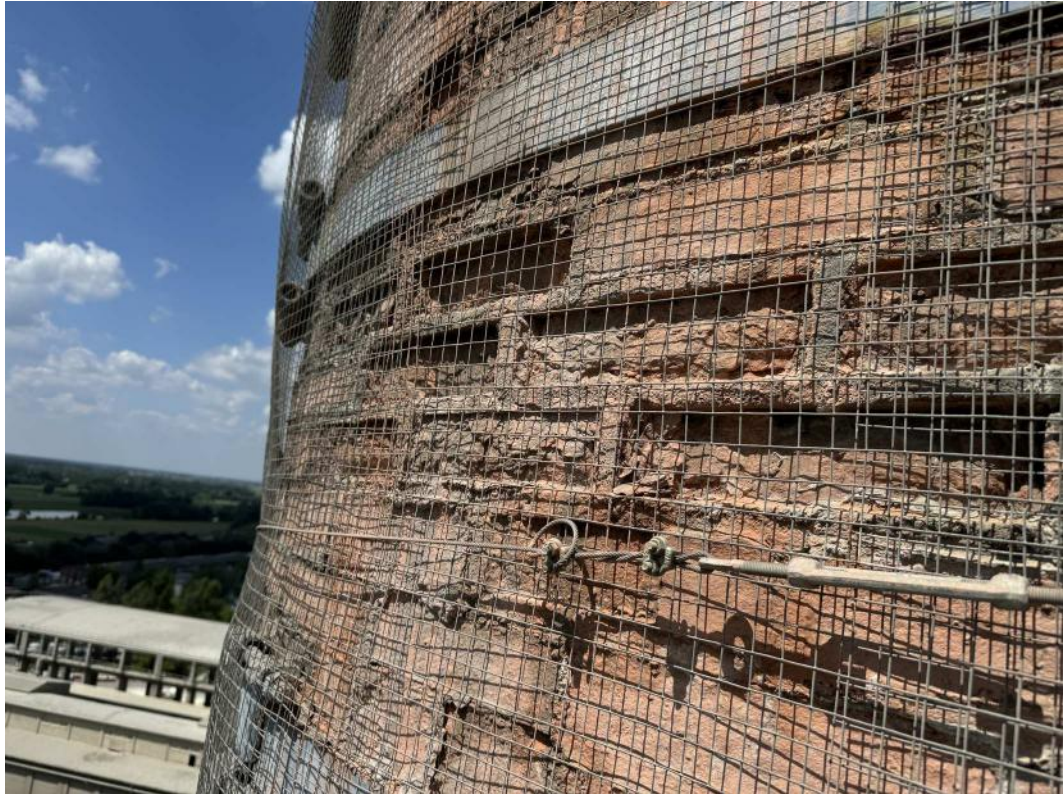
Fot. 18. Część głowicowa - skrajne zniszczenie muru
