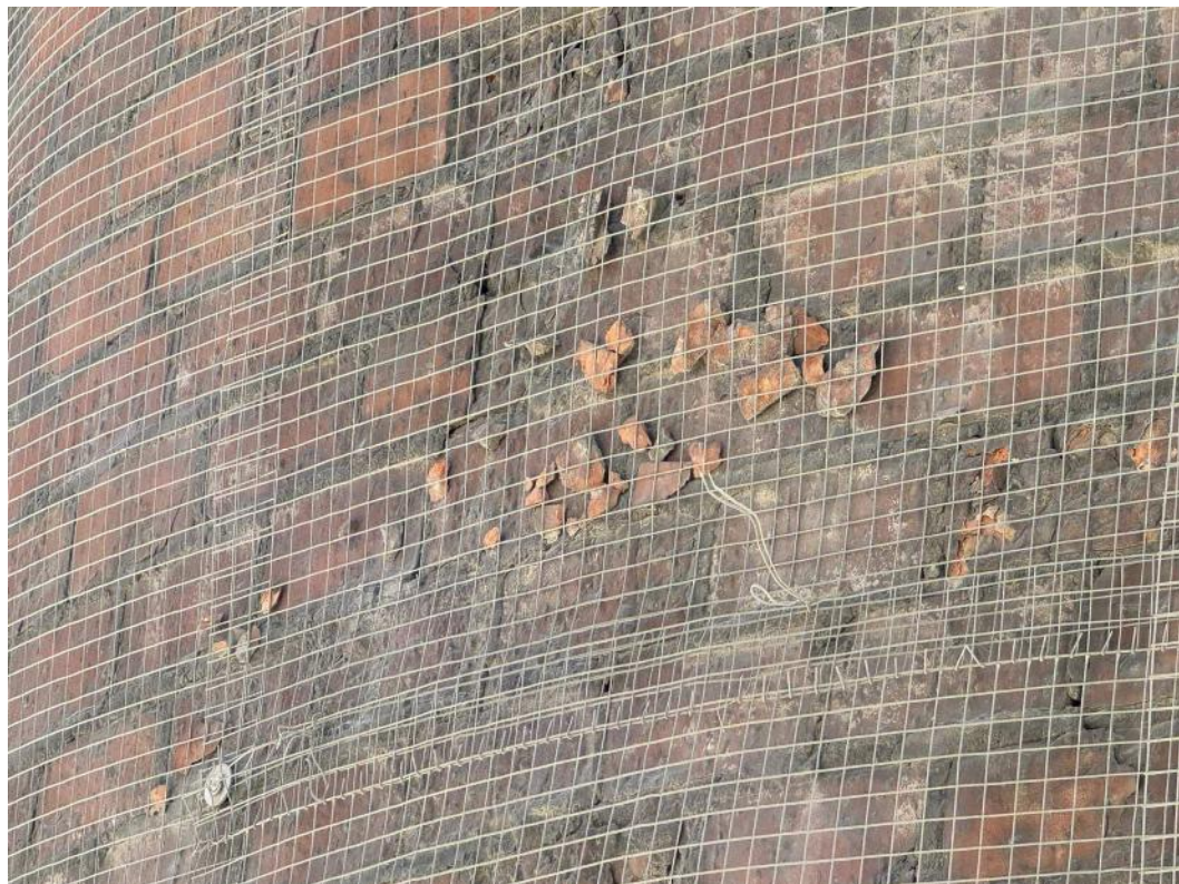
Fot. 29. Odspojenia lic cegieł wyłapywane przez siatki
