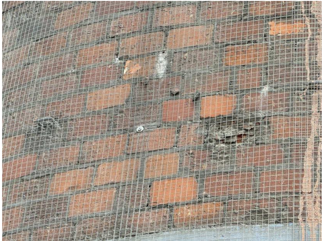
Fot. 16. Zły stan środkowej partii komina - korozja złuszczająca cegieł
