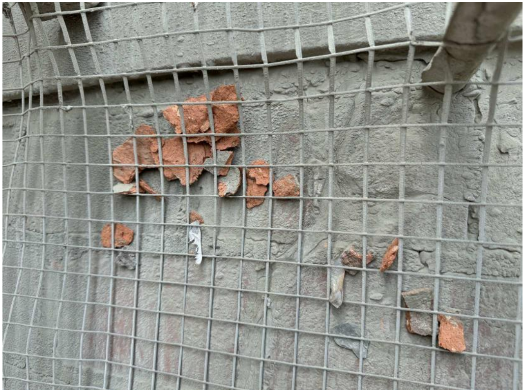
Fot. 48. Złuszczone lica wyłapanne przez siatki
