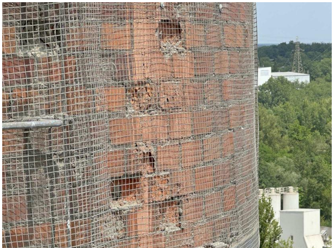
Fot. 15. Górna część komina – degradacja cegieł, ubytki do 5 cm
