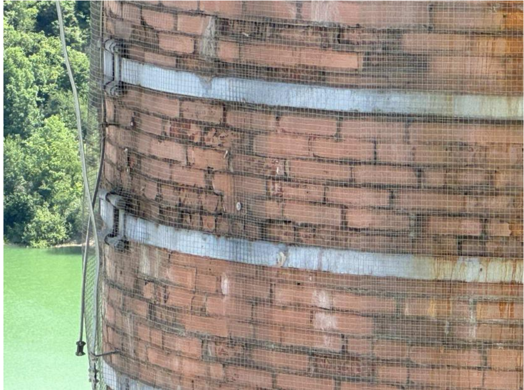
Fot. 14. Uszkodzenia górnej części komina, zruszczanie i odpadanie lic cegieł, wycieki
