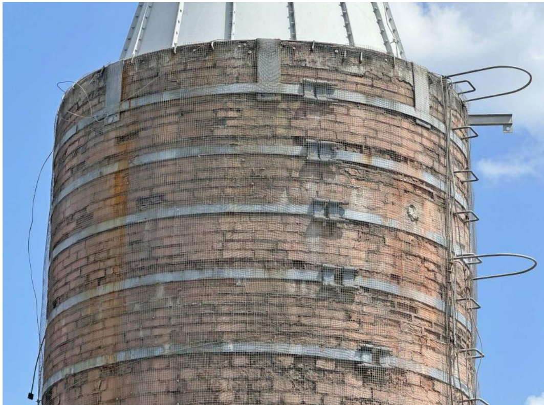
Fot. 5. Głowica komina - silna degradacja, ubytki cegieł, wycieki
