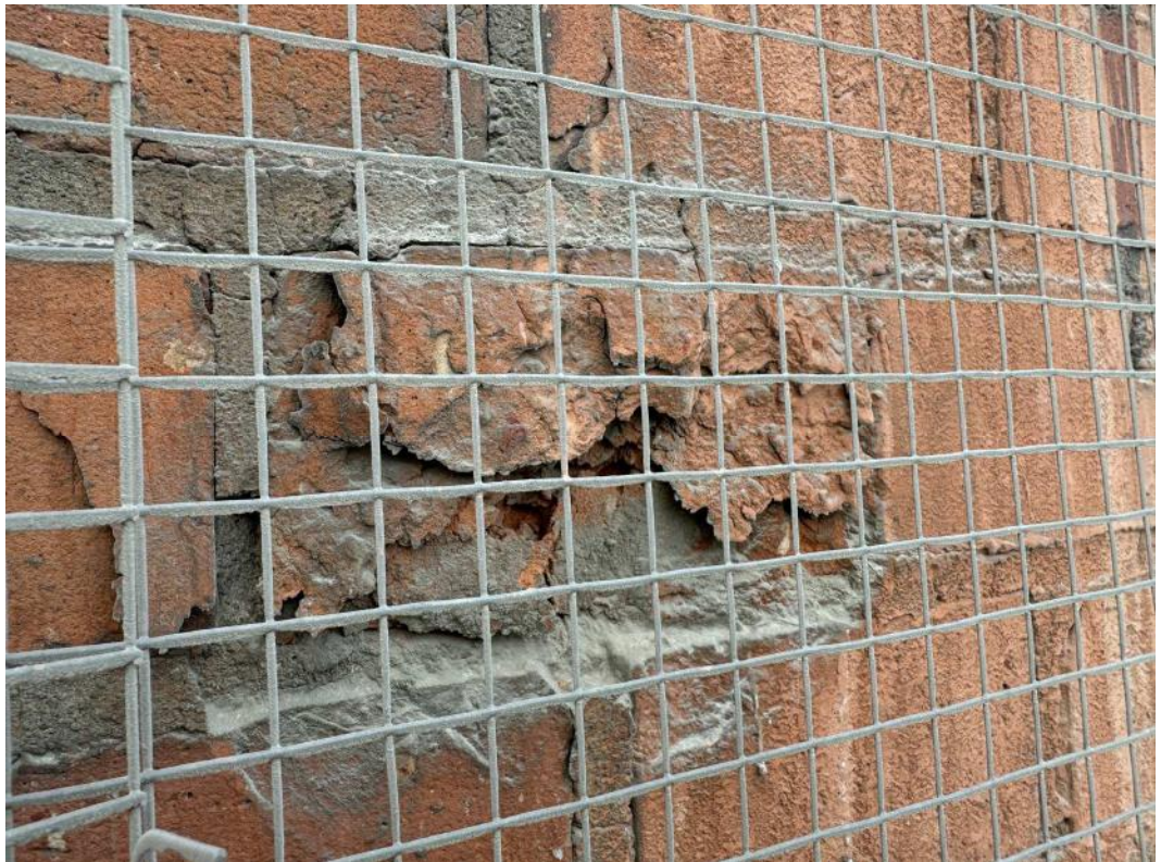
Fot. 39. Zaawansowana korozja cegieł
