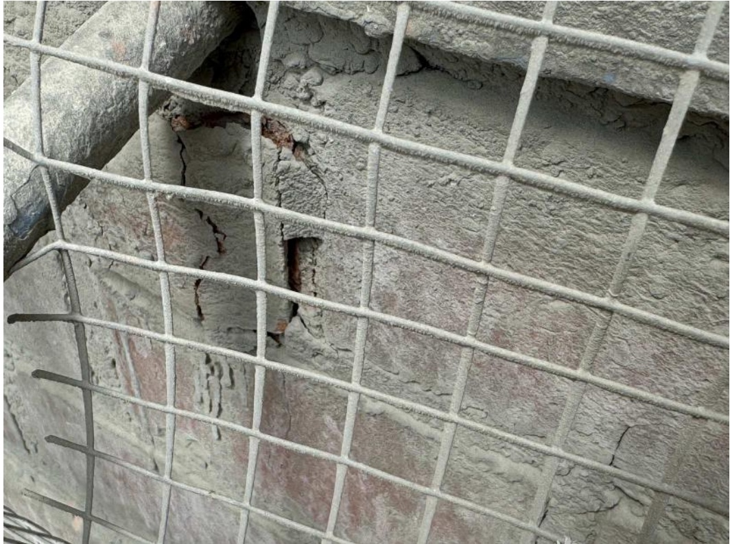
Fot. 45. Dolna część kominu - pojawiające się również miejsca intensywnej korozji
