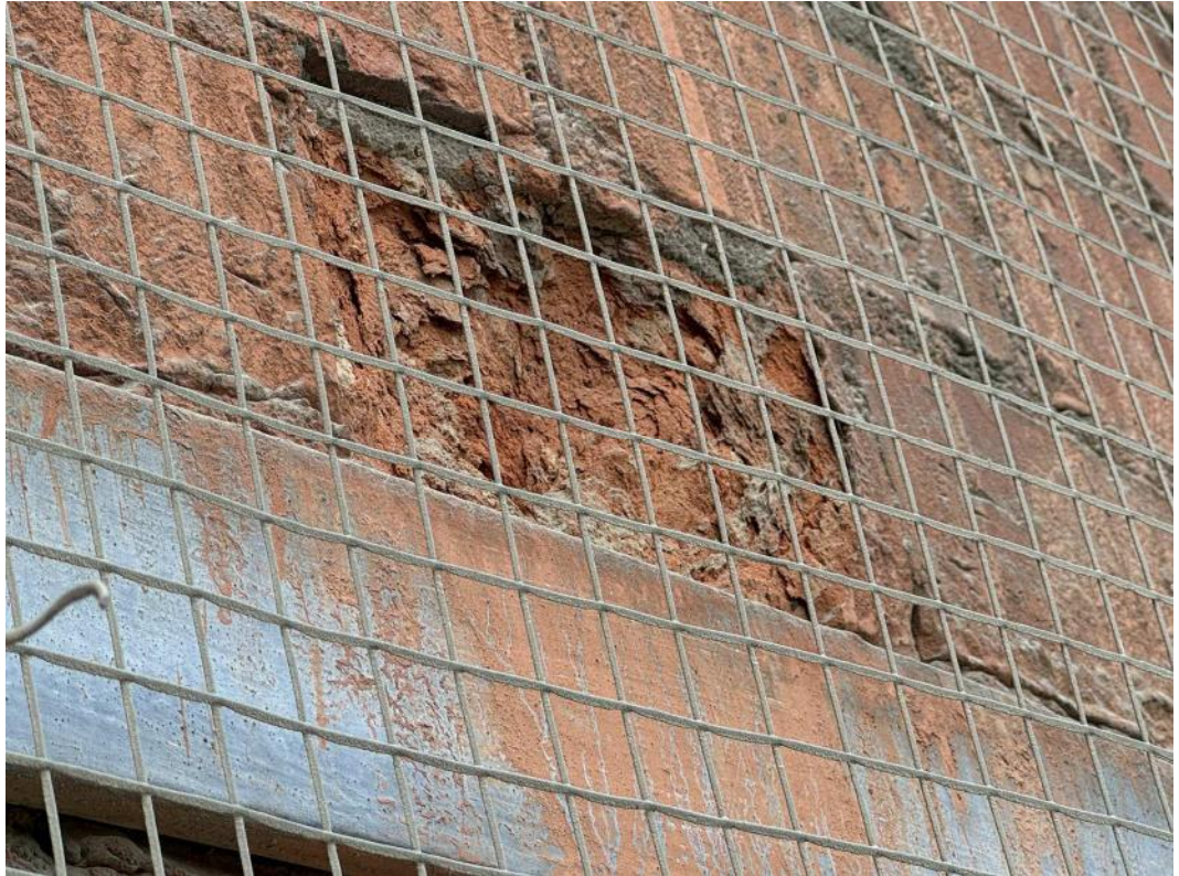
Fot. 40. Intensywna korozja cegieł
