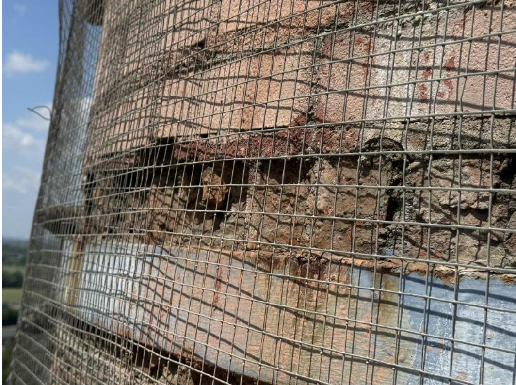
Fot. 23. Degradacja cegieł na głębokość kilkudziesięciu milimetrów
