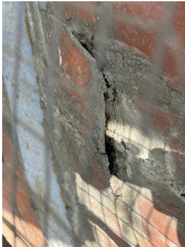
Fot. 24. Samoistne odspajanie lica cegieł
