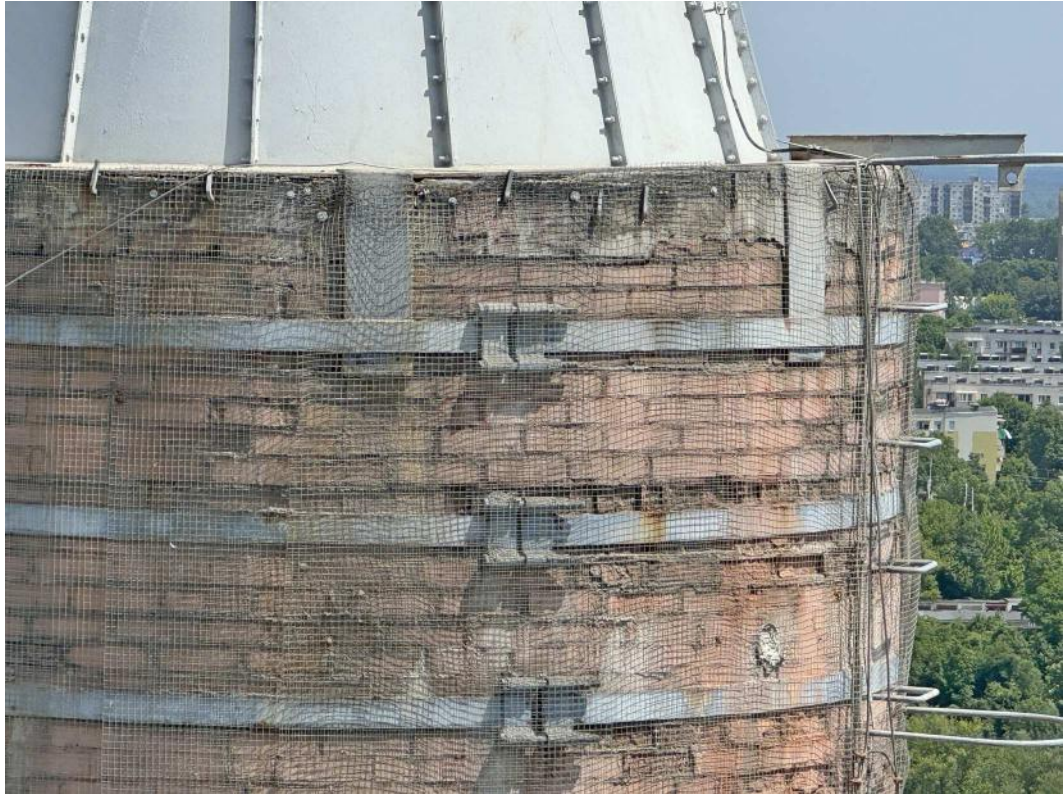
Fot. 8. Górna część komina - liczne ubytki cegieł, zawilgocenia muru, przecieki
