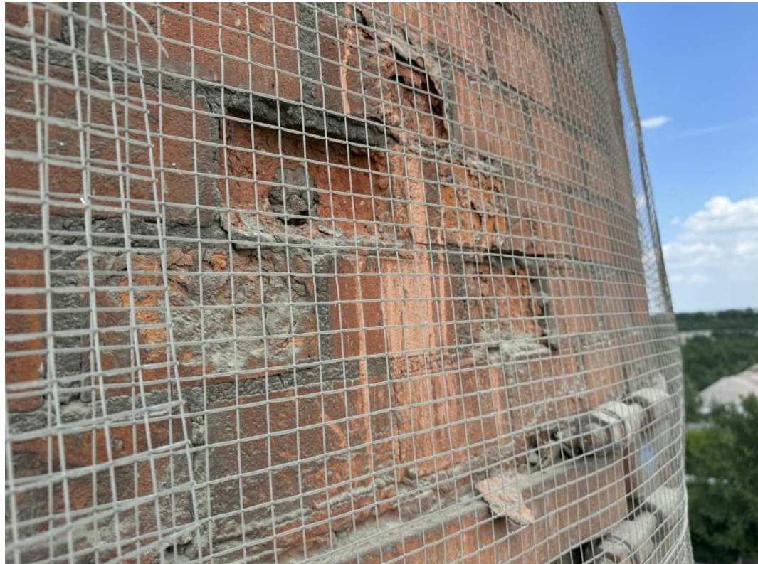
Fot. 33. Złuszczenie i osypywanie się skorodowanych lic cegieł
