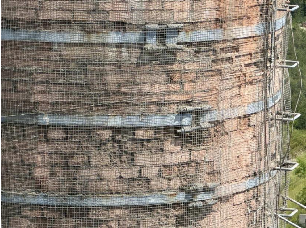
Fot. 10. Bardzo zaawansowany stan destrukcji górnej części komina
