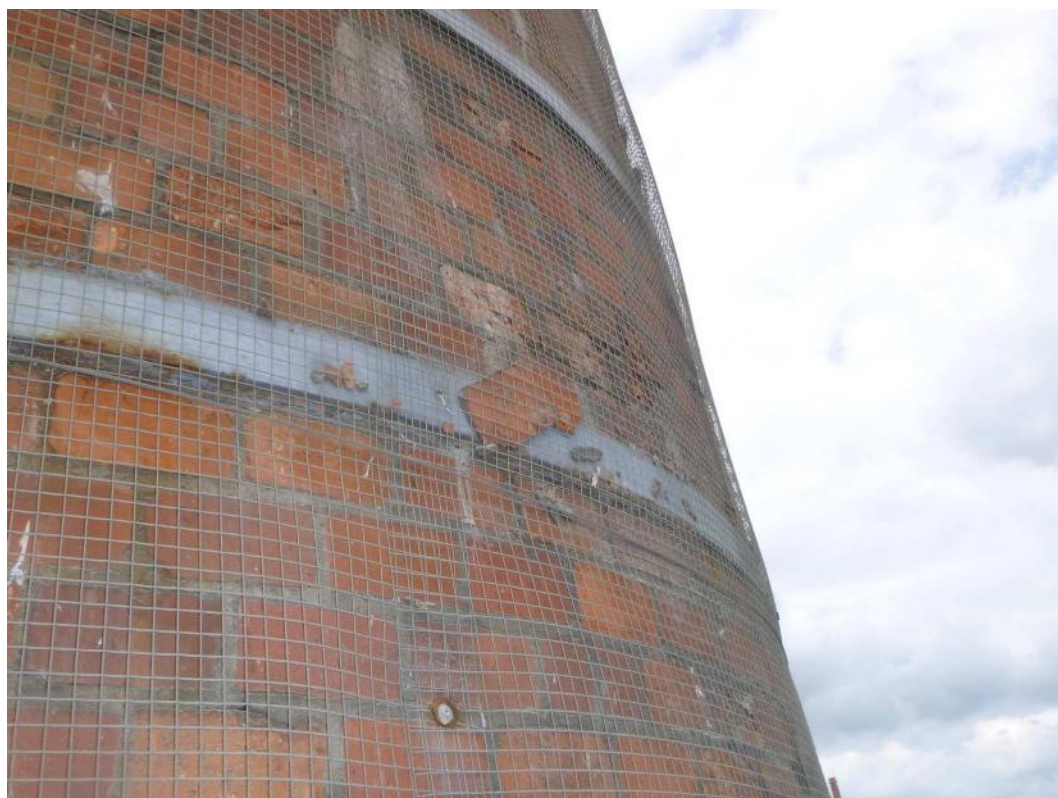
Fot. 30. Całe lica odpadające z nuru
