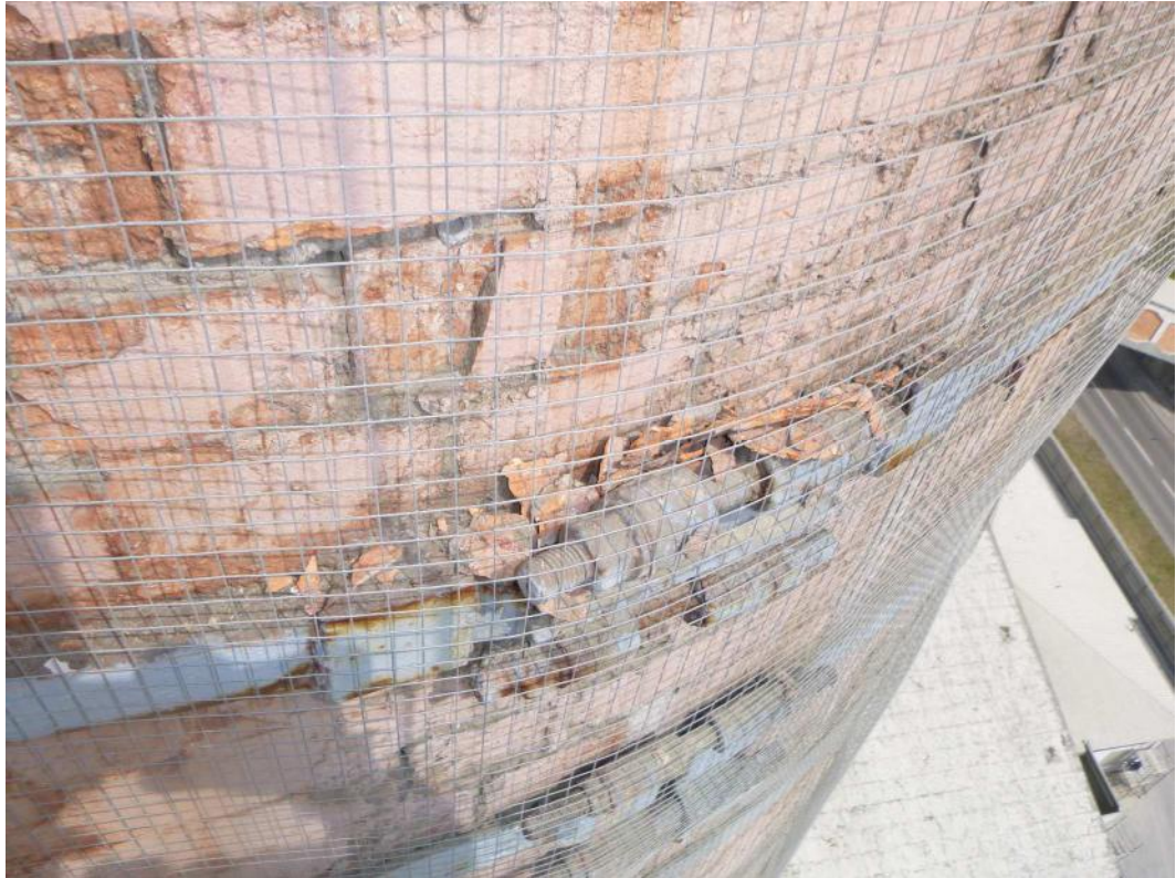
Fot. 27. Liczne odpryski lic cegieł wyłapywane przez siatki
