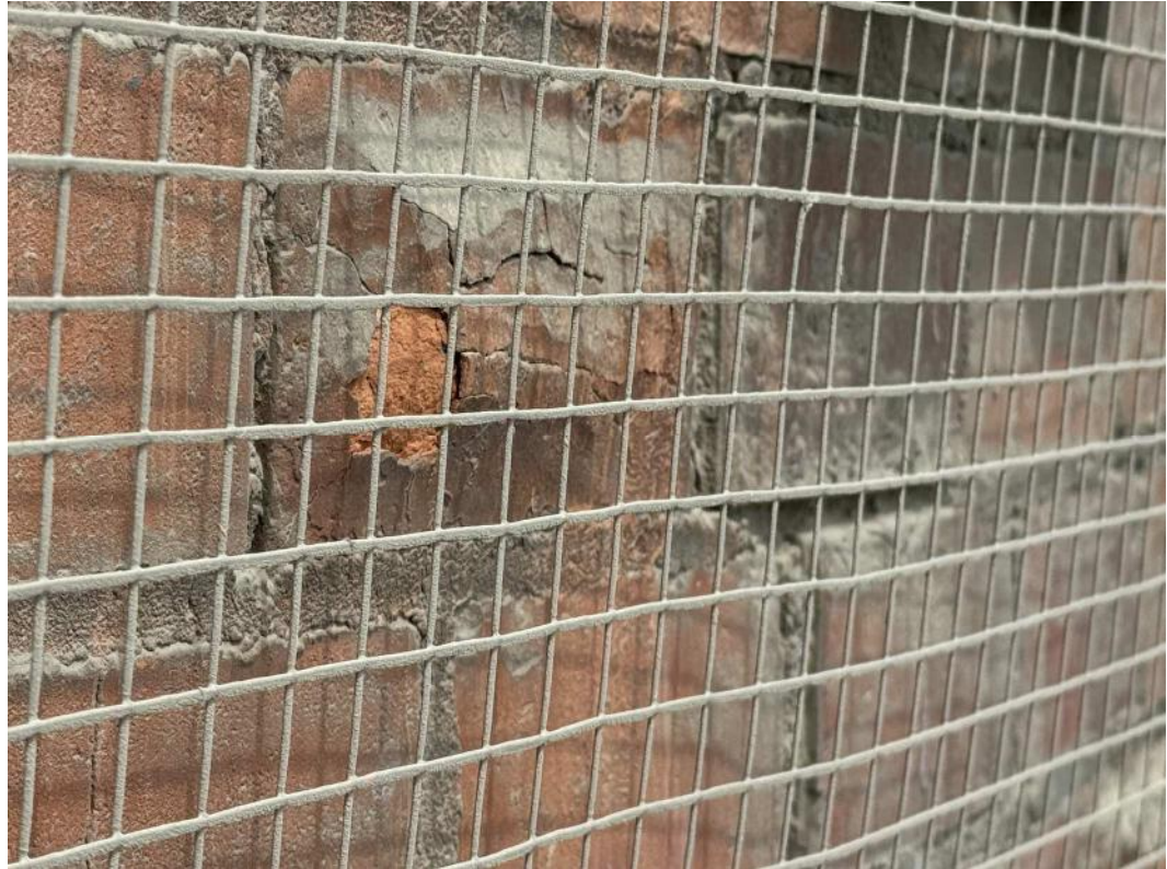
Fot. 43. Korozja pęczniająca cegieł
