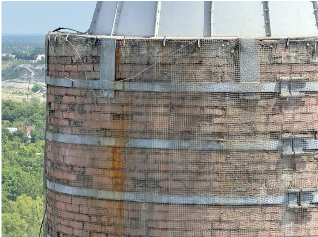
Fot. 7. Wycieki, spękania, ubytki lic głowicy komina
