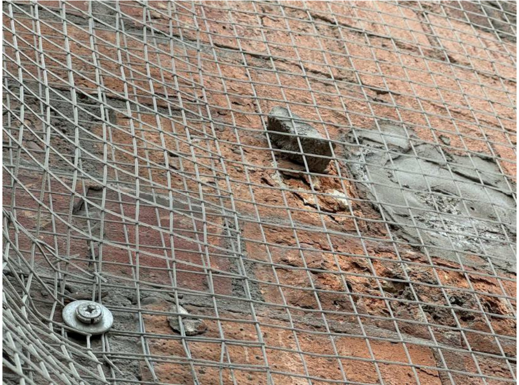
Fot. 38. Odpadające fragmenty spoin wyłapane przez siatki
