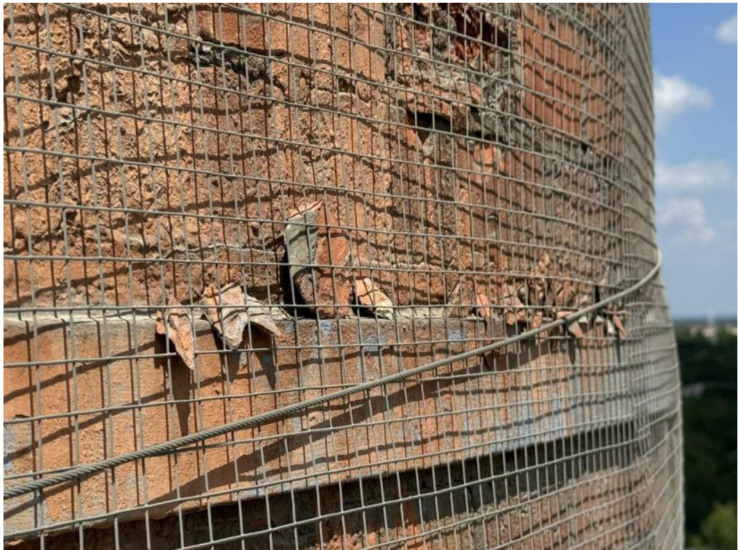
Fot. 28. Odpadające lica cegieł wyłapywane przez siatki ochronne
