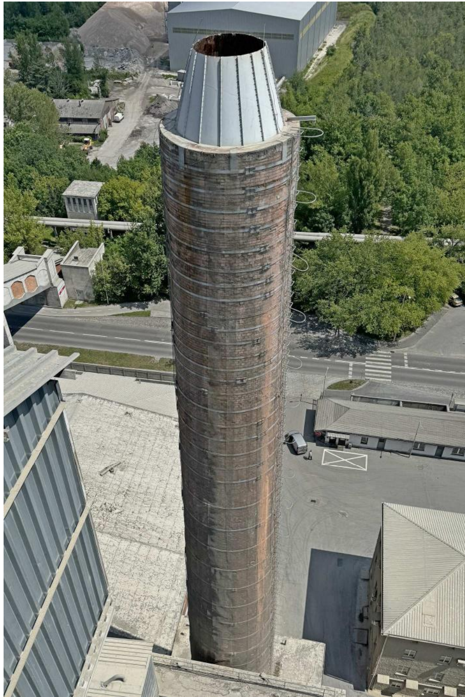
Fot. 3. Część komina ponad dachem – widoczna silna degradacja i liczne uszkodzenia
