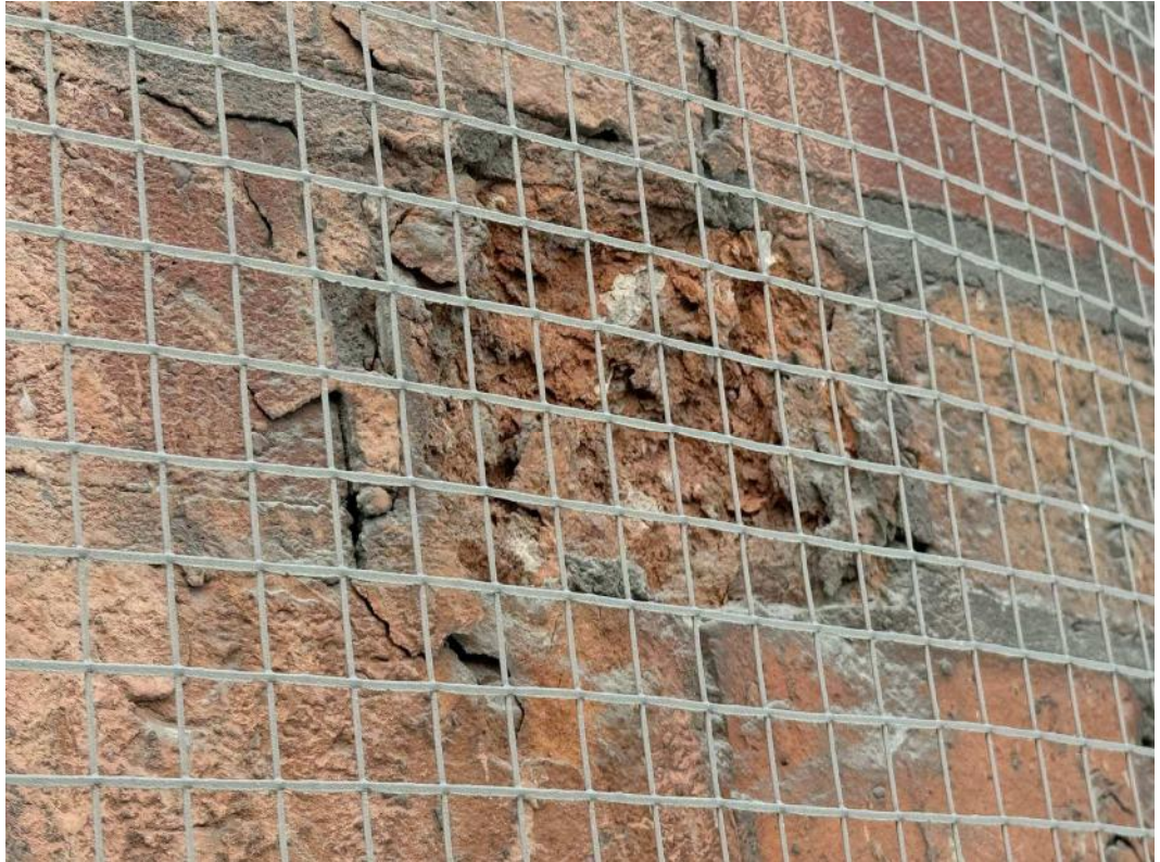
Fot. 35. Wielowarstwowe złuszczenie lic cegieł
