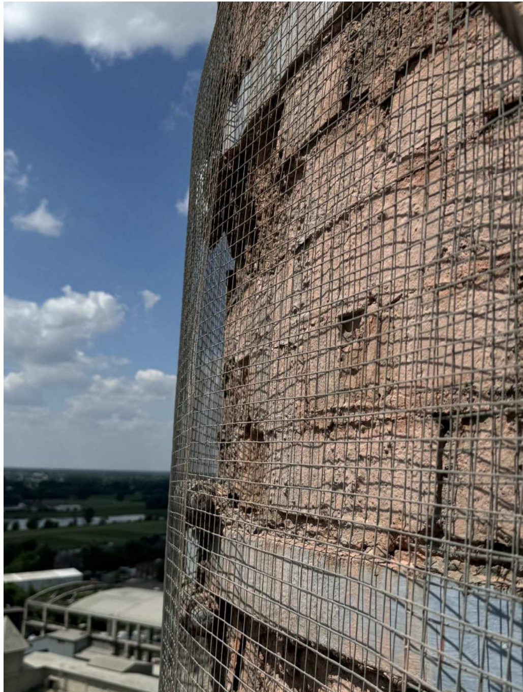
Fot. 22. Degradacja muru w górnych partiach komina na znacznej powierzchni
