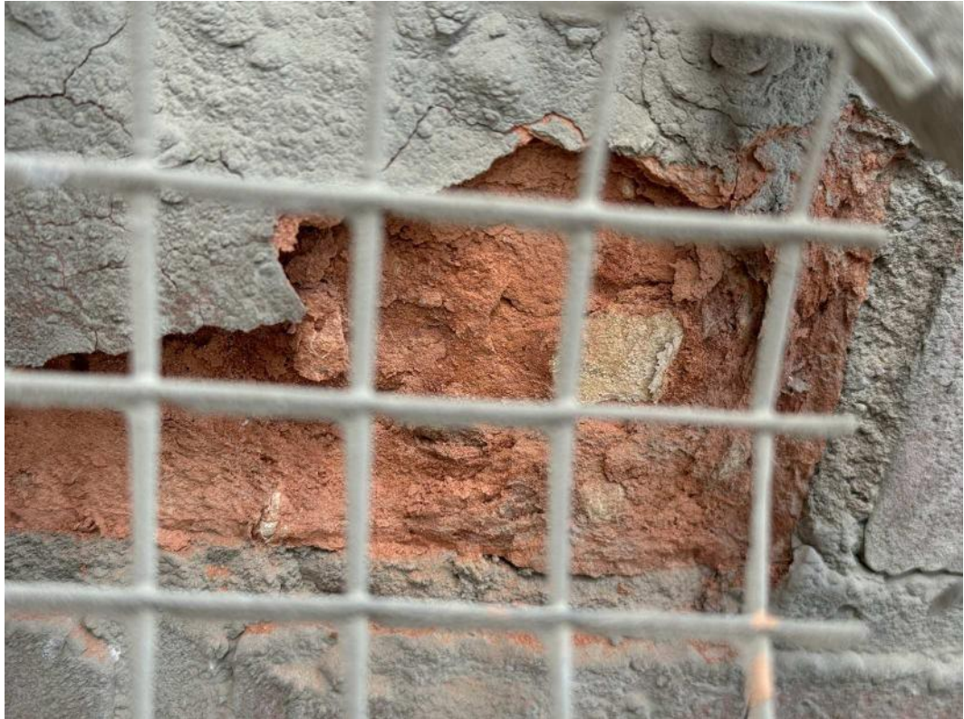
Fot. 47. Miejsca intensywnej korozji cegieł ponad dachem hali
