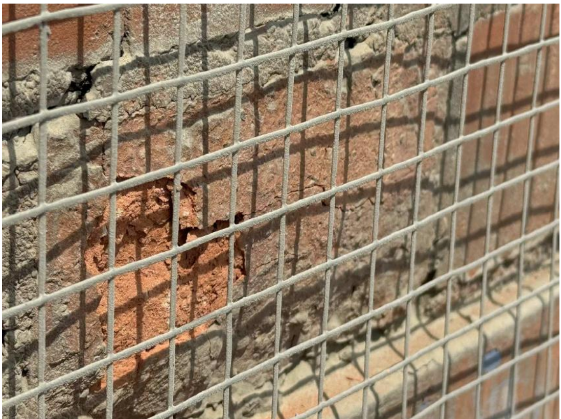
Fot. 42. Warstwy zewnętrzne cegieł odpadające pod naciskiem palca
