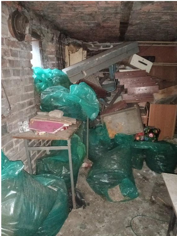
Fot.3. Śmieci w budynku
